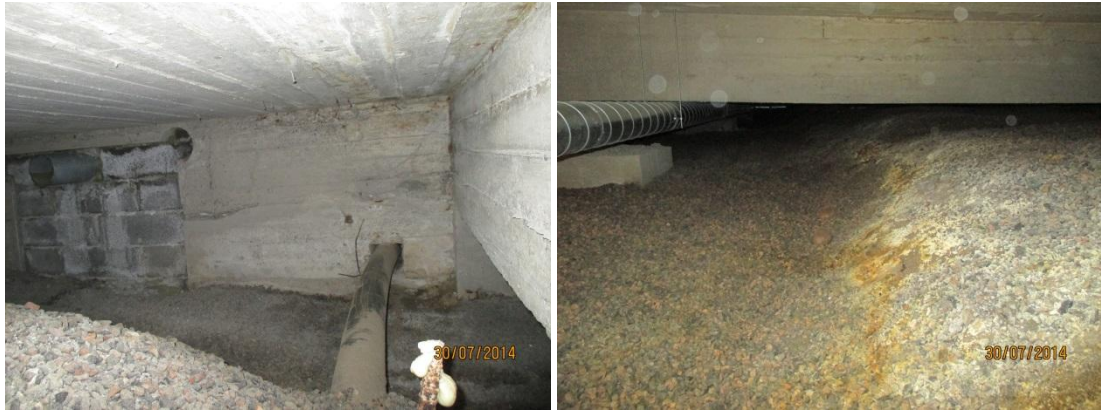
Kuvat 14a ja b. Kuvassa a on luokkatilojen alapuolista alustatilaa, jossa perusmuurin läpi on korvausilmaputkia ja umpeen muurattuja työaukkoja. tilan korkeus vaihtelee 50–90 cm. Kuvassa b on maanpinnan penkereen sivulla mikrobikasvustoa lähellä käytävää. Maapohja on kostea. Alustatilan kunto vaikuttaa olevan sama kuin v. 2006 kartoituksessa on havaittu.
