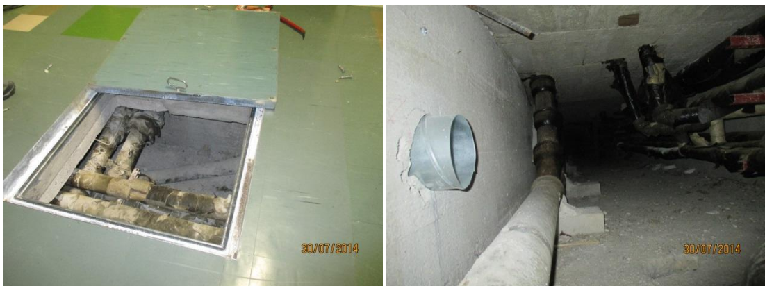
Kuvat 19a ja b. Kuvassa a on käytävän kaasutiivis luukku, joka vaikutti tiiviiltä. Kuvassa b on putkikanaali, jonka pohjalla on mm. laastijätettä. Kanaalin kyljessä on poistoilmakanavan pää.
