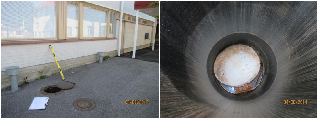
Kuvat 22a ja b. Kuvassa a on v. 1969 laajennusosan itäsivua, jossa on C-lohkon korvausilmaputkia. Salaojien perusvesi-/ tarkastuskaivo tarkastettiin, ks. kuva b. Kuvassa b on itäsivun tarkastuskaivo, jossa salaojien juoksupinnasta on lattiapintaan n. 155 cm. Kaivosta lähtee padotusventtiilillä varustettu purkuviemäri sisäpihan suuntaan todennäköisesti sadevesiviemäriin. Pohjalle on pudonnut pakkasuojaksi asennettu polystyreenilevy.
