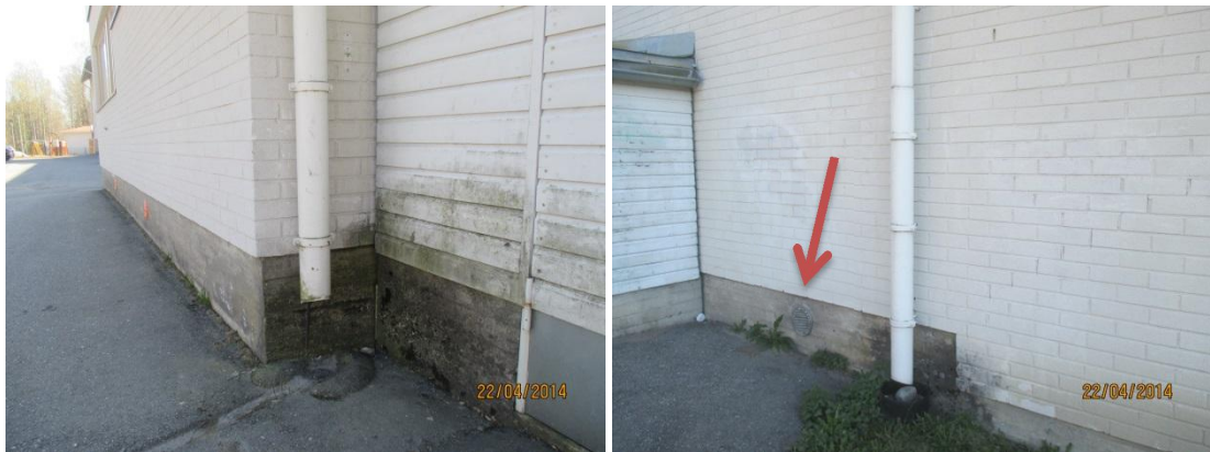
Kuvat 20a ja b. Kuvassa a on A-lohkon lounaiskulmalla oleva syöksytorvi, josta sadevesiä valuu perustusten juureen. Kuvassa b on A- ja B-lohkon rajalla länsisivulla oleva venttiili, johon poistoilmaputki törmää.
