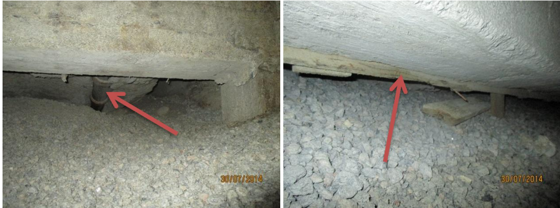
Kuvat 13a ja b. Kuvassa a on käytävän suuntaan nähden poikittainen palkki, jonka ali pilkottaa wc-tilojen vanhoja valurautaviemäreitä. Toisen oppilas-wc:n alta ei ole poistettu täyttömaata. Kuvassa b on wc-tilojen välisen poikittaisen palkin täytön puoleiselle sivulle jätettyä muottilaudoitusta.
