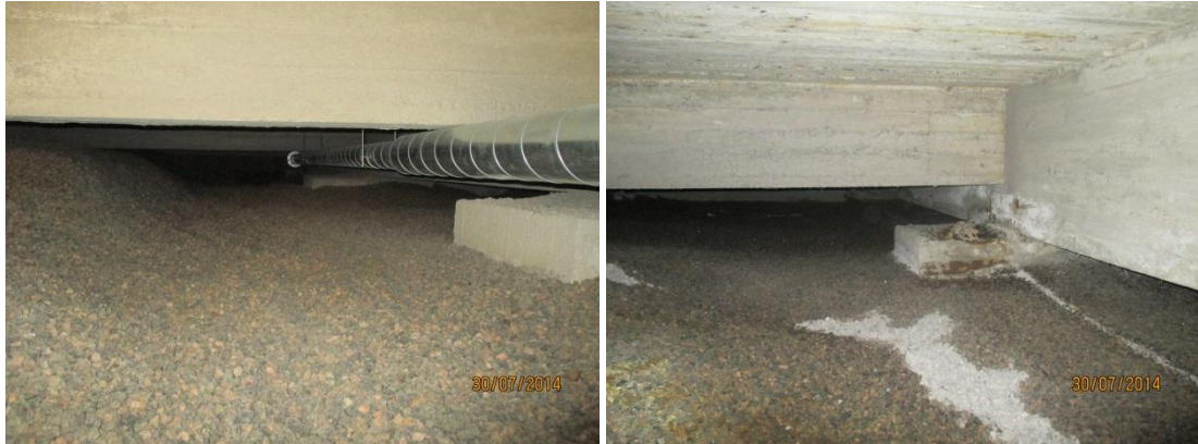
Kuvat 18a ja b. Kuvassa a on alapohjaa kantavien sekundääripalkkien ali viety poistoilmakanava käytävän lähellä. Sepelikerroksen paksuus oli tarkastuspaikassa yli 20 cm. Kuvassa b on kosteaa maata ja mikrobikasvustoa käytävän alla olevan putkikanaalin vierellä. Putkikanaalin ali on 20–30 cm korkea ilmayhteys C-lohkon puolelle.
