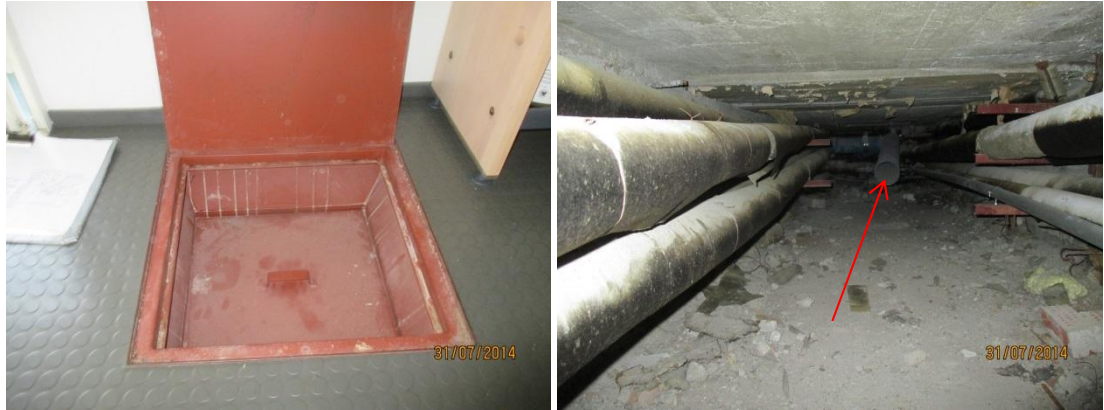
Kuvat 2a ja b. Kuvassa a on putkikanaaliin johtava tiivistämätön 2-kantinen kulkuluukku länsipäädyssä. Kuvassa b on putkikanaalia, jossa perällä on ilmanpoistokanavan avonainen pää. Kanaalin pohjalla on rakennusjätettä, mutta kanaalin pohja vaikutti olevan kuiva.
