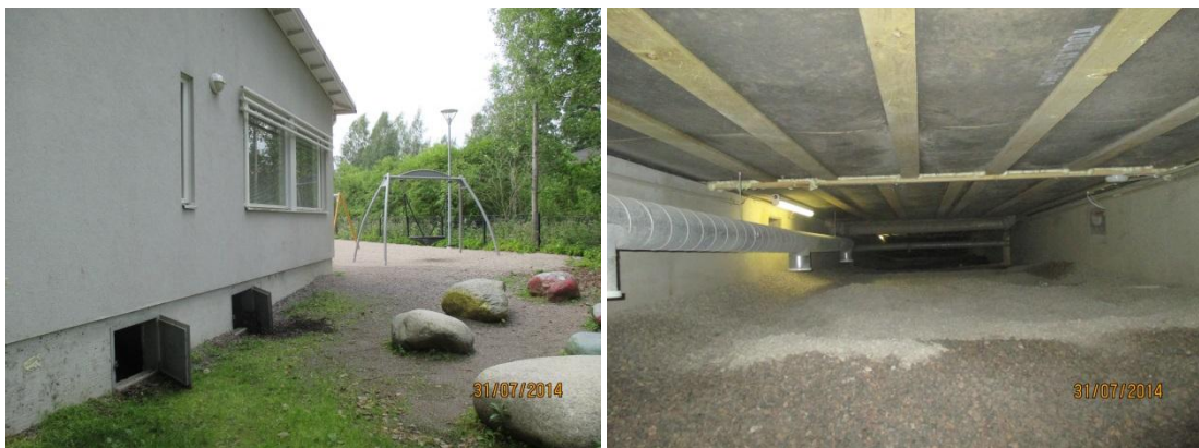
Kuvat 32a ja b. Kuvassa a on koillispääty, jossa on maanpinta on liian ylhäällä ja viettää kohti rakennusta. Kuvassa b on hyväkuntoista alustatila koillispäädyn keskialueella. Kattoon on ripustettu poistoilmakanava.
