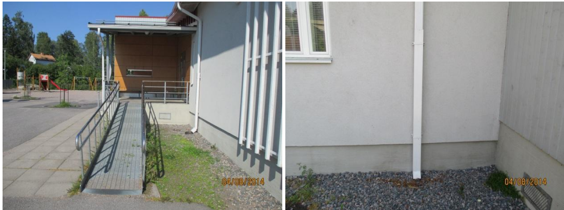
Kuvat 36a ja b. Kuvassa a on sisäpihan puolella oleva painanne, joka kerää pinta- ja sulamisvesiä. Kuvassa b on sepelin alle jäänyt rännikaivo sisäpihan puolella. Sokkelin tuuletusaukot ovat lähellä maanpintaa.
