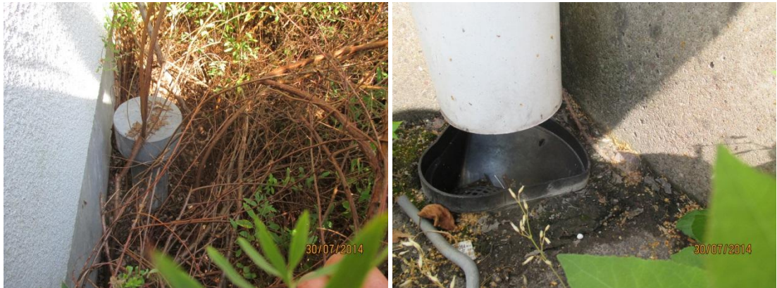
Kuvat 29a ja b. Kuvassa a on pensaiden sisään jäänyt lyhyehkö korvausilmaputki, joka jää myös lumien peittoon. Kuvassa b on hammashoitolan vierellä oleva rännikaivo, josta vedet tulvivat yli.
