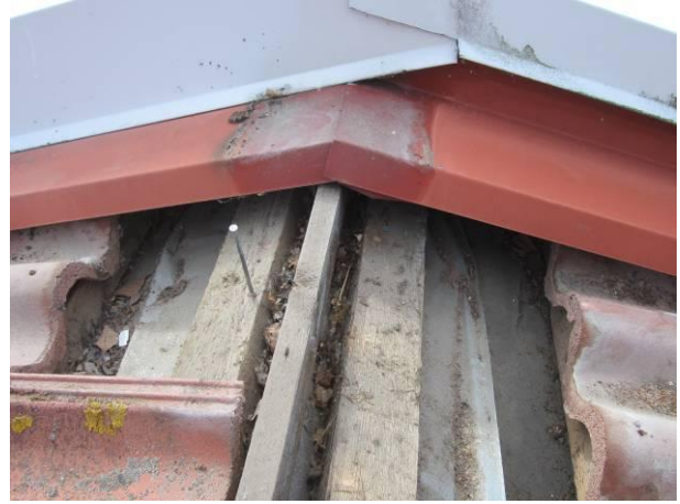
Kuva 8. Päätyräystästä juurinostopellitys on kunnossa.
