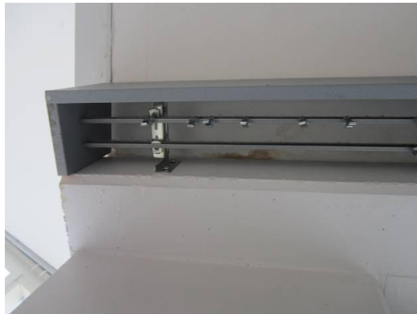
Kuva 40. Vuotojälkiä tilan 214 ulkoseinäliittymässä.
