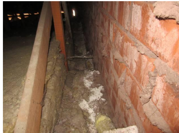
Kuva 14 Päätyseinällä eristys ei nouse yläpohjavillan tasoon .
