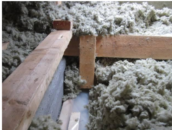
Kuva 32. Avauspaikan alla on ontelolaatan ja puurakenteen raja, villan alla on höyrysulku. Hieman alemmaa löytyi märkää villaa.
