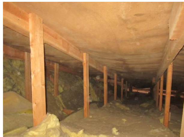
Kuva 16. Vuotojälkiä ja mikrobikasvua jiirin lähellä tilojen 153 ja 155 yläpuolella.
