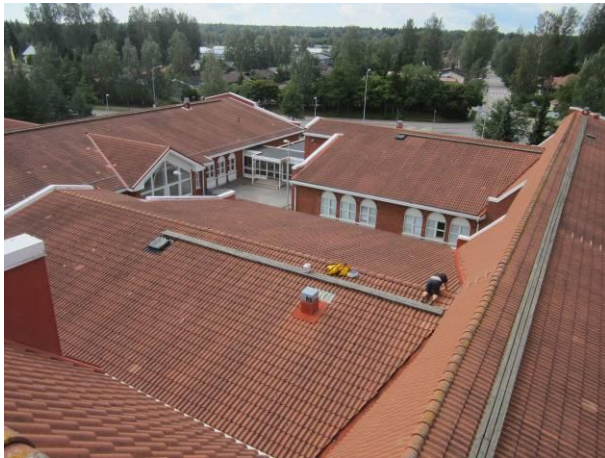
Kuva 1. Yleiskuva kuvattuna liikuntasalin vesikatolta. Vasemmalla laajennusosan vesikatto ja keskellä alkuperäisen osan siipiosat. Jyrkiltä lappeilta vesi valuu vauhdilla jiireihin.
