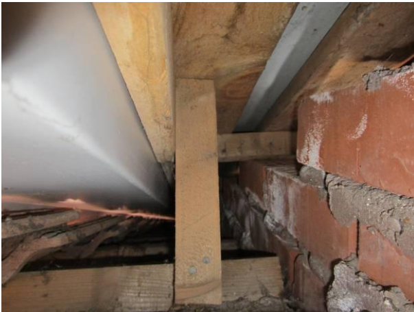
Kuva 9. Päätyräystäällä luokan 160 yläpuolella tiilikate ei ulotu riittävän pitkälle. Pahvialuskatteessa ei ole juurinostoa muurausta vasten.
