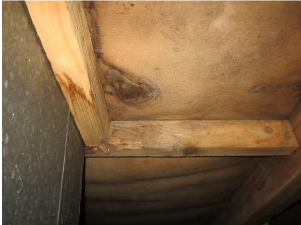
Kuva 17. Vuotojälkiä ja mikrobikasvua, epätiivis IV-läpivienti tilan 154 kohdalla.
