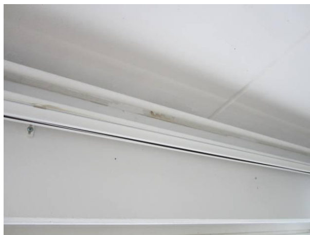
Kuva 42 Vuotojälkiä ulkoseinäliittymässä tilassa 236.
