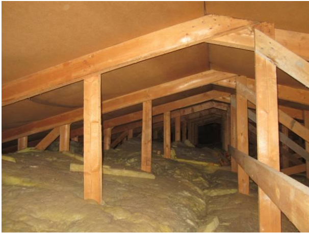
Kuva 11. Ontelossa ei ole kulkusiltaa.
