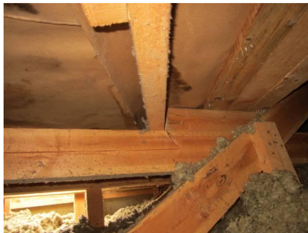
Kuva 34 Vuotojälkiä jiirin alla lähellä ulkoseinää. Bitumikermiä ei ole ylä- eikä alapuolella.
