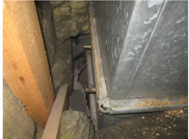
Kuva 18. IV-kanavan juuren huono eristys 154 kohdalla.
