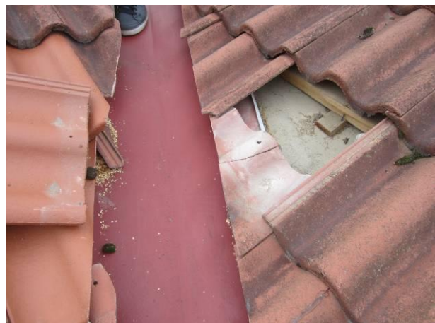
Kuva 30. Jiirin alueen rakenne ja jo uusittuja tiiliä.
