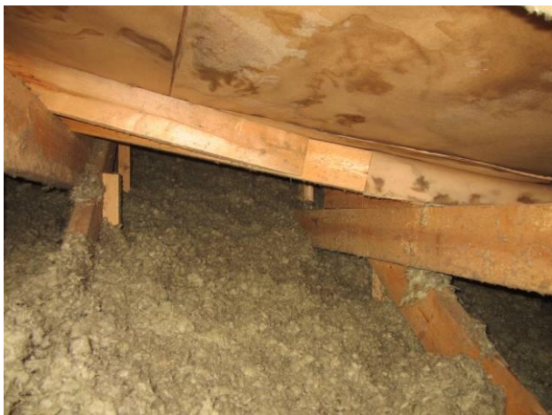
Kuva 33. Vuotojälkiä jiirin sivulla avauspaikan lähellä.
