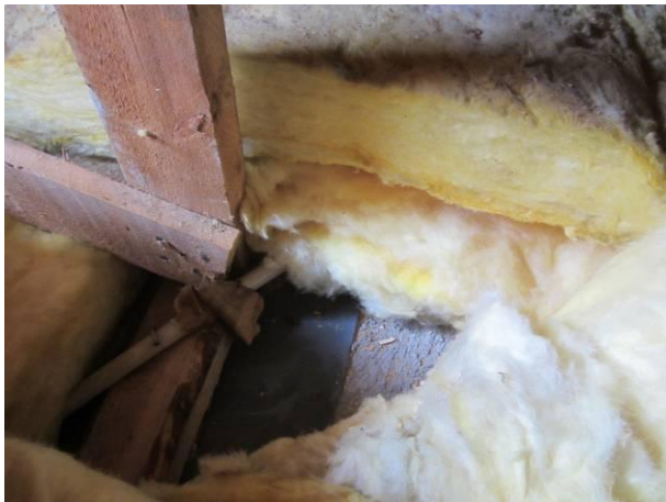
Kuva 13. Eristeiden alla ei ole höyrynsulkua.
