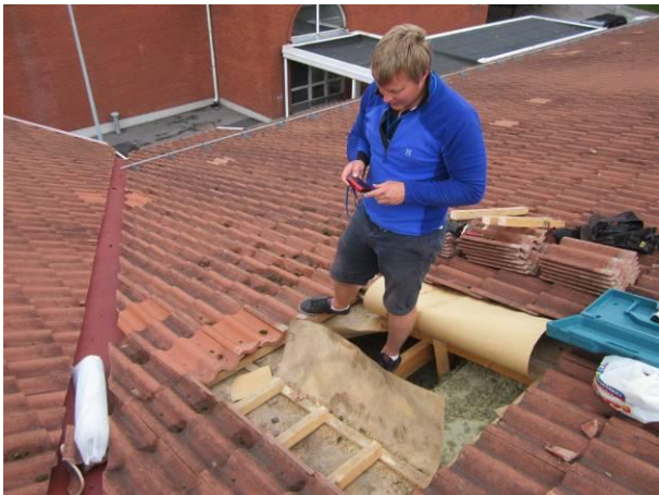
Kuva 31. Avaus tehtiin jiirin viereen arvioidulle vuotolinjalle tilan 214 yläpuolella. Aluskatteissa on vuotojälkiä harjan suunnalta.
