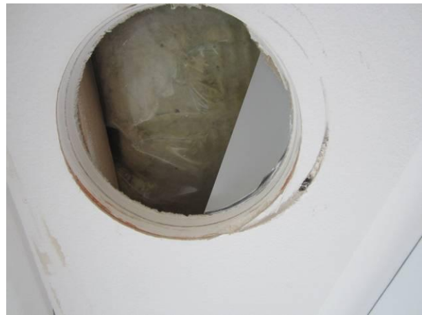
Kuva 46. Avauspaikka SA3 tilan 236 kattoon vuotojälkikohdalle.
