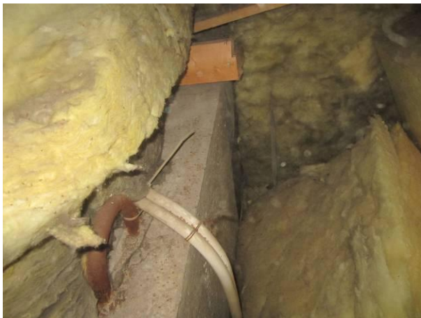
Kuva 19. Huonoja eristyksiä, yläpohjan betonirunko on esillä tilan 153 kohdalla.
