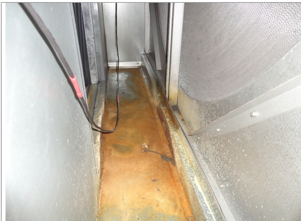
Kuva 10: LTO-kennosta alavirtaan tuloilmapuolella on runsaasti jälkiä ylimääräisestä vedestä. Toistuva kennon kastuminen ja IV-koneen katkokäyttö edistävät kennon tukkeutumista.
