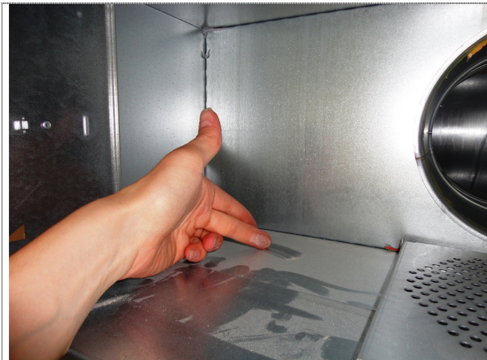
Kuva 14: Tuloilman päätelaitteiden tasauslaatikoiden sisäpinnalla on pölykertymää. Tasauslaatikot tulee puhdistaa nihkeäpyyhinnällä.
