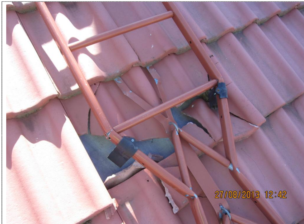
Kuva 3: Rikkoutunut vesikate lapetikkaiden kohdalla. Lapetikkaat ovat vääntyneet rikki ja riskissä pudota seuraava talvena.
