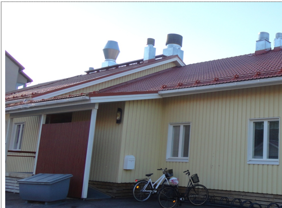
Kuva 8: Katolla näkyvät raitisilmasäleiköt ovat lieriöitä ja avosäleisiä eivätkä suojaa tuloilmajärjestelmää vedeltä ja lumelta. Pienempi tuloilmasäleikkö on keittiön IV-koneen.
