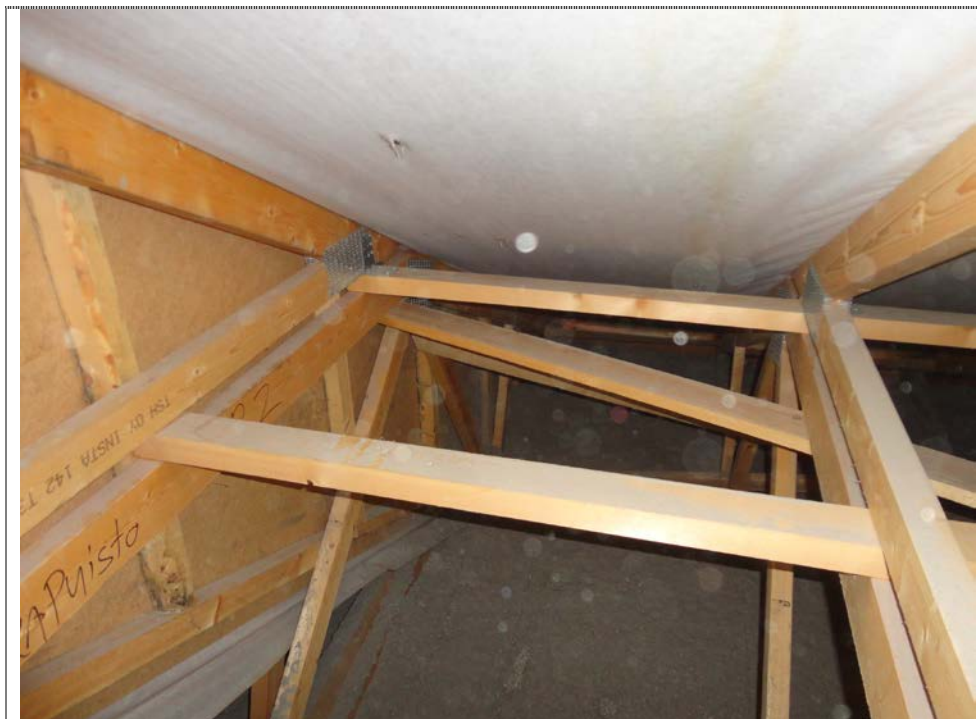
Kuva 6: Rikkoutunut aluskate ja vuotojälkiä lämmöneristeissä.
