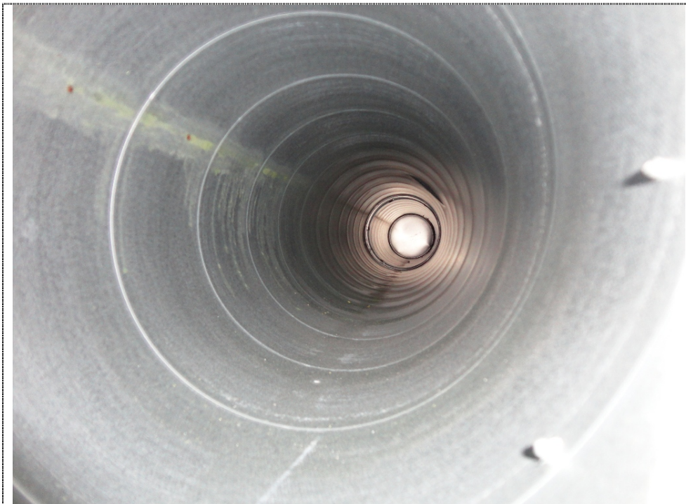
Kuva 12: Tuloilmakanaviston pölykertymä on alle P1 luokan puhdistusraja-arvon 2,0 \text{ g/m}^2 . Kanavistossa on vähäisiä määriä rakennusaikaista likaa ja karkeaa ainetta, mikä ei vaikuta sisäilman laatuun.
