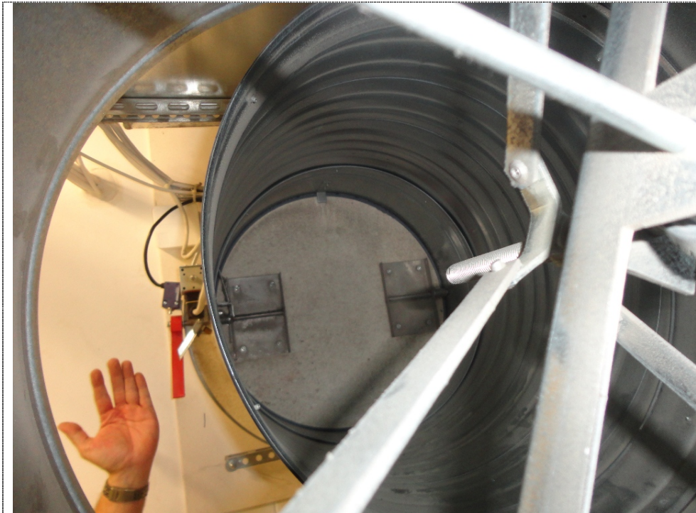
Kuva 7: Muutamien poistoilmarunkojen palopellit olivat häiriötilassa. Rungon pöykertymä ei edellytä puhdistusta.
