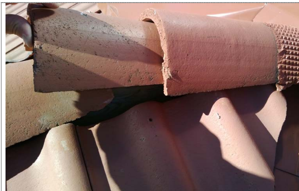
Kuva 4: Vajavaisesti kiinnitetyt harjatiilet.
