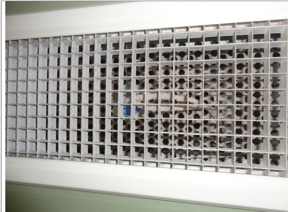
Kuva 15: Poistoilmaventtiilien reikäpellit keräävät pölyä ja voivat tukkeutuvat täysin, mikäli säännöllisestä puhdistamisesta ei huolehdi.
