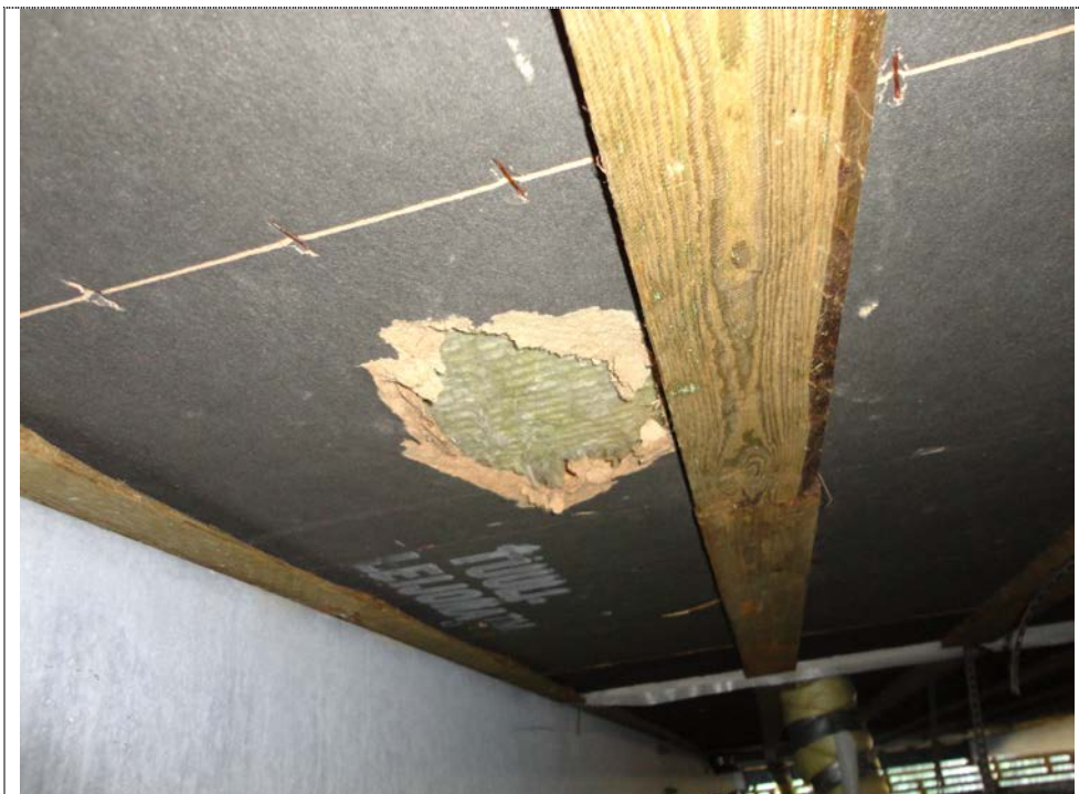
Kuva 2: Alapohjan rikkoutunut tuulensuojalevytytys.
