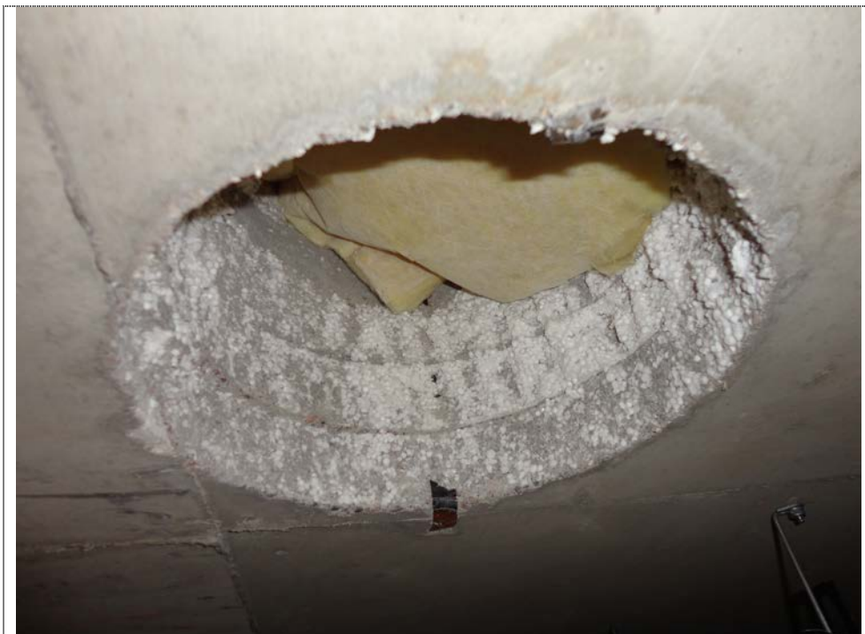
Kuva 2: Ilmanvaihtokonehuoneen välipohjan käyttämätön/tiivistämätön läpivienti. Välipohja on palo-osastoitu rakenne, joka ei tällaisena täytä sille asetettuja vaatimuksia.
