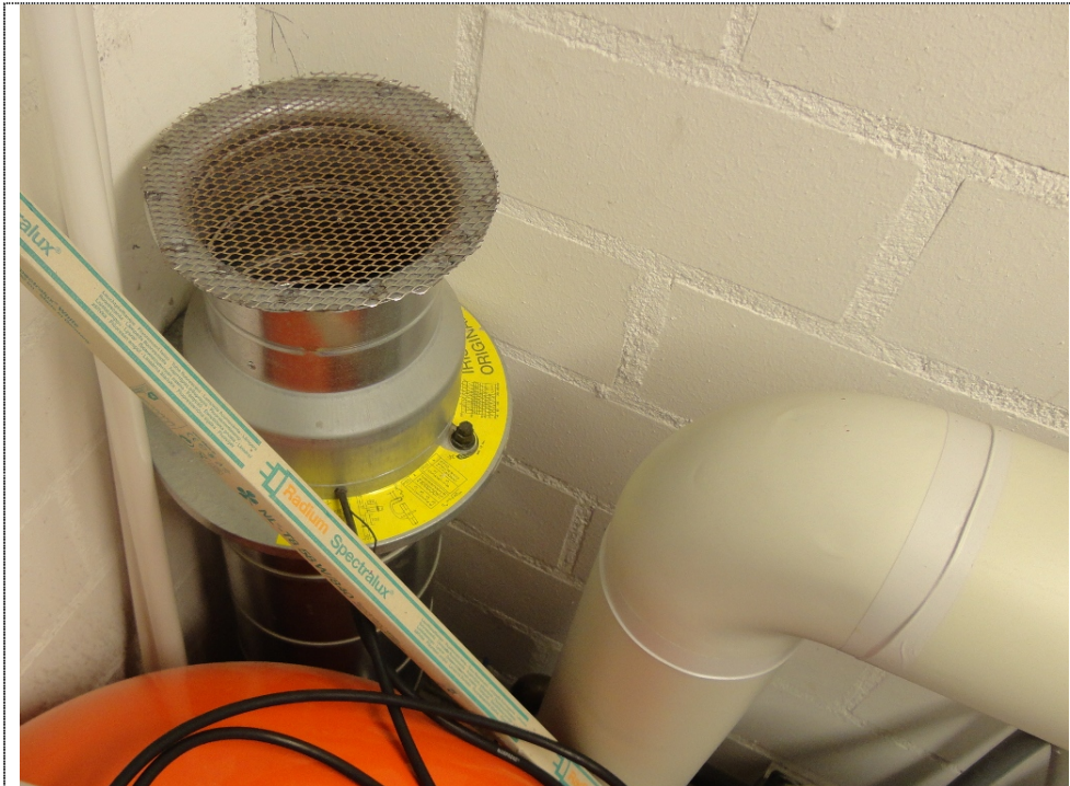
Kuva 11: Lämmönjakohuoneessa olevasta ryömintätilan korvausilmaventtiilistä ei merkksavulla havaittu ilmavirtausta ryömintätilaan.
