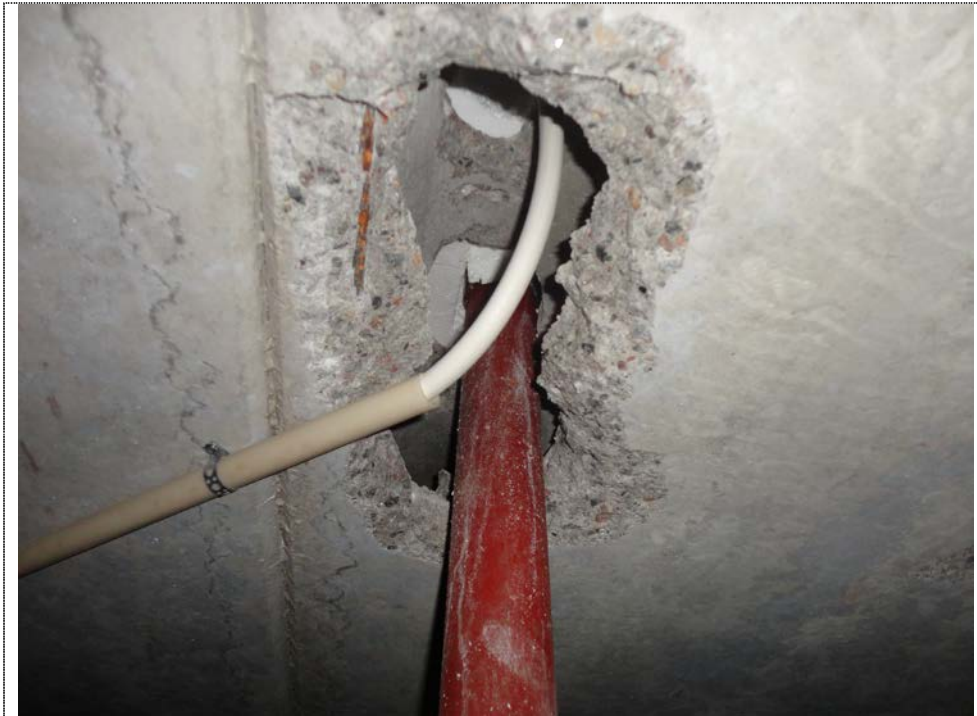
Kuva 1: Alapohjan ontelolaattojen läpiviennit ovat tiivistämättä. On mahdollista että alapohjan epäpuhtaudet kulkeutuvat vuotoilmana sisäilmaan läpivientien kautta.
