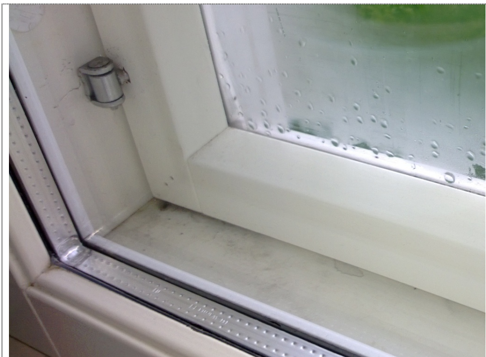
Kuva 14: Työhuoneen 138 vasemmanpuoleisen ikkunan ulkopuitteen havaittiin sateella vuotavan vettä sisä- ja ulkolasien väliin. Ikkunan ulkopuitteen tiivisteet tulee tarkastaa ja korjata.
