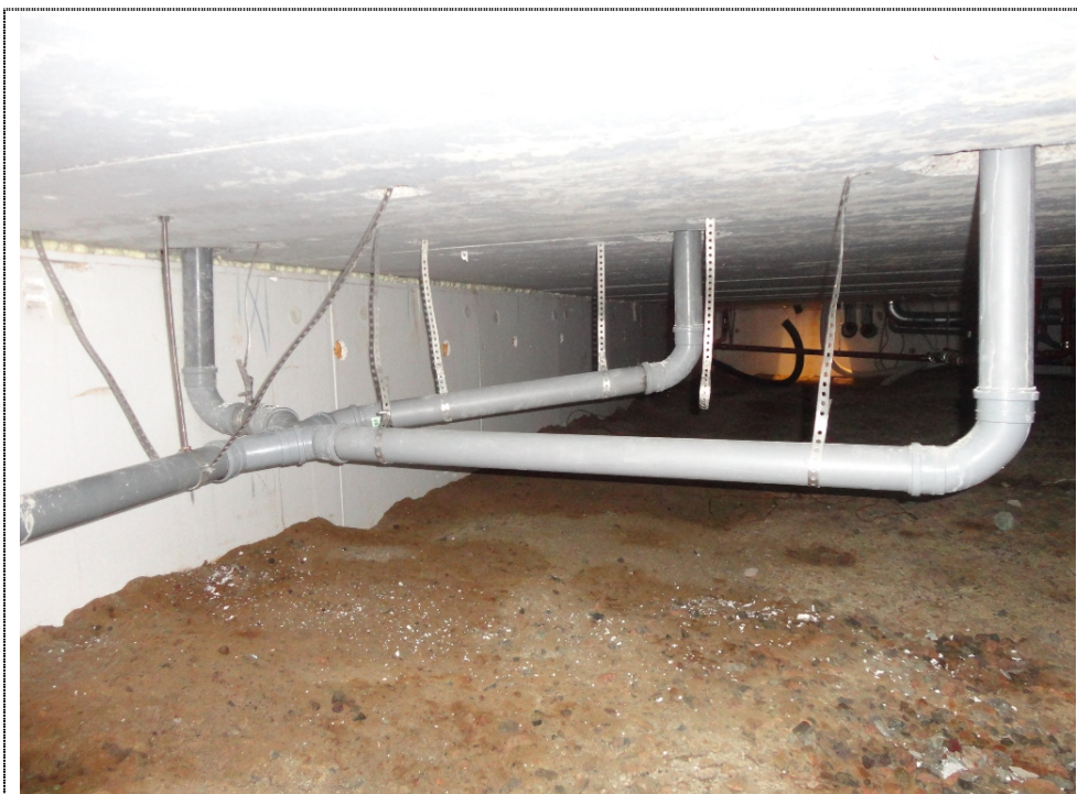
Kuva 10: Viemäriputkiston kannakointi on virheellinen. Kokemuksesta tiedetään tällä tavoin kannakoitujen viemäreiden liitosten irronneen omia aikojaan. Kannakointi tulee korjata viemäri valmistajan ohjeiden mukaiseksi suunnitellun käyttöön saavuttamiseksi.
