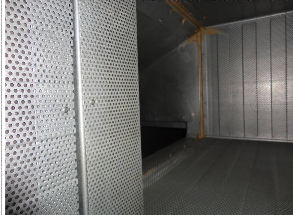
Kuva 5: Puhallinkammion jälkeiset äänenvaimentimet on toteutettu hyvällä sidontapinnalla (reikäpellin alla) ja listoituksella. Kuitujen irtoaminen tuloilmavirtaan on epätodennäköistä.
