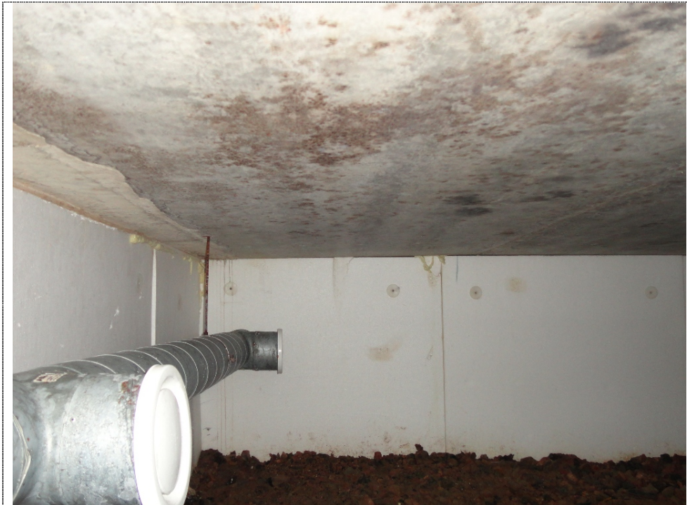
Kuva 9: Ryömintätöilan koneellisen poiston päädyssä kosteus kondensoituu metalliosiin, sepeliin sekä betoniholviin. Ilman suhteellinen kosteus on 100 % lähes koko mittausjaksolla.
