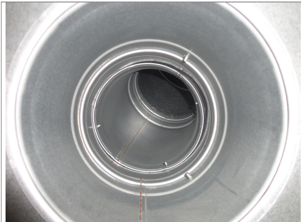
Kuva 6: Tuloilmakanava käytävän 111 tuloilmalaitteelta nähtynä. Ilmanvaihtokanavisto on visuaalisesti arvioiden kohtuullisen puhdas, pölykertymä selvästi alle P1 luokan puhdistusraja-arvon 2,0 \text{ g/m}^2 .
