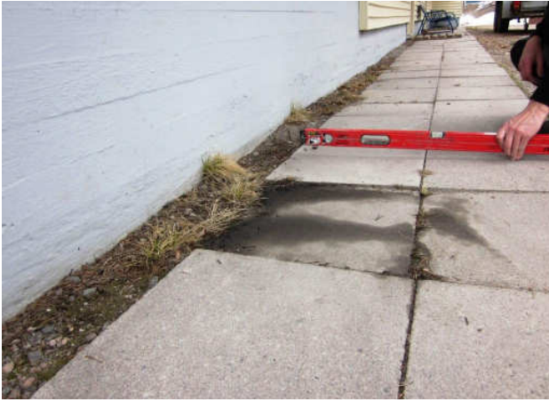
Kuva 1 Pinta viettää rakennukseen päin.
