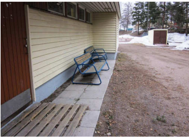
Kuva 3 Pinta viettää rakennuksesta poispäin.
