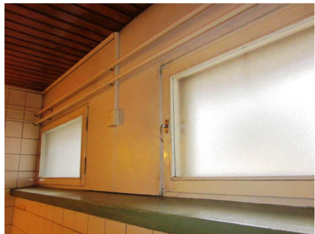
Kuva 10 Lastulevyssä kosteuden aiheuttamia jälkiä.
