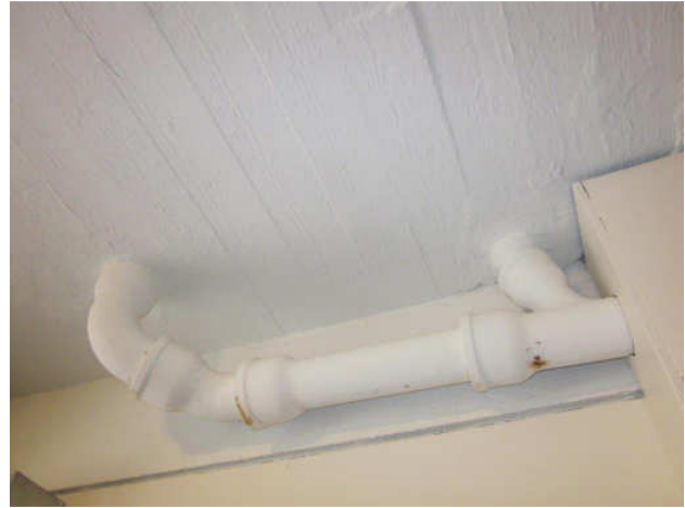
Kuva 17 Valurautaviemärissä pistemäisiä syöpymiä.
