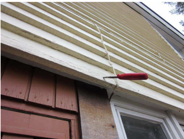
Kuva 9 Alin lauta vaurioitunut.
