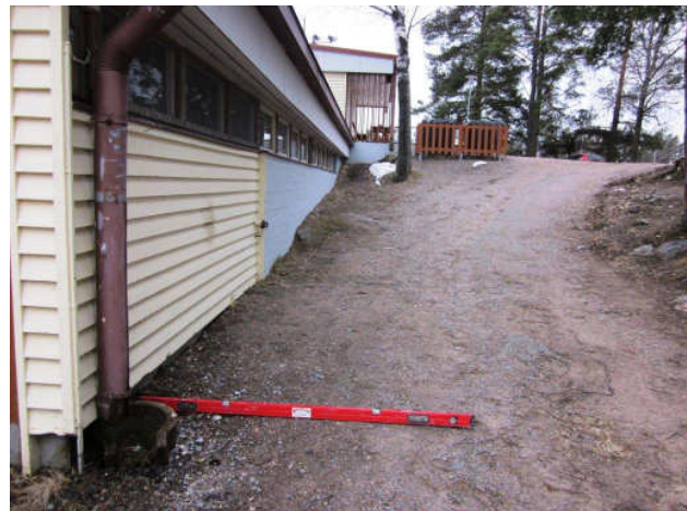
Kuva 2 Loiskekivien asennuksissa puutteita.
