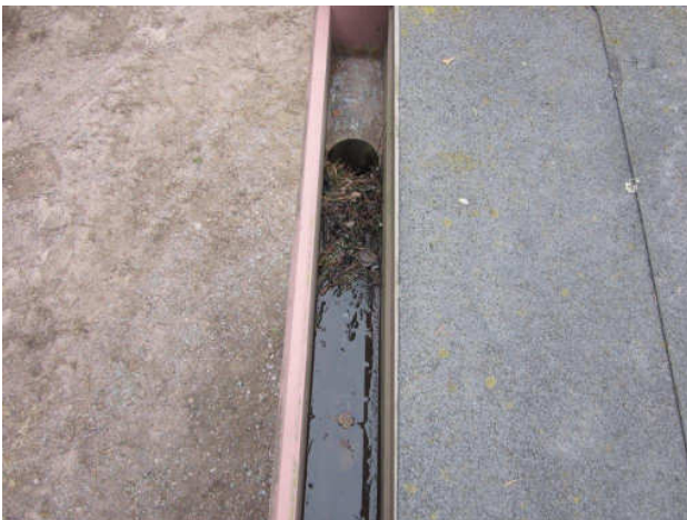
Kuva 1 Räystäskourussa oleva kasvijäte tukkinut syöksytorven lähdön.
