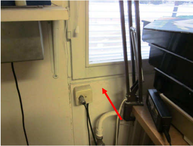
Kuva 11 Lastulevyssä kosteuden aiheuttamia jälkiä.
