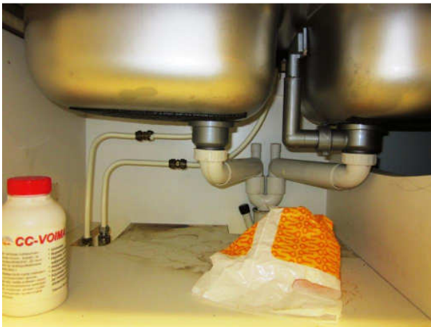
Kuva 15 Keittiön allaskaapina pohjalevyssä veden jättämiä jälkiä.
