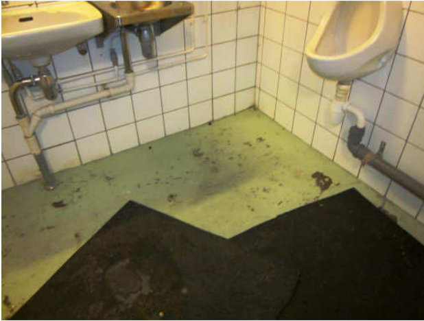
Kuva 3 Maali kuoritunut lattiasta.
