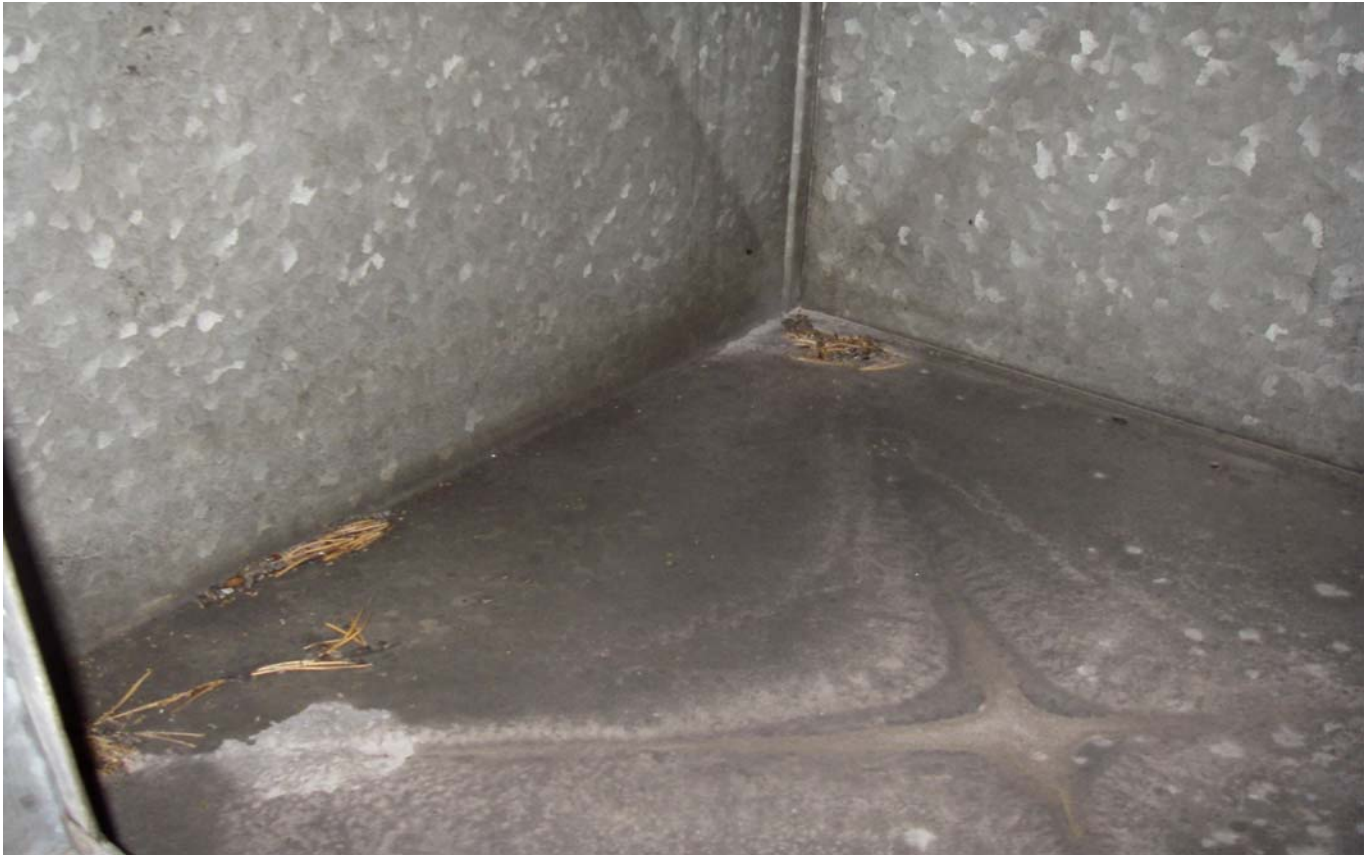
KUVA 3. Tuloilmakoneen kammioissa on roskaa.
