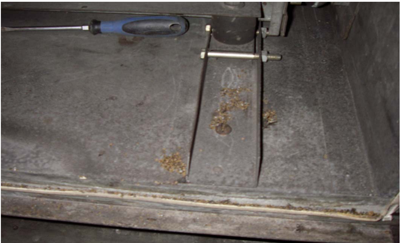
KUVA 4. Tuloilmakoneen kammioissa on roskaa.
