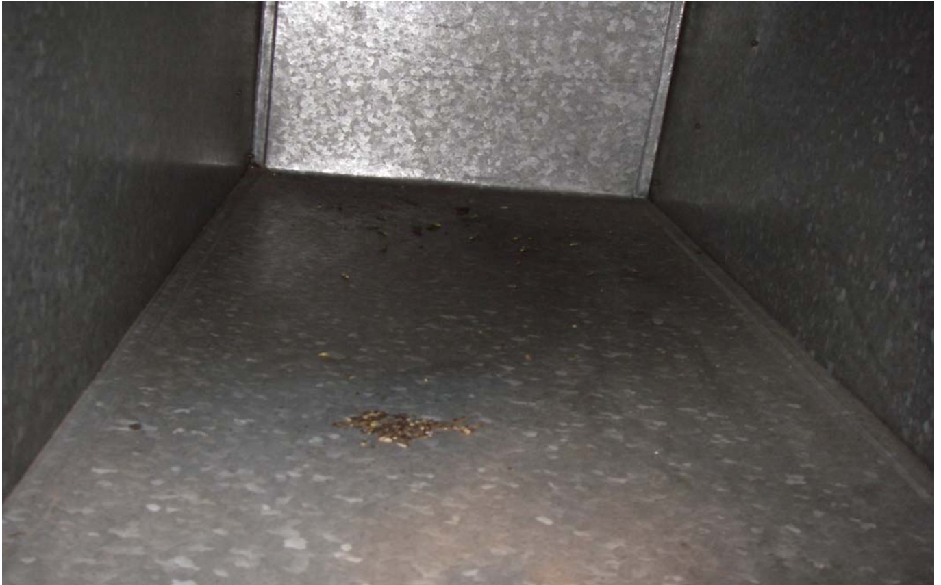
KUVA 7. Tuloilmakoneen kammiossa on roskaa.
