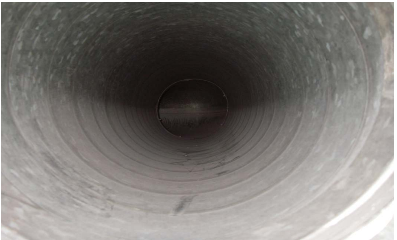
KUVA 10. Poistoilmakanavassa on vain hieman pölykertymää.
