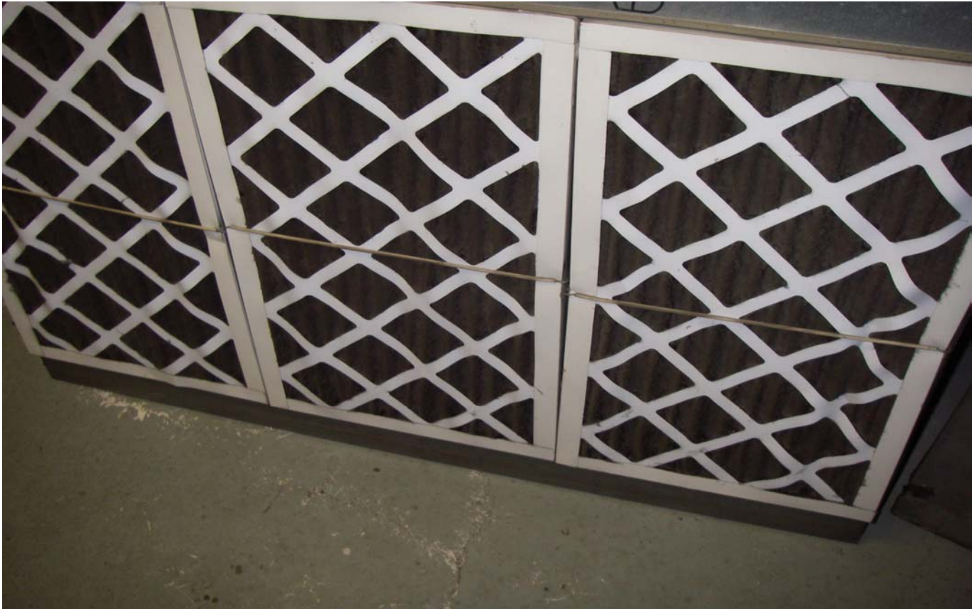
KUVA 5. Tuloilmakoneen suodattimet ovat likaiset.
