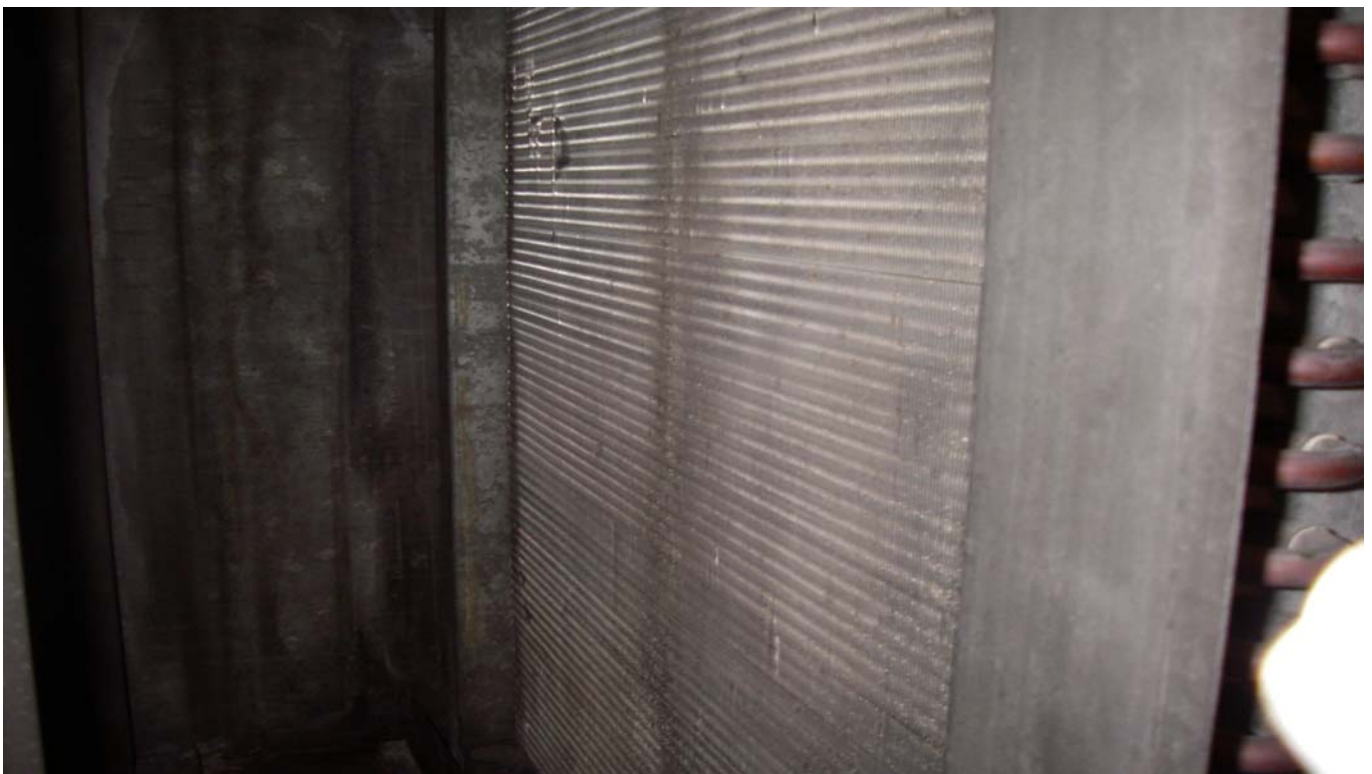
KUVA 2. Tuloilmakoneen lämpöpatteri on nokinen.
