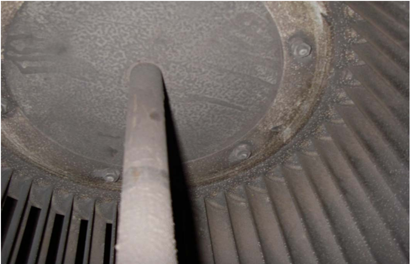
KUVA 1. Puhallin on nokinen ja pölyinen.
