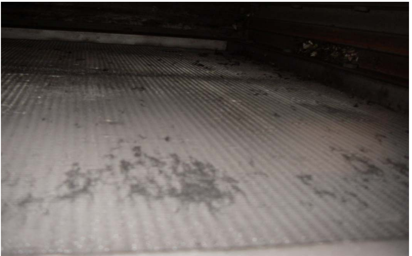
KUVA 6. Tuloilmakoneen lämpöpatteri on likainen.
