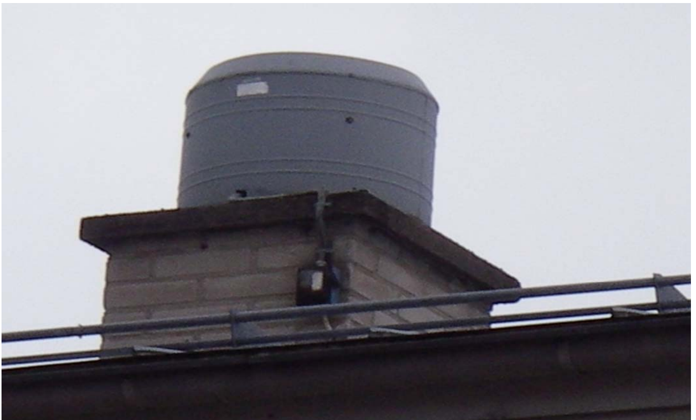
KUVA 8. Yleiskuva paloaseman vesikatolla olevista huippuimureista.
