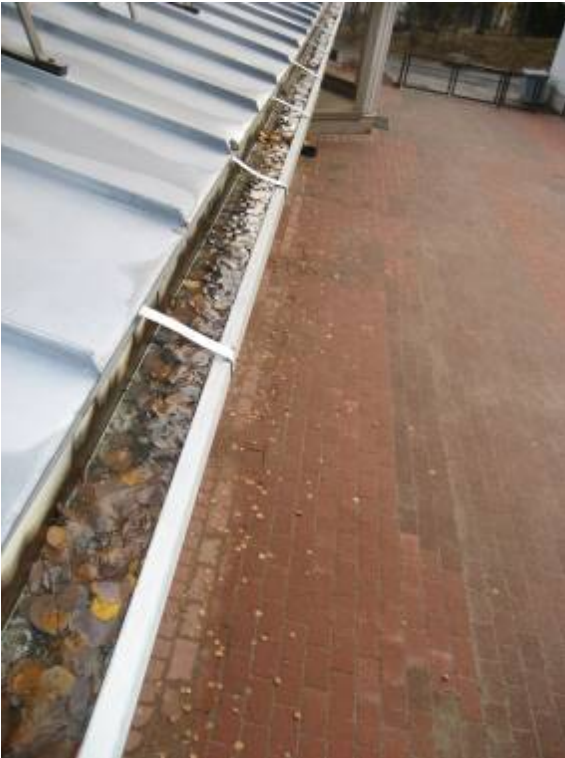
RAK-KUVA 7: Räystäskourujen puhdistamiseen tulee jatkossa kiinnittää nykytasoa enemmän huomioita.
