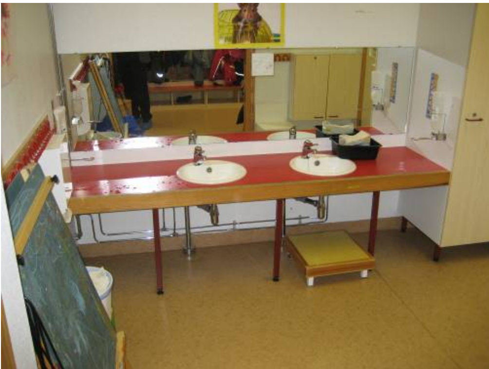
RAK-KUVA 10: Päiväkodin märkätilojen rakenteet ovat käyttökänsä mukaisesti ikääntyneitä mutta yleisilmeeltään tyydyttävässä kunnossa.
