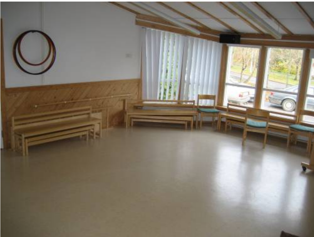
RAK-KUVA 8: Pintarakenteiden ikääntymisestä huolimatta kokonaisuudessaan päiväkodin sisätilat ovat yleisilmeeltään tyydyttävässä kunnossa.
