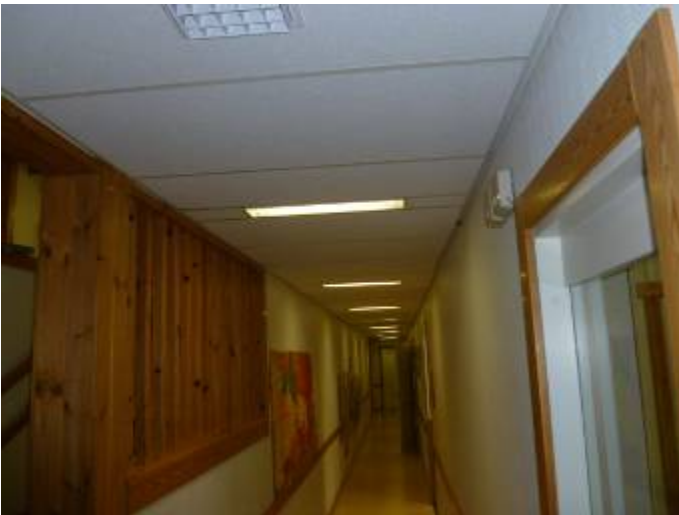
S-KUVA 6. Käytävän valaistus
