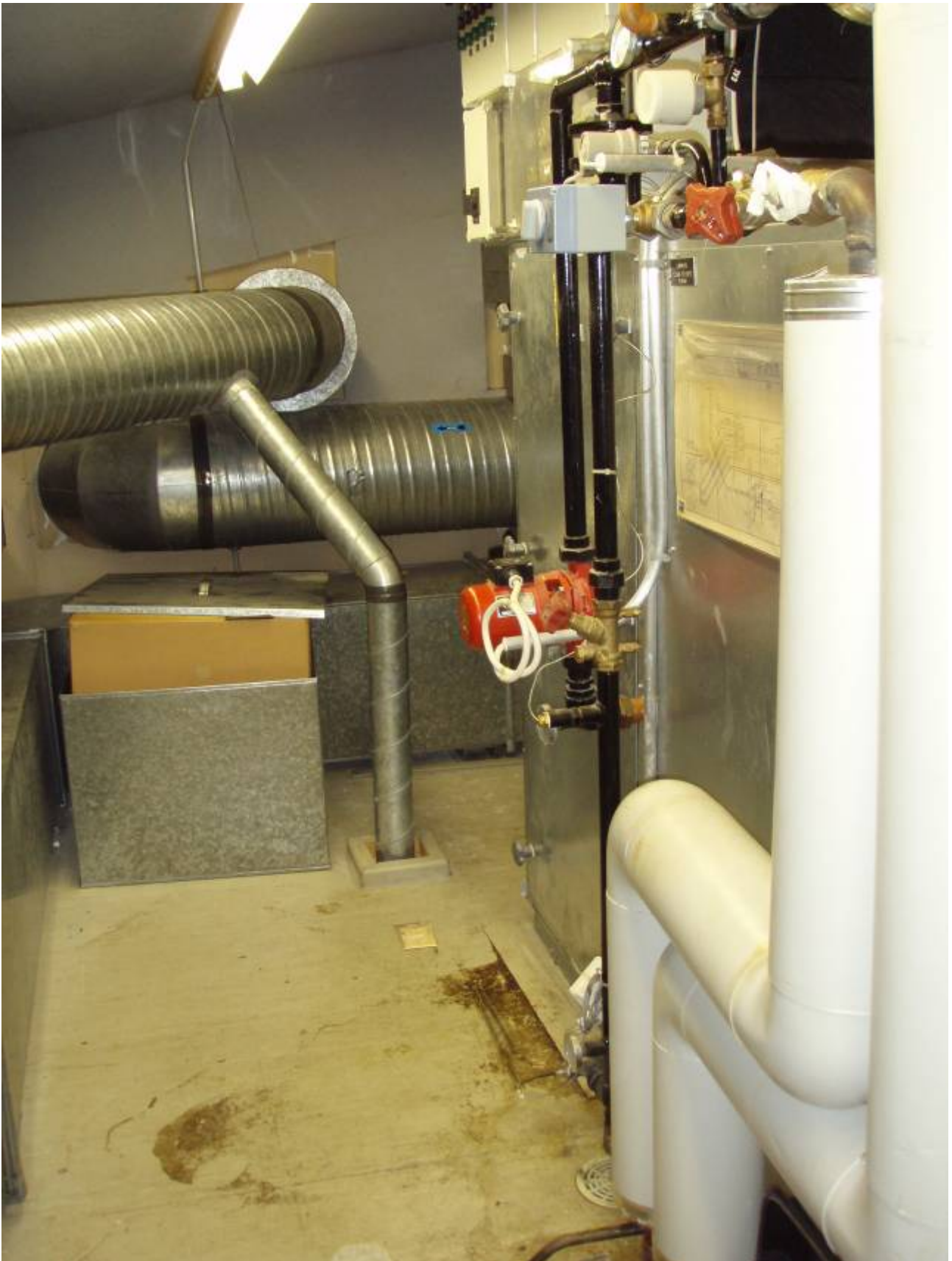
LVI-kuva 6. Yleiskuva IV- konehuoneesta.
