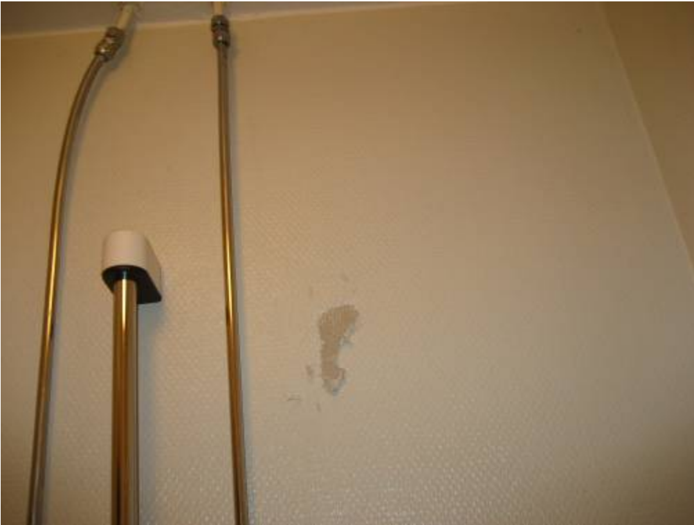
RAK-KUVA 11: Kuva märkätilan seinärakenteessa olevasta, yksittäisestä vaurioista.
