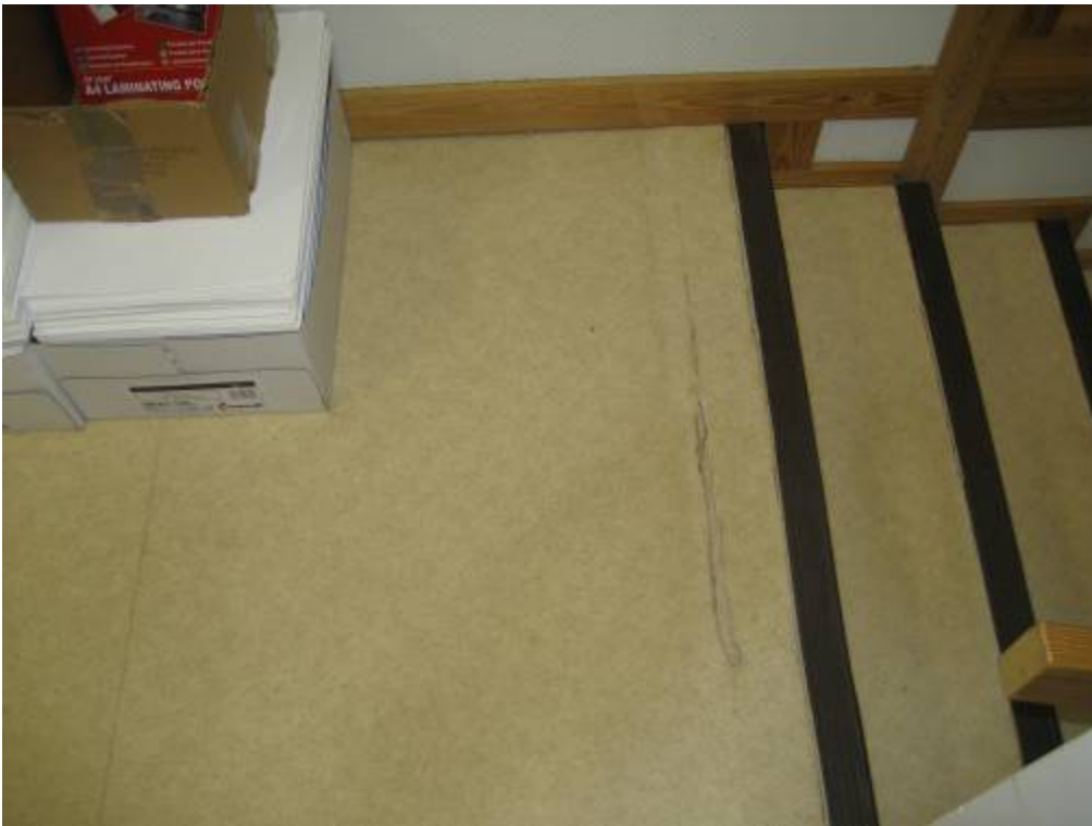
RAK-KUVA 9: Sisätilojen pintarakenteissa esiintyi merkkejä niiden ikääntymisestä ja rakenteellisen käyttiän loppumisesta.
