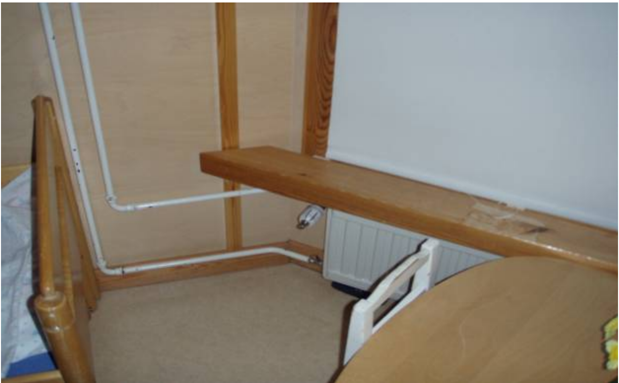
LVI-kuva 2. Yleiskuva patteriventtiileistä.
