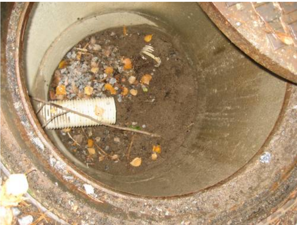
RAK-KUVA 4: Salaojakaivoista tehdyt havainnot antavat aiheita rakenteen toimivuuden tarkastamiselle / järjestelmän huuhtomiselle.
