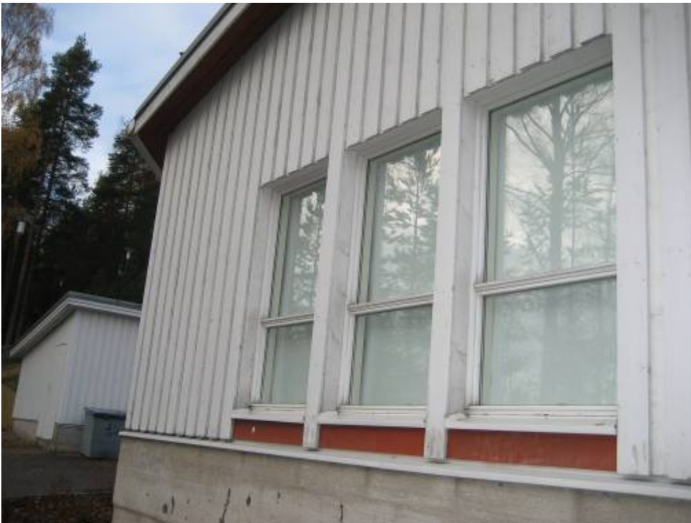
RAK-KUVA 5: Ikkunarakenteet arvioitiin edellyttävän huoltomaalausta lähivuosien aikana.
