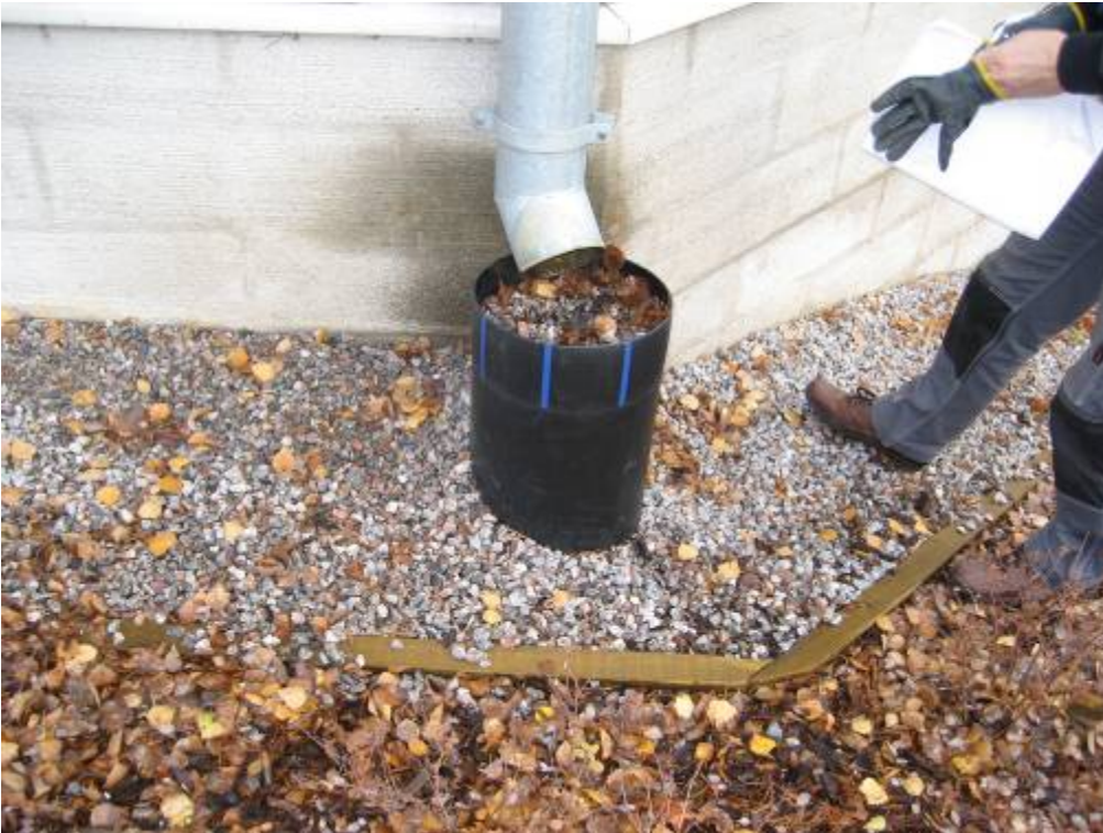
RAK-KUVA 3: Lehdistä / sepelistä tukkeutunut sadevesisuppilo. Sadevesisuppiloiden säännöllinen tarkastaminen / puhdistaminen tulee liittää kiinteistön huolto-ohjelmaan.
