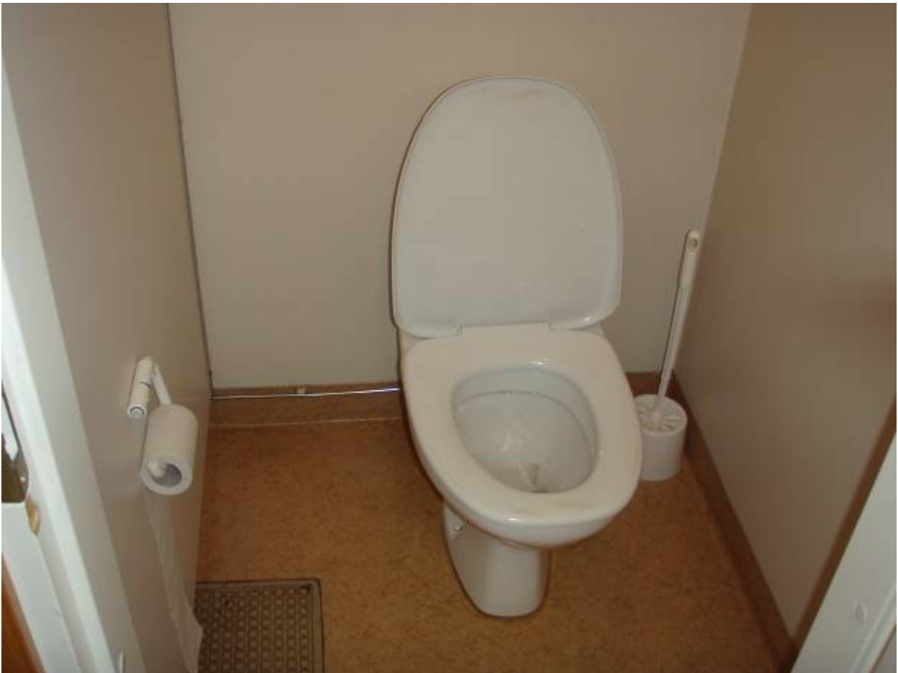
LVI-kuva 5. Yleiskuva wc-istuimista.
