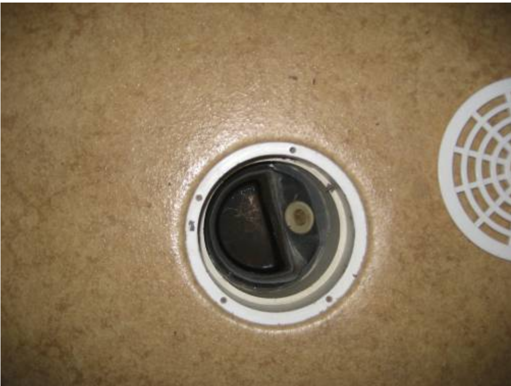
RAK-KUVA 12: Märkätiloissa lattiakaivojen ja niihin liittyvien korokerengasrakenteiden liittymäkohtien tiiveys on puutteellinen jmkä tulee huomioida tilojen mahdollisten korjaustöiden suunnittelun yhteydessä.
