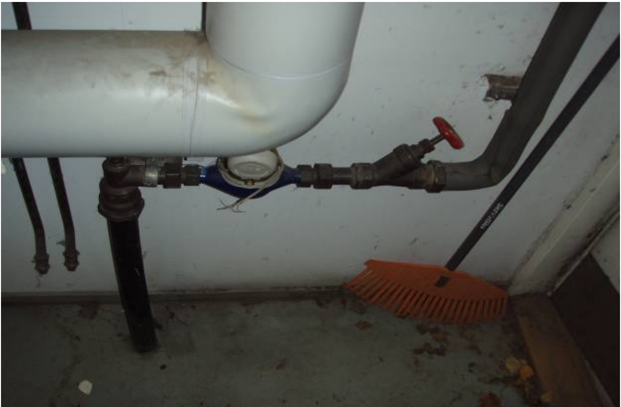
LVI-kuva 3. Yleiskuva vesimittarista ja pääsuluista.
