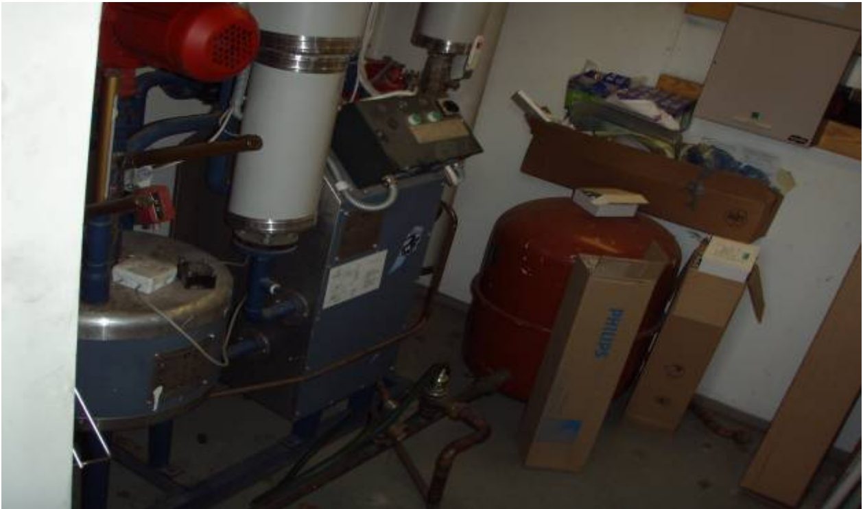
LVI-kuva 1. Yleiskuva lämmönjakohuoneesta.
