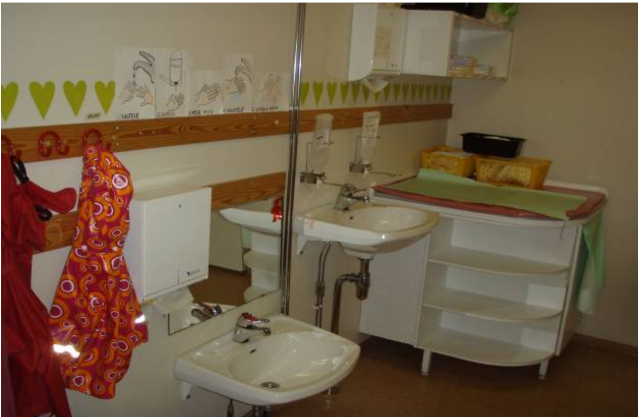
LVI-kuva 4. Yleiskuva vesikalusteista.
