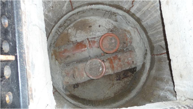
Viemärin tarkastusluukun pohjalla kostea hiekkaa. Maakellarimainen haju nousee toimistotilaan.
