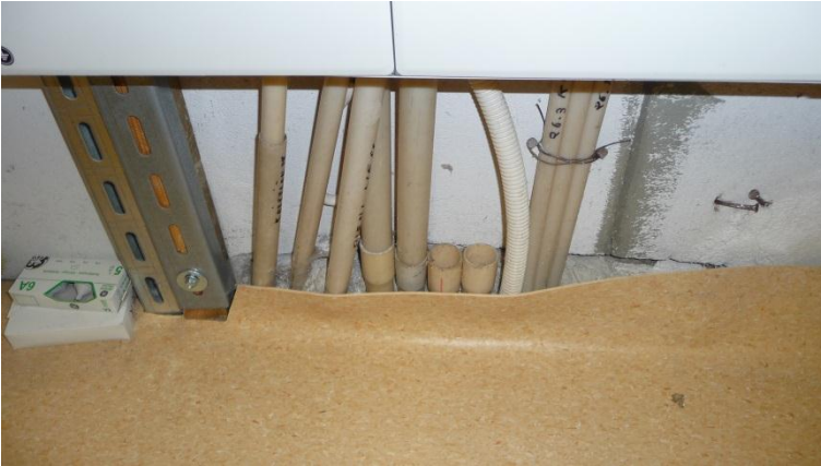
Sähkökaapin läpiviennit eivät ole tiiviit alapohjaan nähden
