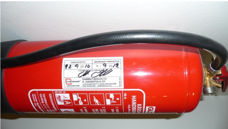
Sammuttimen tarkastusmerkki vanhentunut
