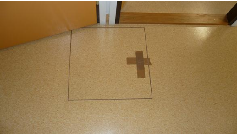
Viemrän tarkastuskansi. Hajut nousee toimistotilaan alipaineen johdosta.
