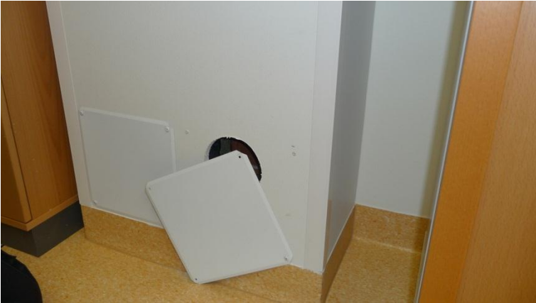
Huoneen 103 kanavan tarkastusluukku. Ilmavuotoja sisätilaan.
