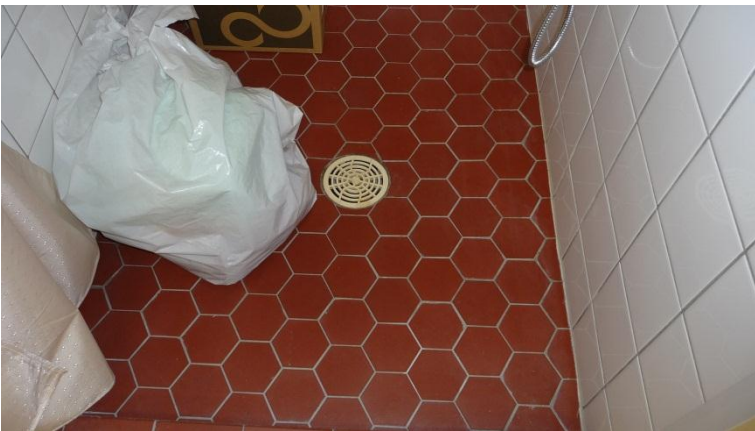
Suihkukaivo käyttämätön ja kuiva. Viemärinhajua.
