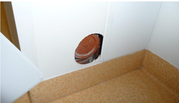
Huoneen 106 vastaava viemäriputken tarkastusluukku. Ilmavuotoja sisätilaan.
