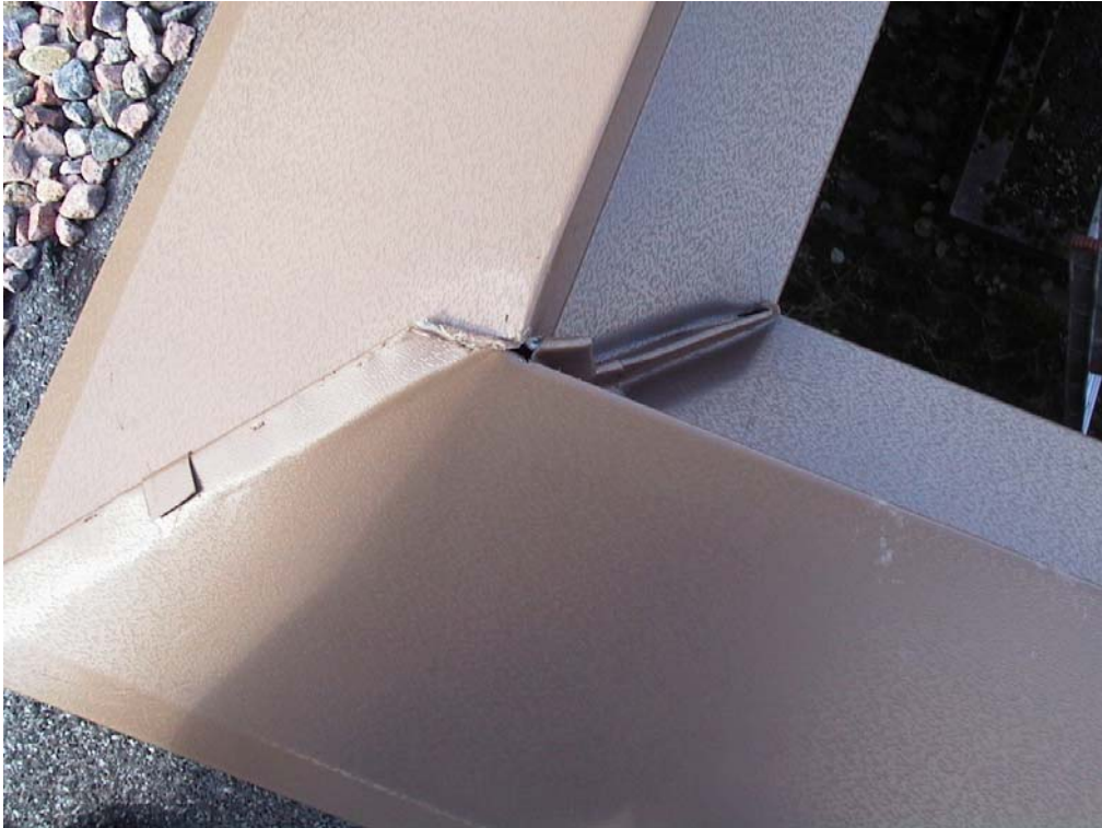
Kuva 5 Vesikaton räystäspellin sauma. Saumauksen yhteydessä pelti on revennyt ja sisänurkkaan on jäänyt reikä . Vastaavia kohtia oli melkein jokaisessa nurkassa.
