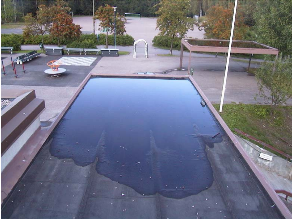
Kuva 7 Sisääntulokatoksilla seisoo vesi. Katoksen vedenpoisto kaivot ovat ylempänä kuin katon alin nurkka. Kaivot laskettava, niin että veden pois virtaaminen on mahdollista.
