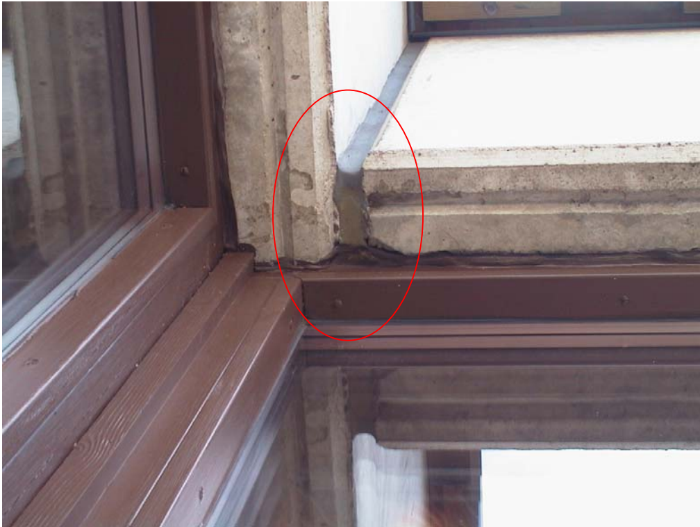
Kuva 3 Nurkka joka sijaisee luokan h043 yläpuolella. Nauhaelementin elementtisaumassa reikä , tämä on mahdollinen vuotopaikka, tämä ei kuitenkaan ole aiheuttanut luokan h 043 vesivahinkoa.
