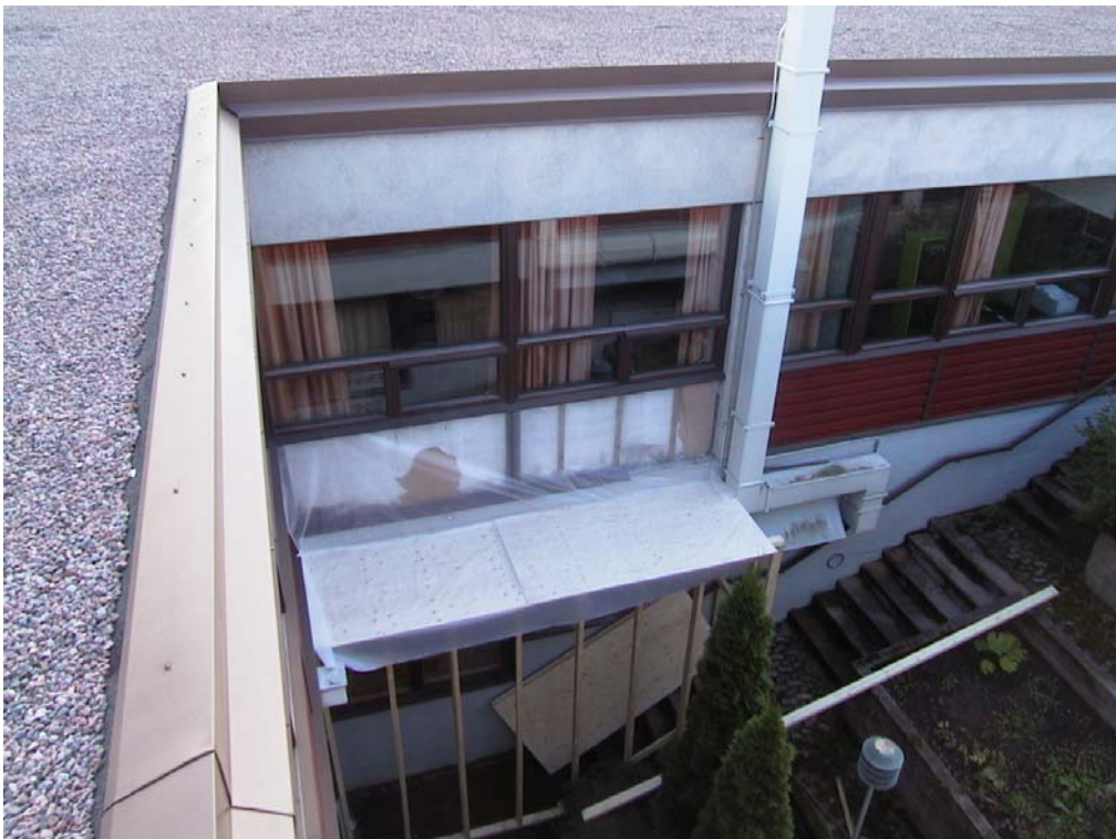
Kuva 6 Ulkopuolelta purettu seinä, seinän tuulensuojapaperi+ lujalevy vaurioitunut purkutyön yhteydessä . Korjattava ennen julkisivupeltien uudelleen asentamista.
