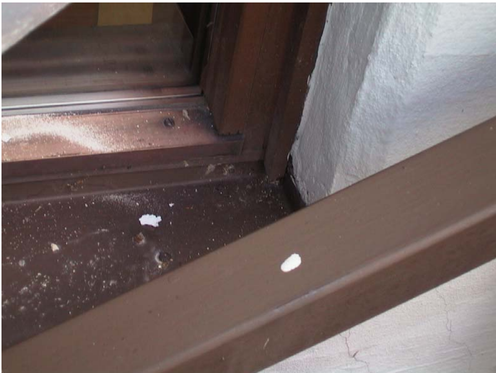
Kuva 4 Betonisokkelin ja ikkunapellityksen liitos. Pellin pääty on irti rakenteesta, jolloin seinällä valuvan veden on mahdollista päästä rakenteen sisään.
