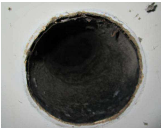
Pesuhuoneen poistoilmahormista puuttuu venttiili.
