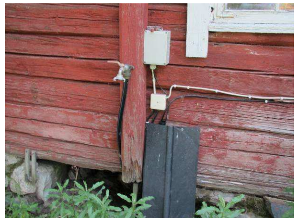
Ulkoseinähirsissä on runsaasti ravistumaa ja paikoin lahovaurioita
