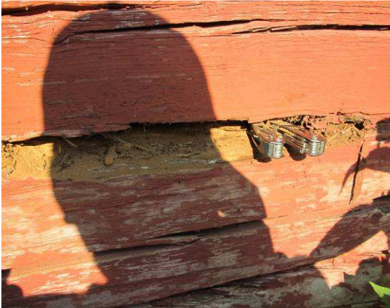
Ulkoseinähirsissä on lahovaurioita varsinkin alakerroksien hirsissä
