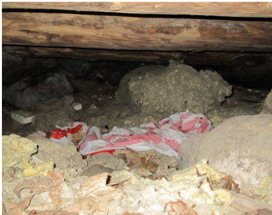
Alapohjassa on runsaasti rakennusjätettä ja maa on osin märkää
