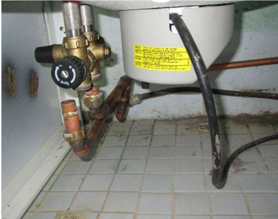
Lämpimän käyttöveden varaaja tulee uusia.
