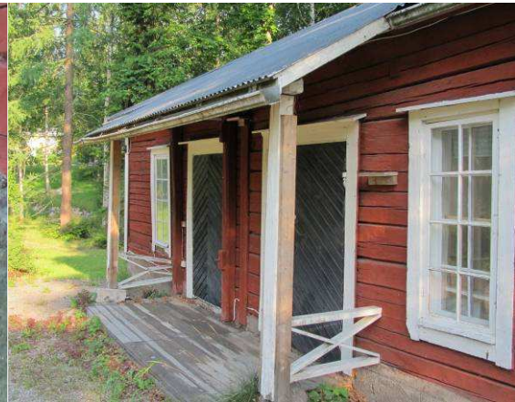
Etupihalla maanpinta kallistaa rakennuksen suuntaan
