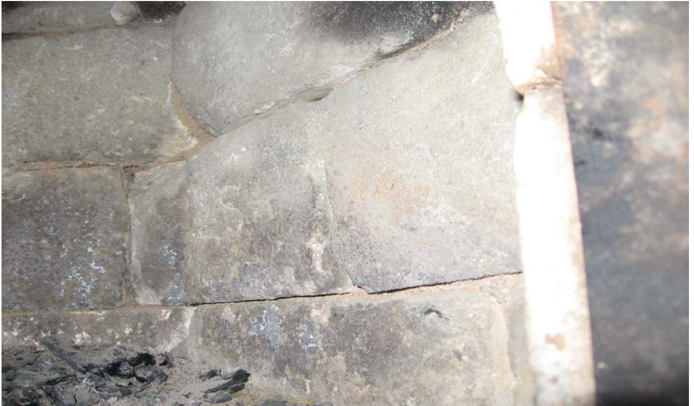
KUVA 29. Yleiskuva uunin n:o 12 tulipesästä.
