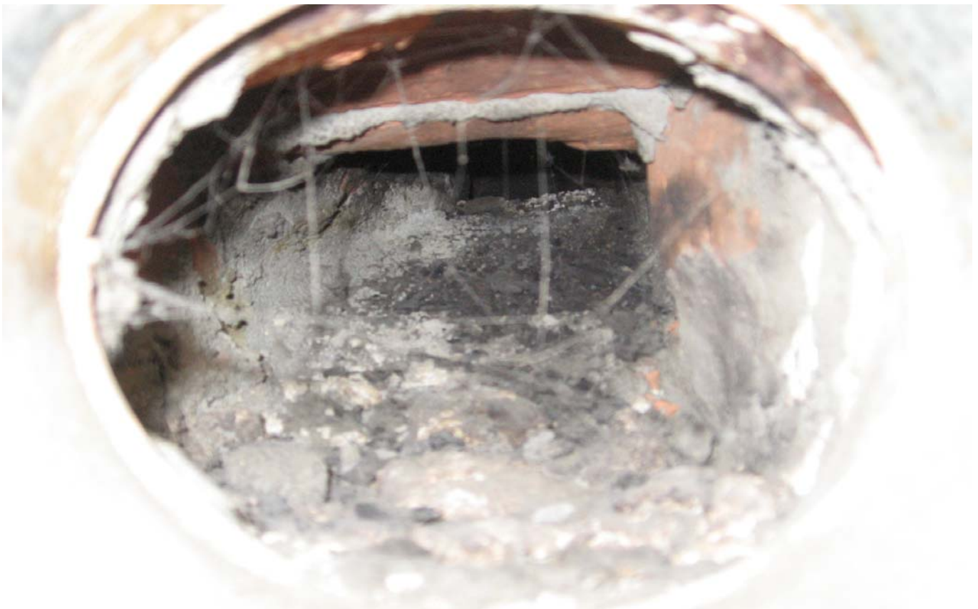
KUVA 18. Yleiskuva uunin n:o 6 poistoilmahormista.
