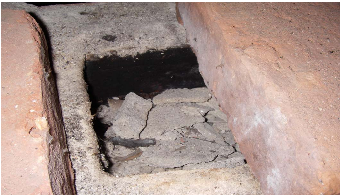
KUVA 36. Katkaistun hormiryhmän hormit ovat täynnä tiilen ja laastin kappaleita.
