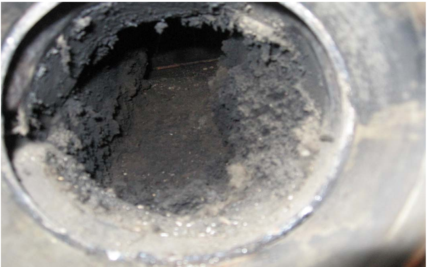
KUVA 10. Yleiskuva uunin n:o 2 poistoilmahormista.
