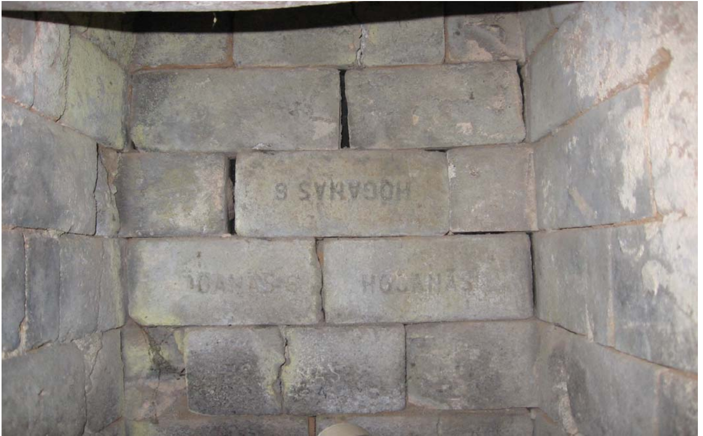
KUVA 19. Yleiskuva uunin n:o 7 tulipesästä.
