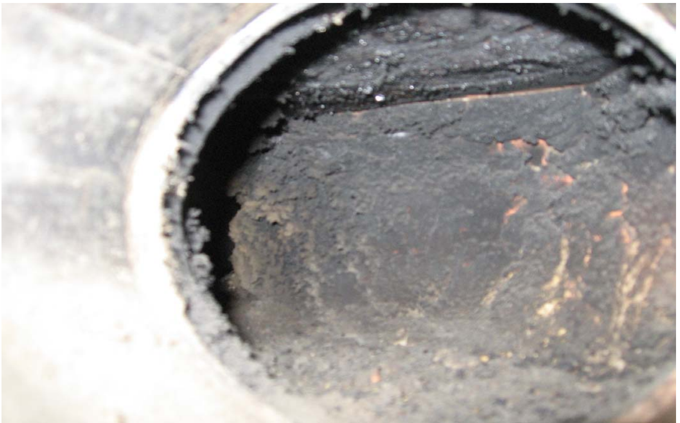
KUVA 12. Yleiskuva uunin n:o 3 poistoilmahormista.
