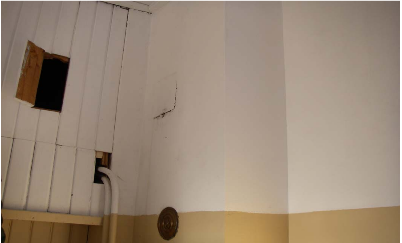
KUVA 31. Keittiön poistoilmahormissa oleva luukkua ei saa täysin auki.
