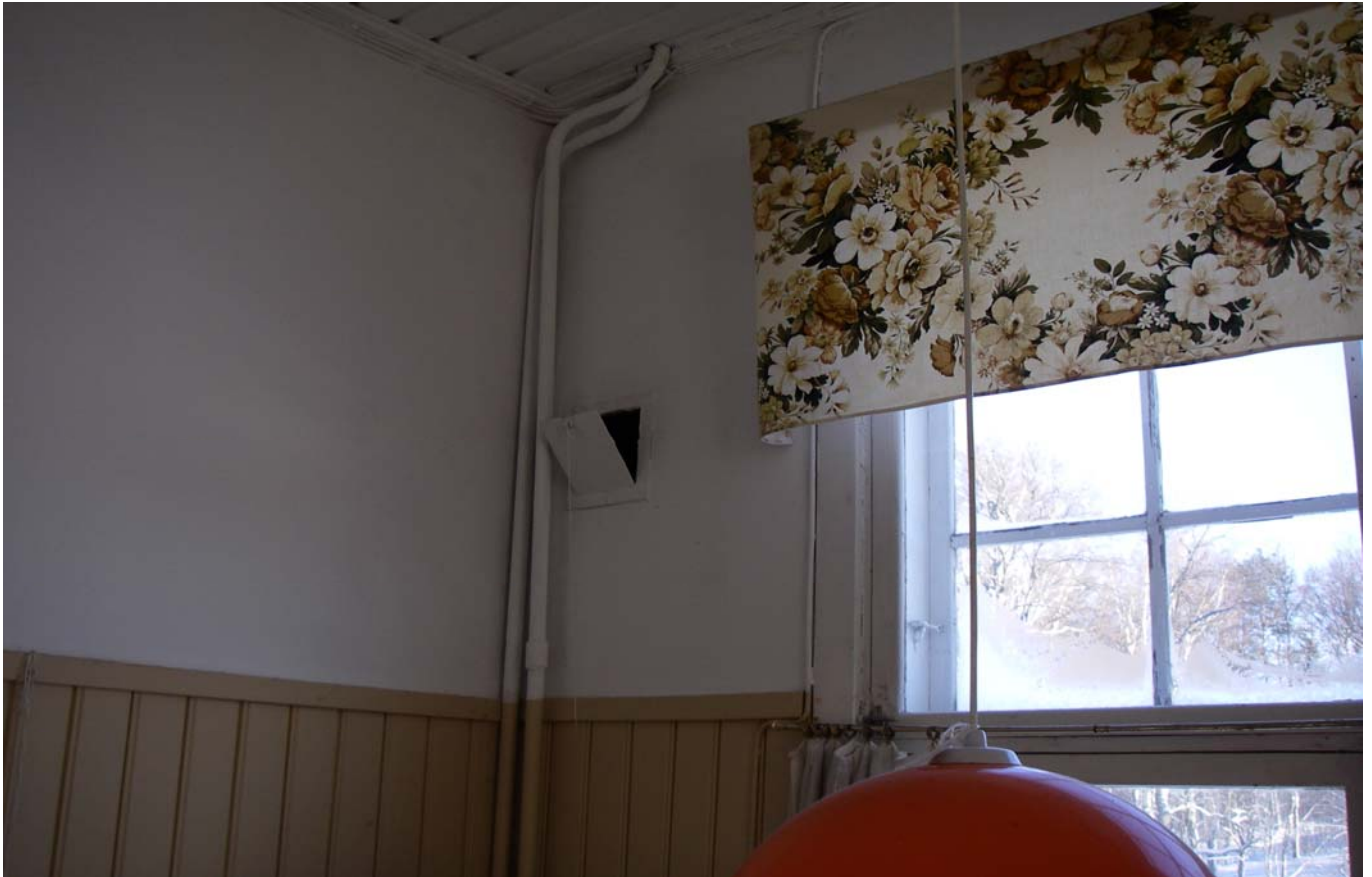
KUVA 3. Keittiön seinässä on korvausilmaluukku.
