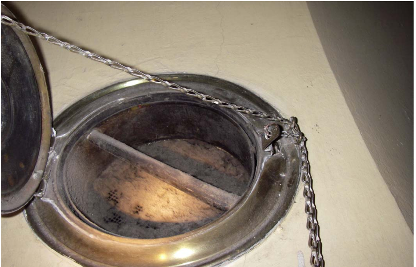
KUVA 6. Luukkujen alla on irrotettavat suojaverkot, jotka ovat osin melko pölyisiä.
