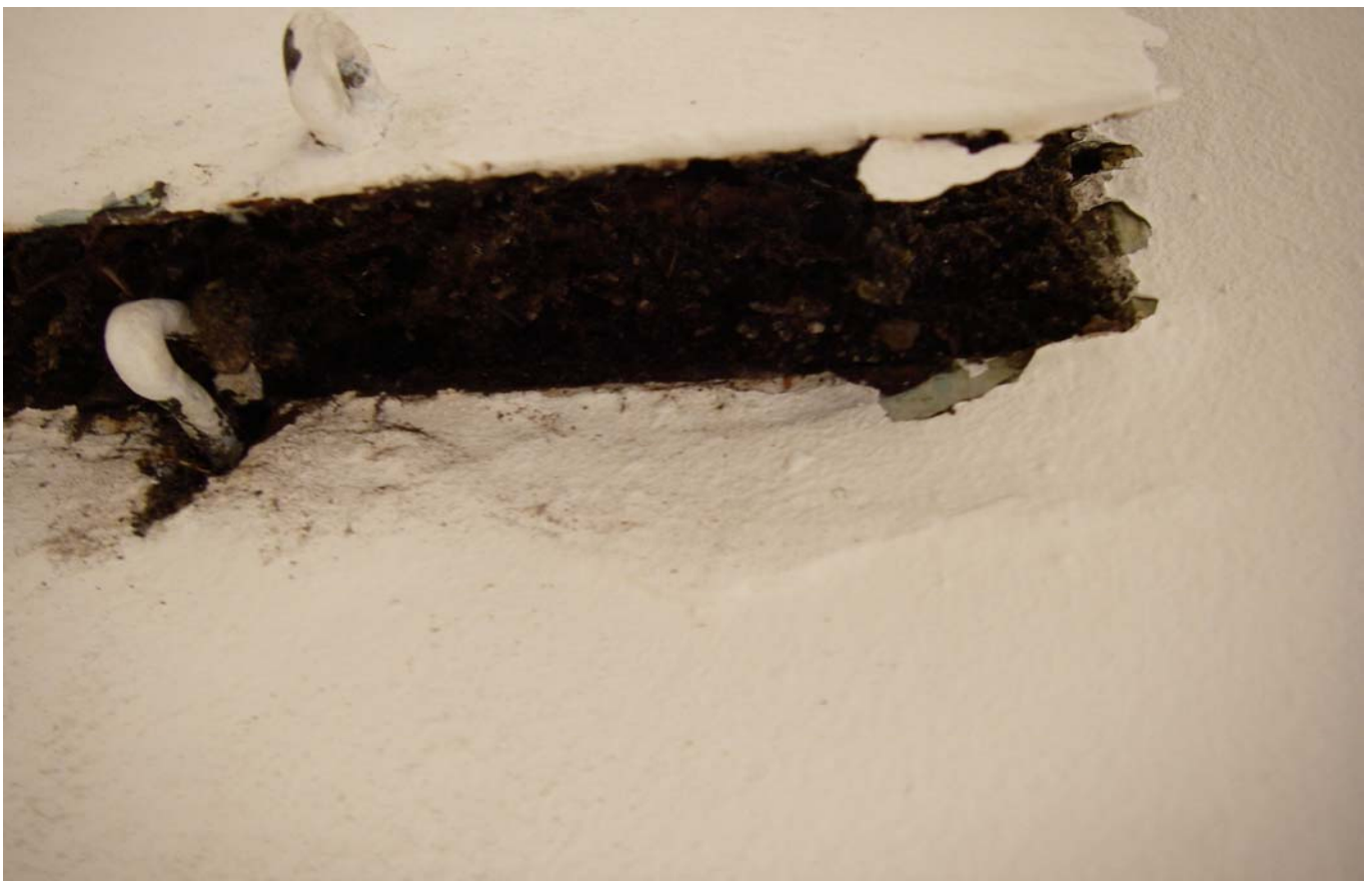
KUVA 32. Keittiön poistoilmahormissa on melko paljon pölyä ja roskaa.
