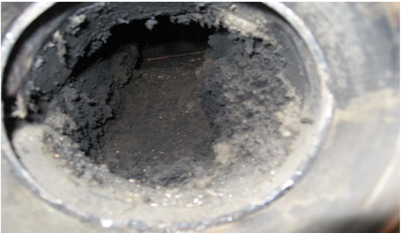
KUVA 2. Poistoilmahormeissa on pöly- ja nokikertymää.
