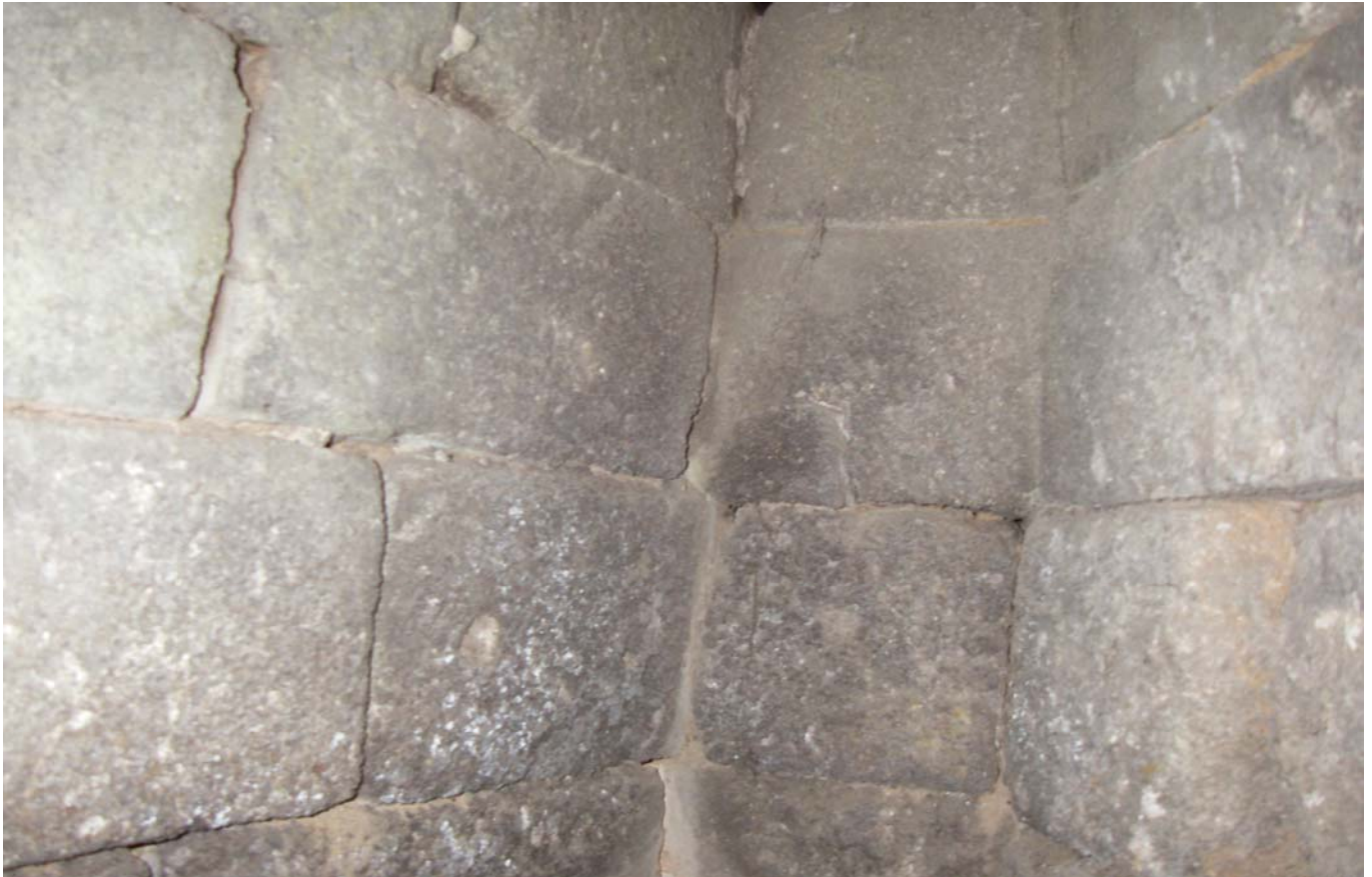
KUVA 25. Yleiskuva uunin n:o 10 tulipesästä.
