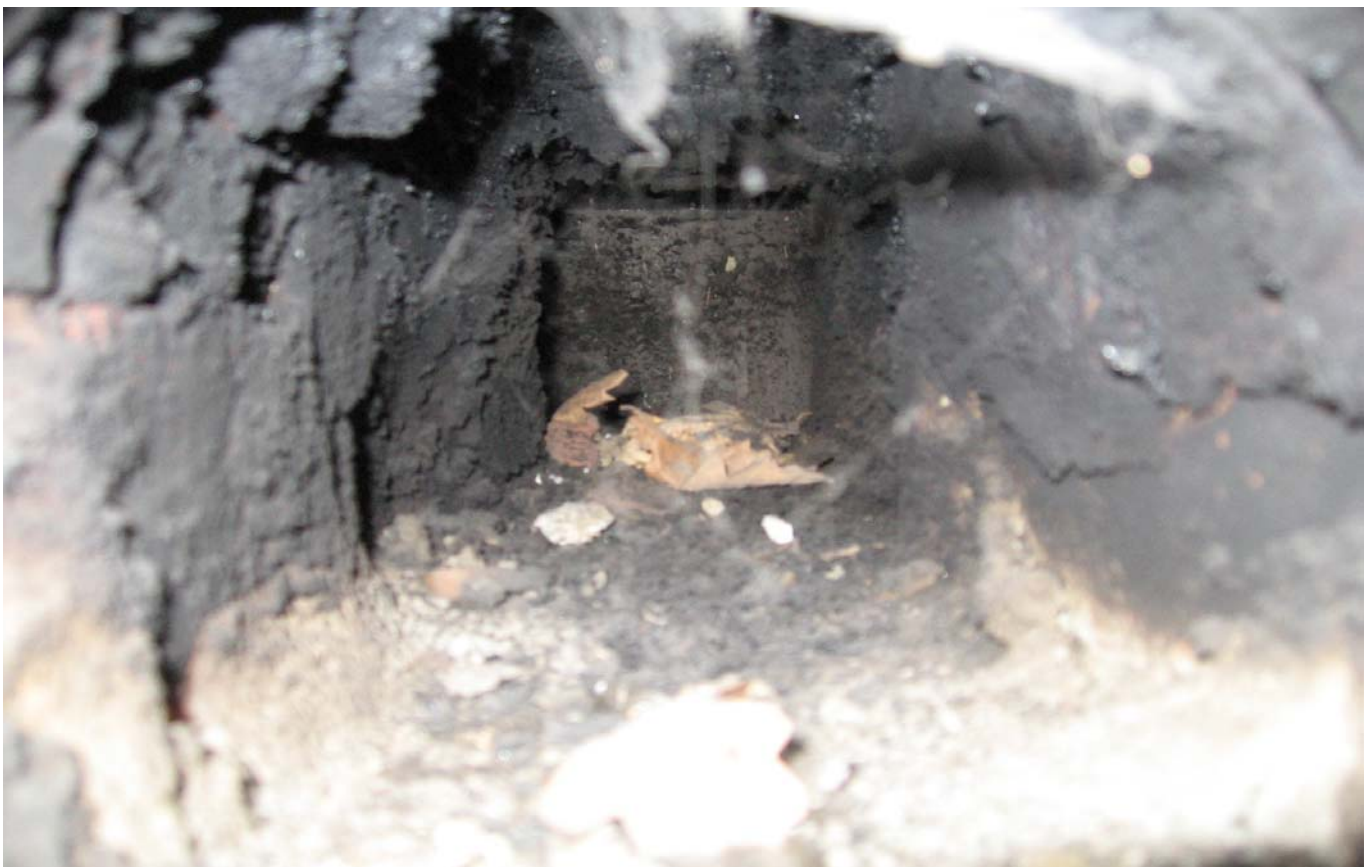
KUVA 24. Yleiskuva uunin n:o 9 poistoilmahormista.
