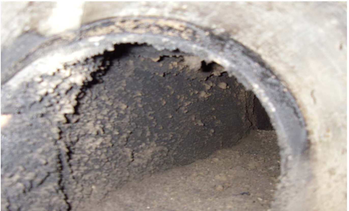
KUVA 16. Yleiskuva uunin n:o 5 poistoilmahormista.
