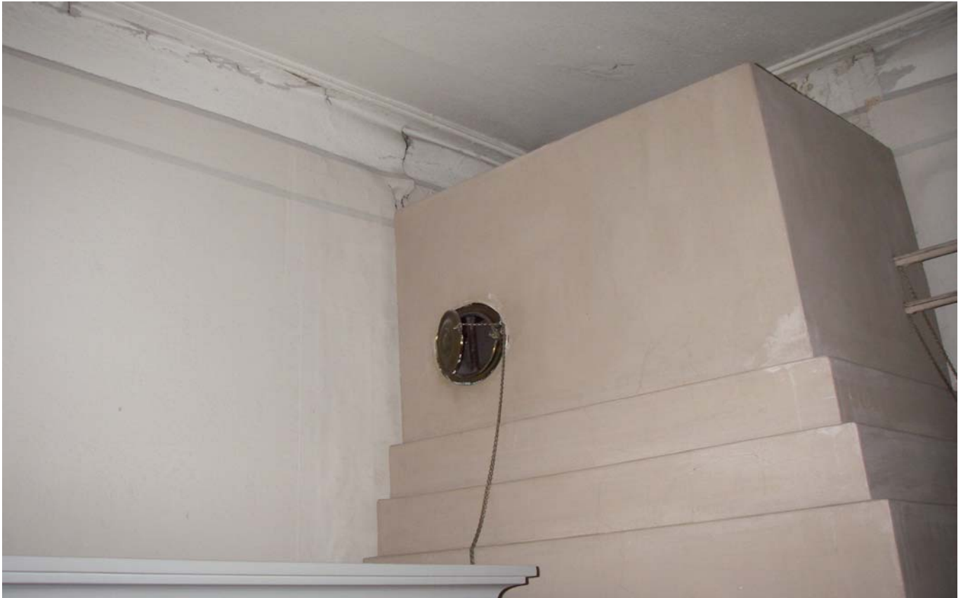
KUVA 5. Pystyjuunien poistoilmahormeissa on alkuperäiset suljettavat poistoilmaventtiilit.
