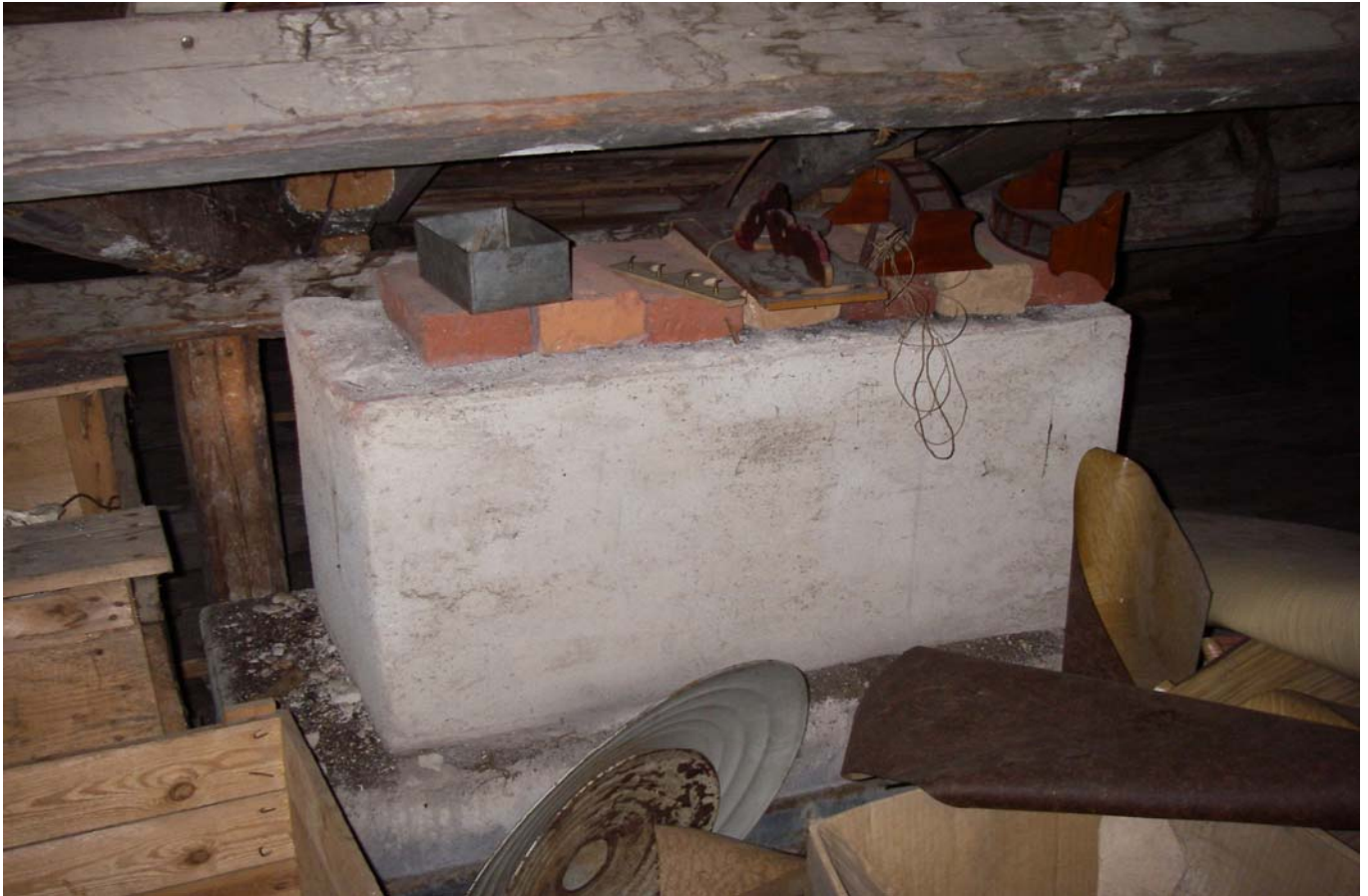
KUVA 35. Pohjoisin hormiryhmä on katkaistu ullakkotiloissa.
