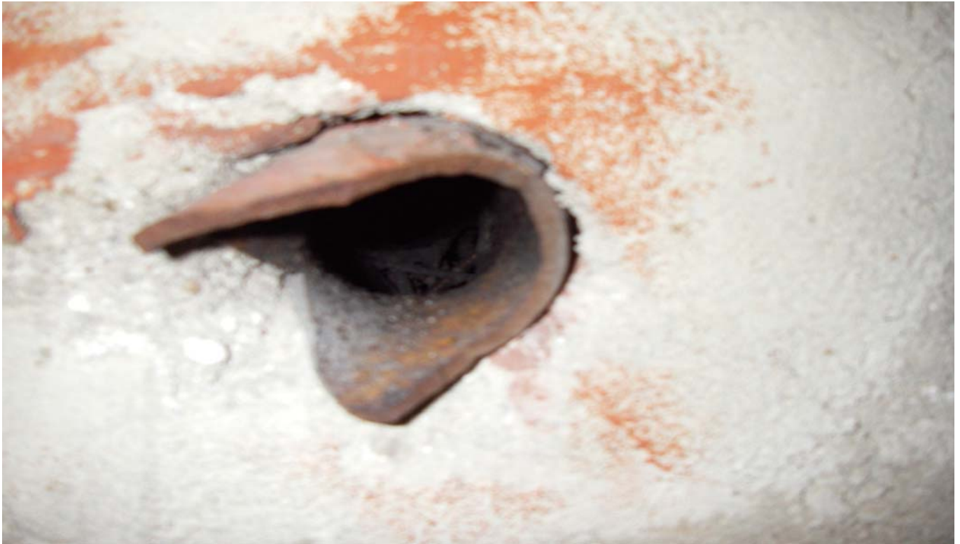
KUVA 37. Savuhormissa on katkennut valurautaputki.
