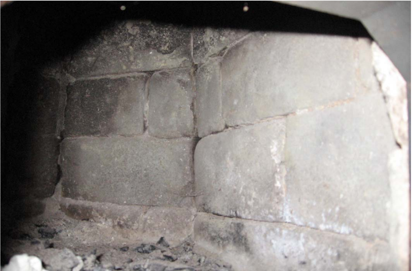
KUVA 21. Yleiskuva uunin n:o 8 tulipesästä.
