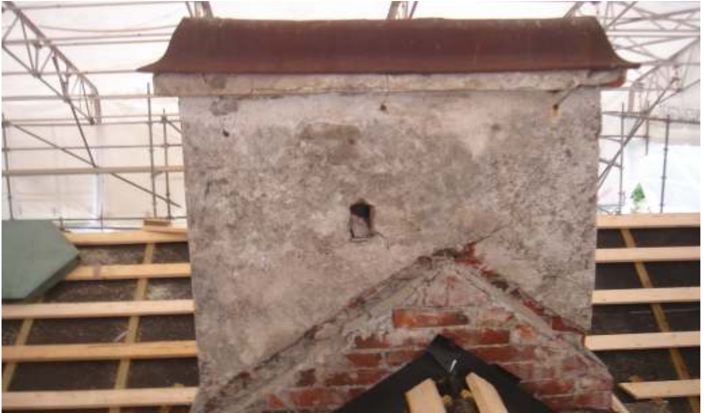
KUVA 5. Piippuryhmän n:o 2 ulkokuoressa on havaittavissa halkeamia ja reikiä.
