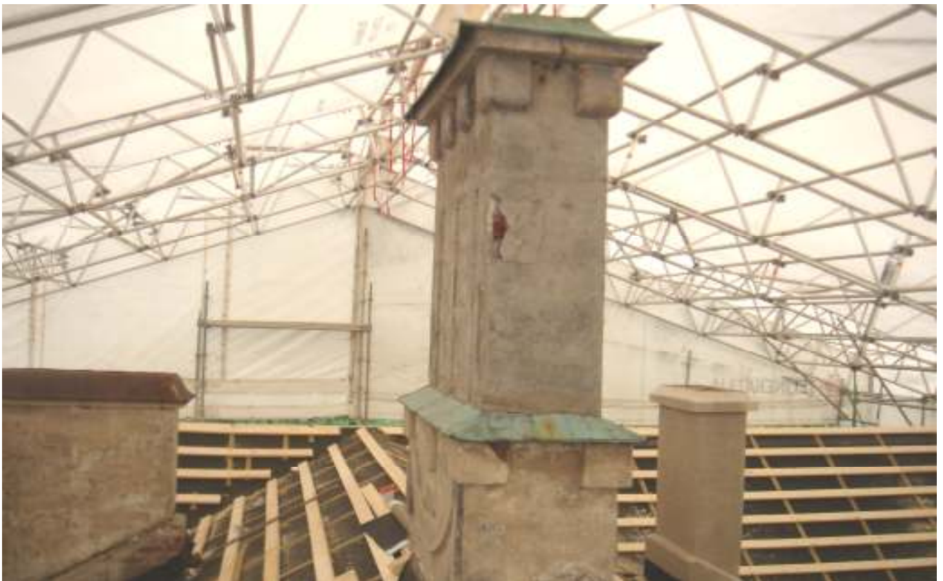
KUVA 4. Piippuryhmän n:o 1 ulkokuoressa on havaittavissa halkeamia.
