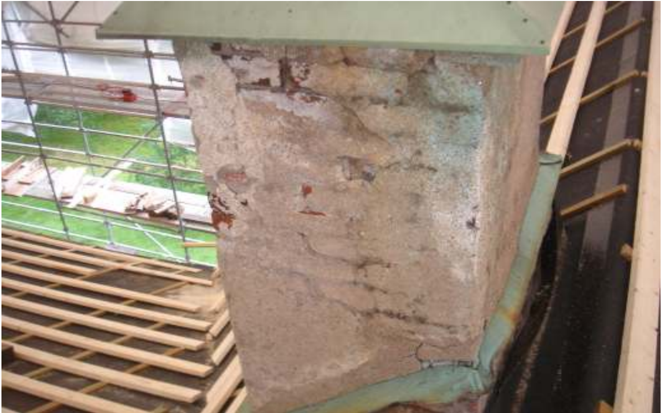
KUVA 7. Piippuryhmän n:o 3 ulkokuoressa on havaittavissa halkeamia.
