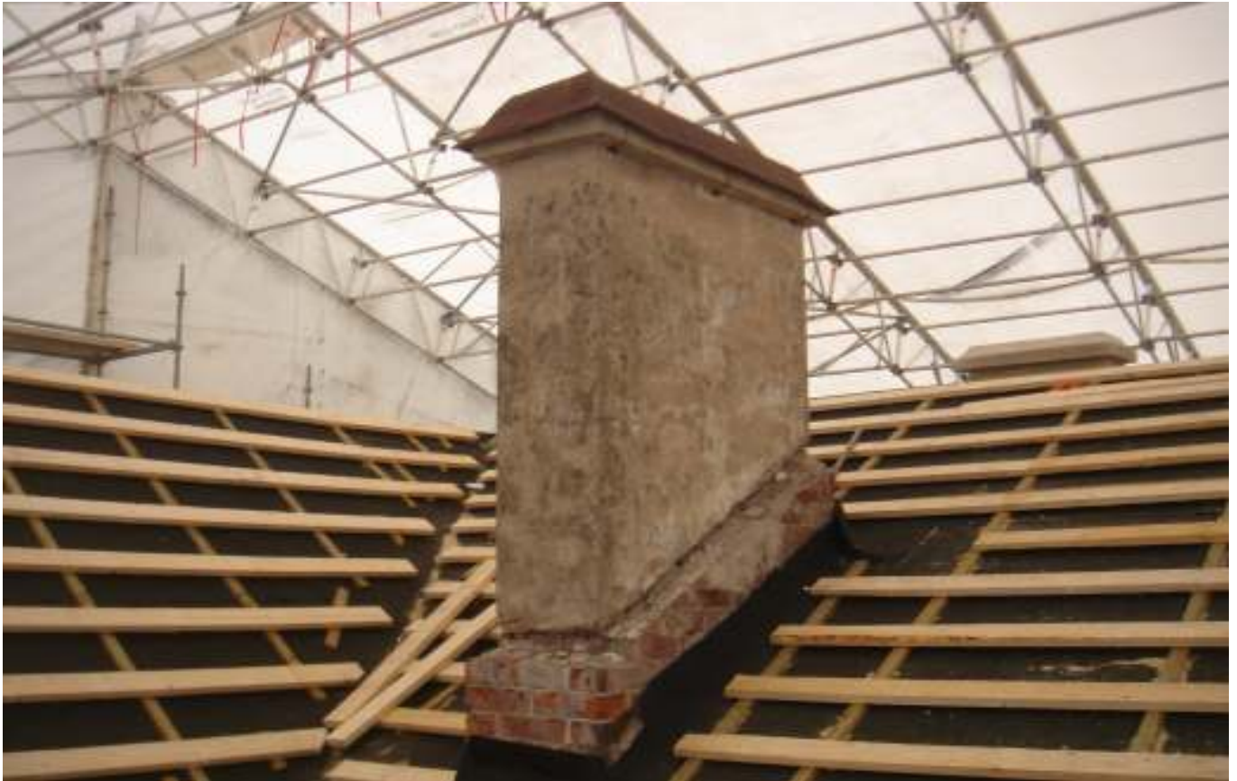
KUVA 9. Piippuryhmän n:o 4 ulkokuoressa on havaittavissa halkeamia.
