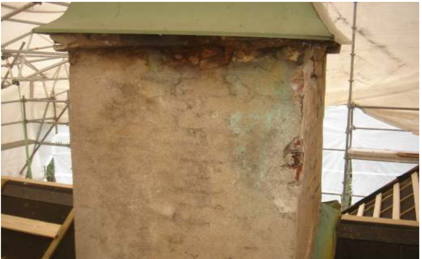
KUVA 8. Piippuryhmän n:o 3 ulkokuoressa on havaittavissa monin paikoin halkeamia.
