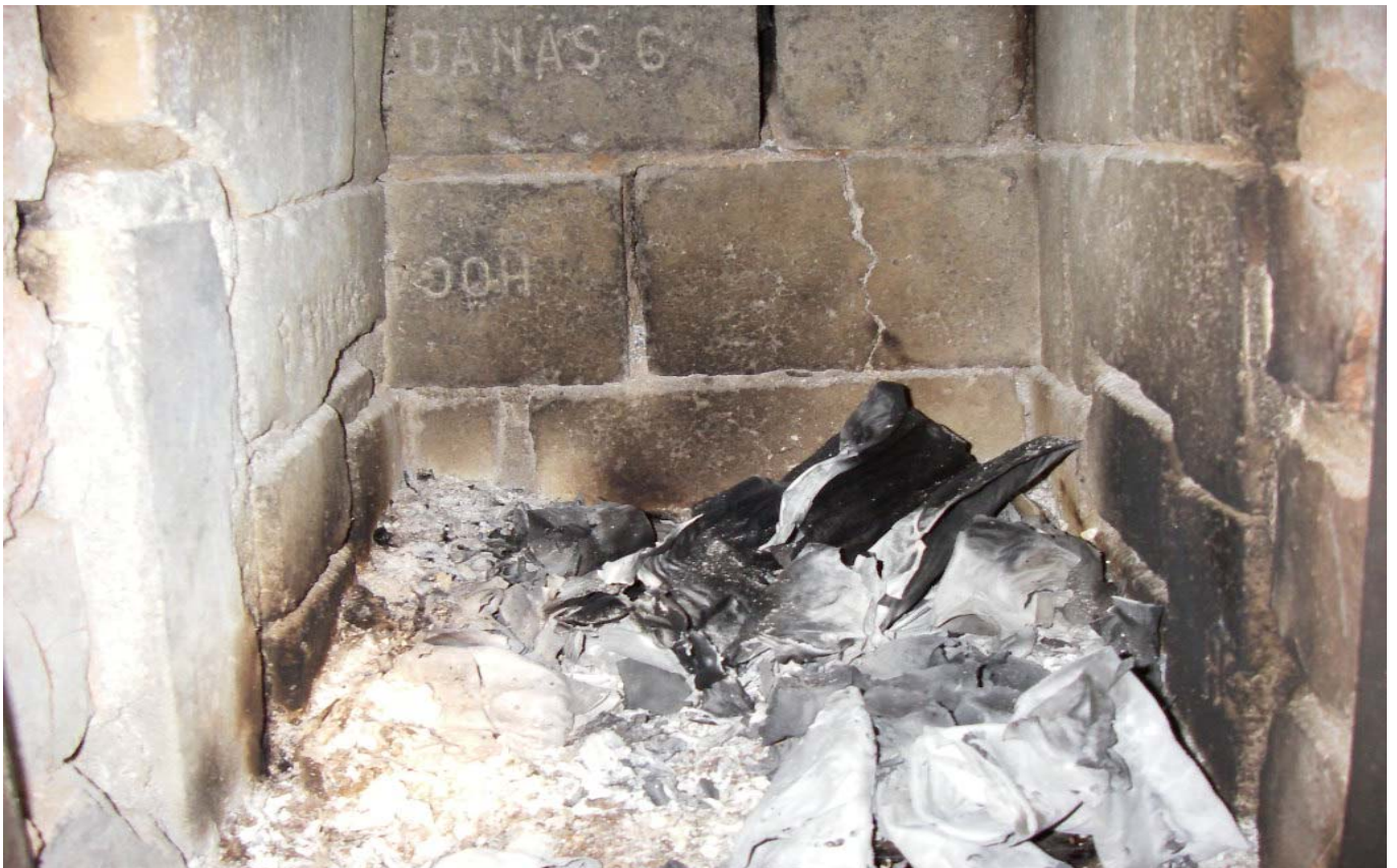
KUVA 12. Yleiskuva uunin n:o 4 tulipesästä.
