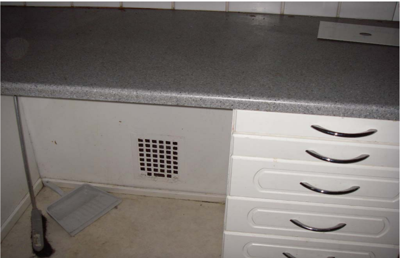
KUVA 4. Keittiön seinässä on korvausilmaritilä.
