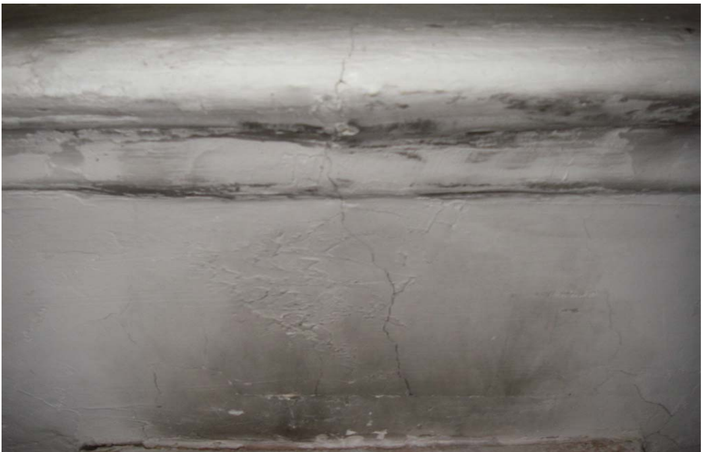
KUVA 6. Pystyuunin n:o 1 ulkokuoressa on halkeamia.
