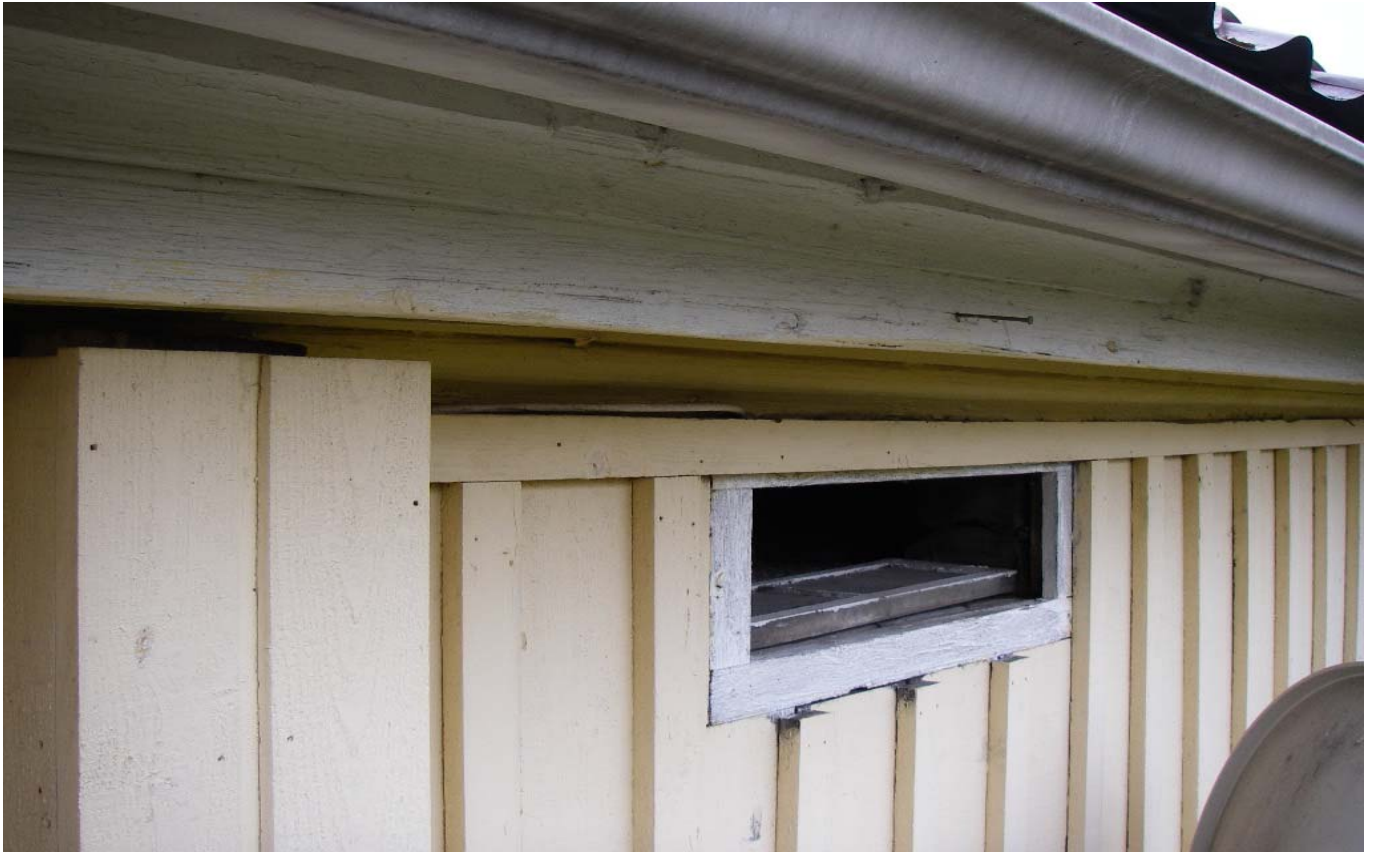
KUVA 15. Ullakkotiloissa on ikkunoita auki.
