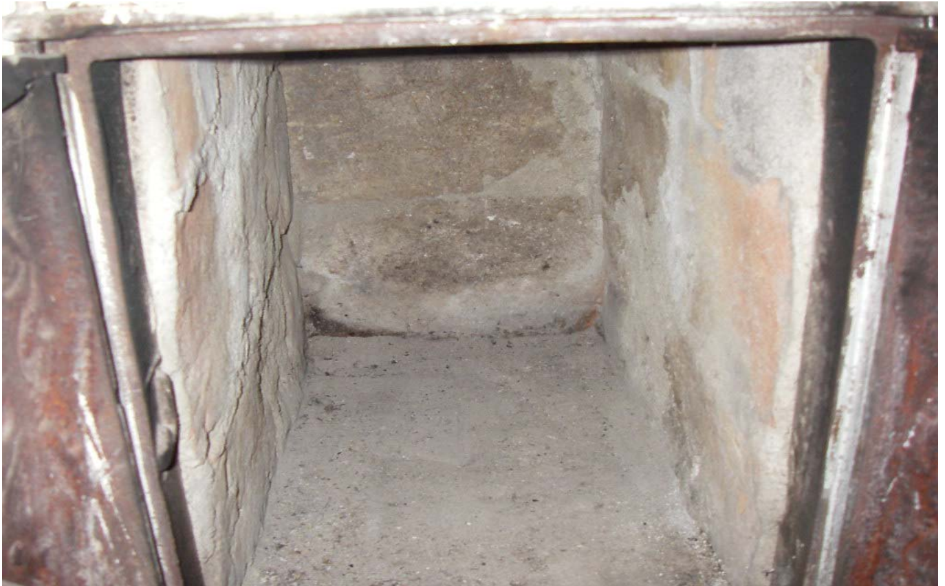
KUVA 9. Yleiskuva uunin n:o 2 tulipesästä.
