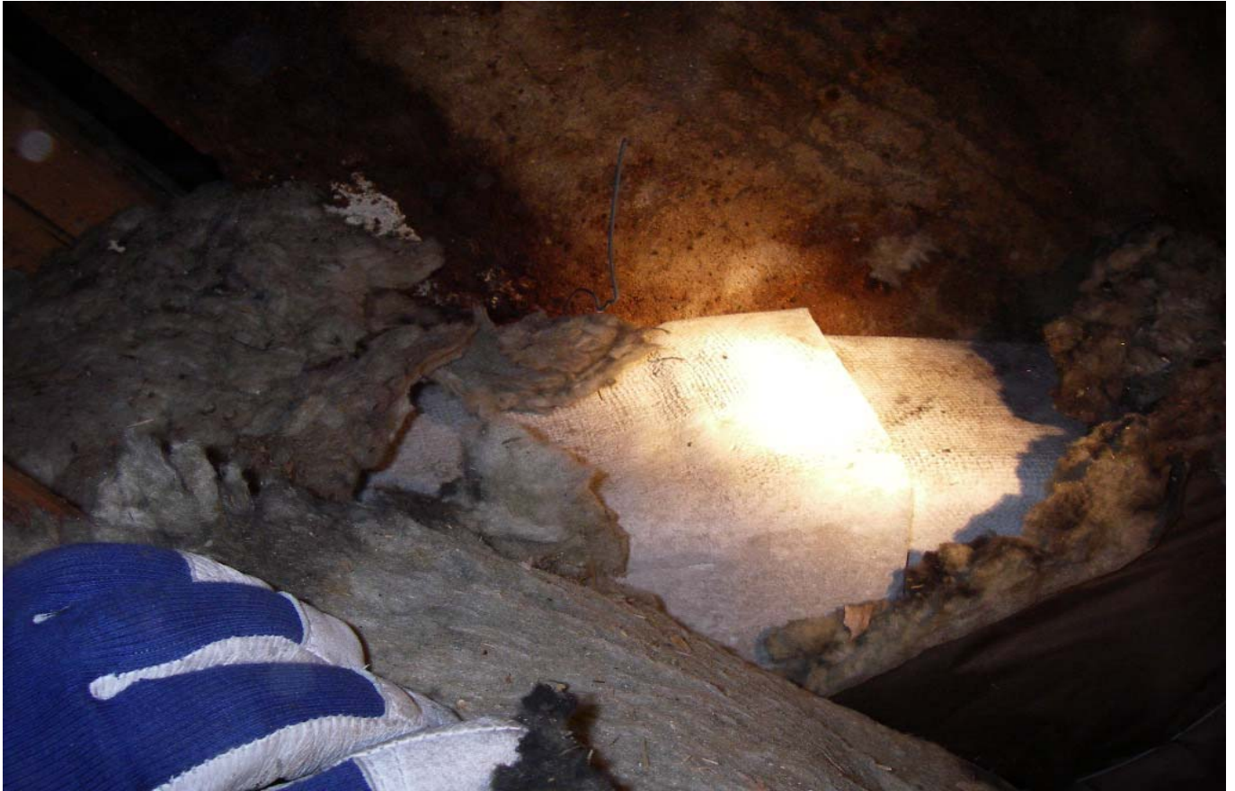
KUVA 1. Poistoilmahormit on rakennettu asbestisementtikanaavalla.
