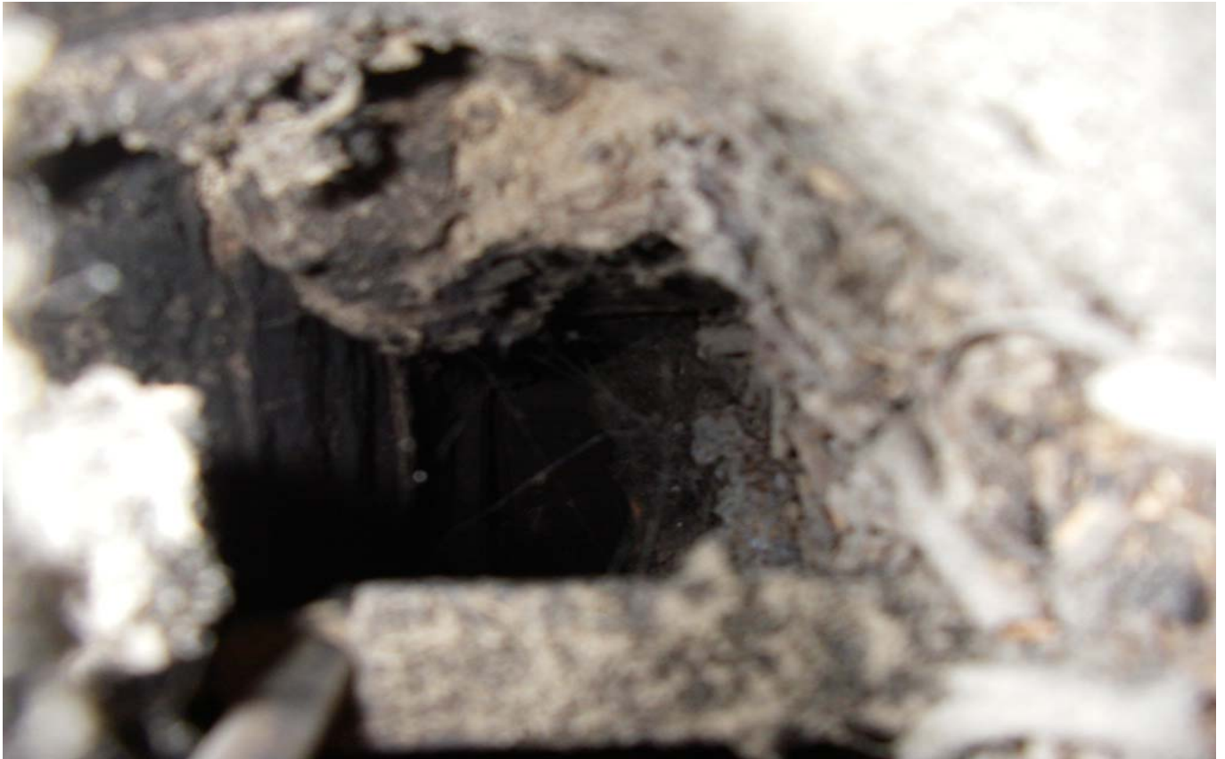
KUVA 11. Yleiskuva uunin n:o 2 korvausilmahormista.
