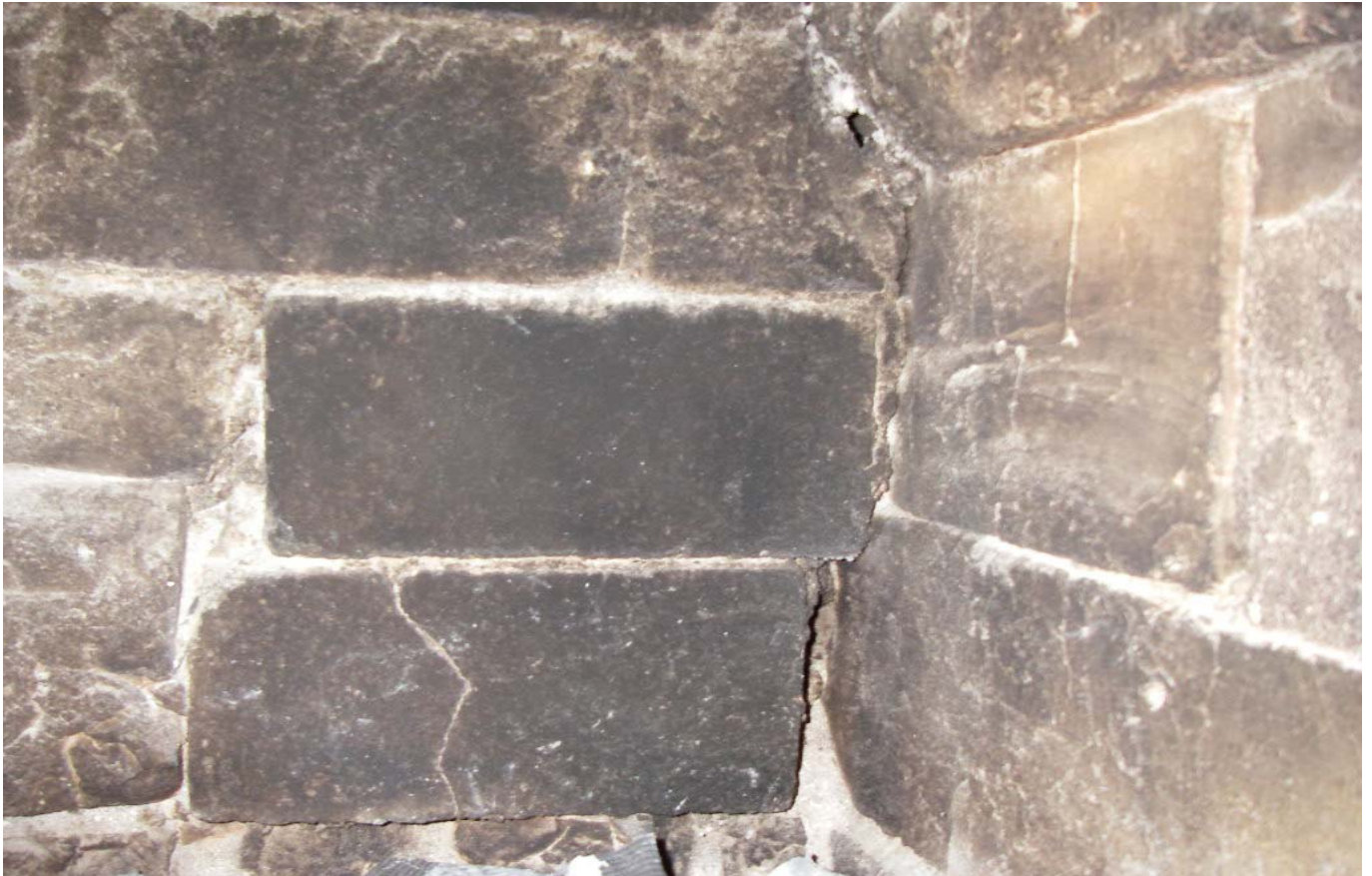
KUVA 7. Yleiskuva uunin n:o 1 tulipesästä.
