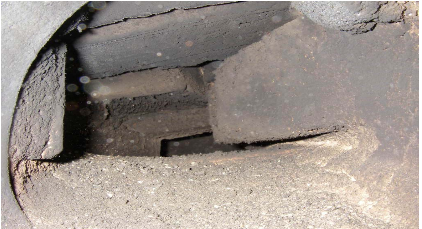
KUVA 14. Yleiskuva uunin n:o 4 korvausilmahormista.
