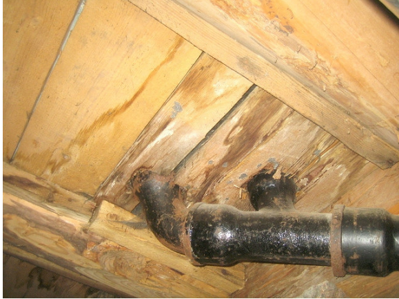
Kuva 3 Keittiöstä tulevan viemärin ympärillä oli vanhoja kosteusvauriojälkiä
