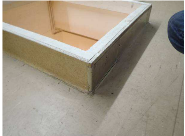
IV-konehuoneen kulkuluukun kohdalta matto on haljennut (tila 50).
