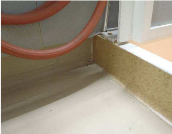
IV-konehuoneen mattonostot ovat haljenneet (tila 50).
