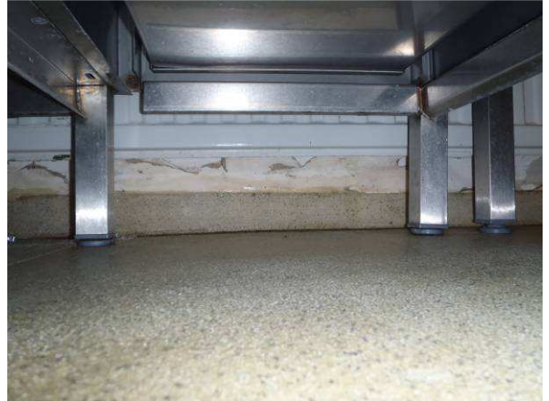
Keittiön ulkoseinällä havaittiin kohonneita kosteusarvoja ja kosteuden aiheuttamia vaurioita (tila 13).
