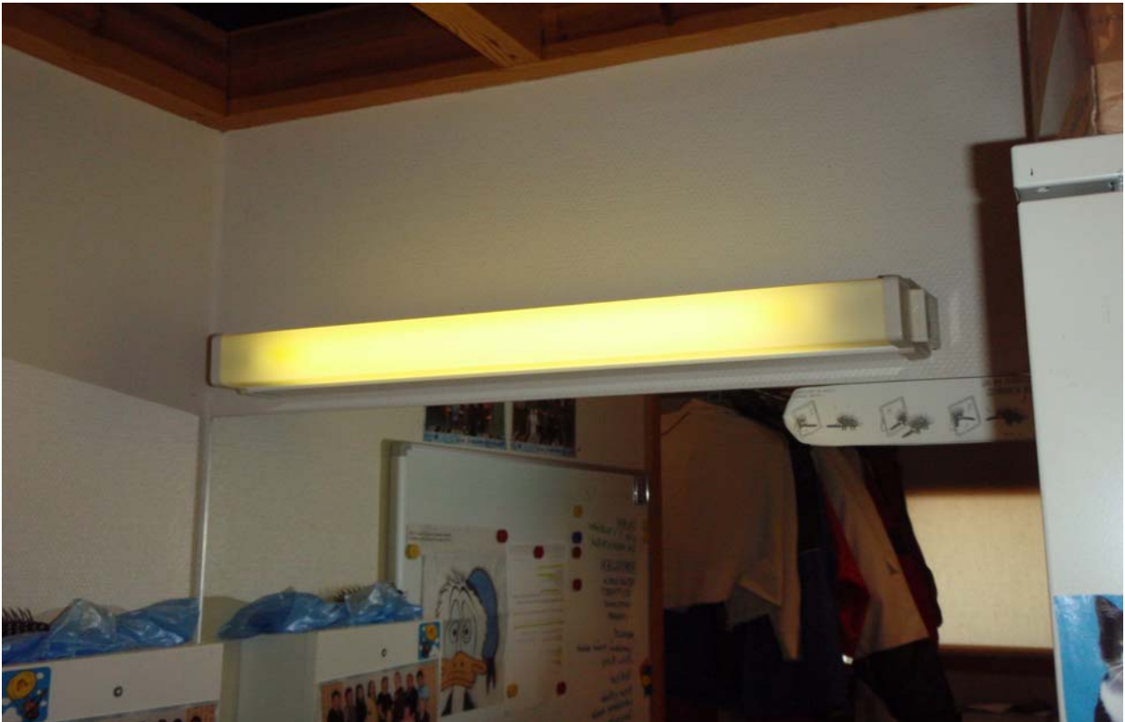
S-KUVA 7. WC- tilojen valaistus
