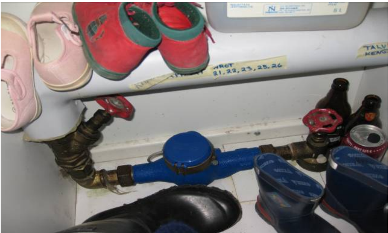
LVI-kuva 2. Yleiskuva vesimittarista ja pääsuluista.
