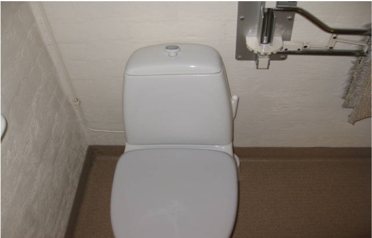
LVI-kuva 4. Yleiskuva vesikalusteista.
