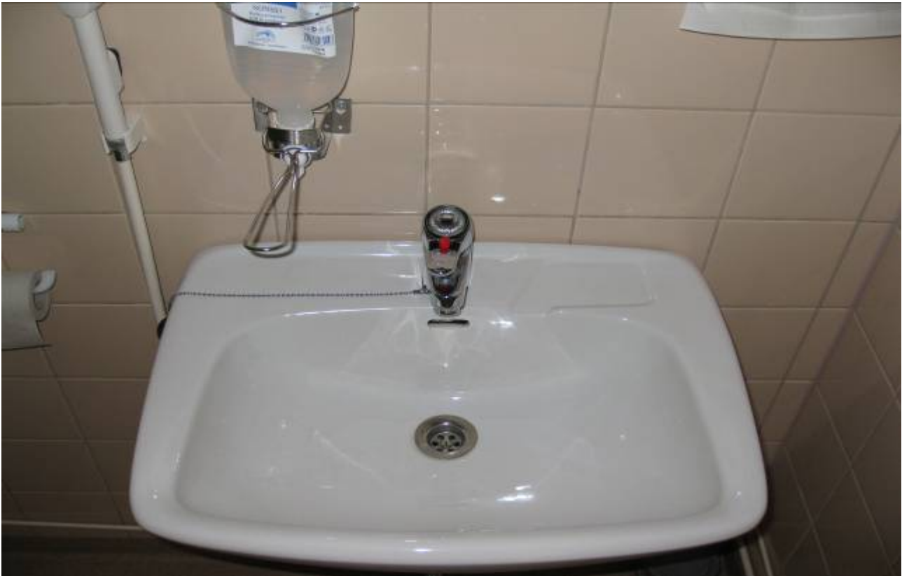
LVI-kuva 3. Yleiskuva vesikalusteista.
