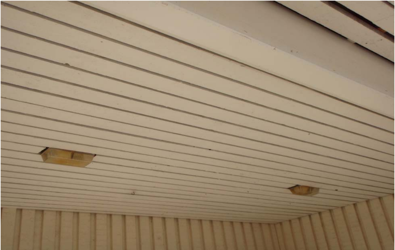
S-KUVA 1. Sisäänkäynnin valaistus
