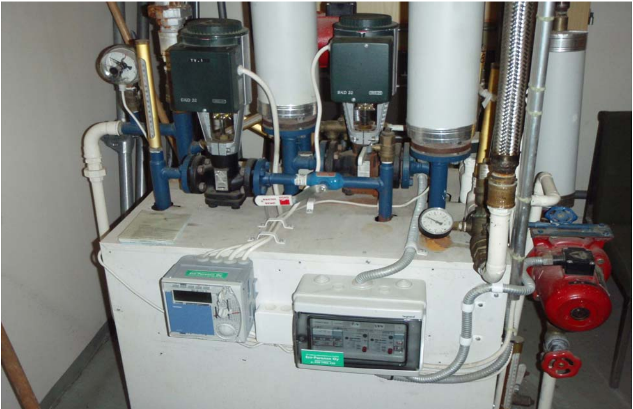
S-KUVA 13. Lämmitysjärjestelmän yksikkösäädin
