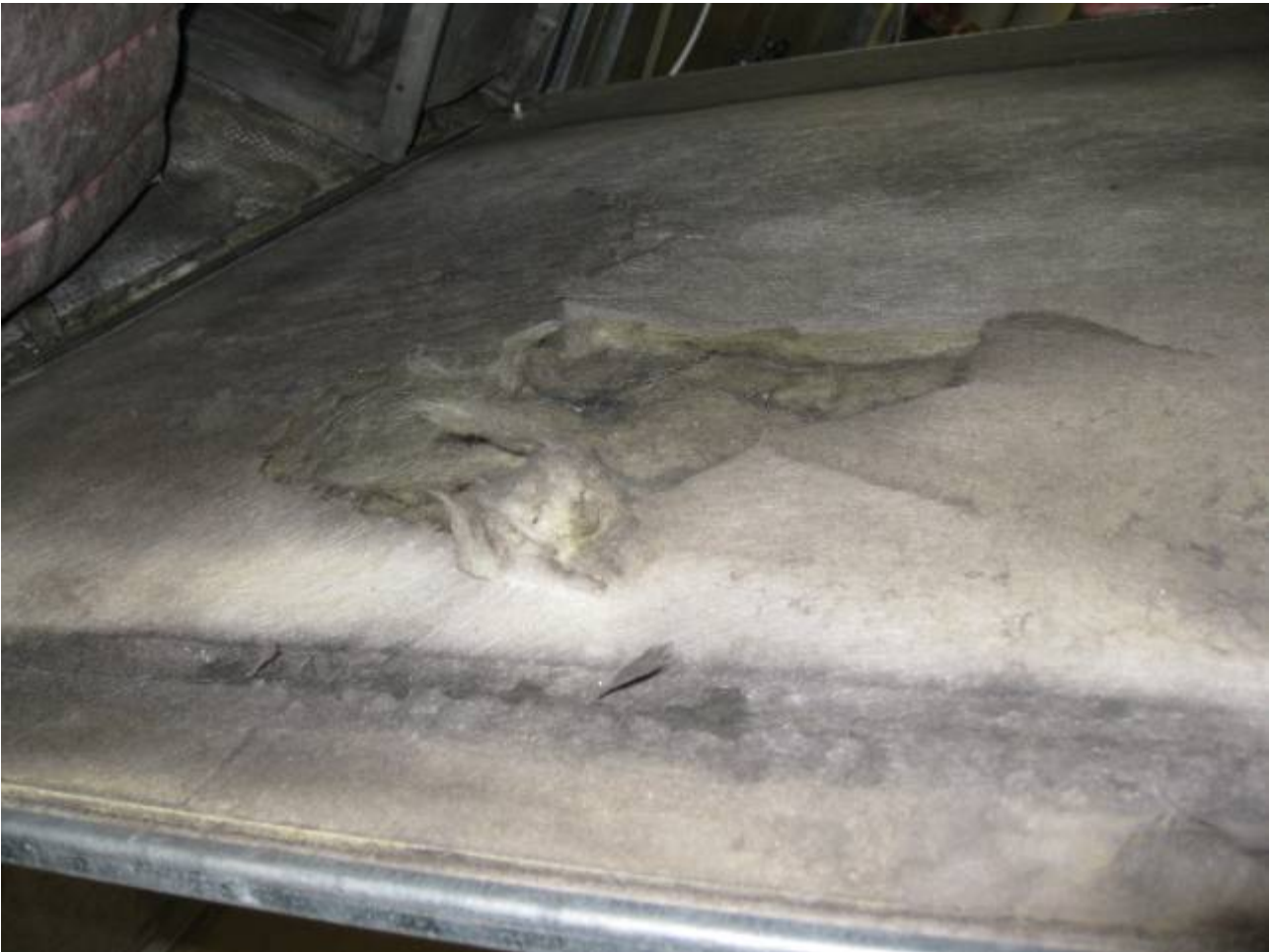
LVI-kuva 5. Ilmastointikoneen suodatinkammion villapinnoite on rikkoutunut.
