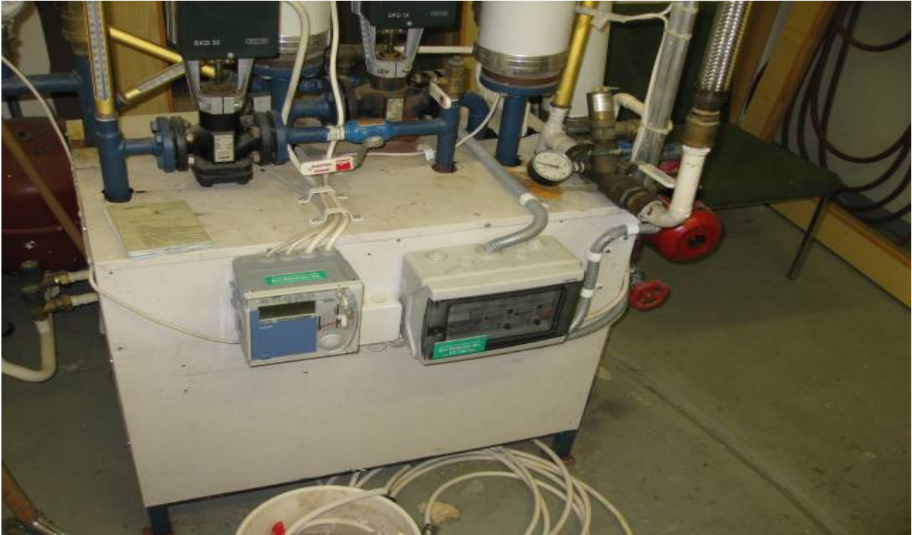
LVI-kuva 1. Yleiskuva lämmönjakohuoneesta.
