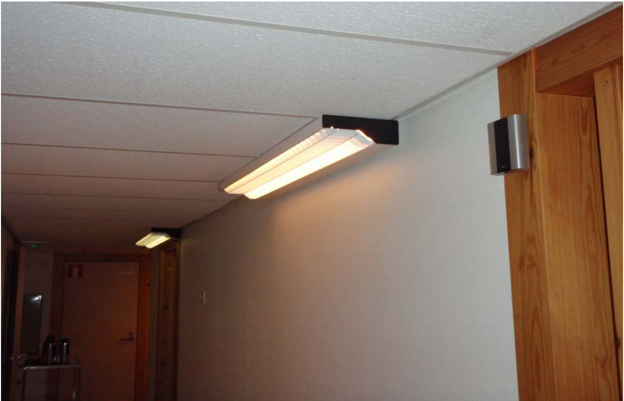
S-KUVA 5. Käytävän valaistus
