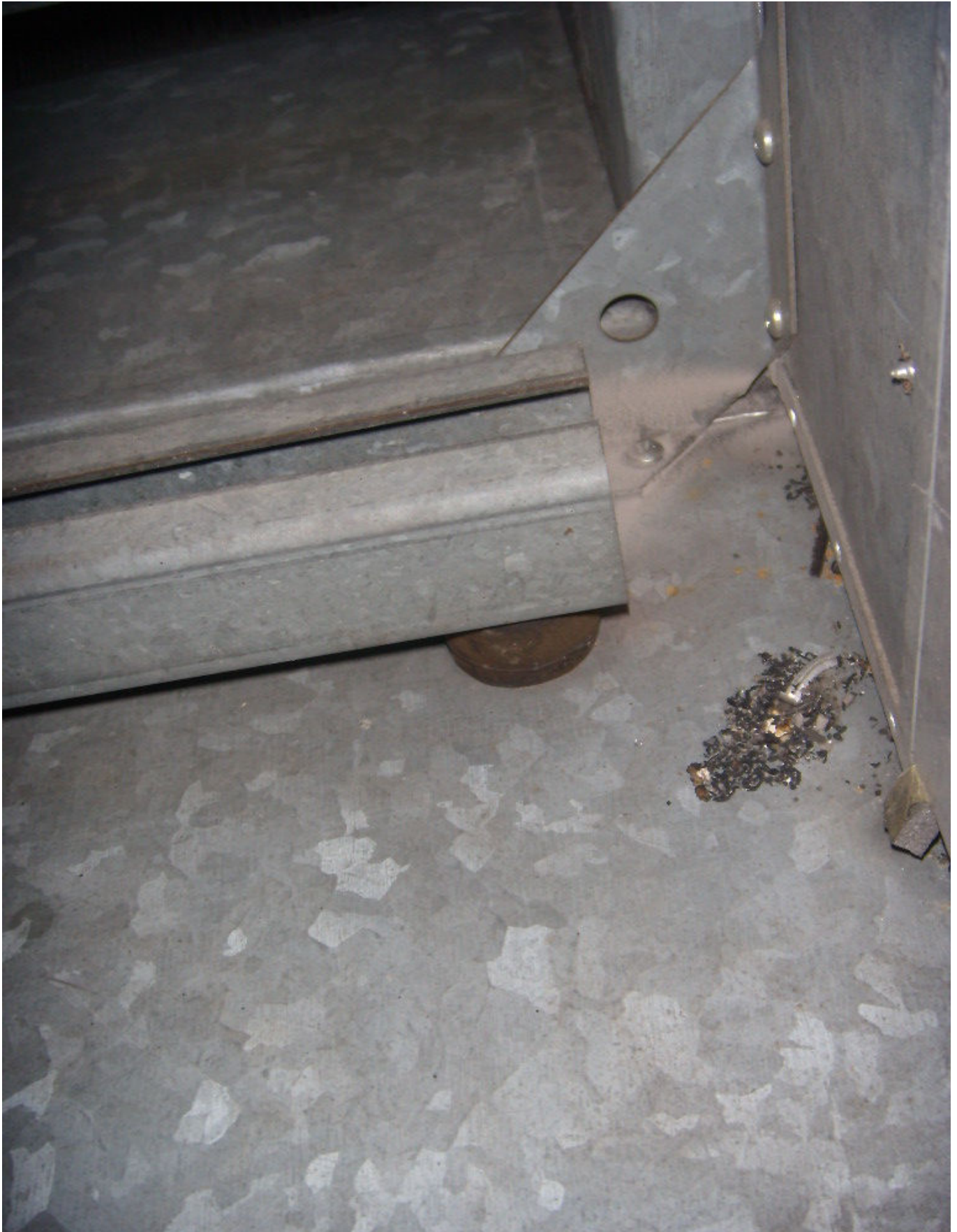
KUVA 7. Yleiskuva poistoilmakoneen kammiosta.
