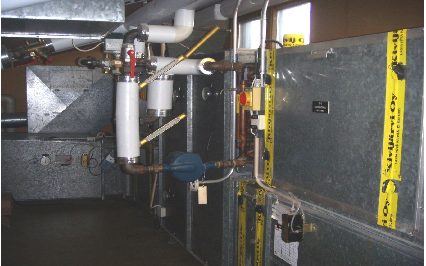
KUVA 1. Yleiskuva IV- konehuoneesta.
