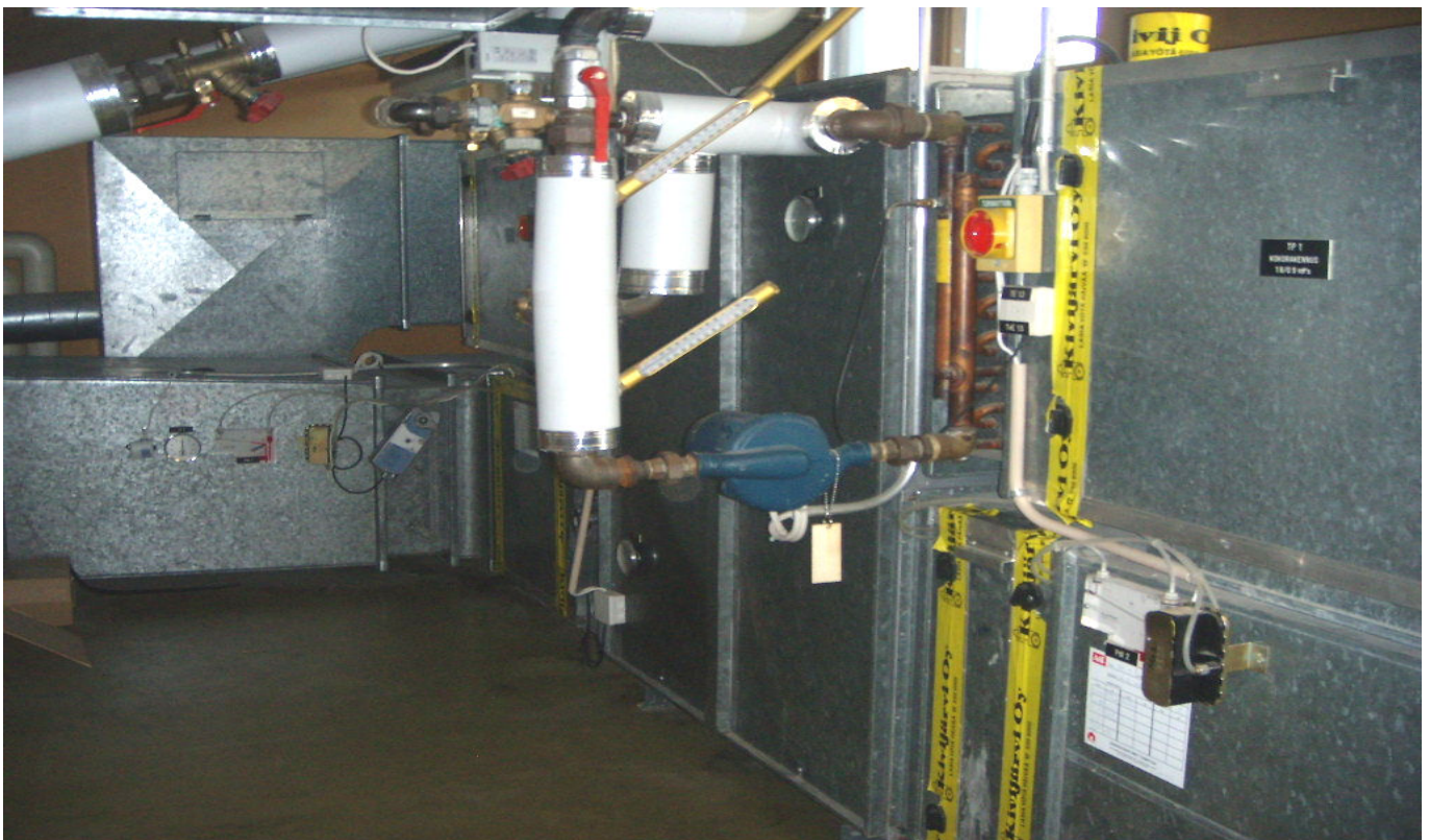
KUVA 2. Tuloilmakoneen luukkuja on tiivistetty teipillä.
