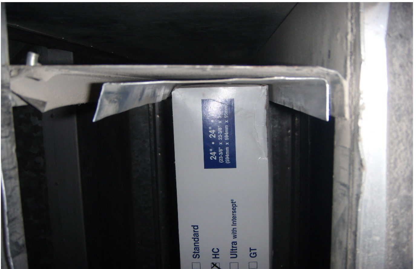
KUVA 4. Yleiskuva poistoilmasuodattimien kehikosta.
