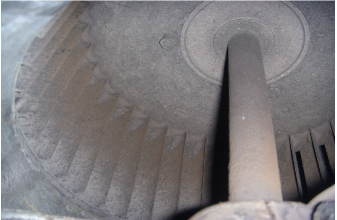
KUVA 5. Yleiskuva poistoilmahuuhaltimesta PP1.
