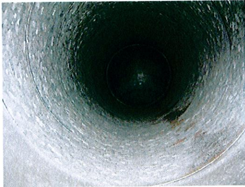
Kuva 1. Tuloilmakanava, tyttöjen pukuhuone.
