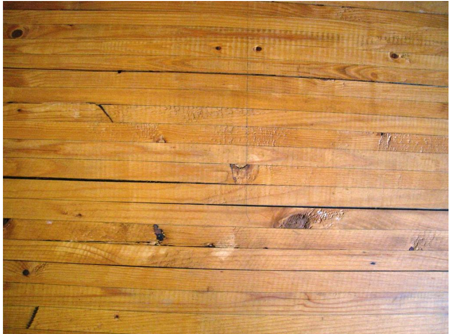
Kuva 5. Pieniä kuivumishalkeamia palkin kyljessä.
