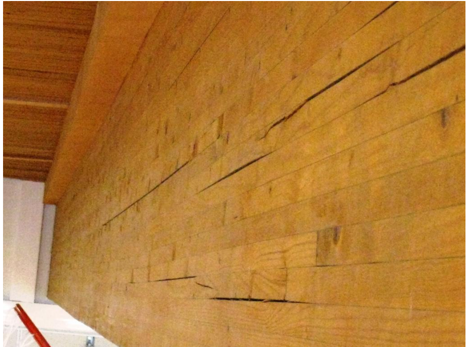
Kuva 2. Halkeamia puolapuupäädyn vastakkaisella puolella, Suurin mitattu syvyys oli 30 mm.
