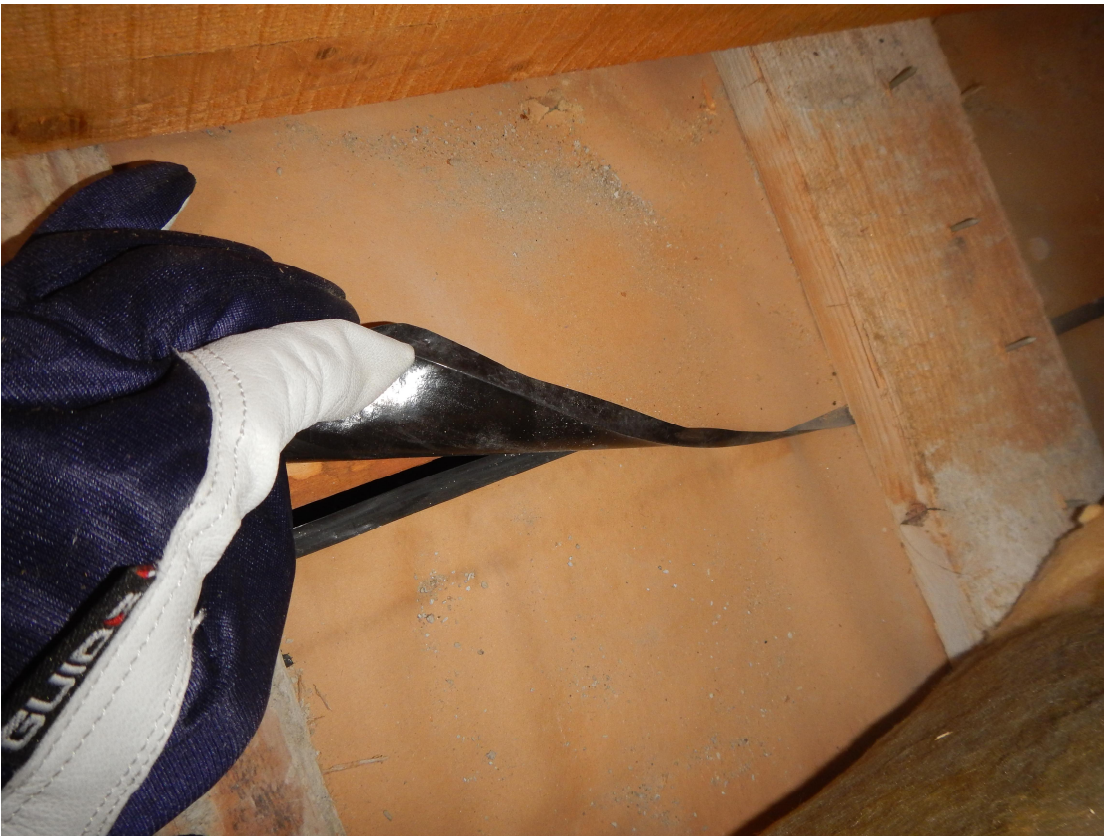
Kuva 5. Liikuntasalin yläpohja. Eristepaperin saumoista näkyi osittain liikuntasalin sisätila. Merkkiainekokeissa kaasu kulkeutui liikuntasalin sisäilmaan yläpohjan ilmatilasta.
