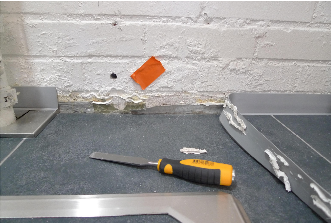
Kuva 19. AVAUS 7. K074. Ulkoseinän ja lattian liittymän tiivistyksestä puuttui noin 10 cm kokoinen pala Codex-nauhaa.
