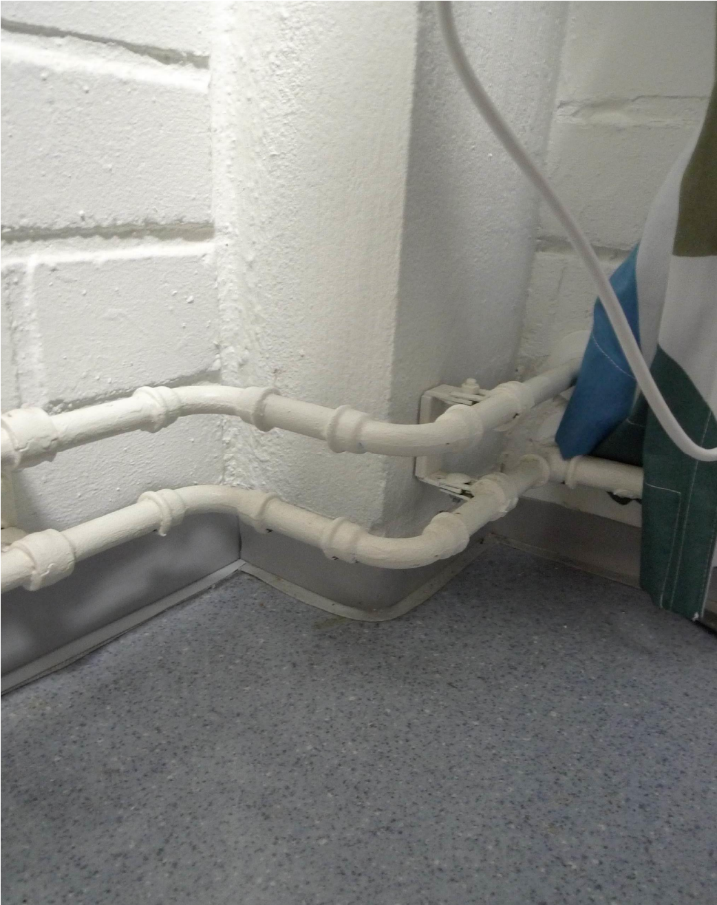
Kuva 4. AVAUS 2. 1004. Opinto-ohjaajan huoneen ulkoseinällä olevan pilarin ja ulkoseinän liittymästä löytyi merkkiainekokeessa merkittäviä ilmavuotoja.
