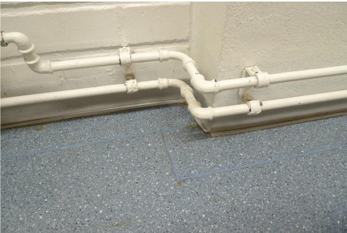
Kuva 10. AVAUS 4. 1060. Kotitalousluokan pilarin ja ulkoseinän liittymästä löytyi merkkiainekokeessa merkittäviä vuotoja.
