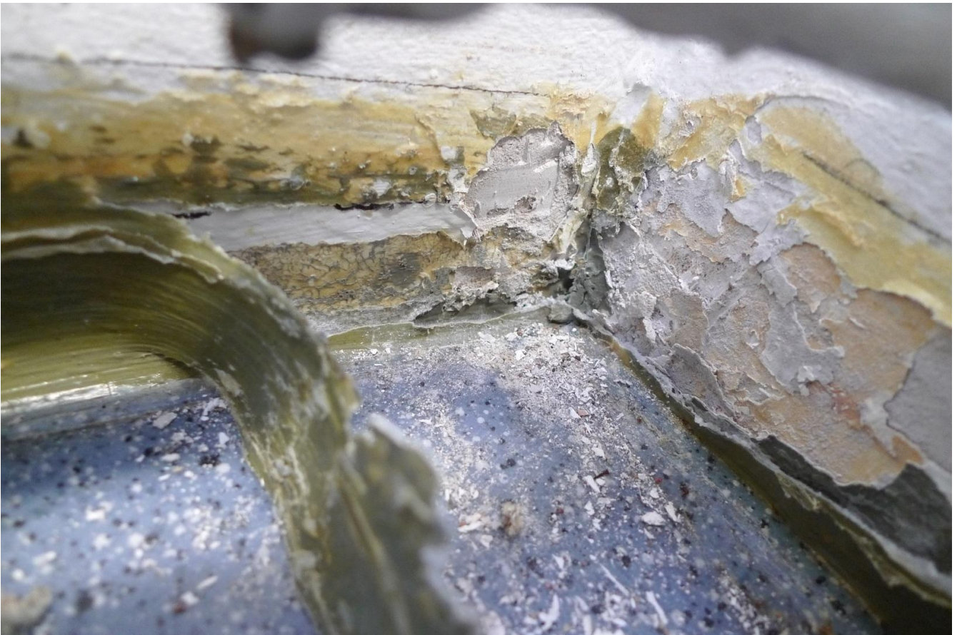
Kuva 11. AVAUS 4. 1060. Tiivistysmateriaalina oli käytetty väristä päätellen yksikomponenttista Ardex S 1-K –vedeneristemassaa sekä Ardex SK 12 –tyyppistä vahvikenauhaa, joka rikkoutui avauksessa.
