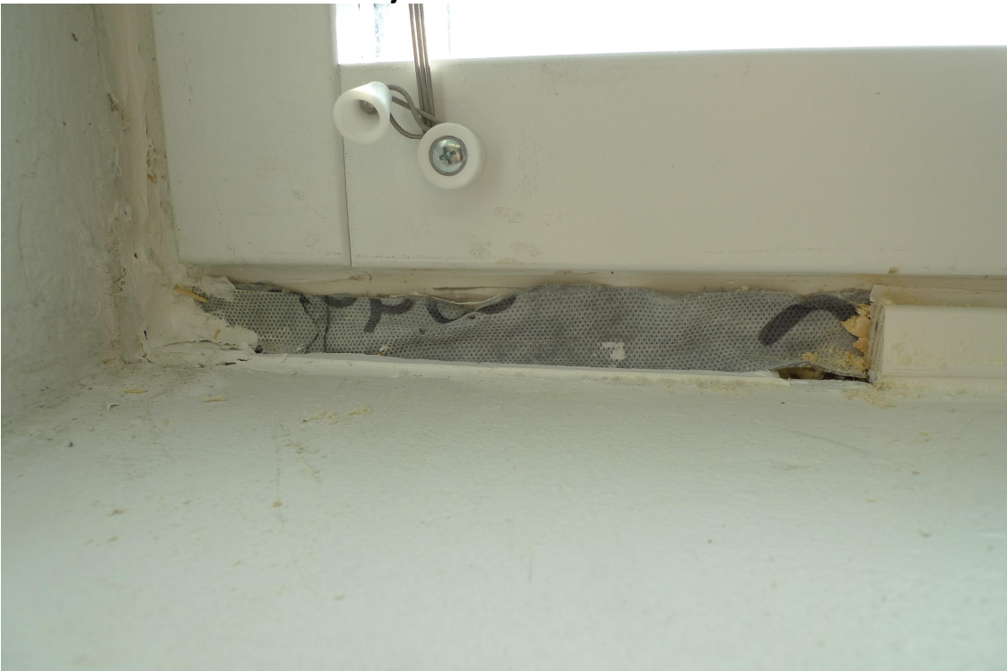
Kuva 22. AVAUS 8. K074. Liittymä oli tiivistetty Codex-nauhalla. Nauha lähti osittain irti listaa irrotettaessa. Nauhassa näkyvät listanauhojen tekemät reiät.
