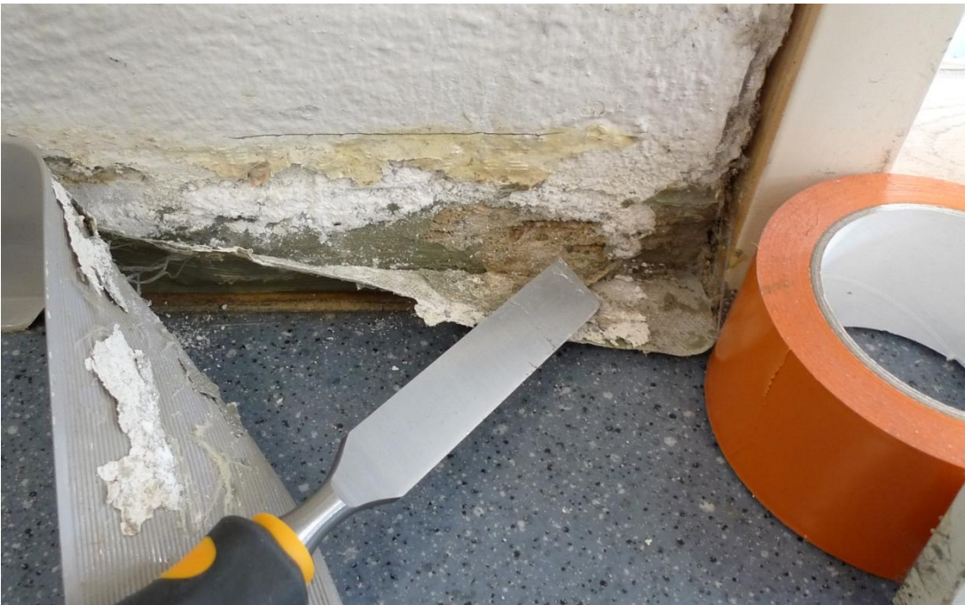
Kuva 18. AVAUS 6. K074. Listan alle oli muodostunut kalkkihärmettä, joka oli osittain syynä tiivistyksen irtoamiseen alustastaan.
