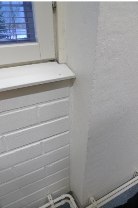
Kuva 12. AVAUS 5. 1060. Ikkunapenkin ja ulkoseinän liittymästä sekä pilarin ja ulkoseinän liittymästä löytyi merkkiainekokeessa merkittäviä ilmavuotoja.
