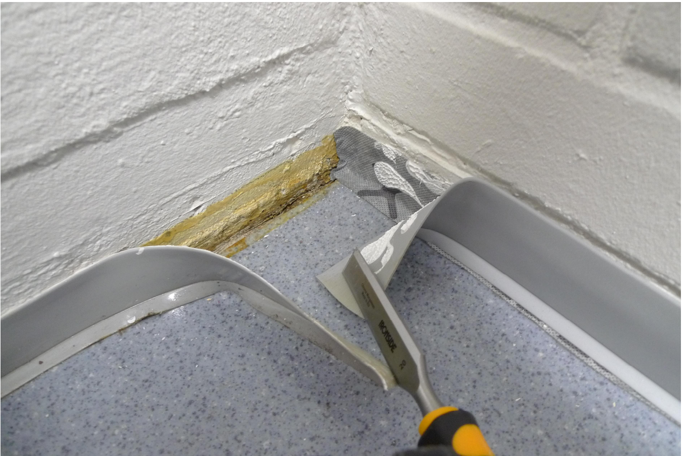
Kuva 8. AVAUS 3. 1004. Kauden ulkoseinän liittymässä Codex-nauha oli liimattu suoraan tiilipinnalle samoin kuin aiemmassa pilarin ja ulkoseinän liittymässä. Nauhaa ei ollut ulotettu toiselle ulkoseinälle.
