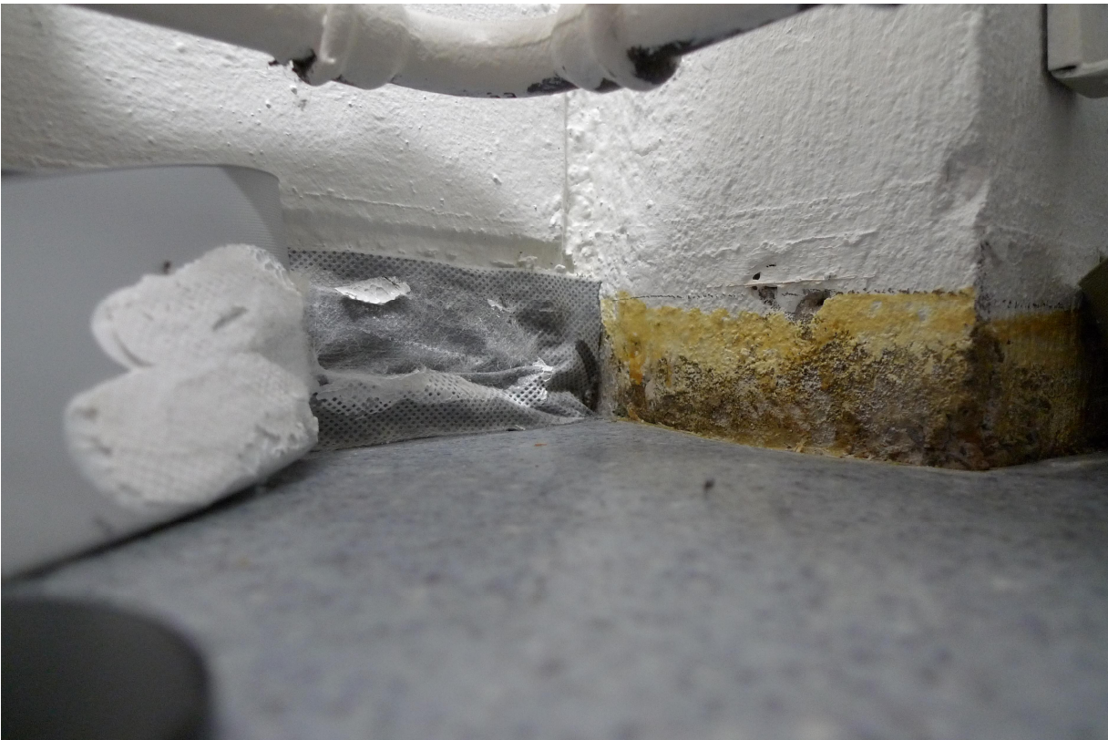
Kuva 5. AVAUS 2. 1004. Pilarin liittymä oli tiivistetty suoraan betoni- ja tiilipinnoille liimatulla Codex-nauhalla.
