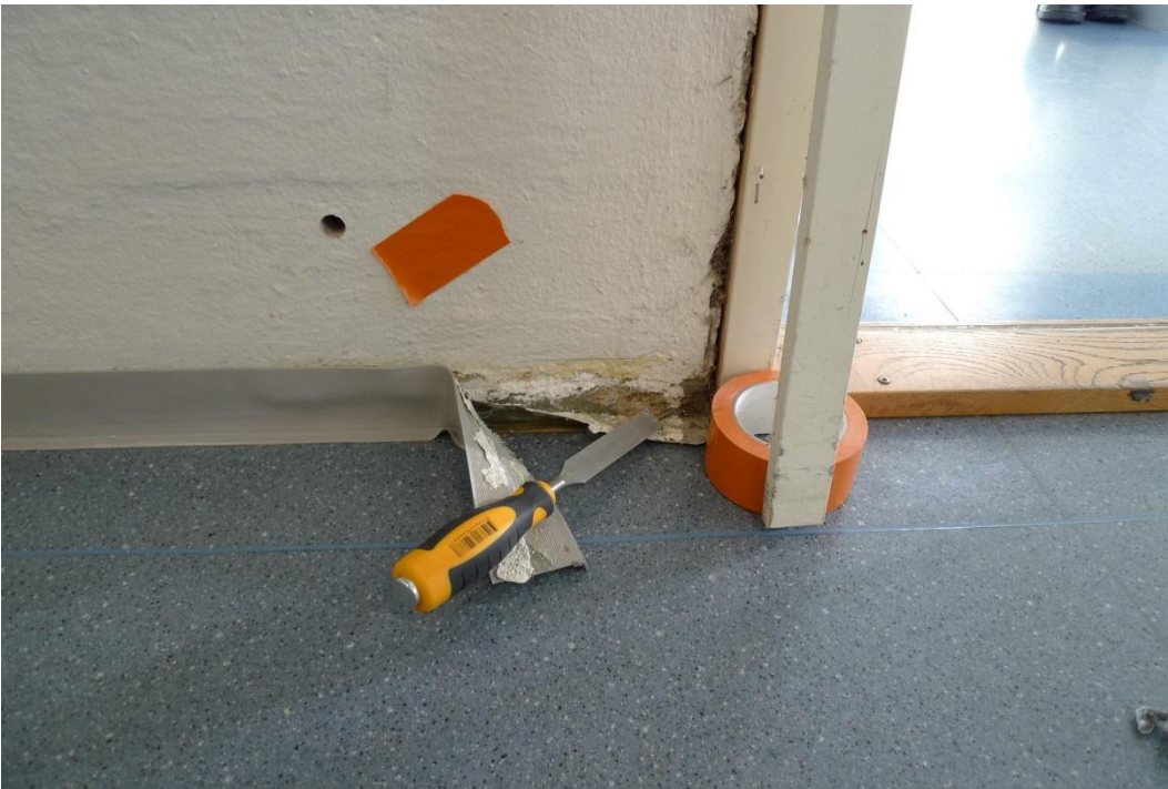
Kuva 17. AVAUS 6. K074. Musiikkiluokan porraskäytävään johtavan oven vieressä oleva seinän ja lattian liittymä oli tiivistetty väristä päätelleen Ardex S 1-K -vedeneristeellä ja Ardex SK 12 -tyyppisellä vahvikenauhalla.
