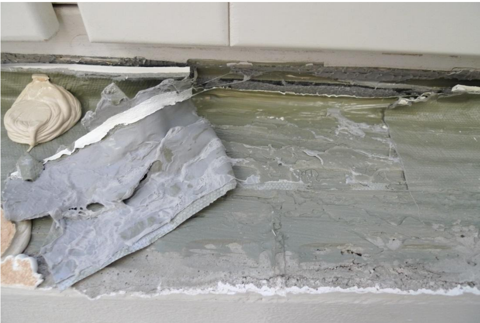
Kuva 14. AVAUS 5. 1060. Butyyliteipin tartunta vedeneristemassaan oli kohtalainen, mutta alusta ei ollut tasainen. Karmin ja ulkoseinän liitoksessa oli harmaa solumuovinauha, jonka yli butyyliteippi oli liimattu. Tartunta karmiin ei ollut kaikilta osin riittävä. Kuvassa näkyy valkoista kittiä, joka ei ollut elastista ja rikkoutui palasiksi ikkunapenkkiä irrotettaessa.
