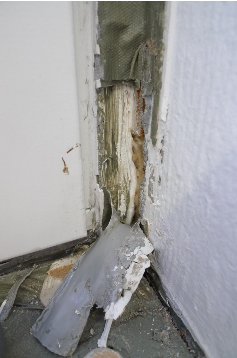
Kuva 16. AVAUS 5. 1060. Pilarin ja ikkunankarmin välinen rako oli tiivistetty kiinnittämällä butyylinauha suoraan elastisen kitin ja mineraalivillan päälle. Tartuntapintaa reunoilla oli vähän.
