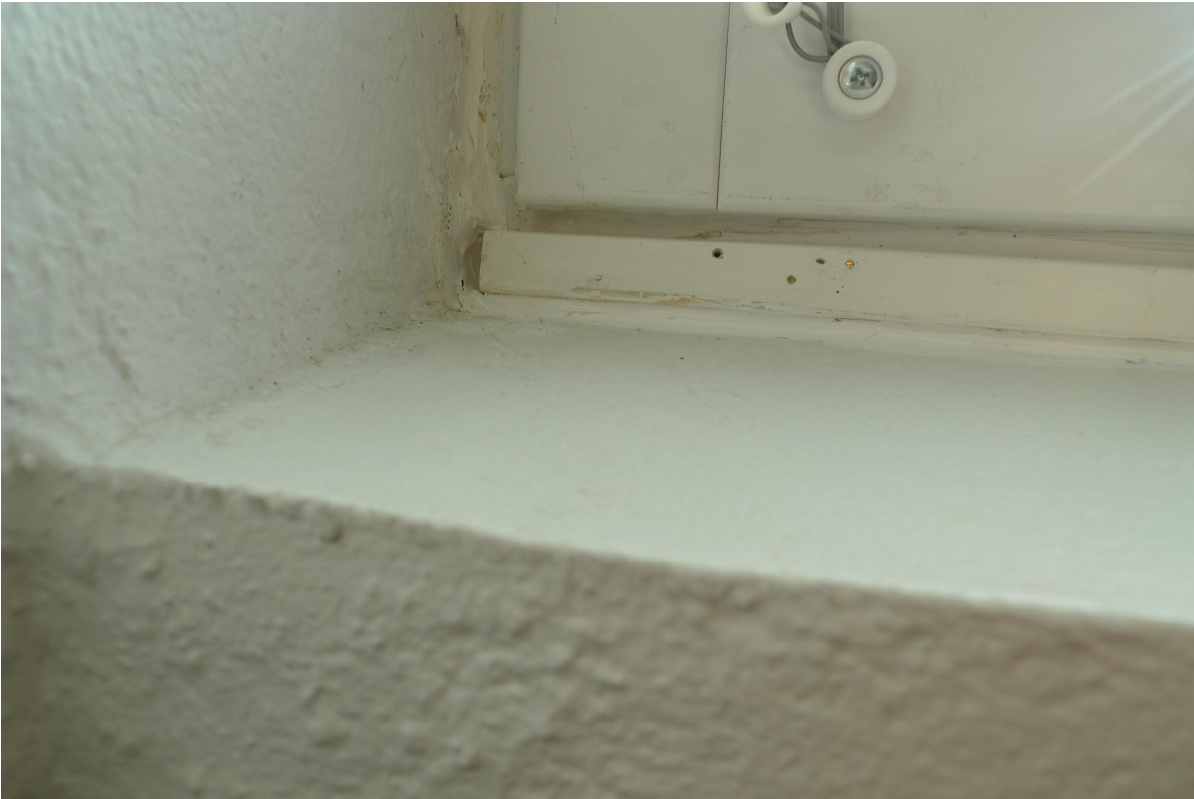
Kuva 21. AVAUS 8. K074. Ikkunan ja ulkoseinän liitoksessa lista oli naulattu kiinni.
