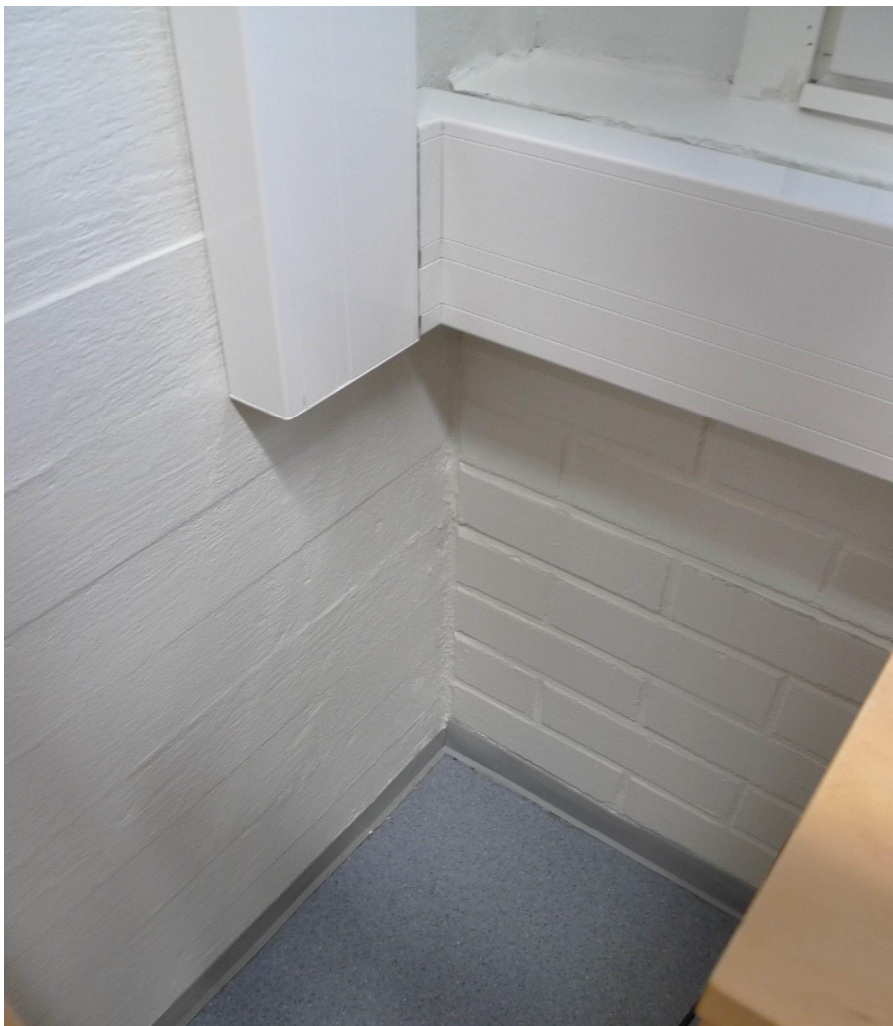
Kuva 7. AVAUS 3. 1004. Kahden ulkoseinän liittymässä ei havaittu merkkiainekokeessa ilmavuotoa.
