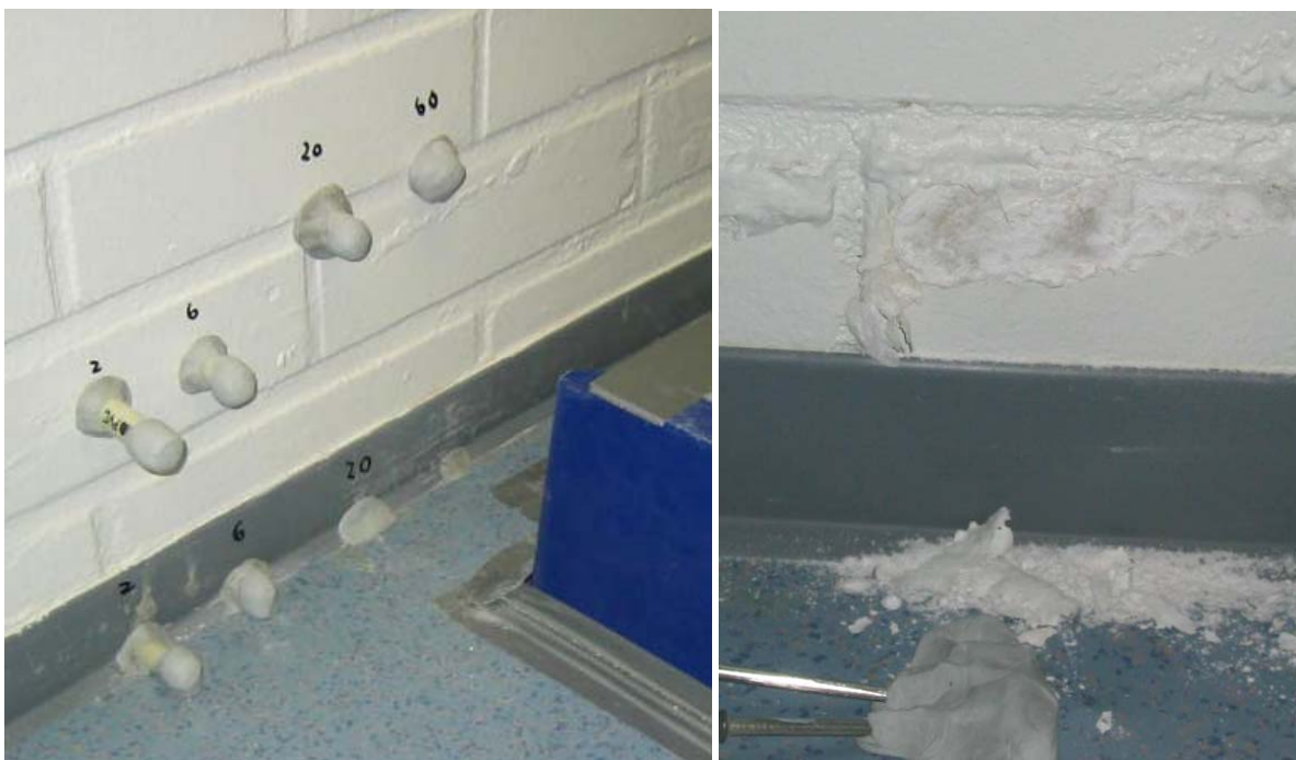
Kuva 6. Vasemmalla seinän alaosa mittapistessä S1 ja oikealla mittapistessä S2. Pisteessä S2 maalipinta on puhjennut, mistä syystä seinän pintakosteusarvot ovat alhaisempia kuin Pisteessä S1, jossa maalipinta on vielä lähes ehjä. Pisteiden S1 edustalla lattian pintakosteusarvot olivat korkeimmillaan.
