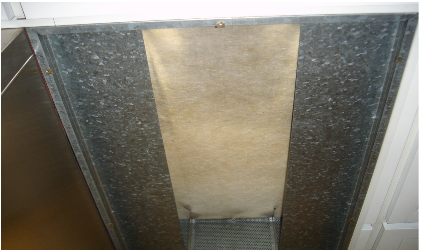
KUVA 19. Yleiskuva keittiön tasauslaatikosta.
