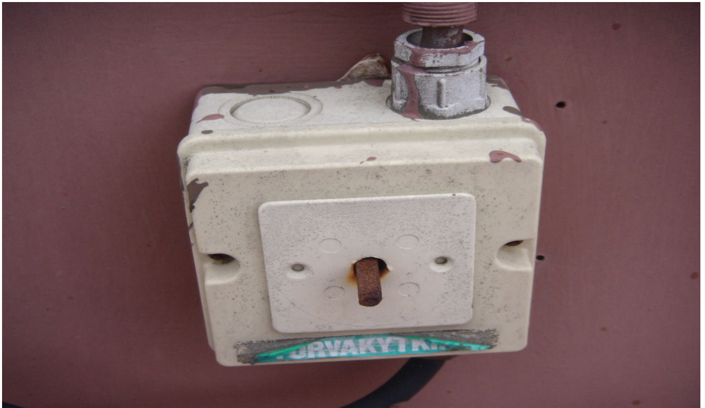
KUVA 10. Yleiskuva huippuimurin 2PP1 turvakytkimestä.
