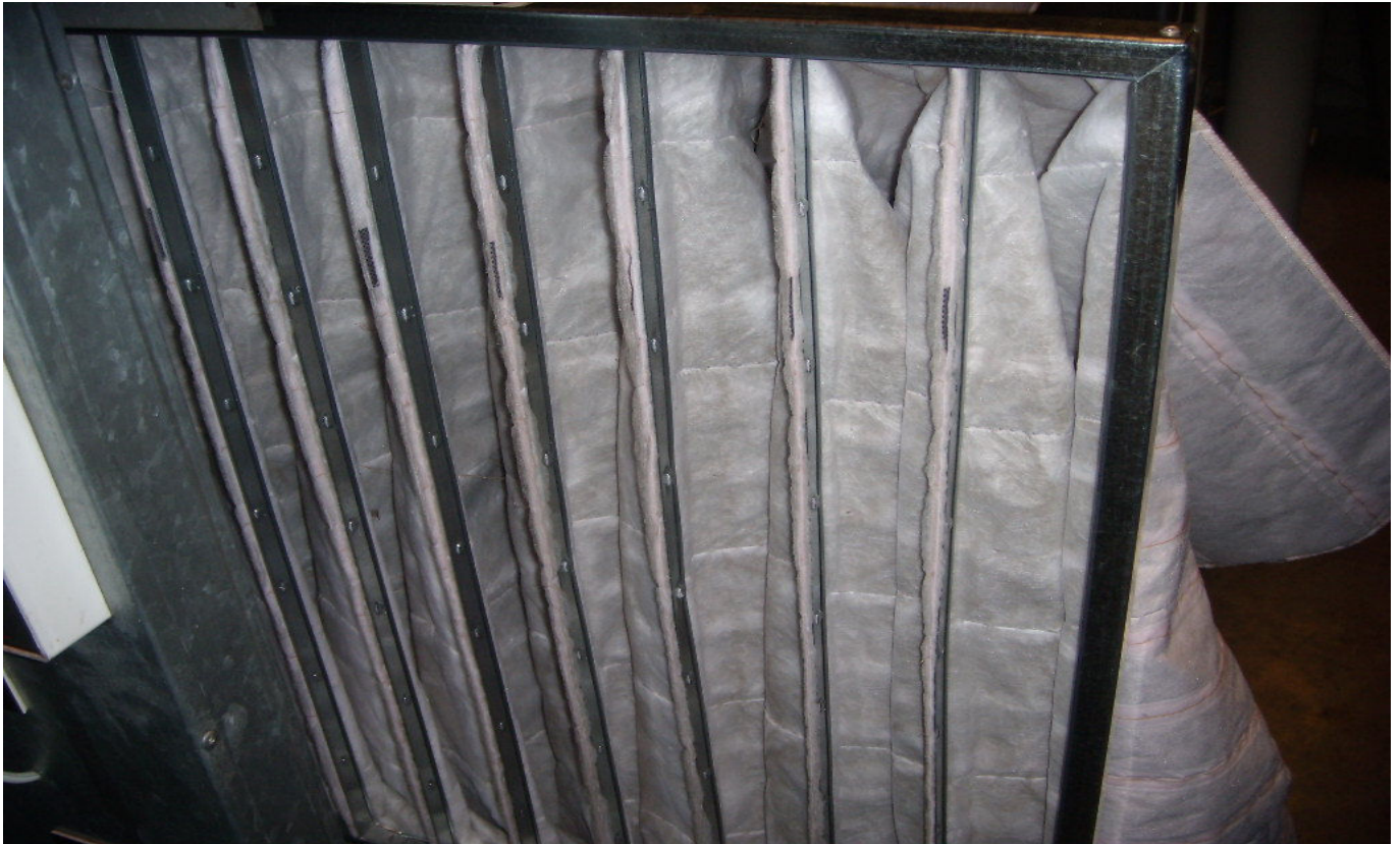
KUVA 2. Yleiskuva tuloilmasuodattimista 1TP1.
