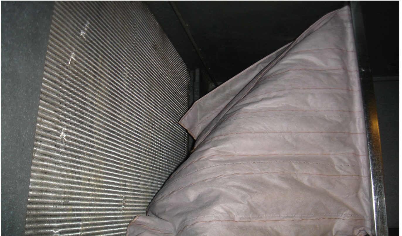
KUVA 12. Yleiskuva tuloilmasuodattimista 3TP1.
