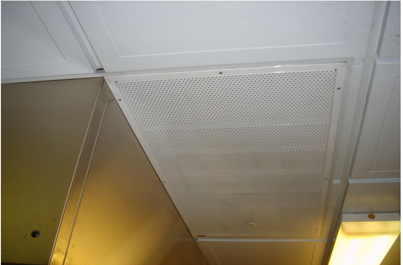
KUVA 18. Yleiskuva keittiön tuloilmaelimestä.
