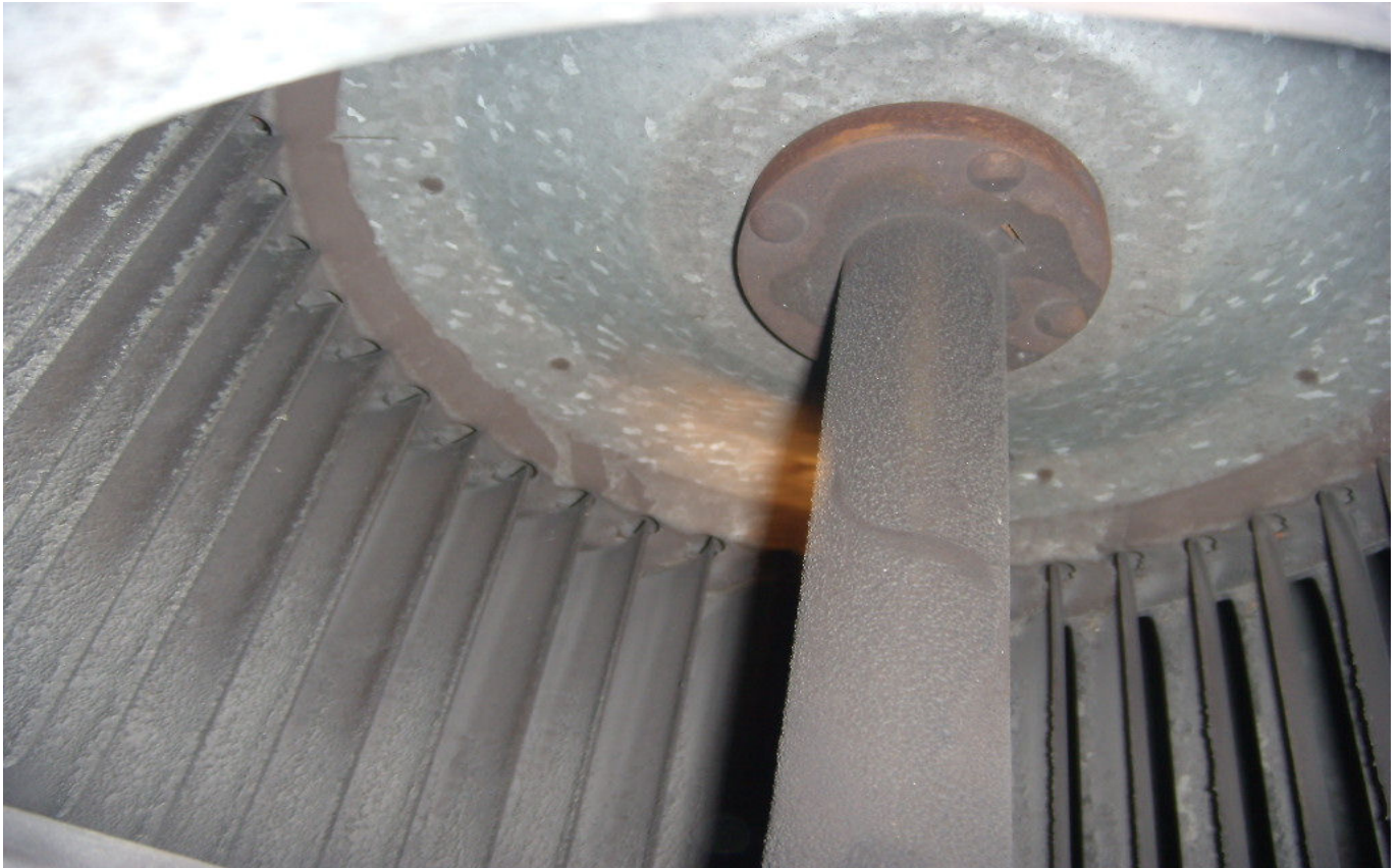
KUVA 6. Yleiskuva poistoilmapuhaltimesta 1PP1.
