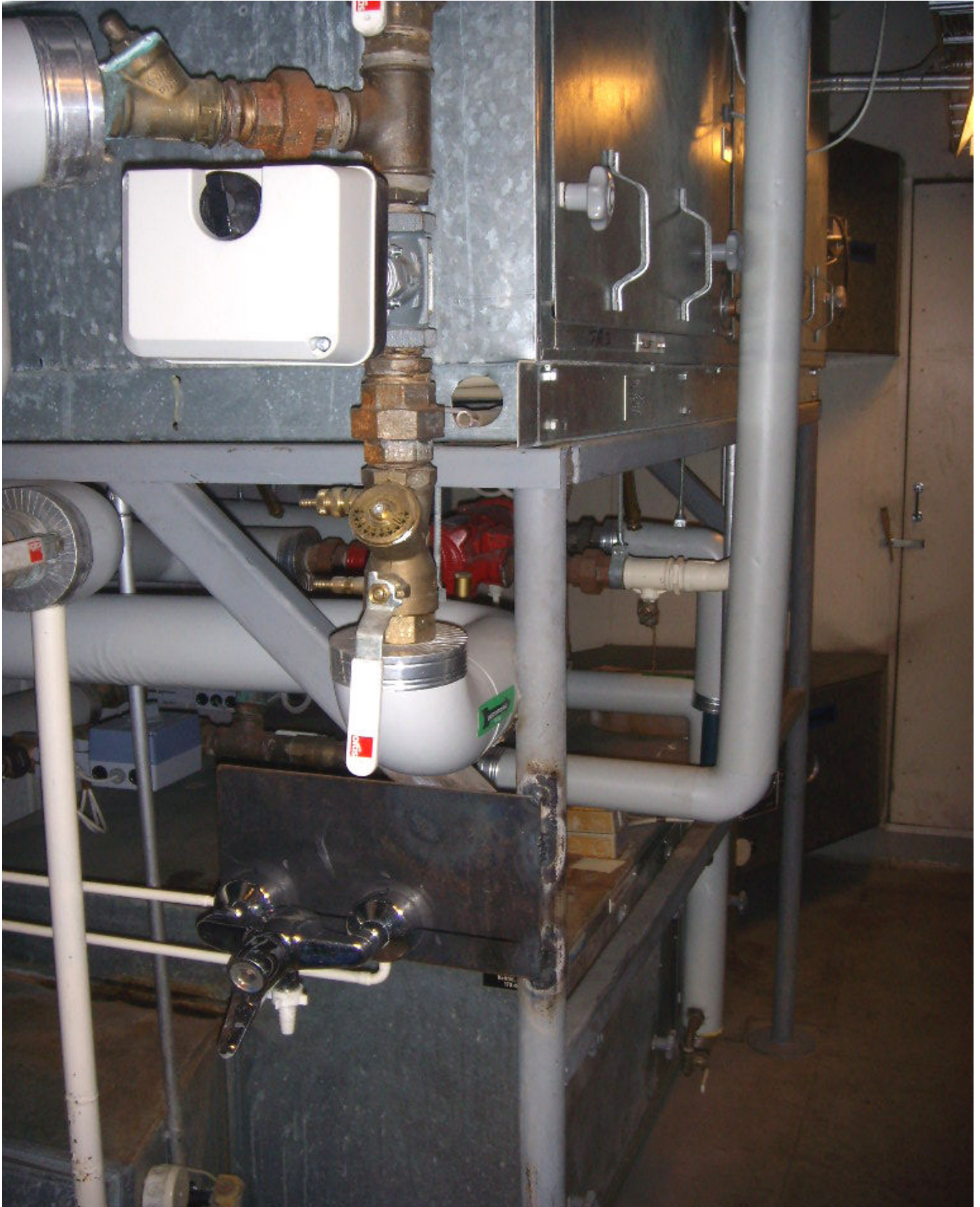
KUVA 1. Yleiskuva IV- konehuoneesta.
