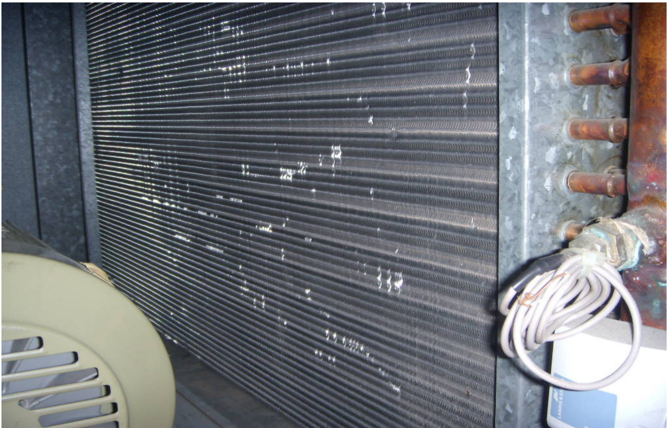
KUVA 9. Yleiskuva lämpöpatterista 2TP1.
