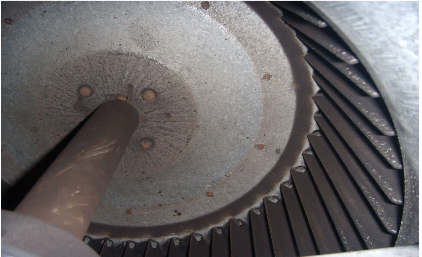
KUVA 4. Yleiskuva tuloilmapuhaltimesta 1TP1.
