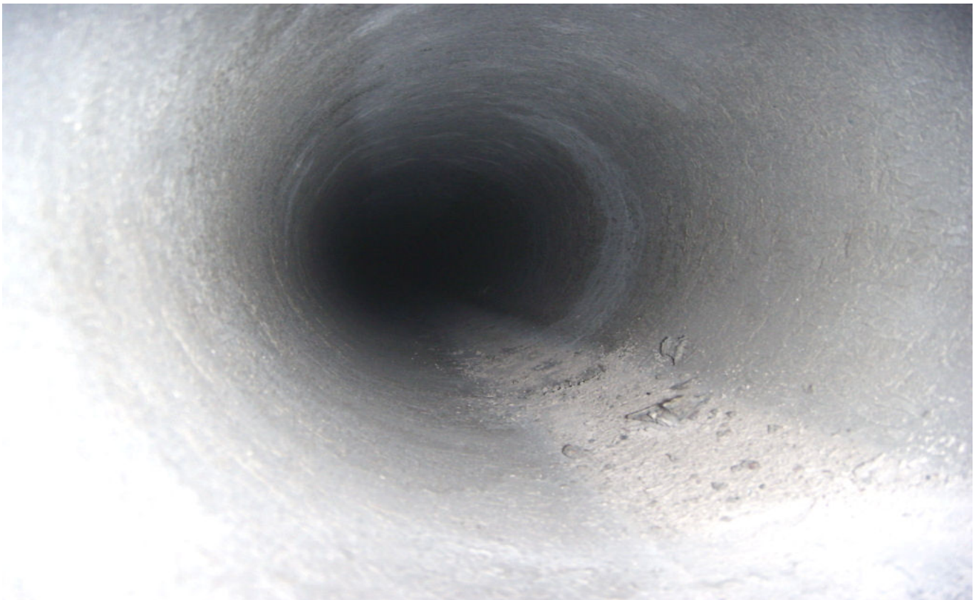
KUVA 17. Onteloissa on melko paljon hienojakoista betonipölyä.
