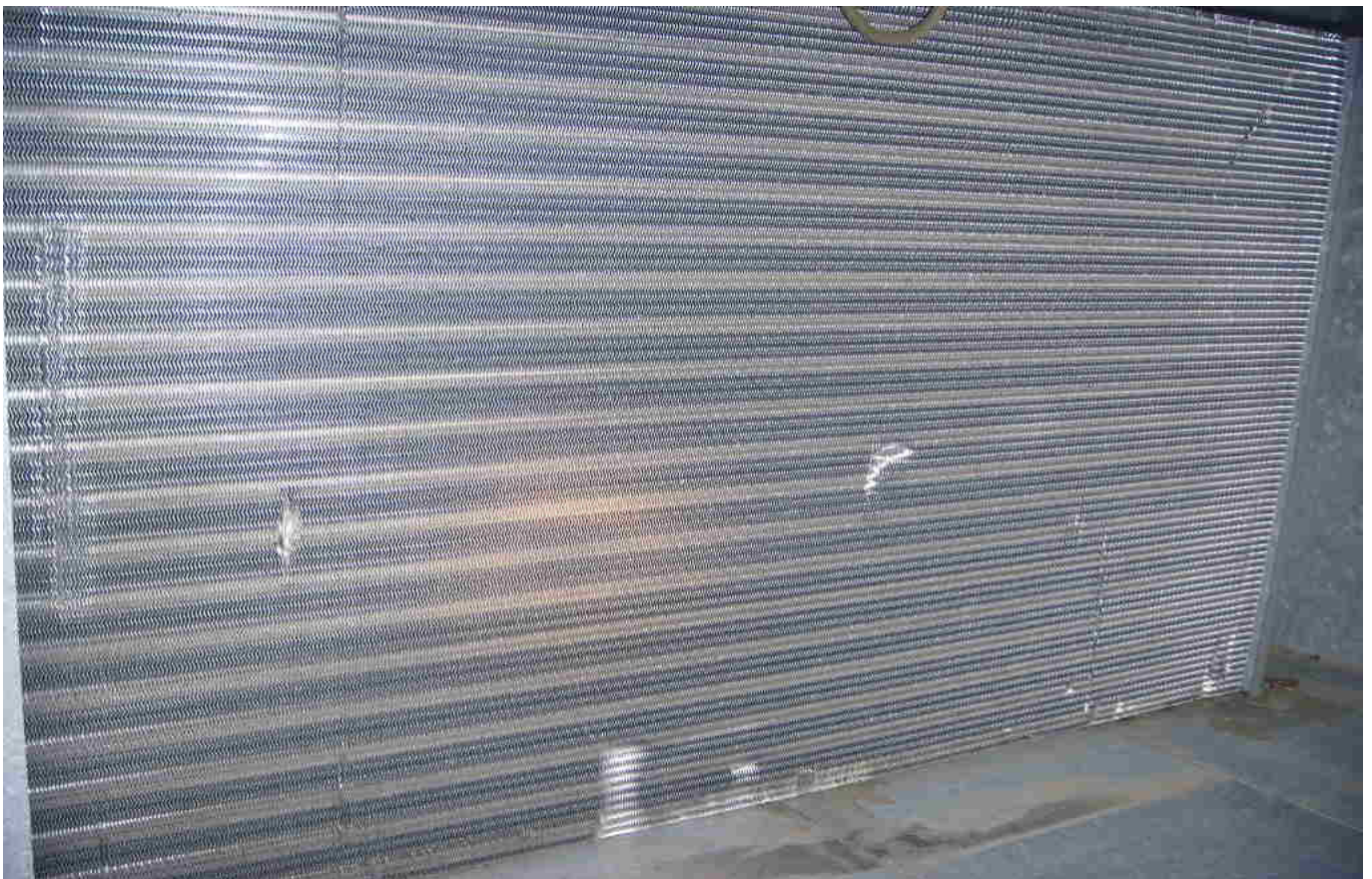
KUVA 3. Yleiskuva lämpöpatterista 1TP1.
