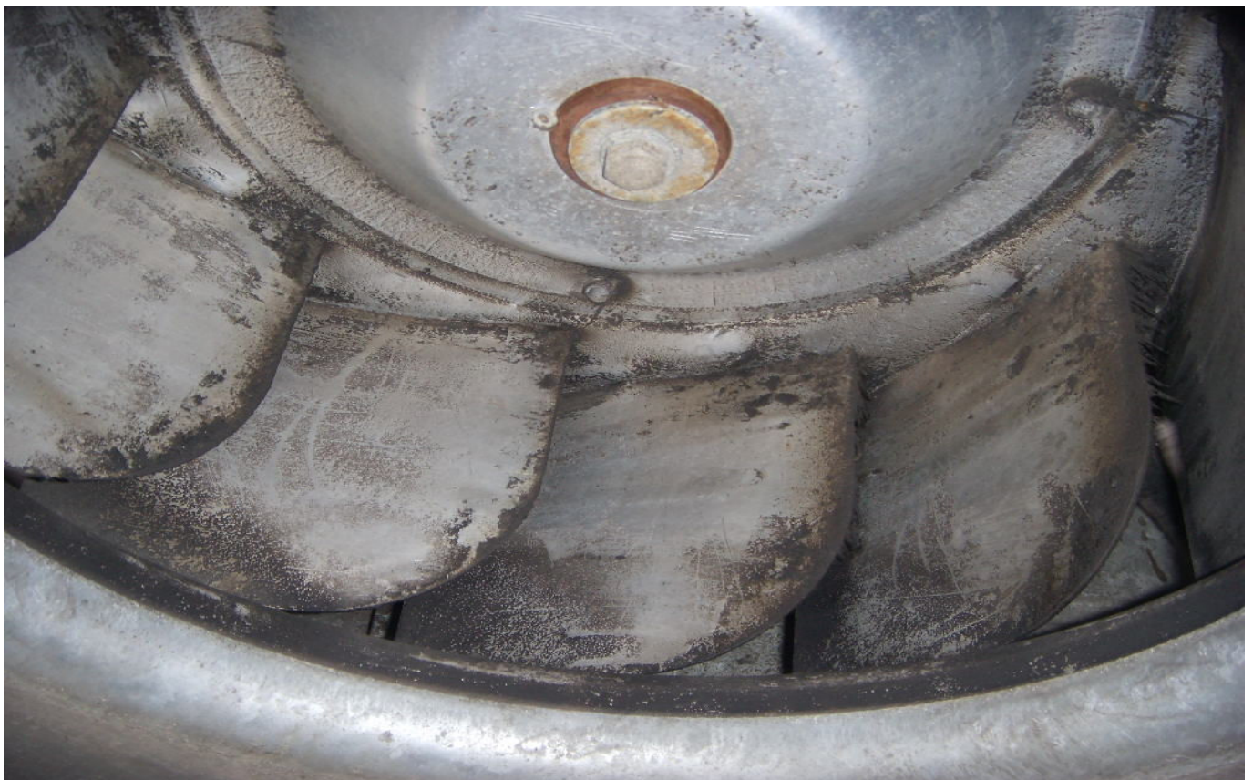
KUVA 11. Huippuimuri 2PP1 on hieman pölyinen.
