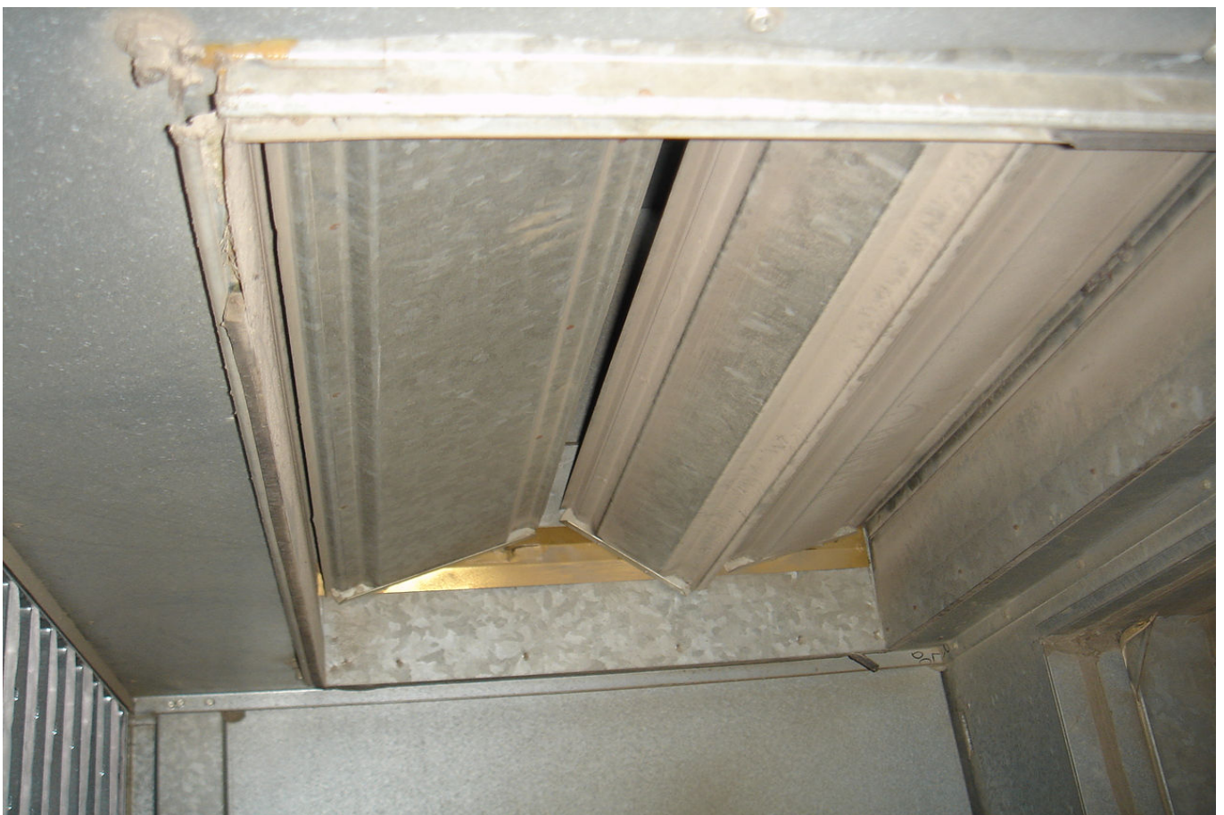
KUVA 13. Yleiskuva tuloilmakoneen kiertoilmapelistä 3TP1.
