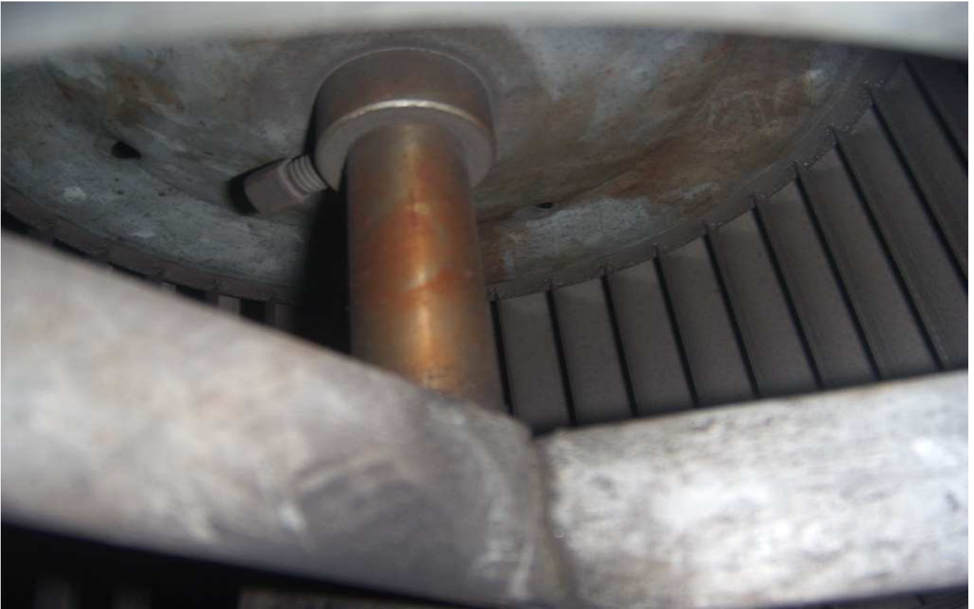
KUVA 12. Yleiskuva tuloilmapuhaltimesta TK 1.
