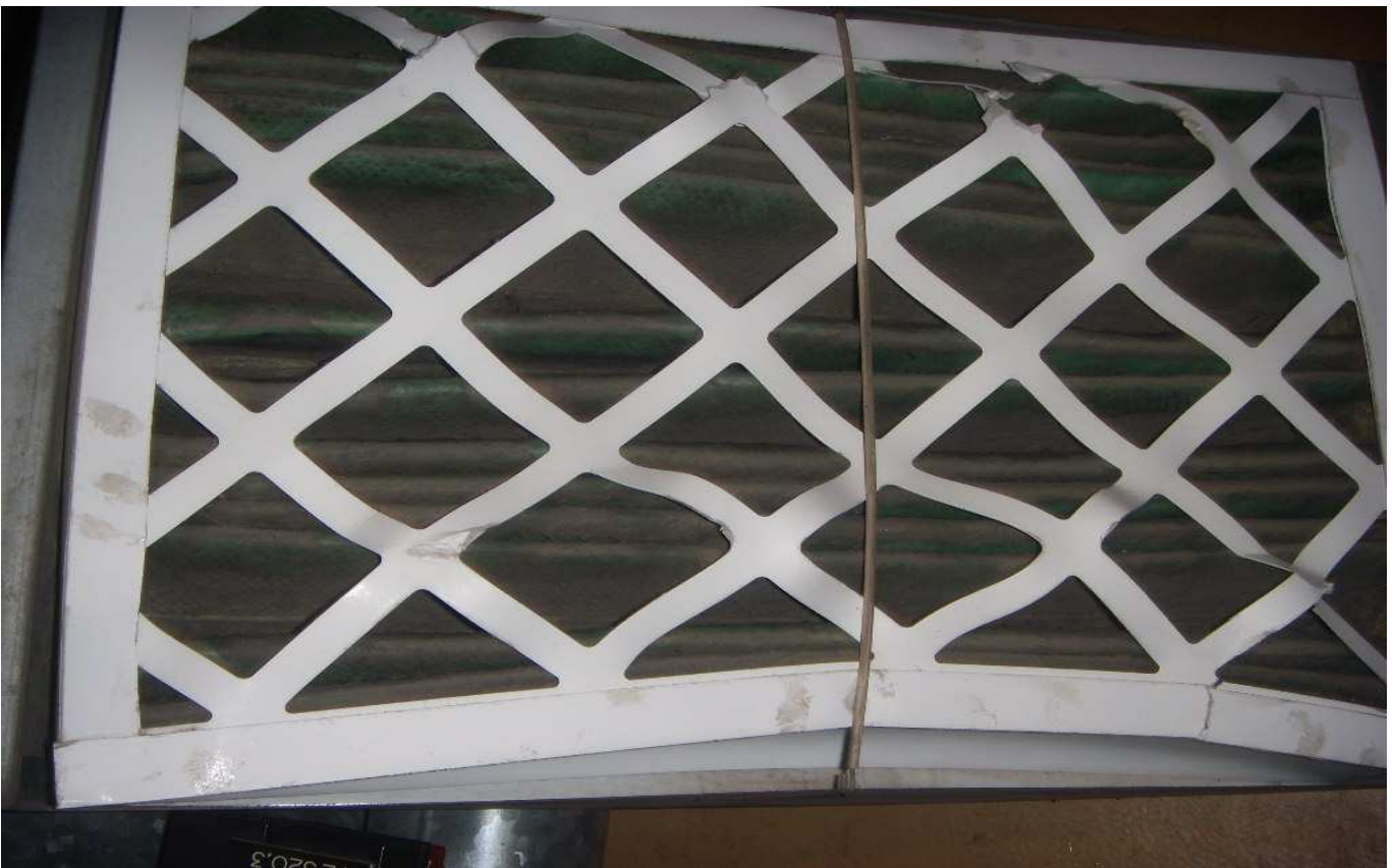
KUVA 2. Yleiskuva tuloilmasuodattimesta TK 2.
