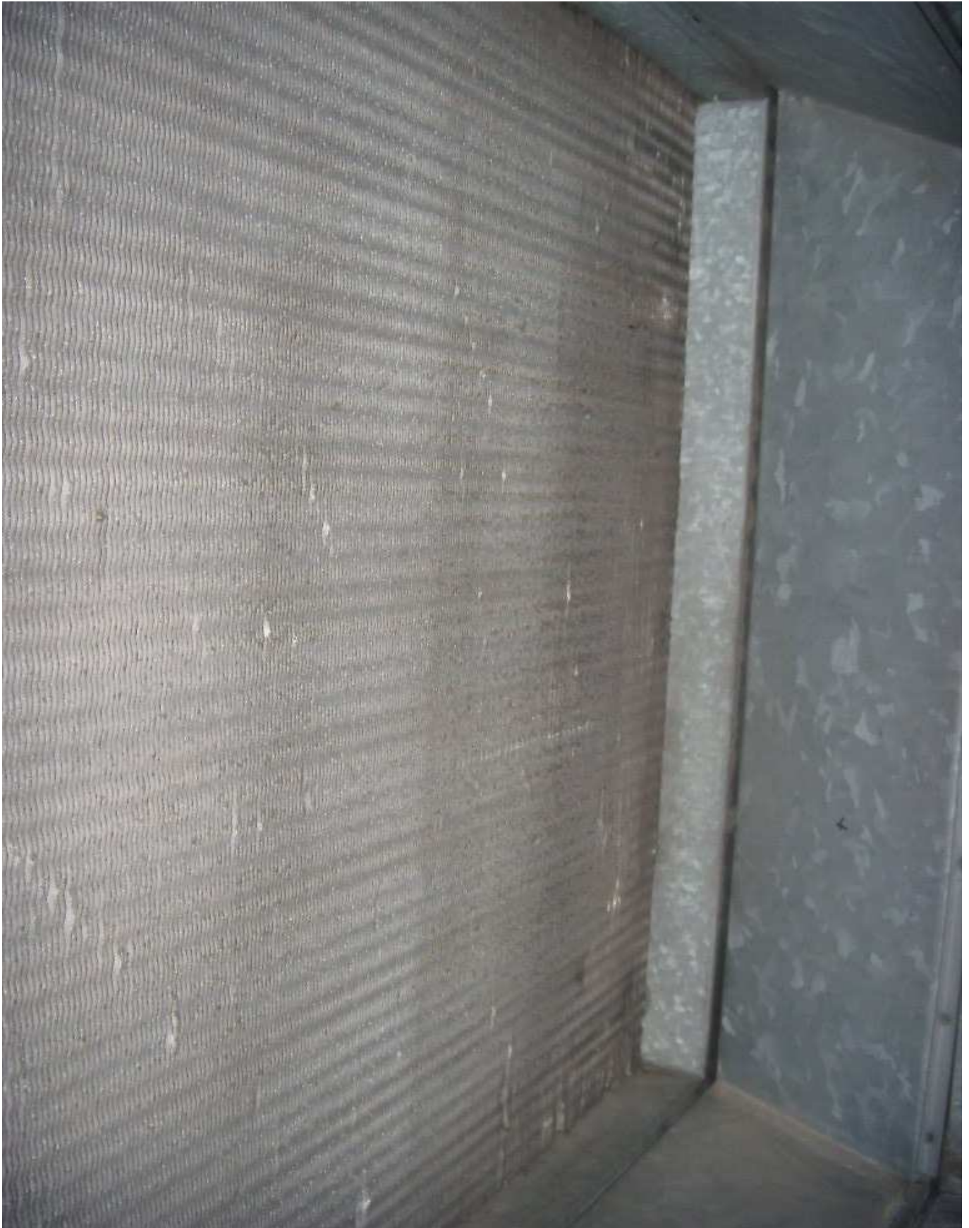
KUVA 3. LTO- ja lämpöpatterit ovat pölyiset ja nokiset.
