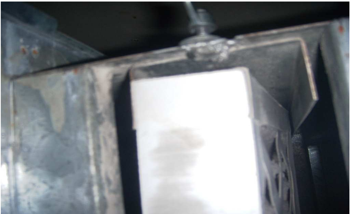
KUVA 7. Yleiskuva suodatinkehikosta PK 2.
