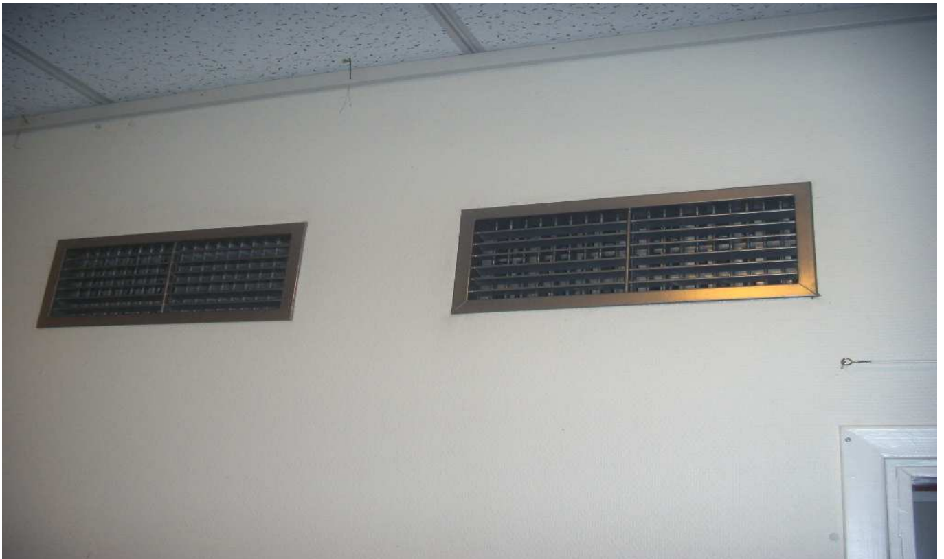
KUVA 19. Yleiskuva tuloilman päätte-elimistä.
