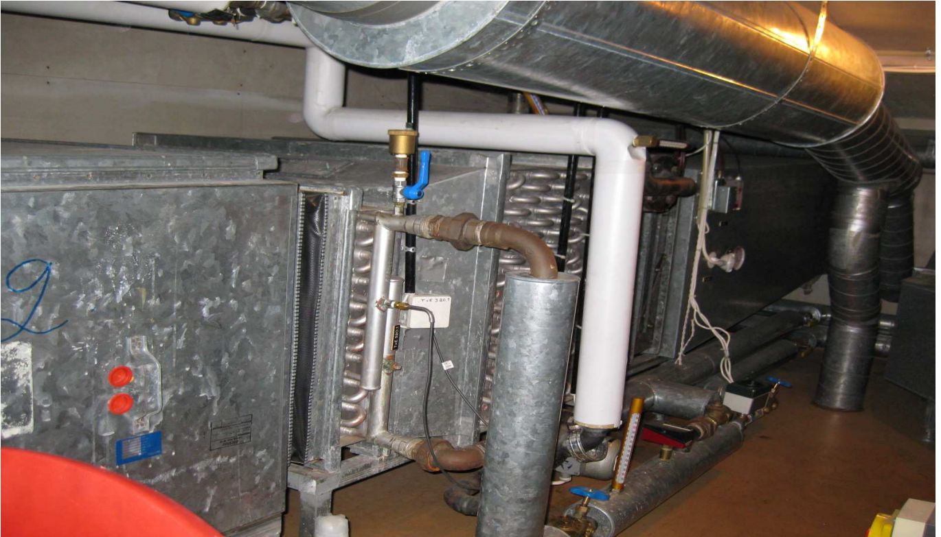
KUVA 1. Yleiskuva IV- konehuoneesta.
