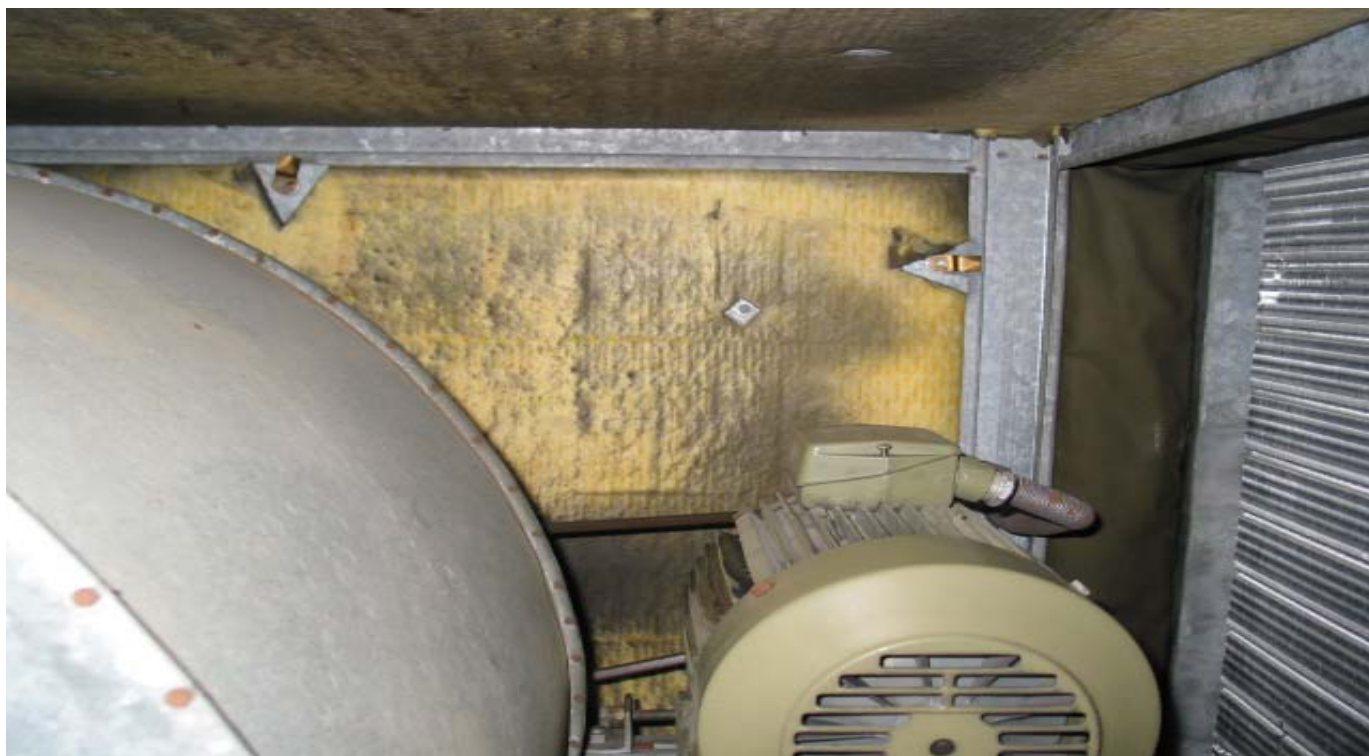
KUVA 2. Ilmastointikone on villapintainen.
