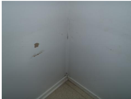
KUVA1: Lisärakennuksen nurkissa levytyksissä havaittiin halkeilua.
