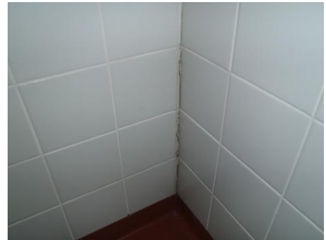
KUVA2: Lisärakennuksen vesileikkiktilan ulko- ja väliseinän liittymäkohdassa halkeilua.
