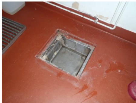
KUVA3: Siivousshuoneen lattiakaivon tiivistys puutteellinen.
