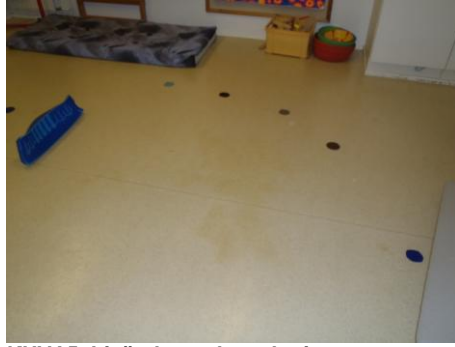
KUVA5. Lisärakennuksen lattiamatossa tummia laikkuja.
