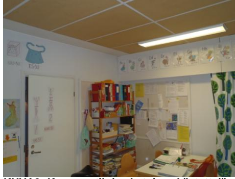
KUVA6: Kuvassa tilojen katoissa käytettyjä akustiikkalevyjä.
