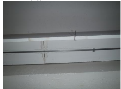
KUVA4: Päärakennuksessa havaittiin vanha vesivuotojälki.
