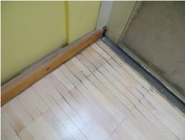
kuva 5 Voimistelusalin lattiassa on kosteusvauriojälkiä salin varapoistumisoven edustalla.
