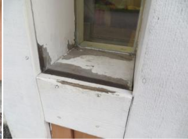
kuva 12 Kosteusvaurioita, koska ei ole vesipeltiä.
