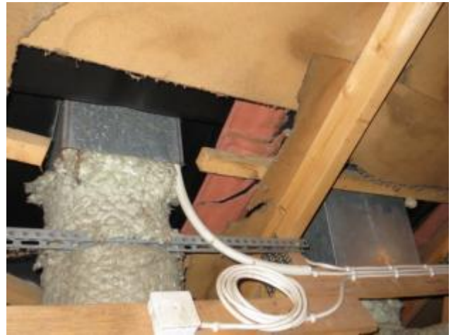
kuva 20 Aluskatetta ei ole IV-läpiviennissä.
