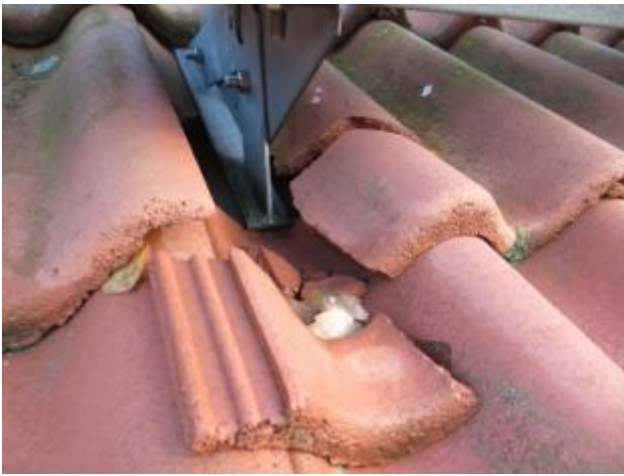
kuva 21 Vesi pääsi suoraan aluskatteelle.
