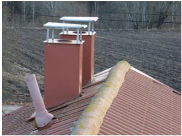
kuva 22 Tuuletusviemärin kallistuma, josta pääsi vettä.
