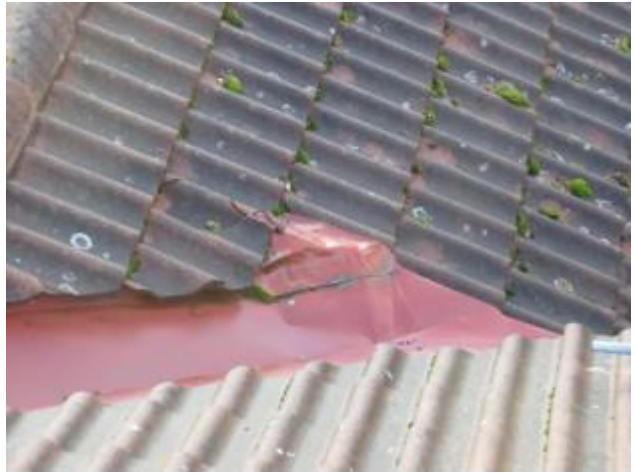
kuva 18 Tiili rikki katoksen jirissä
