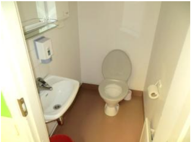
kuva 8 WC:n muovimatossa on juurinosto seinälle.
