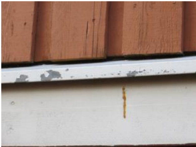
kuva 9 Ulkoverhous halkeilee vesirasituksessa.
