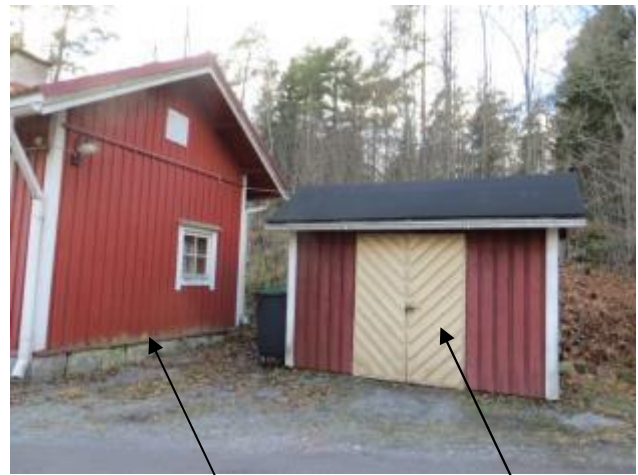
kuva 30 Lahoja lautoja pohjoispäädyssä, jätekatos.
