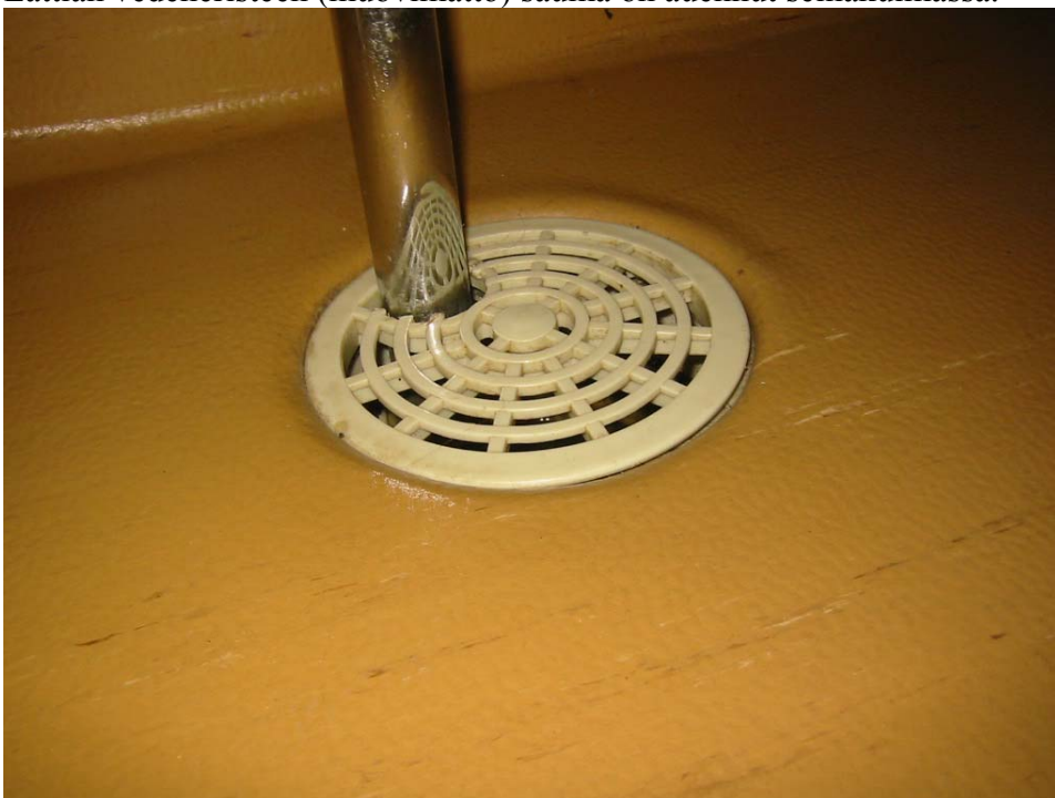
Kuva 6. Kaivon vierellä on muovimatto irronnut alustastaan (on melko yleistä ja johtuu yleensä puutteellisesta kaivon asennuksesta mattotyön yhteydessä).
