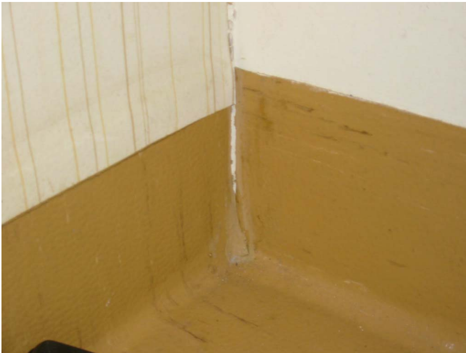
Kuva 5. Lattian vedeneristeen (muovimatto) sauma on auennut seinäkulmassa.
