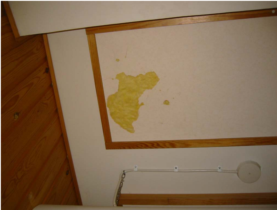
Kuva 1. Huonetilassa 04 on kattopinnan yksi akustovillalevy rikkoutunut.
