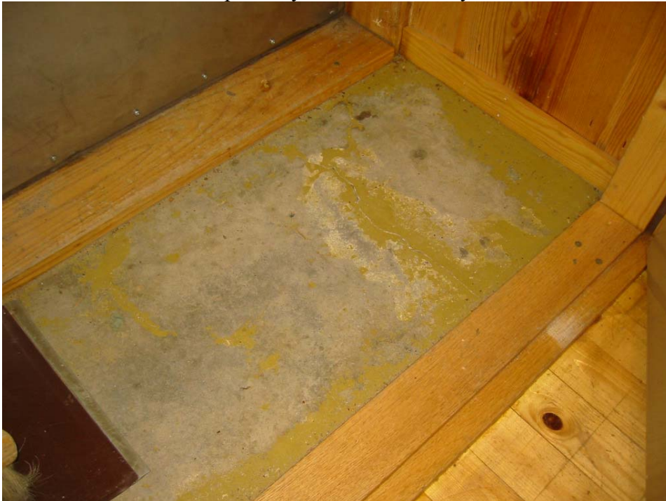
Kuva 2. Huonetilan 04 ulko-ovien välitilan lattia on maalattua betonia. Betonissa on halkeamia ja lohkeamia, jotka on syytä korjata ja lattia pinnoittaa uudelleen.
