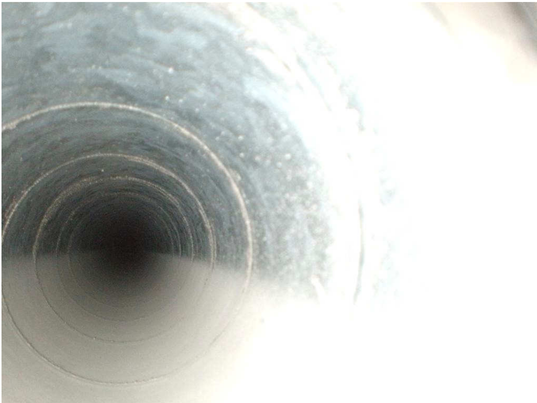
KUVA 5. Poistoilmakanavissa on hieman pölykertymää.
