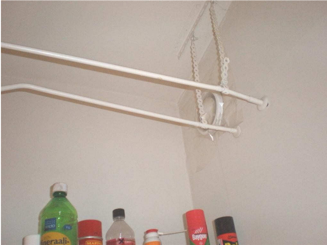
KUVA 4. Sosiaalitalan no:15 wc:n poistoilmaventtiili on teipattu umpeen.
