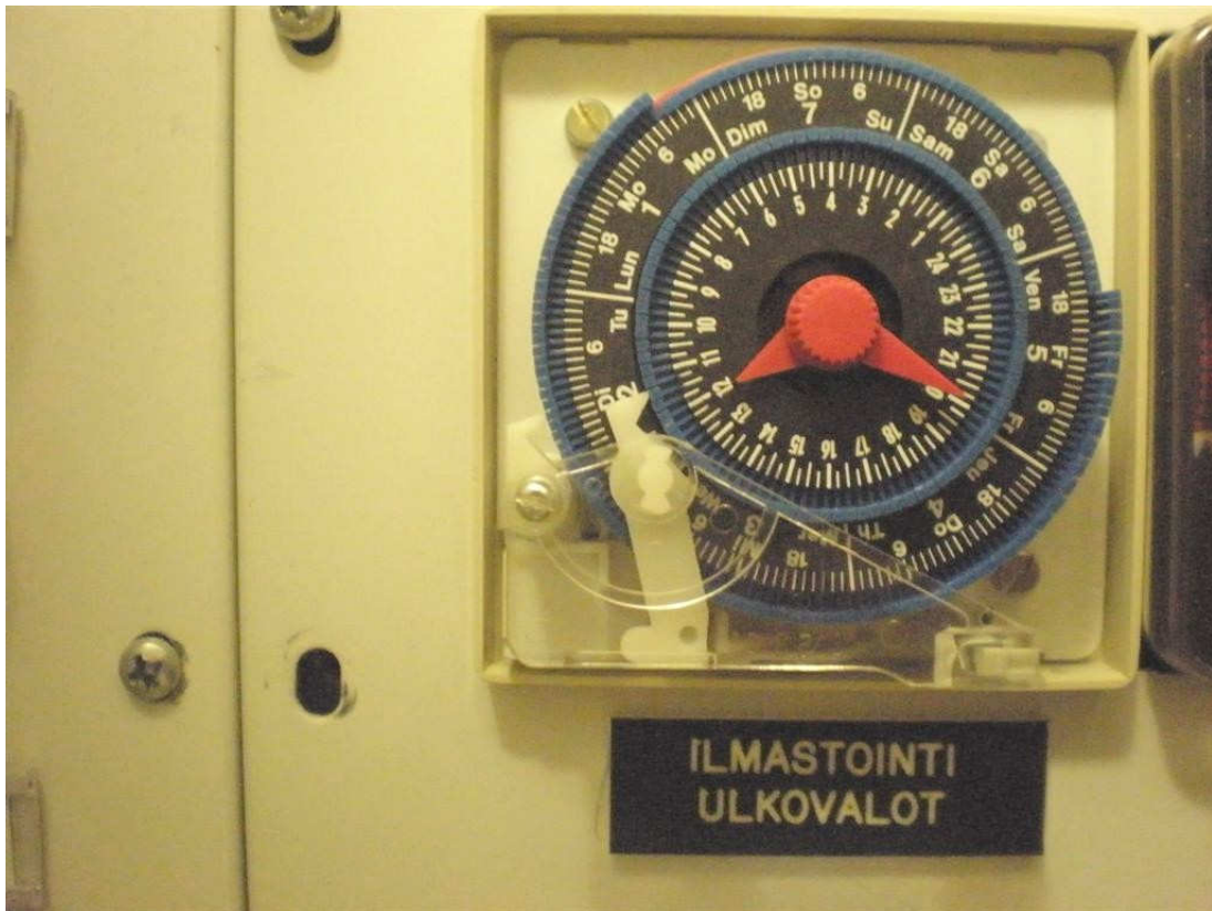
KUVA 2. Huippuimurin kello-ohjaus joka ohittaa käyttökytkimet ja on säädetty sammuttamaan huippuimuri viikonlopuiksi kokonaan pois päältä.
