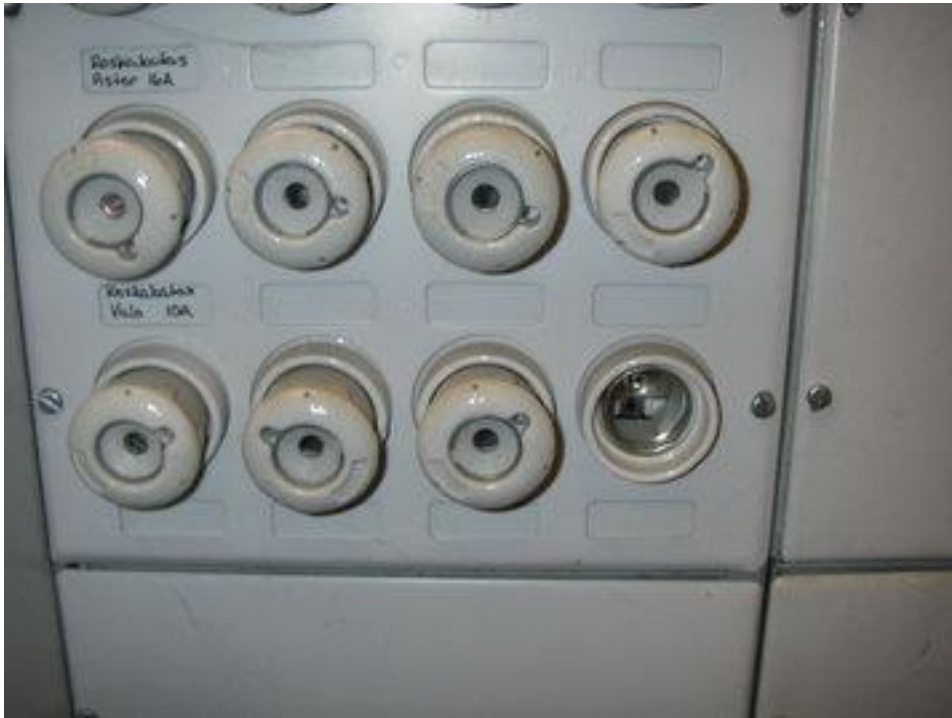
Nousukeskuksesta puuttuu sulakekansi.
