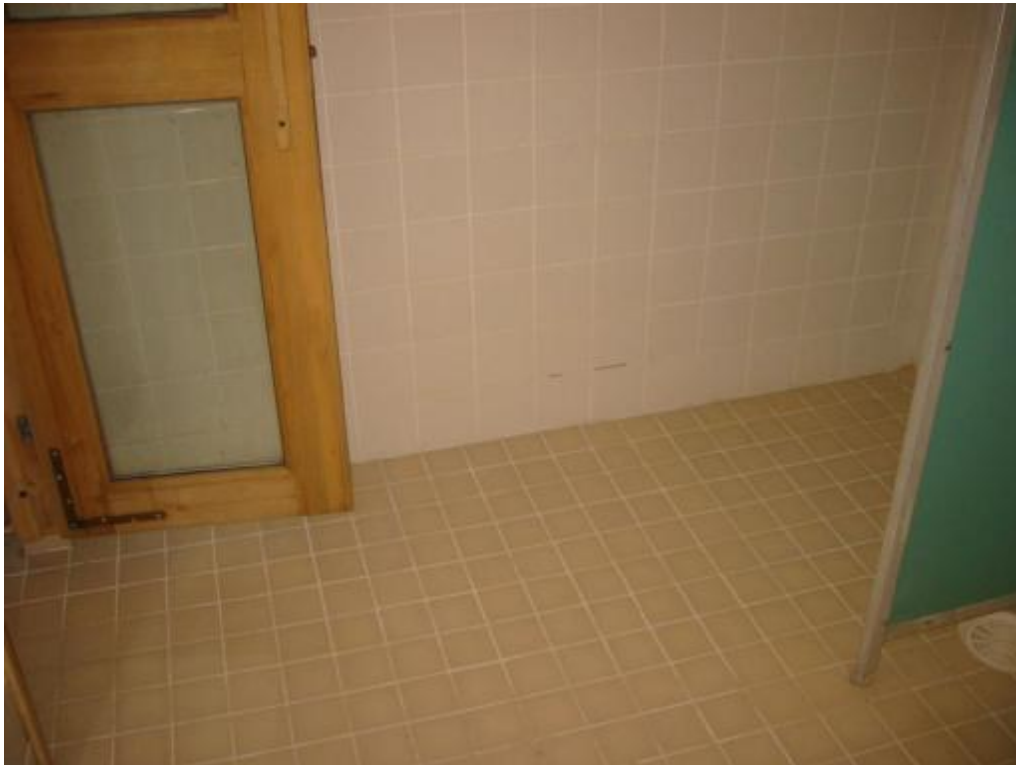
Saunaosaston pesuhuoneen rakenteet ovat ikääntyneitä ja mm. seinälaattojen saumoja on auki.
