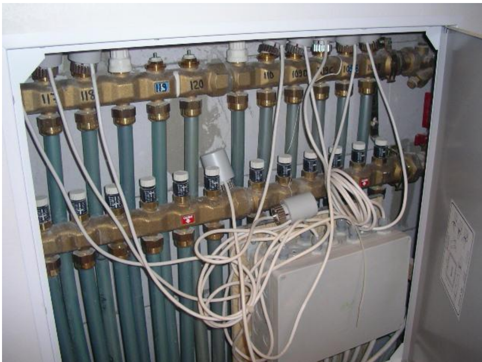
Laajennusosan lattialämmityksen jakotukkiventtiilien säätöosat olivat irrallaan ja mitatut sisälämpötilat olivat epätasaisia. Koko rakennuksen lämmitys tulee ottaa tarkasteluun vanhan osan patteriverkosta säädettyä.
