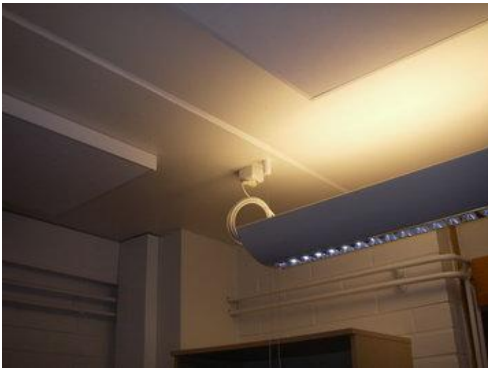
Uusittua valaistusta pohjoispuolen toimiston tiloissa.
