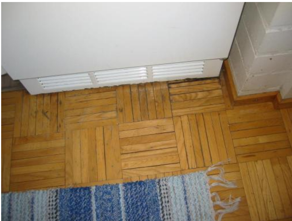
Lattiaparketissa on kosteusvauriojälkiä jääkaapin kohdalla.
