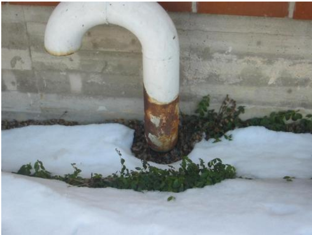
Sokkelin vieressä oleva teräsputki on ruostunut maanrajassa.
