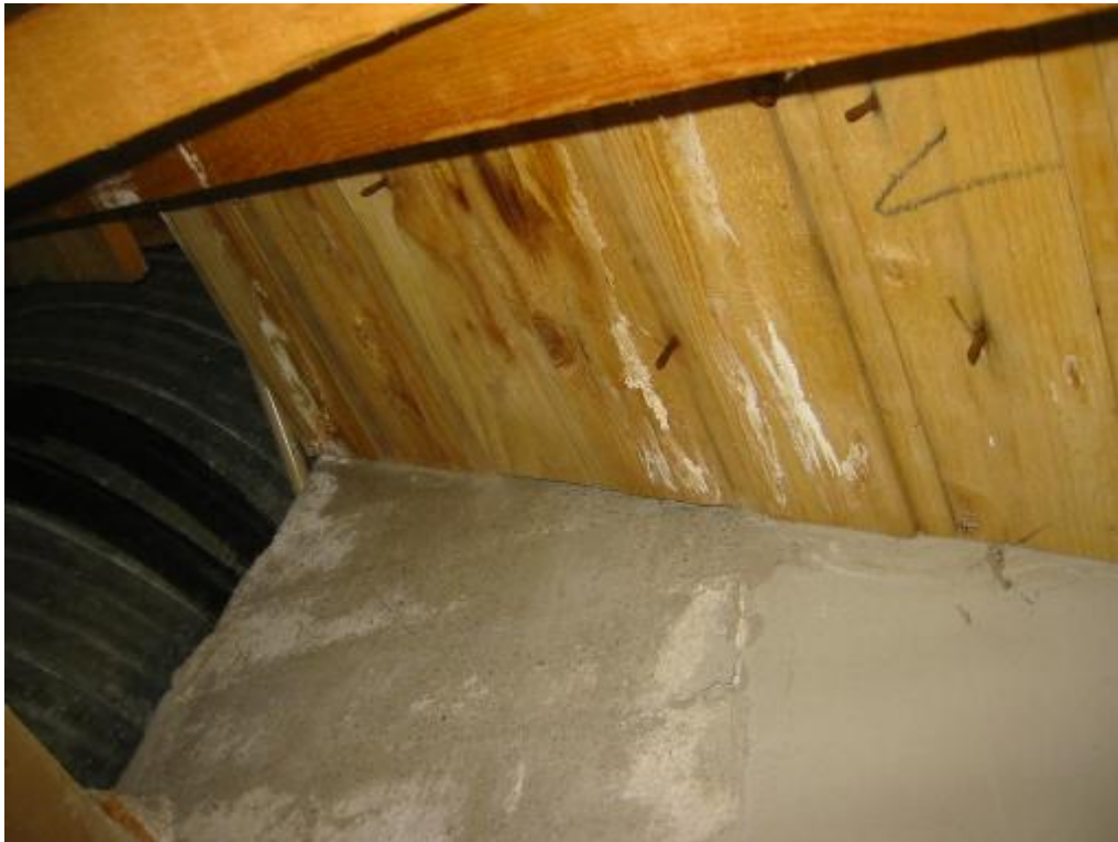
Savupiipun kohdalla on kattovuotoihin viittaavia kosteusjälkiä.
