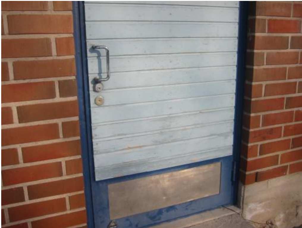
Ulko-oven panelointi hilseilee. Myös ulko-ovien tiivistyksissä ja toimivuudessa esiintyy puutteita.
