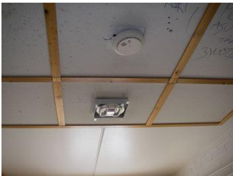
Valaisimen suojakupu puuttuu.
