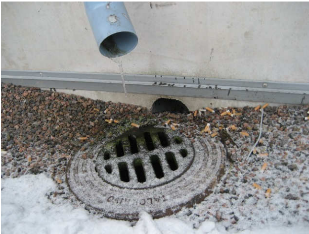
Kuva 7 Tilan 127 kumalla puuttuu alapohjan tuuletusputki ja sadevesi valuu osin reiästä alapohjaan. Sokkelilevy on painunut irti listasta.
