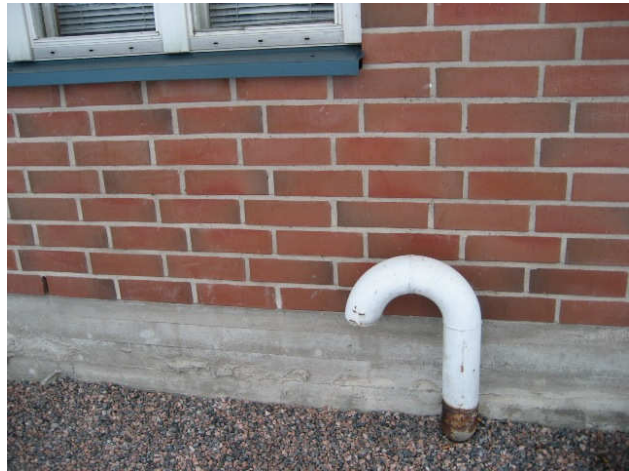
Kuva 8 Alkuperäisen osan tuuletusputket ovat ruosteessa.
