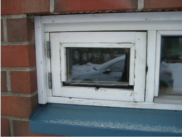
Kuva 13 Alkuperisen osan pellitykset ovat loivia. Ikkunassa on pintavaurioita.
