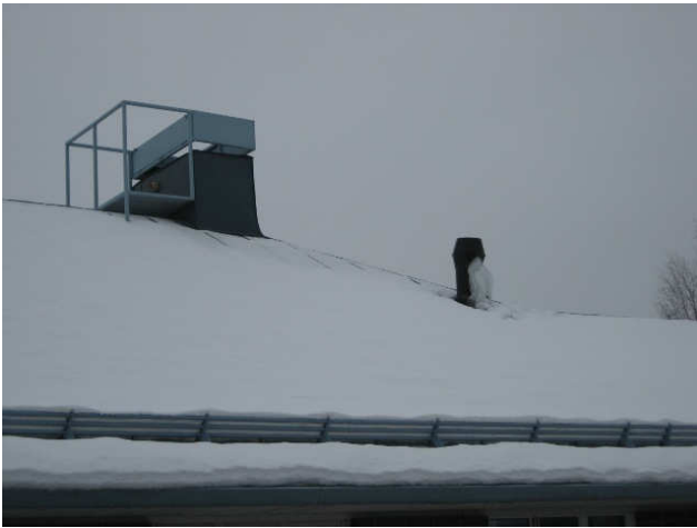
Kuva 15 Alkuperäisen osan alapohjan tuuletuspuhaltimen päähän muodostuu jäätä pakkasilla.
