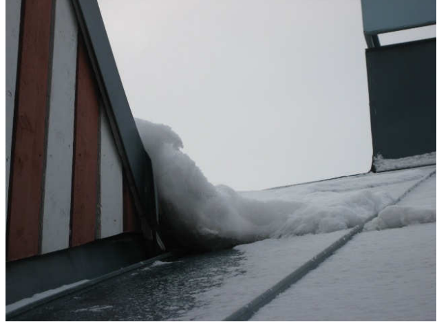
Kuva 20 Tilan 040 yläpuolella on huonoja peltityksiä, jiiritaite ja padottunutta jäätä, joista vuoto voi johtua.
