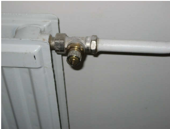
Kuva 25 Jumissa ollut patteritermostaatin mäntä, jonka termostaatti oli poistettu.
