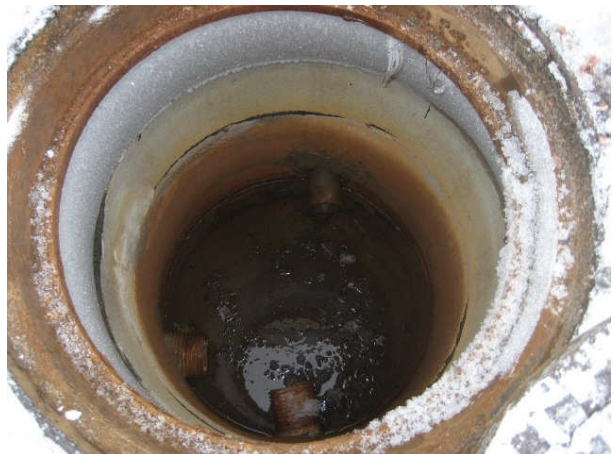
Kuva 6 Tarkastuskaivo oli huurteessa, välikansi puuttuu.
