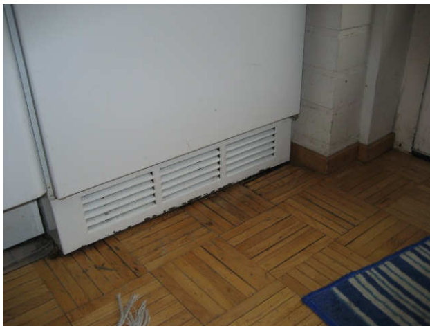
Kuva 23 Ruokailutilan 008 kalusteiden alla on vuotovaurioita.
