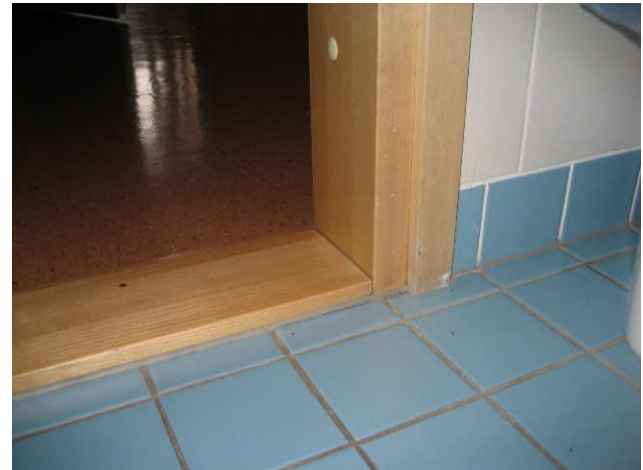
Kuva 22 Laajennusosan wc-suihkutilojen kynnykset eivät täytä RakMk C2 määräyksiä.
