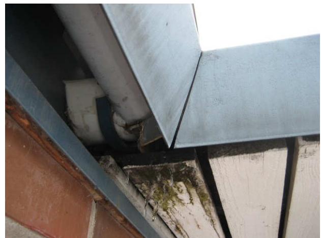
Kuva 4 Selvä vuotokohta kourun liitoksessa, joka on aiheuttanut lahovaurion.
