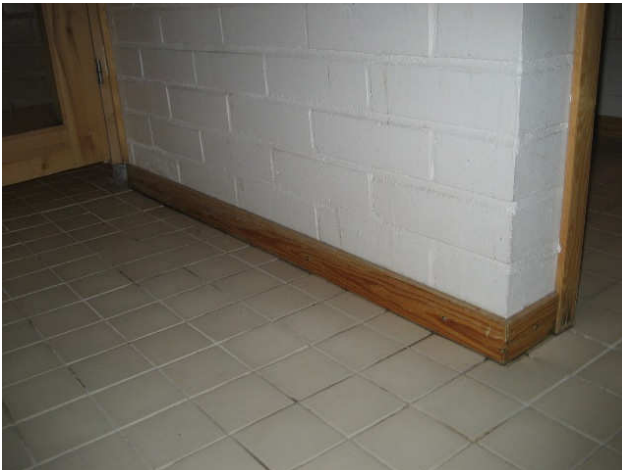
Kuva 21 Saunan pukuhuoneeseen valuu vettä pesuhuoneesta, laatoissa on kopoja.
