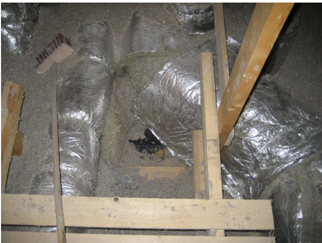
Kuva 17 Laajennusosan yläpohjan eristys on puutteellinen tilan 126 yläpuolella
