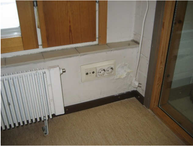
Kuva 19 Kosteusvauriokohta alkuperäisen osan ruokailutilan 040 nurkassa.
