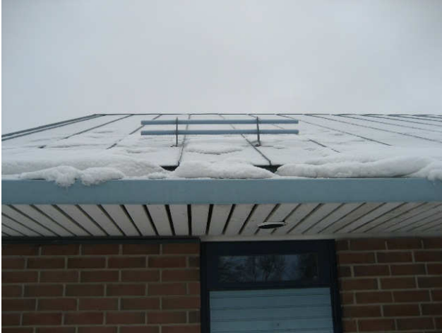
Kuva 1 Alkuperäisen osan vesikaton varuste- kiinnityksiä on tehty vesikatteen läpi.
