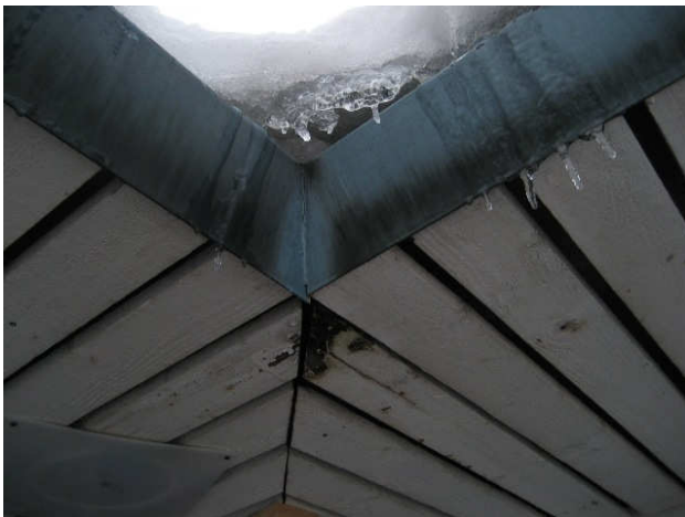
Kuva 3 Jiirin nurkassa räystäskouruvuoto on aiheuttanut aluslaudoitukseen lahoa.
