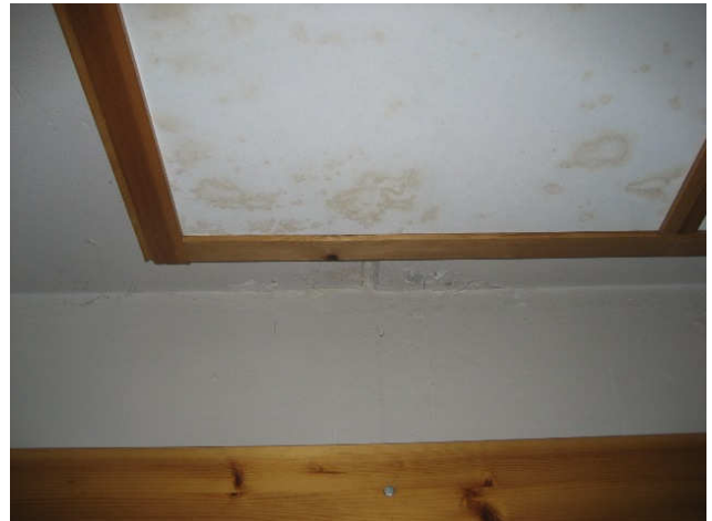
Kuva 24 Takkahuoneen 055 katossa on vesivuotojälkiä mm. katon akustiikkalevyissä .
