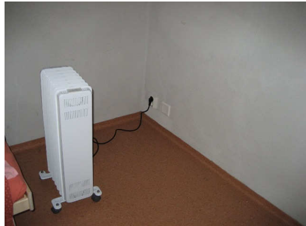
Kuva 26 Lisälämpöpatteri lasten asuinhuoneessa.
