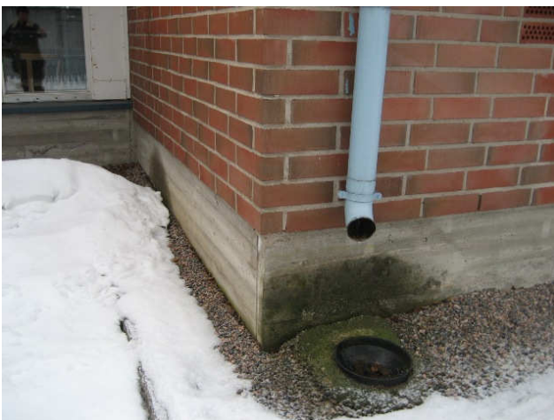
Kuva 11 Ylhäältä roiskuva sadevesi turmelee sokkelin pintaa.
