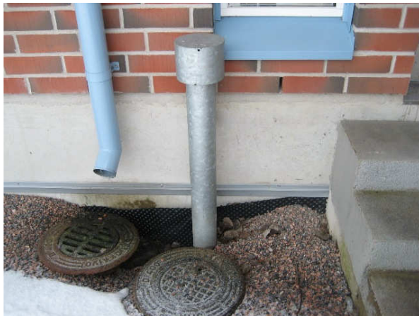
Kuva 9 Tilan 110 kohdalla rännivesi on aiheuttanut montun sokkelin viereen.
