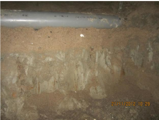
Kuva 27 Lohko 4, alituskaivannon reunalla hiekan seassa oleva viemäri
