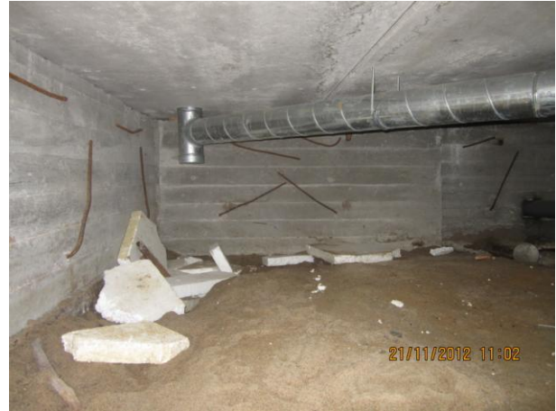
Kuva 32 Lohko 5, poistokanava nousee alapohjan läpi, maa kostea, mikrobeja
