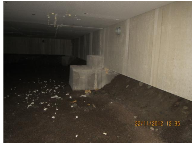
Kuva 52 Maa on kostea, sokkelipalkin alta puutuu vastatäyttö
