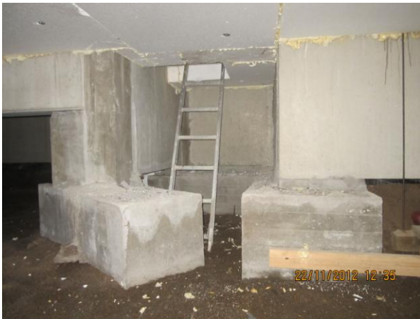
Kuva 51 Huoltoluukun alue TK108 kohdalla, maa on kostea
