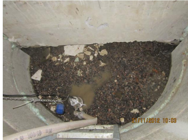
Kuva 8 HL1 pohjalla oli vettä, joka pumpattiin pois, jotta alustaan päästiin.
