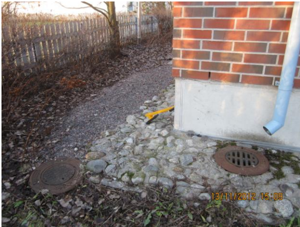
Kuva 49 SOK 18, vesi valuu rännikaivon ohi
