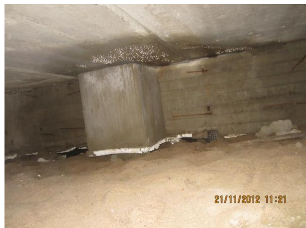
Kuva 48 Lohko 7, pohjoissivun sokkeli on kostea, katossa kondenssia, painumia
