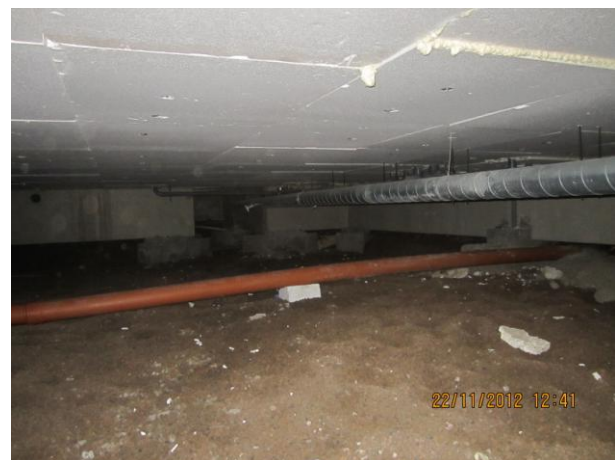
Kuva 54 Alustatila luokan 140 alla, viemärin kallistus ei ole kunnossa
