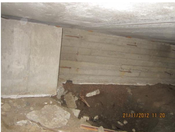
Kuva 47 Lohko 7 eteläsivun sokkelin alta valuu sepeliä kaivantoon
