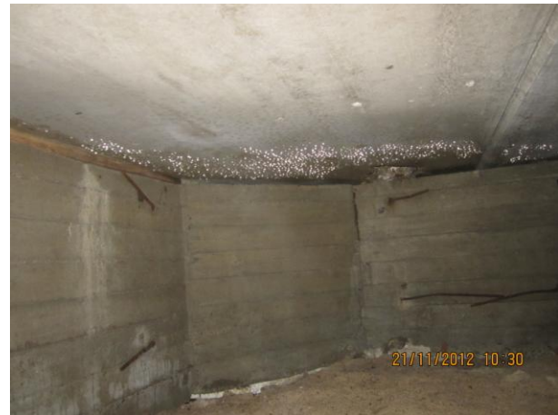
Kuva 28 Lohko 4, korvausilmaputki alapohjan läpi, kondenssia, seinämät märät
