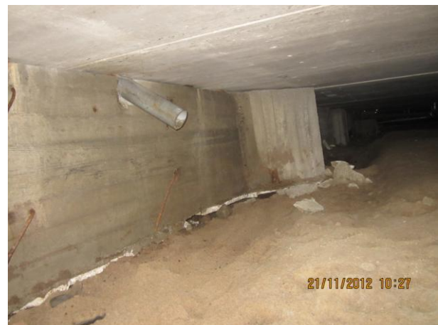
Kuva 18 Lohko 2, sokkelipalkin sivu on märkä, tuuletusputki
