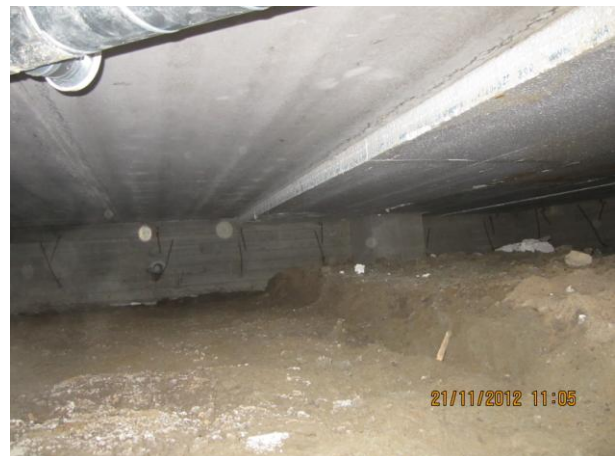
Kuva 36 Lohko 6, lisäeristys katossa, sen alla rajalla maassa porrastus, maa märkä, mikrobeja
