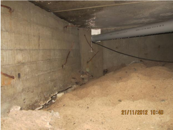
Kuva 25 Lohko 2, kondenssia katossa ja viemärissä, märkä seinä, kostea hiekka
