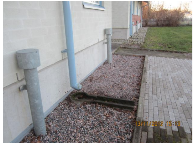
Kuva 50 Pohjoissivulla rännivesi imeytyy sepeliin loiskekourusta
