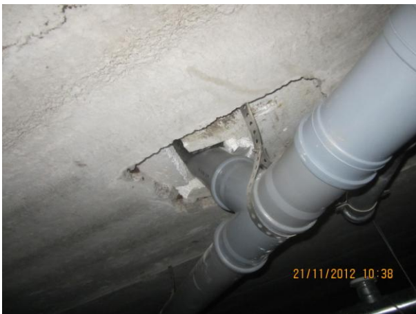
Kuva 23 Tyypillinen viemärin läpivienti
