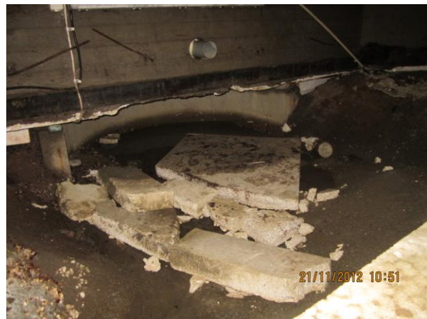
Kuva 12 Lohko 1, HL3 kulkuluukun montussa sisäpuolella oli runsaasti vettä
