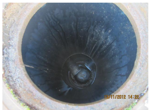
Kuva 6 Säätkannellinen tarkastuskaivo, putket uusia kaksoisputkia.
