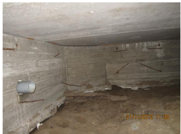
Kuva 42 Lohko 6 eteläisivun sokkeliä. lahoa puuta
