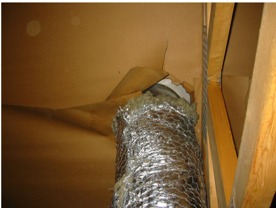
Kuva 4. Kanavien ja putkien liitokset aluskatteeseen on tehty yleisesti epätiivivisti.
