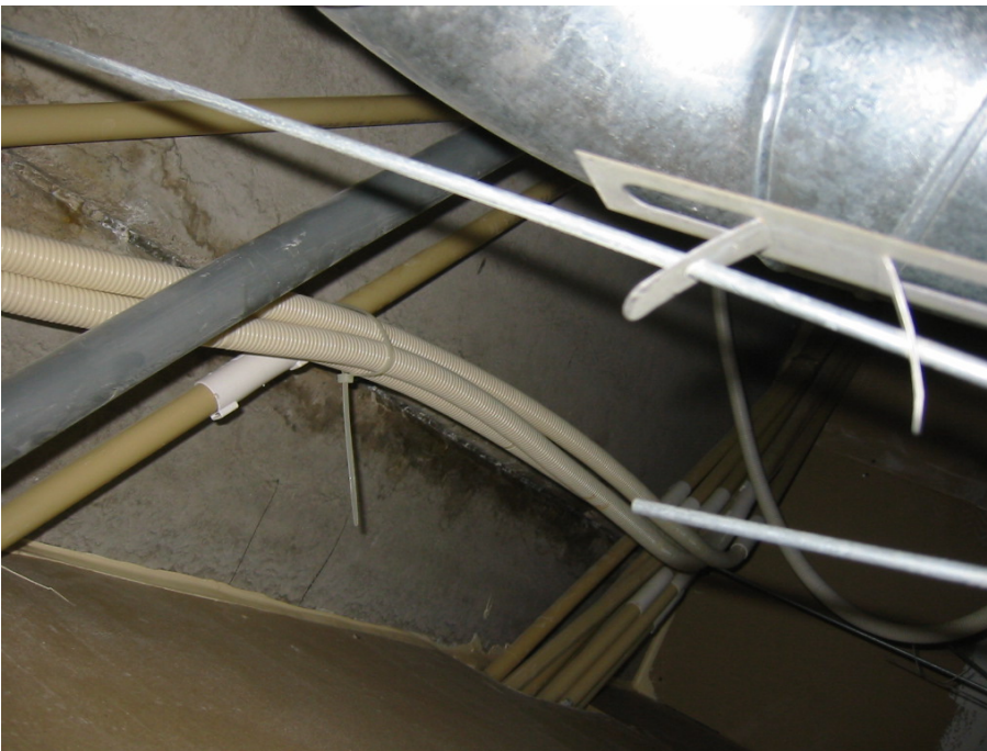
Kuva 2. Kosteusjälki huonetilan 1.069 alakattorakenteen yläpuolisessa ontelotilassa (on todennäköistä, että kuvan vuotojäljet ovat syntyneet rakennusajankohdan jälkeen, koska ne eivät olleet yleisiä).
