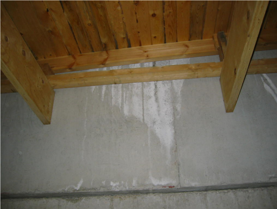
Kuva 25. Vuotojälkiä C1- ja C2-osan yläpohjan ontelossa betonielementtipinnalla, ks. myös kuva 21.
