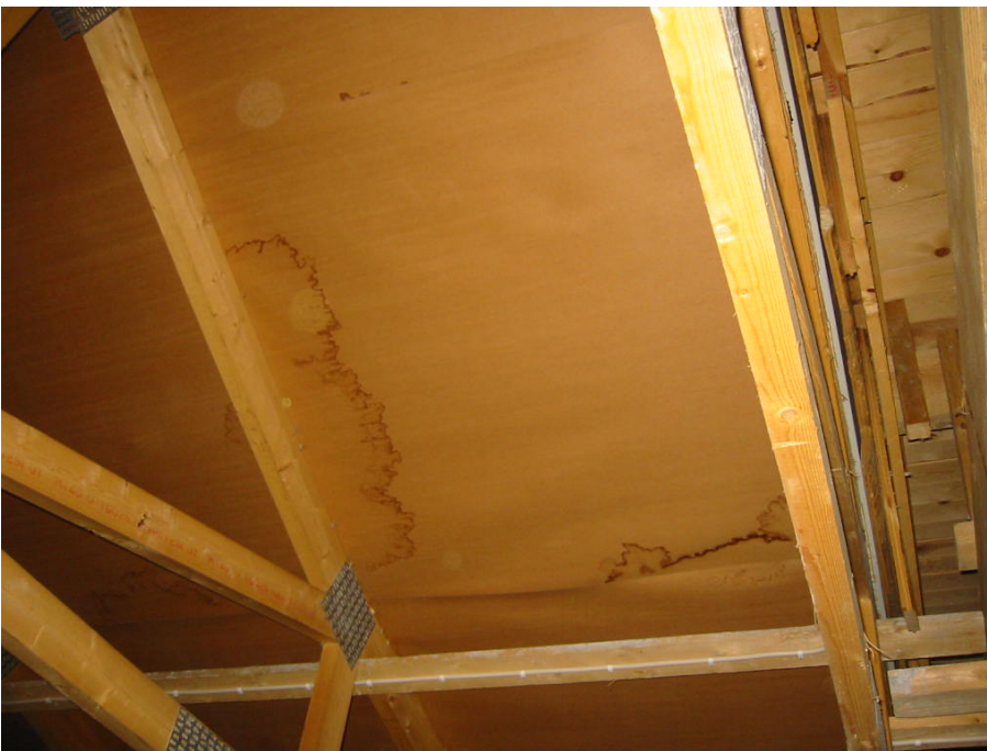
Kuva 24. Vuotojälkiä B-osan kattoluukun reunarakenteeseen liittyen.
