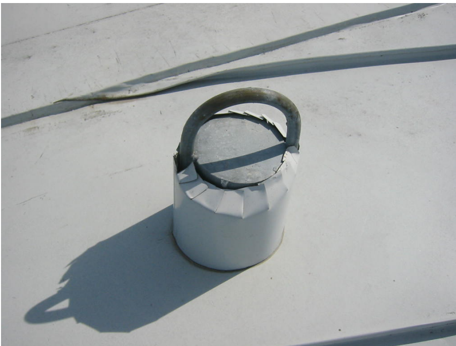
Kuva 28. Juhlasakin katolla olevien kattopollareiden liitos kattopeltiin on epätiivis.
