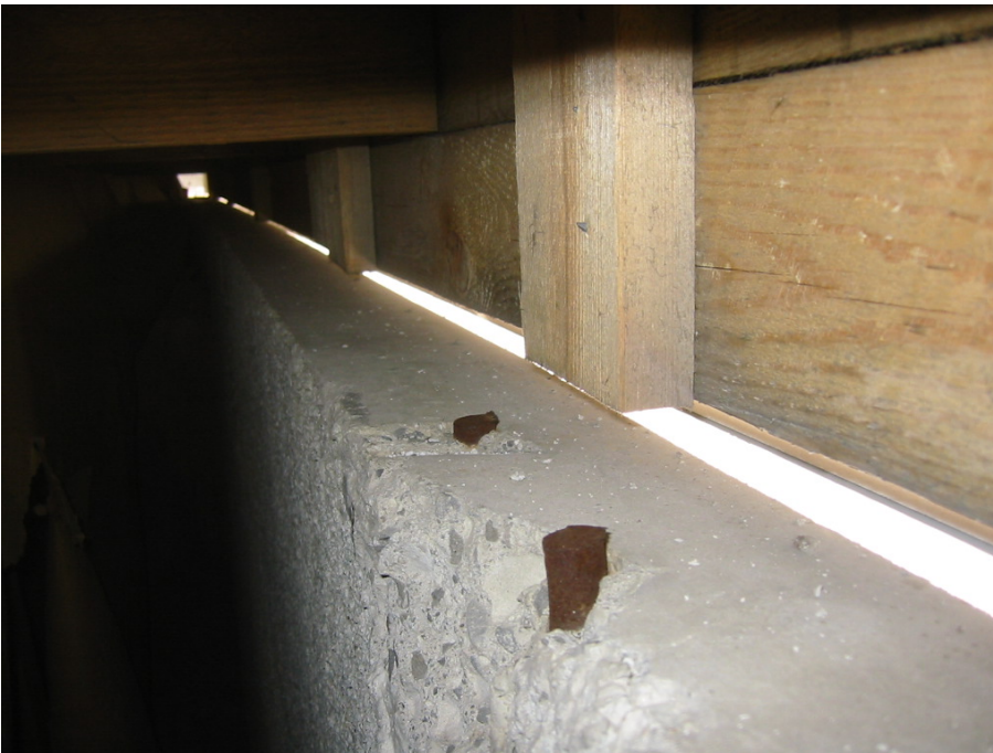
Kuva 12. D-sisäänkäynnin päätyräystäaseen liittyen on räystäspellityksen limitys ulkokuoreen vähäinen ja myrskypellitys puuttuu.
