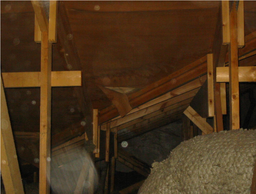
Kuva 23. Vuotojälkiä A-osan sisäjiiriin liittyen.
