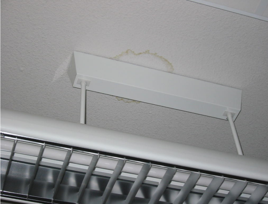
Kuva 1. Kosteusjälki huonetilan 1.013 kattorakenteessa.
