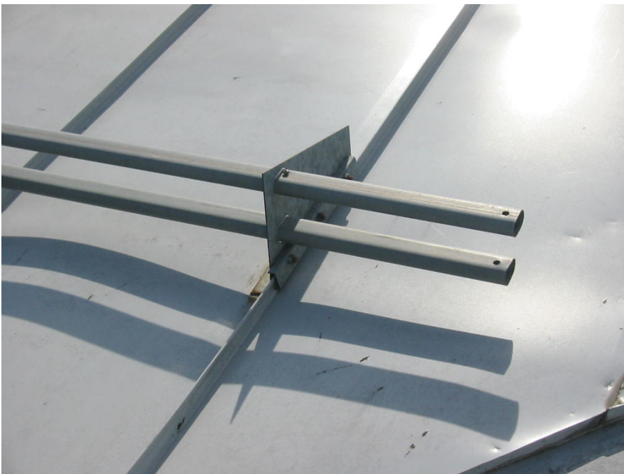
Kuva 18. Sinkittyihin vesikaton varusteisiin (lumiesteet, kulkusillat, lapetikkaat) liittyen ovat erityisesti kiinnikkeet ruostuneet.
