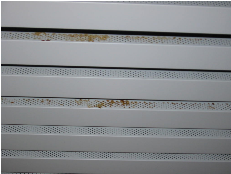
Kuva 3. Kosteusjälki huonetilan 1.090 alakattorakenteessa.
