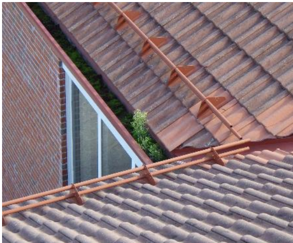
Kuva 29. B- ja C-osan yhtymäkohdan sadevesikourun pohjalle on kerääntynyt sammalta ja kasvillisuutta.
