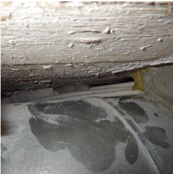
Kuva 21. Luokan 210 alakattotilan kohdalla, hormin IV- ja sähköjohtojen läpiviennin kohta on osin tiivistämättä. Kanavan pinnalla on havaittavissa rakennuspölykertymää.
