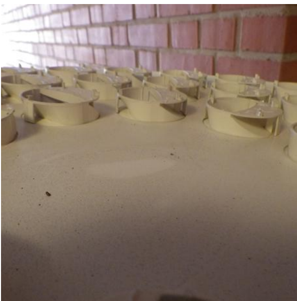
Kuva 9. Käytävän 202 tuloilmakanavan päätelaitteen hajotajalevyn päällä pölykertymää.
