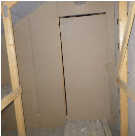
Kuva 31. C-osan ullakon palo-osastoseinän käyntiovi on irronnut saranoiltaan.
