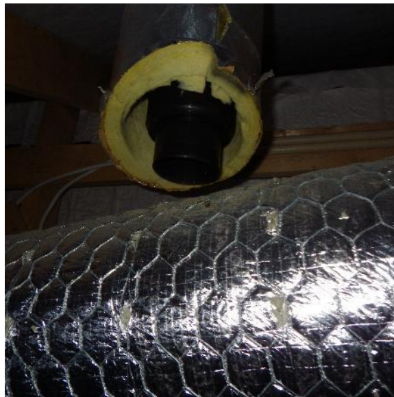
Kuva 32. C-osan lounaissivun kattolappeella oleva toinen tuuletusviemärin purkupiippu on poistettu käytöstä. Viemäri on yhdistetty viereiseen tuuletusviemäriin, jonka purkupiippu on katon samalla lappeella.
