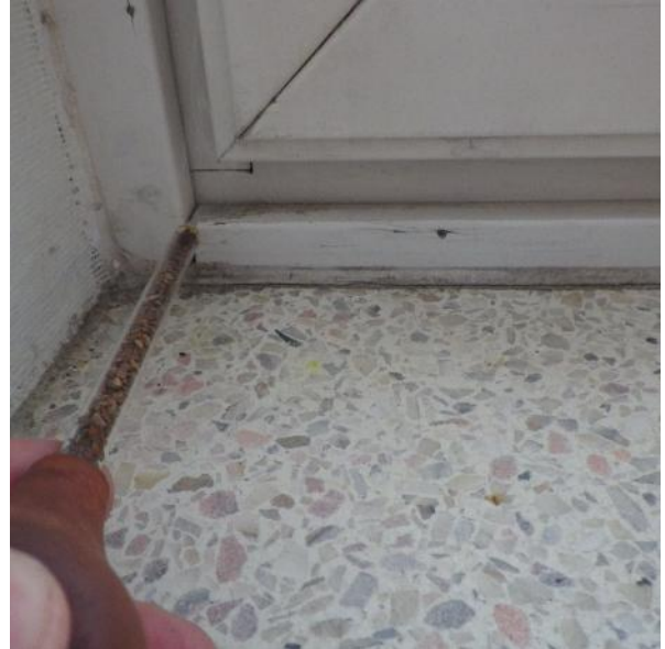
Kuva 16. B-osan ikkuna- ja ulkoseinäliitoksissa todettiin vuotoilma-kohtia.
