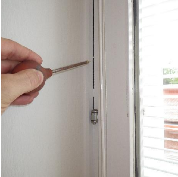
Kuva 15. B-osan ikkuna- ja ulkoseinäliitoksissa todettiin vuotoilma-kohtia.
