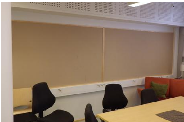
Kuva 25. Neuvotteluhuoneessa 229 aistittu hajuhaitta aiheutuu tilaan asennetuista linoleumista valmistetuista ilmoitustauluista. Ilmoitustaulujen pinta-ala on n. 8 m 2 . Em. hajua voi aiheuttaa ärsytysoireita herkistyneille henkilöille.
