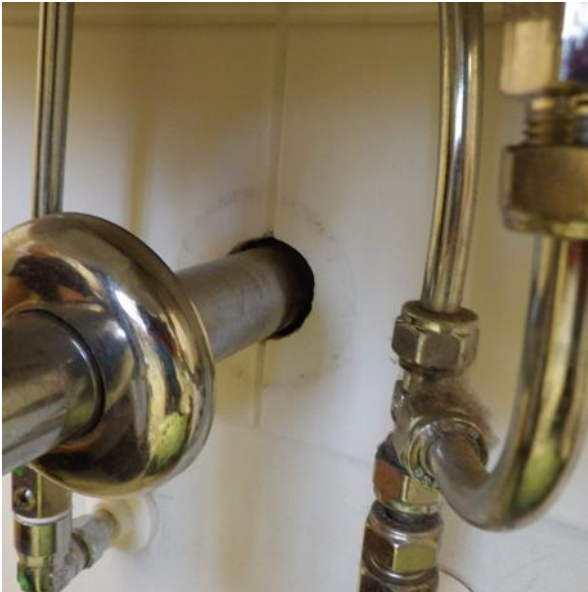
Kuva 19. Luokassa 211 viemäriputken pystyhormin läpivienti on tiivistämättä.
