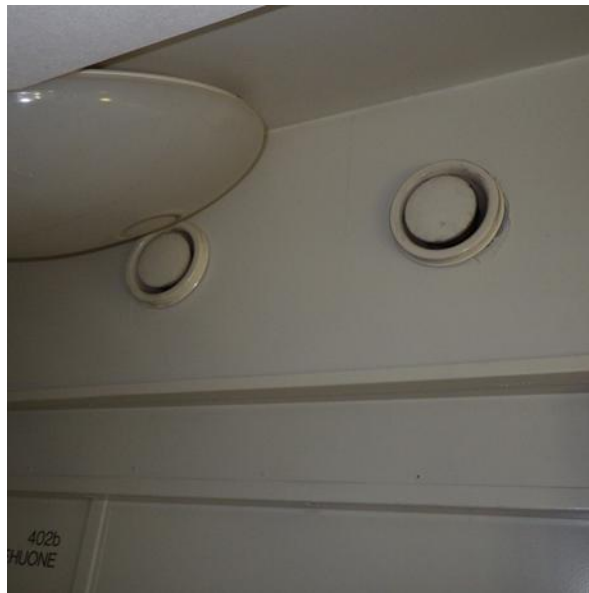
Kuva 12. Porrashuoneen 171 poistoilmaventtiilit sijaitsevat porrashuoneen yläosassa.
