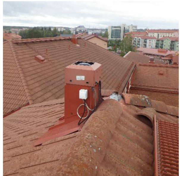
Kuva 30. B-osan tiilikaton harjakappale on irronnut.
