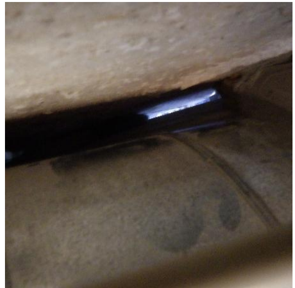
Kuva 22. Kuva on otettu 210 alakattotilasta hormin suuntaan. Hormiin asennettu valo paljastaa vuotokohdan.
