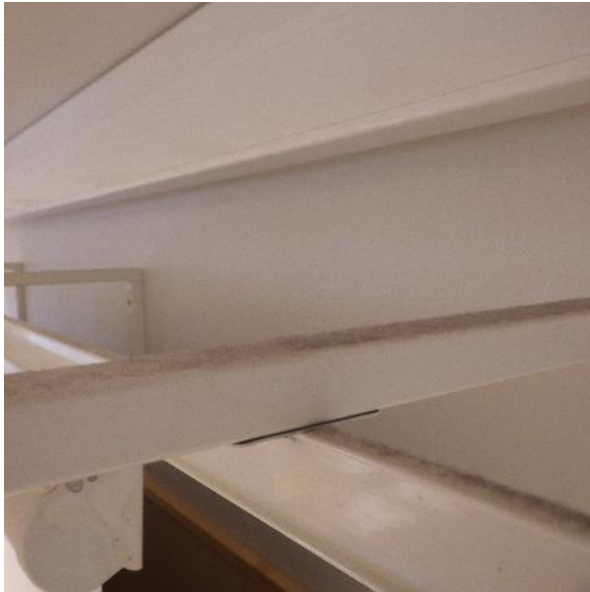
Kuva 27. Luokan 210 yläpinnoilla pölyä. Yläpölyt tulee puhdistaa vähintään kerran vuodessa.
