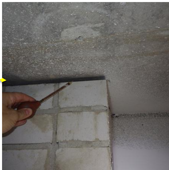
Kuva 14. Tiilirakenteisen pystyhormin ja välipohjarakenteen liitoskohta on epätiivis. Merkkisavua virtasi tutkimuksen aikana hormin suuntaa, tilan ollessa ylipaineinen ulkoilman suhteen. Hormissa sijaitsee poistoilmakanavia. Kolmannessa kerroksessa ko. hormin ja yläpohjan liitos oli tiivis.
