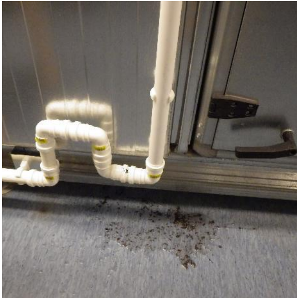
Kuva 4. TK 1 tuloilmasuodatinkammion viemäriputken hajulukko. Hajulukossa oli tutkimuksen aikana vettä. Veden lisääminen hajulukkoon on hieman hankalaa.
