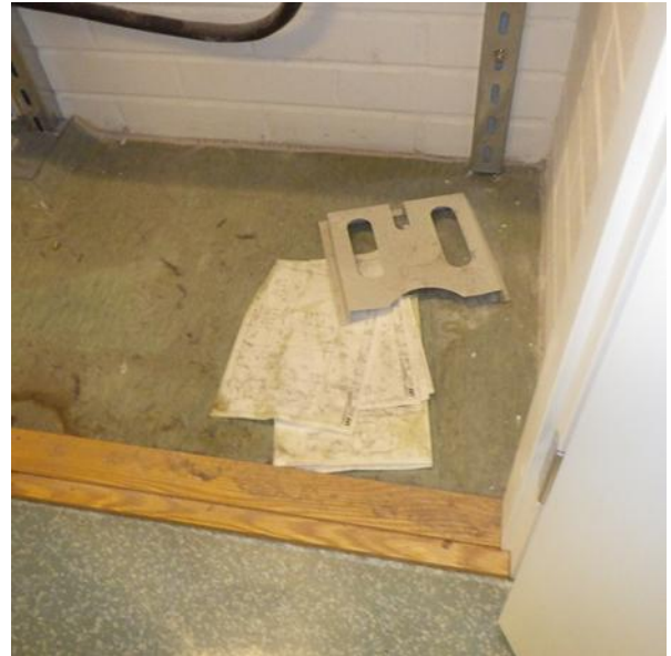
Kuva 28. Sähköpääkeskuksen 249 lattialla pitkäaikaisista pölykertymästä. Vastaavat tilat tulisi siivota systemaattisesti vuosisiivouksen yhteydessä.
