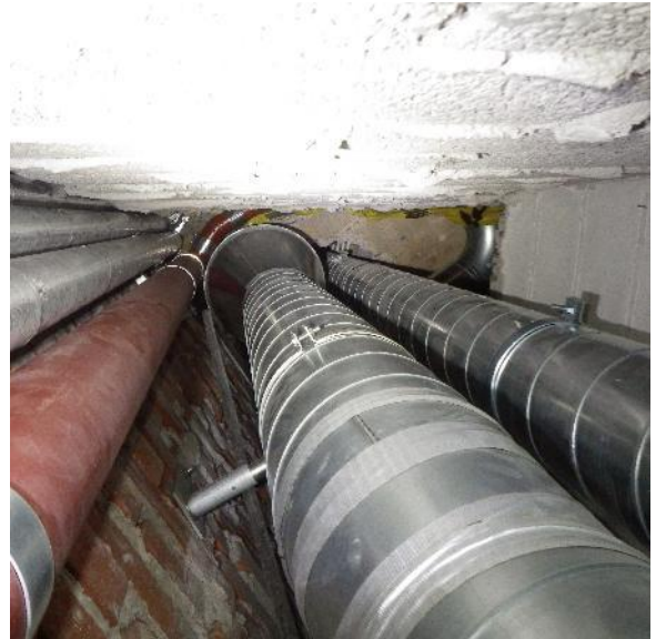
Kuva 18. Kuva hormin sisältä (luukusta ylöspäin). Väli-pohjien läpiviennit ovat osin avoimia .
