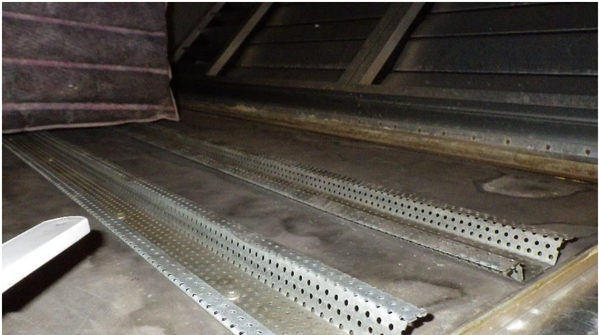
Kuva 3. TK5 tuloilmakammion pohjalla on vesijälkiä reikäpelistä tehdyt kiskot estävät suodattimen alareunan koskettamisen kammion pohjaan ilmanvaihdon pysähtyessä.
