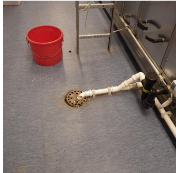
Kuva 5. TK 1 kammioiden vedet johdetaan lattiakaivoon. Lattiakaivossa oli tutkimuksen aikana vettä. Viemäriputkea voisi lyhentää siten, että sen purkuaukko sijaitisi lattiakaivosta esim. 200 mm:n päässä. Tällä vähennettäisiin riskiä viemärihajujen kulkeutumisesta tuloilman vaihtoon, mikäli viemärikaivo ja viemärin hajulukko olisi kuivillaan.
