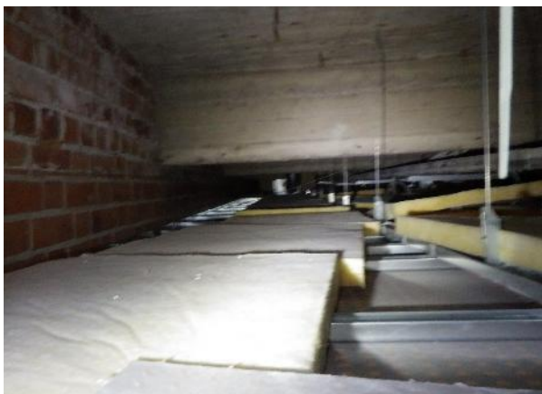
Kuva 23. B-osan käytävän alakattotilan tarkastuskohta. Alakattotilaan on asennettu mineraalivillalevyjä, joista irtoavien kuitujen kulkeutumisriski sisäilmaan on vähäinen, tiiviin levyrakenteen vuoksi.
