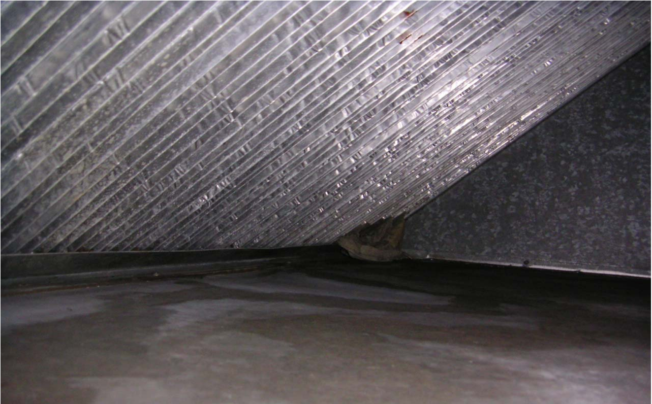
KUVA 1. Lämmöntalteenoton ristivirtauskenossa on roskaa.
