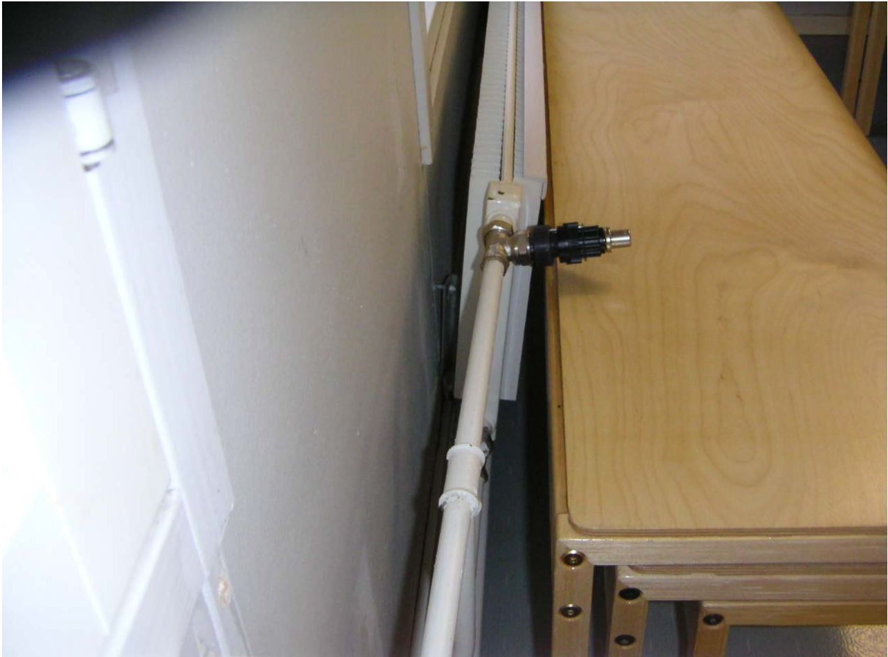
Kuva 5. Lämpöpatterin kiinnitys on pettänyt ja patteritermostaatti on rikki.
