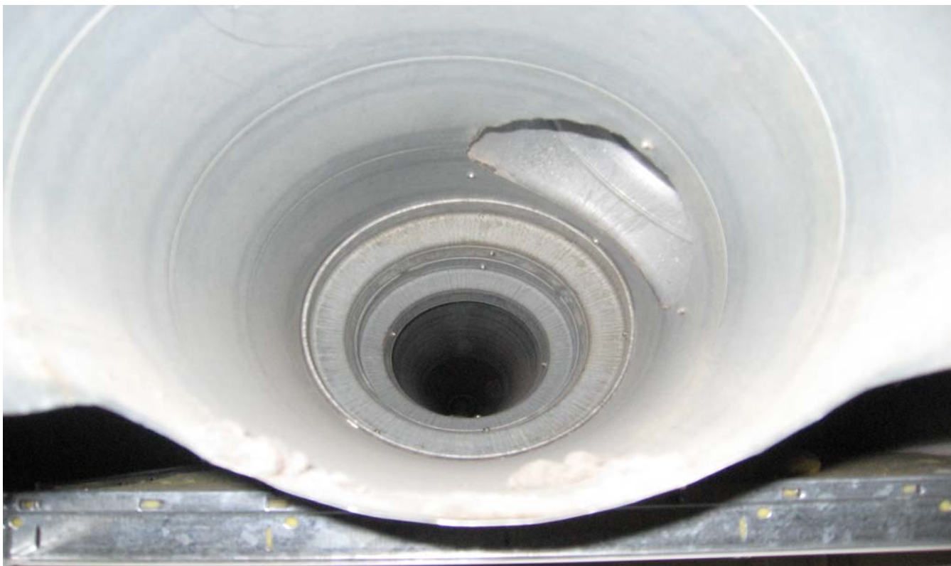
KUVA 4. B- osalla olevassa runkokanavassa on pölykertymää.
