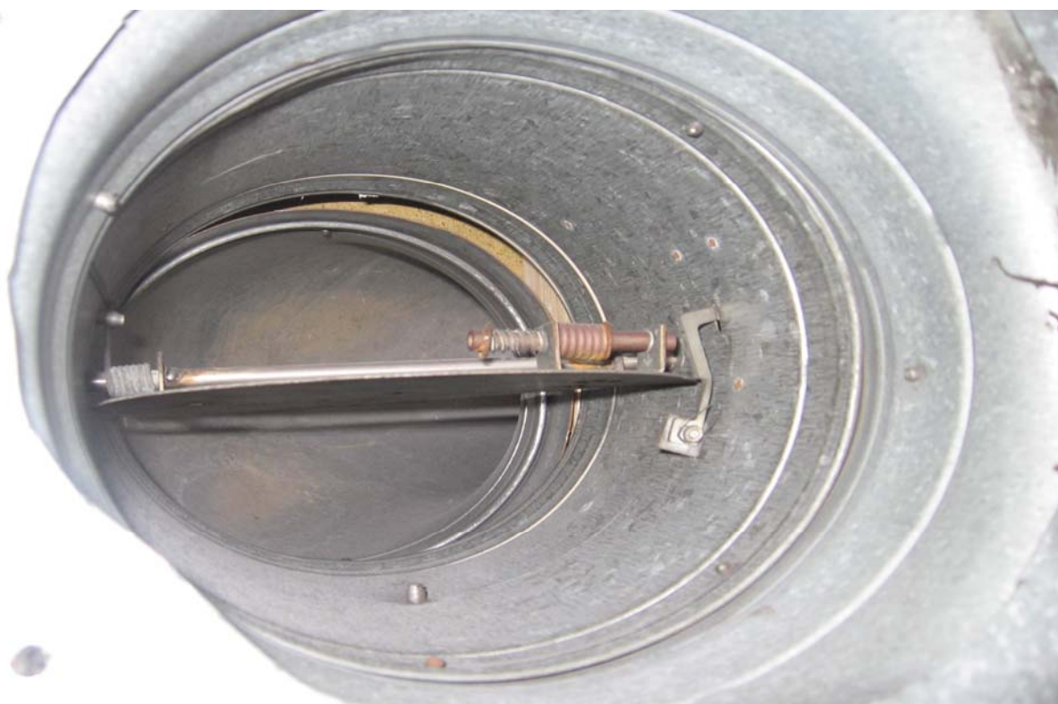
KUVA 2. Keittiön tuloilmakanava on irti ennen tasauslaatikkoa.
