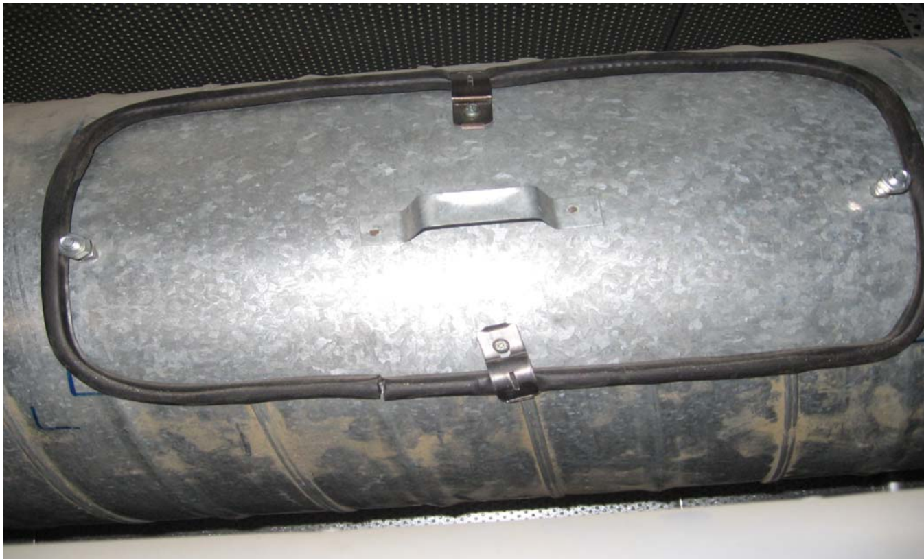
KUVA 1. Puhdistusluukun lukituspelti oli irti.
