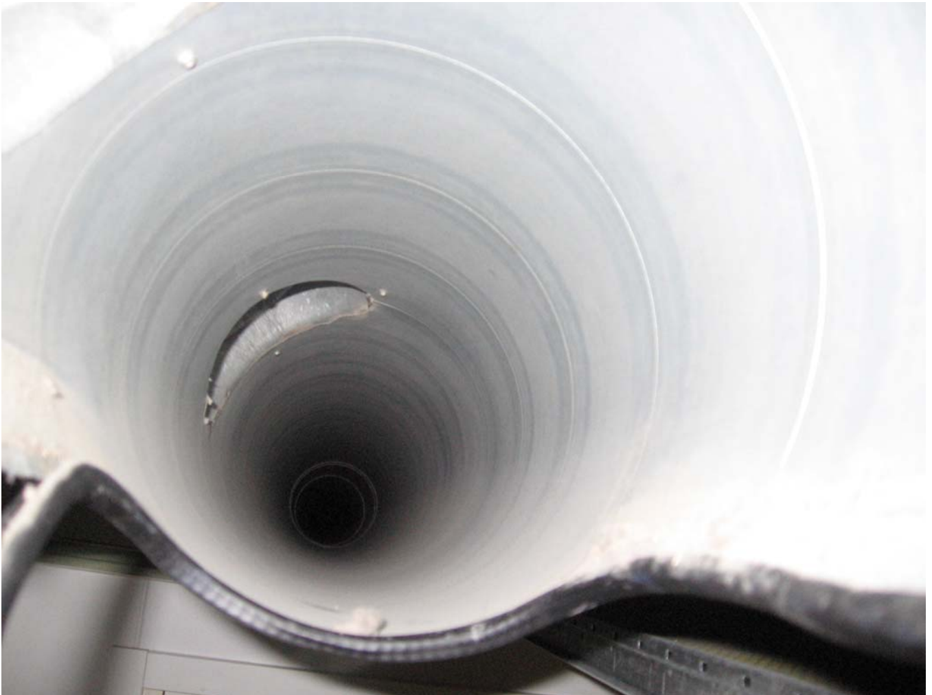
KUVA 5. B- osalla olevassa runkokanavassa on pölykertymää.
