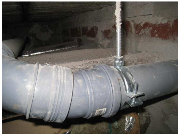
Kuva 16 Vuotojälkiä muiden putkien eristeiden pinnalla. Joku näistä liitoksista vuotaa. Kannakointi voi antaa periksi. Viemäri tulee tilan 056 suunnalta ja kääntyy jyrkästi käytävälle 016c.
