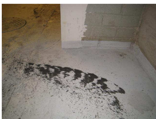
Kuva 10 Käytävän lattialla oli vielä kattohuovan sirotekiteitä siivoamatta.
