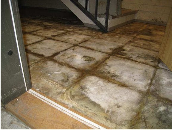
Kuva 1 Porras C/ tila 059 on päässyt vettä kynnyksen yli.
