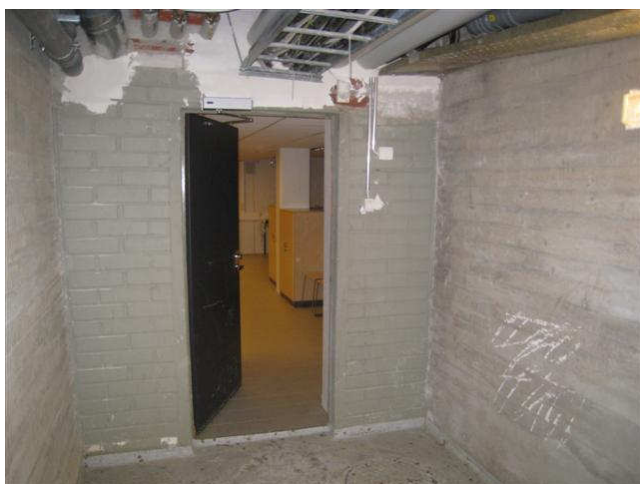
Kuva 11 Tästä oven kynnyksestä oli päässyt vettä tilaan 030/ op.työtila.
