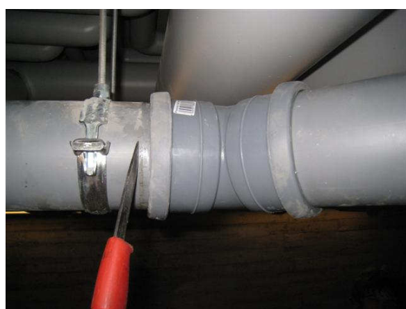
Kuva 6 Tämä sadevesiviemärin muhvin pää pääsi luistamaan viemäriä kevyesti liikuttaessa.
