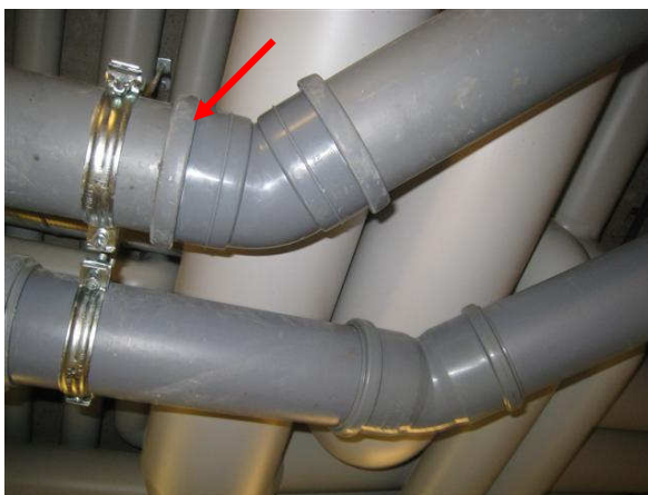
Kuva 5 Tässä ylempänä on sadevesiviemäri (nuoli) ja sen vieressä jätevesiviemäri. Kulmaosat ovat erilaiset.
