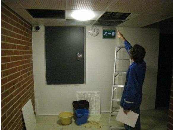
Kuva 13 Vahinkopaikka 2 käytävän 049 kohdalla, jossa oli vielä sankoja yms. Kouluisäntä Nevalainen osoittaa vuotoa paikkaa.
