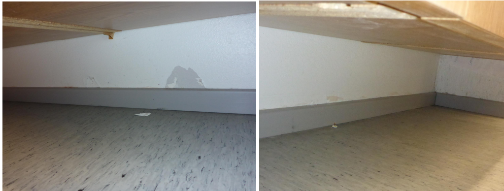
Kuvat 6 ja 7. Luokan ja käytävän 201C väliseinän alaosan maalipinta on irronnut alustastaan paikallisesti.
