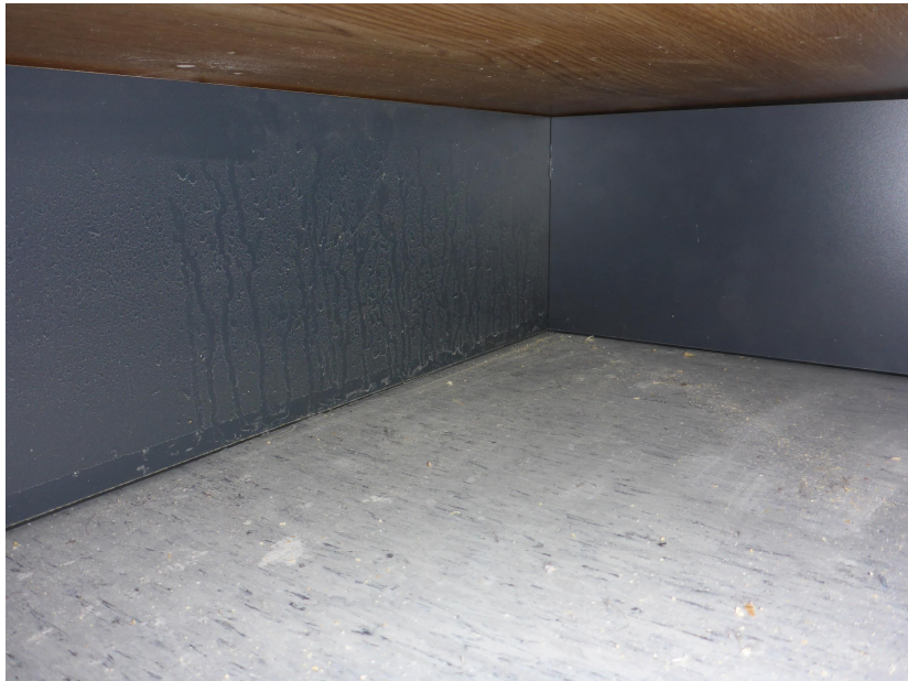
Kuva 3. Luokan 221 kiintoalakaapin alla, kaapiston takasokkelilevyssä on havaittavissa veden valumajälkiä.
