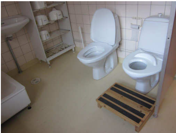
Kuva 5 Pesuh./ WC –tila 62. Pintakosteus koholla WC-istuimen ympärillä lattiasa.
