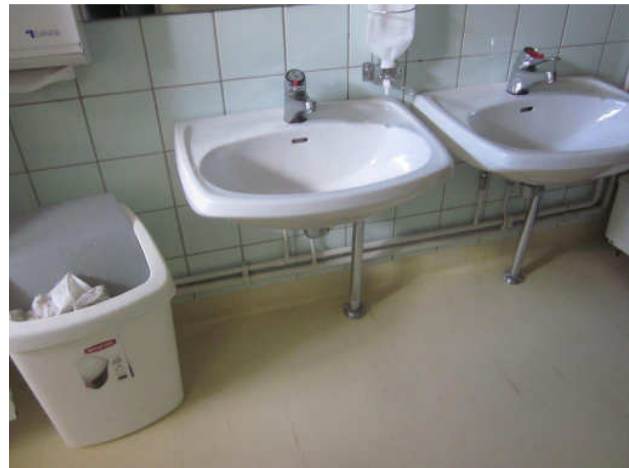
Kuva 6 Pesuh./ WC –tila 21. Pintakosteus koholla käsipesualtaiden alapuolella lattiasa.
