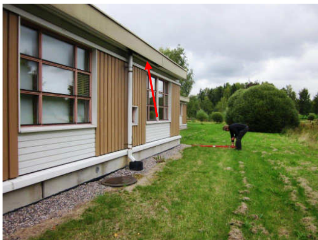
Kuva 12 Räystäslautoitusta on asentamatta.
