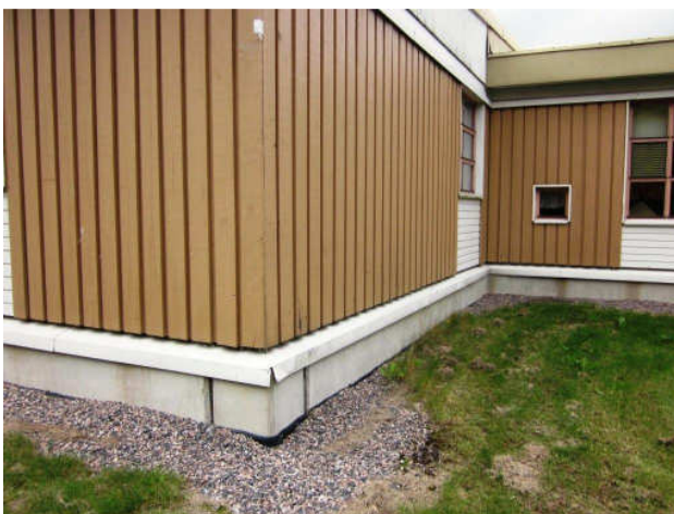
Kuva 7 Lomalautoituksen alapäissä alkavaa rakoilua.
