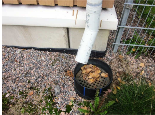
Kuva 4 Syöksytorven ja kaivon keskinäinen sijoittaminen puutteellinen.
