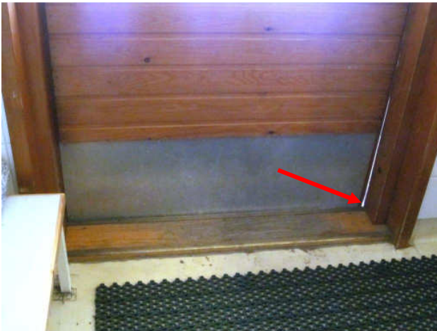
Kuva 11 Ovi ei ole tiivis.
