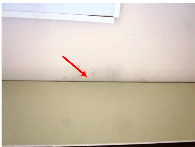
Kuva 14 Vanha kosteuden aiheuttama jälki katossa. Mikrobivaurioon viittaavia pilkkuja.
