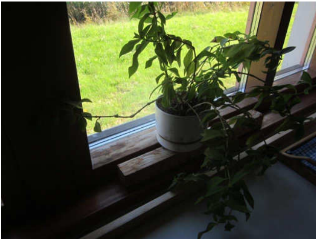
Kuva 9 Ikkunakarmissa kukkien kasteluveden aiheuttamia jälkiä.
