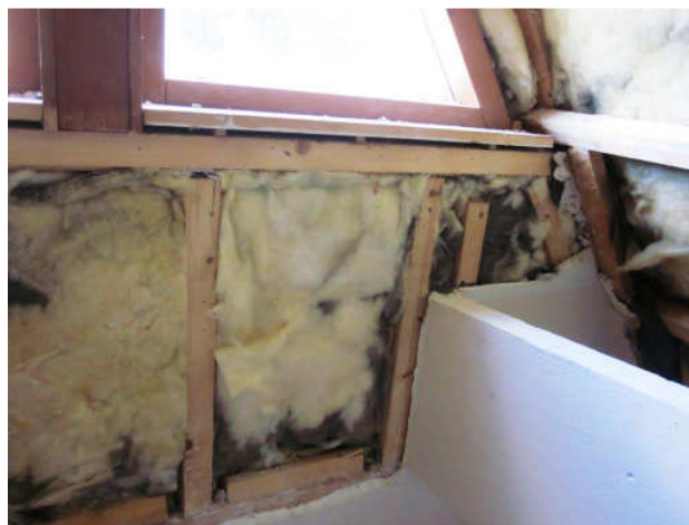
Kuva 13 Kattolyhtyrakennetta. Puurakenteet terveen värisiä. Mineraalivilloissa ilma- vuotojen aiheuttamia tummentumia.
