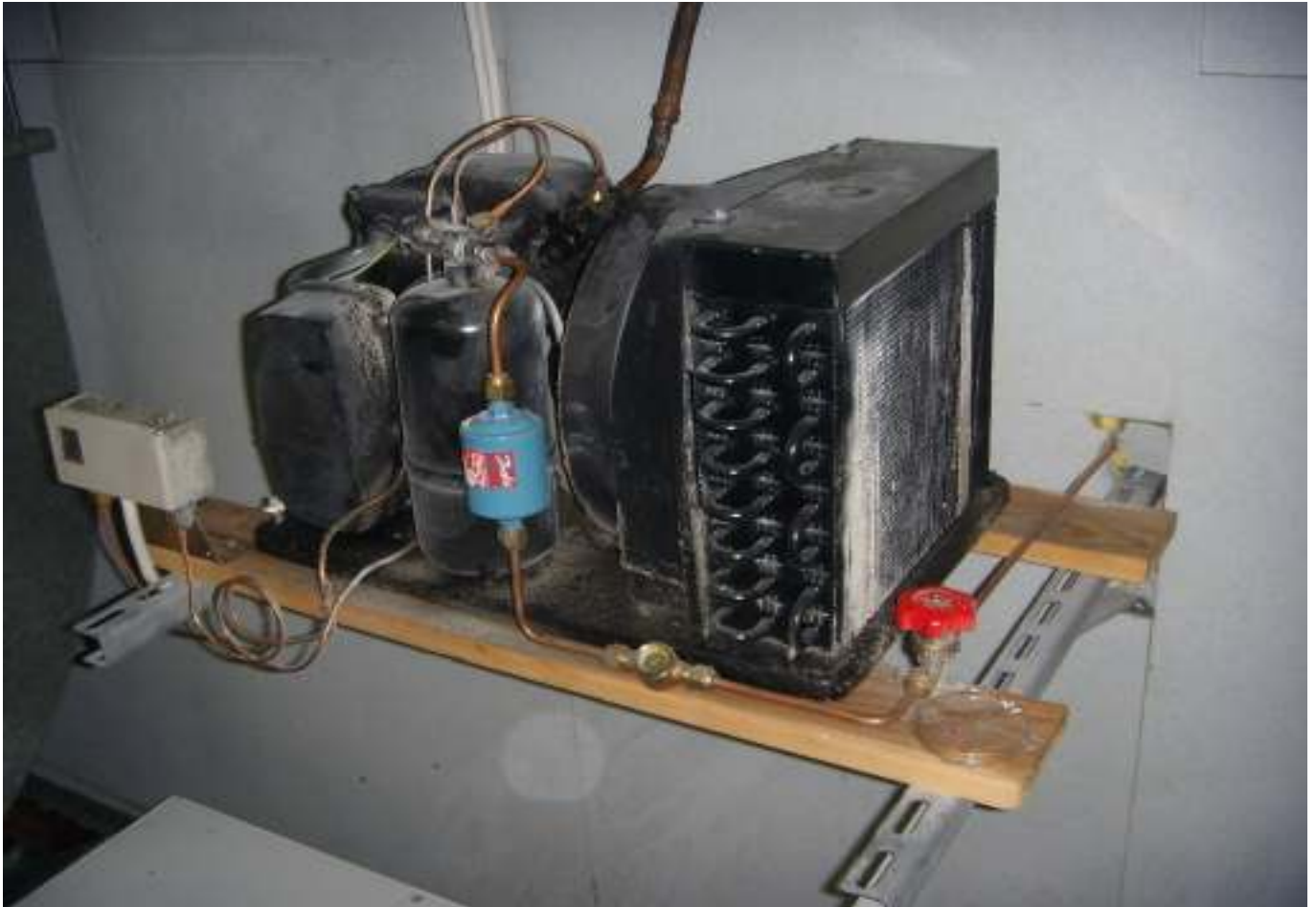
KUVA 13. Yleiskuva IV- konehuoneesta olevasta kylmiön kylmälaitteistosta.
