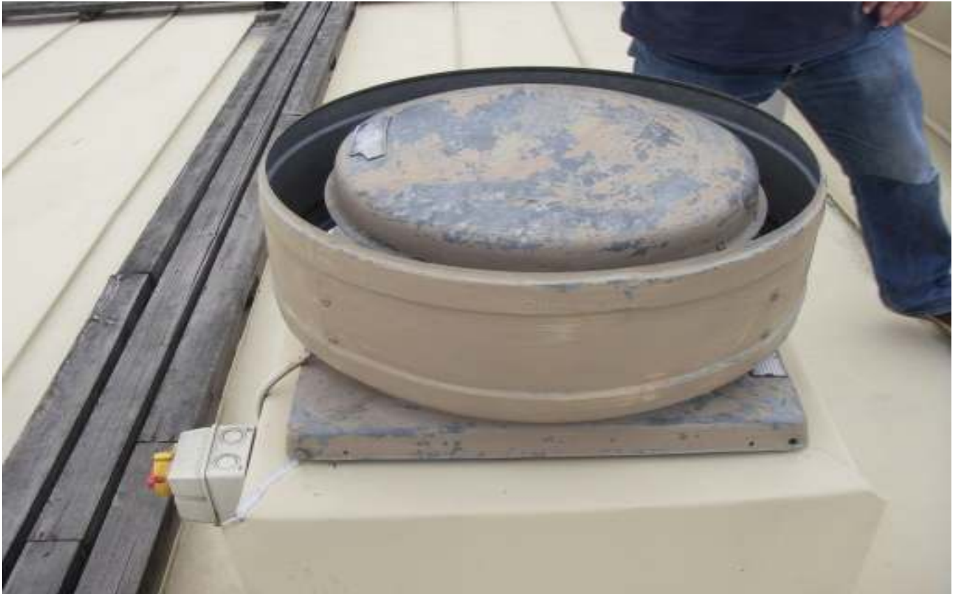
KUVA 7. Yleiskuva vesikatolla olevasta huippuimurista.
