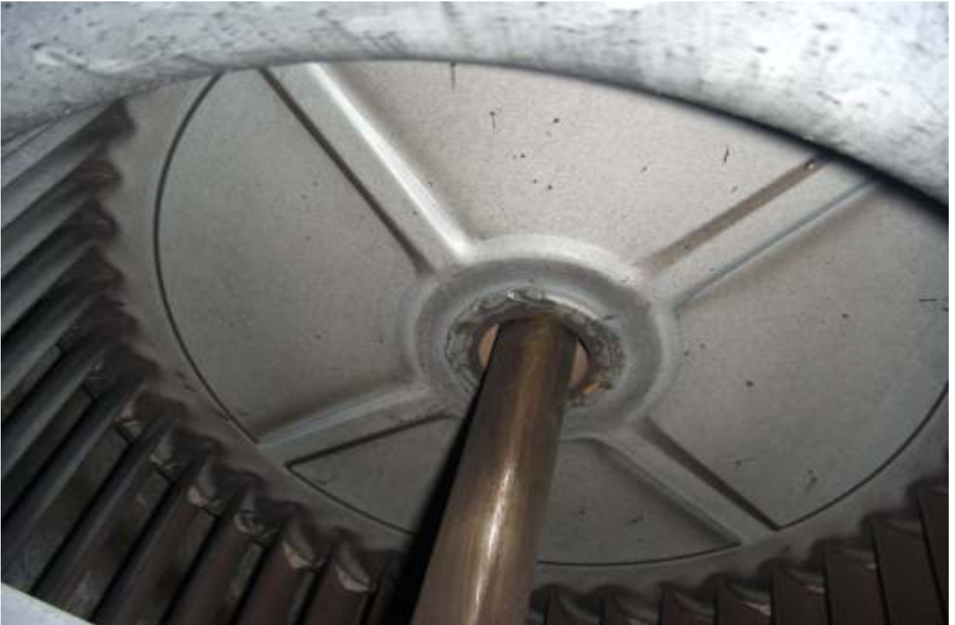
KUVA 3. Tuloilmapuhallin on hieman pölyinen ja nokinen.
