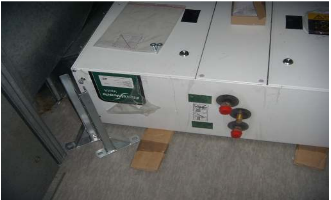
KUVA 16. Yleiskuva alustatilan tuloilmakoneesta.
