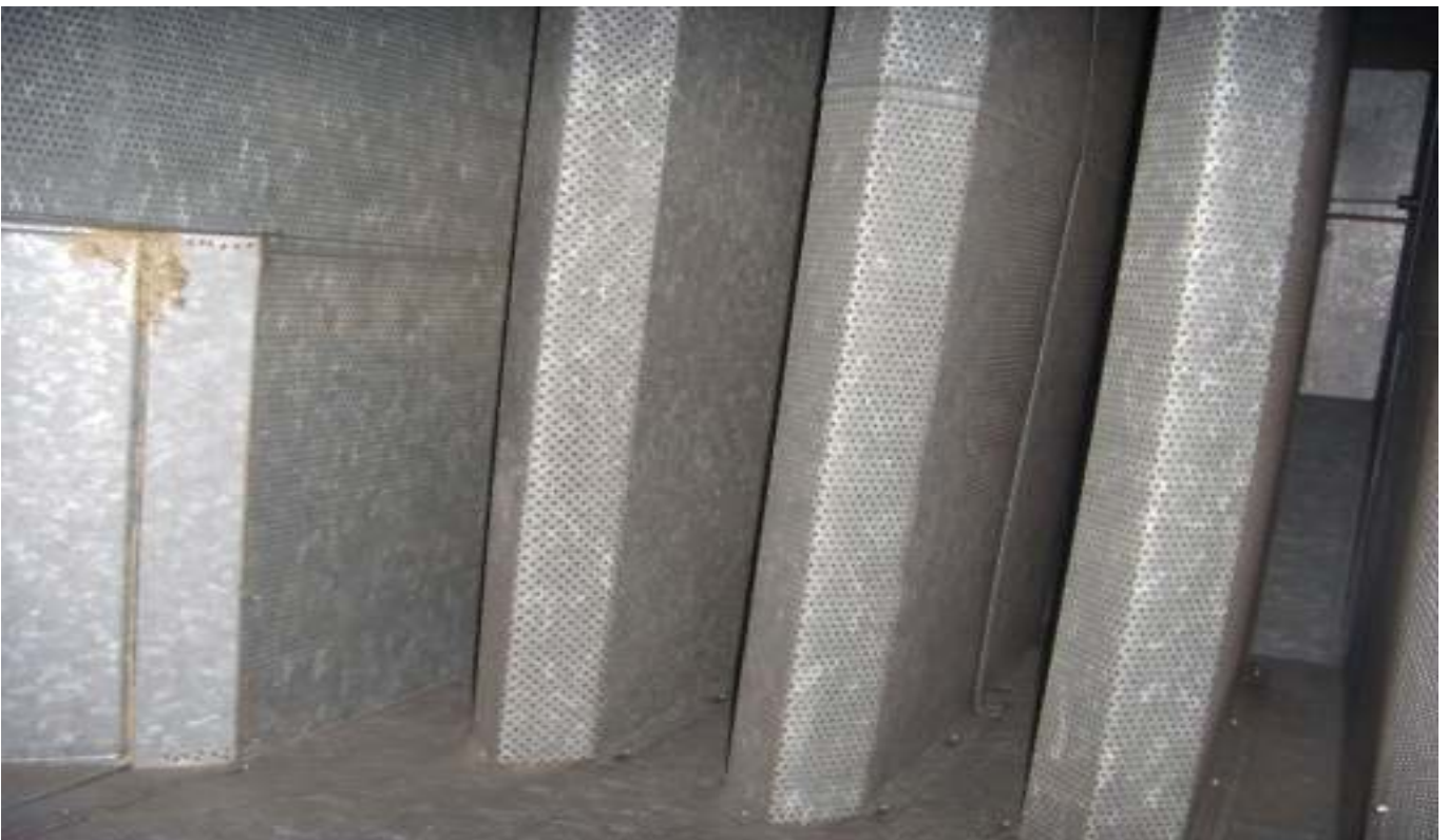
KUVA 4. Tuloilmakoneen kammiot ja äänenvaimennin on eristetty mineraalivillalla, joka on päällystetty reikäpellillä.
