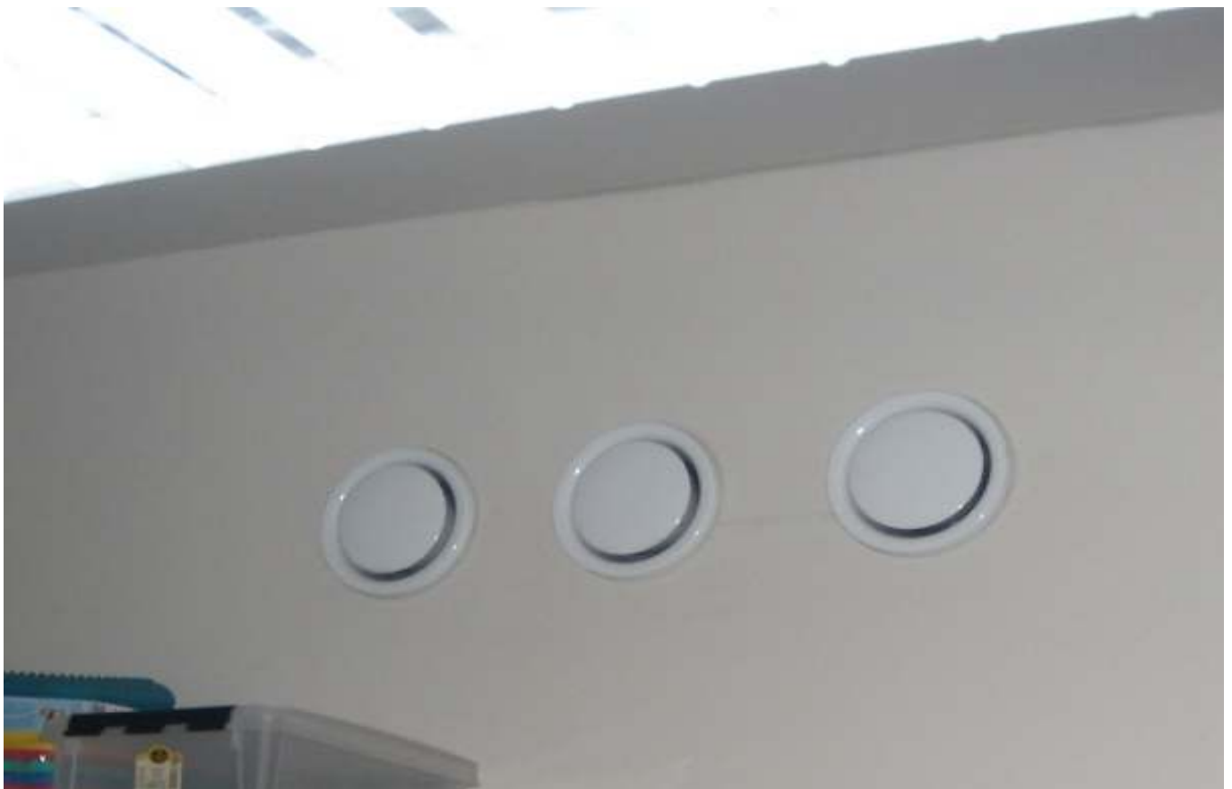
KUVA 12. Yleiskuva huoneiden poistoilmaventtiileistä.
