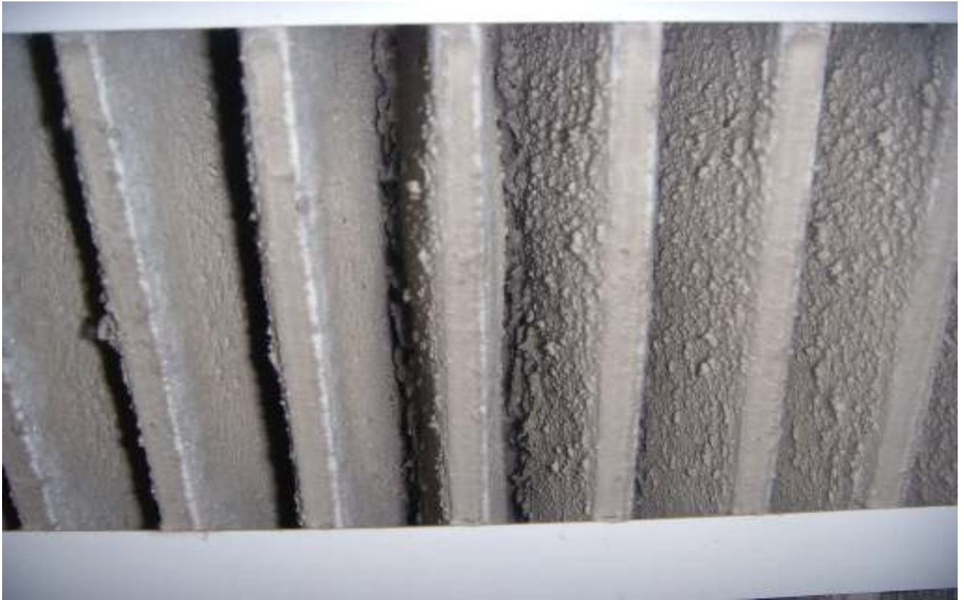
KUVA 5. Yleiskuva poistoilmasuodattimen ns. puhtaalta puolelta.
