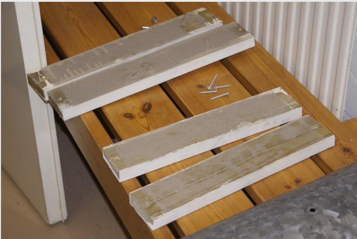
Kuvat 25,26. Pukuhuoneen 147 kattolaudoitus on tehty painekyllästetystä puusta. Painekyllästettyä puuta ei tulisi käyttää sisätiloissa.
