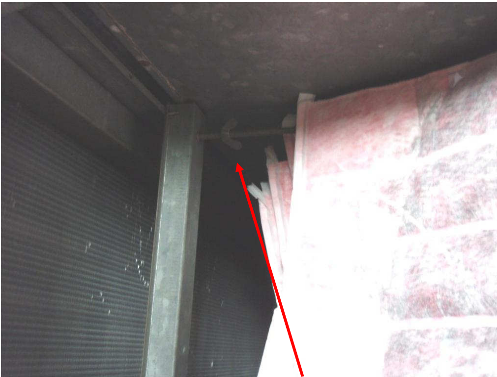
KUVA 3. Tuloilmakoneen 2TP suodattimien kiristin
