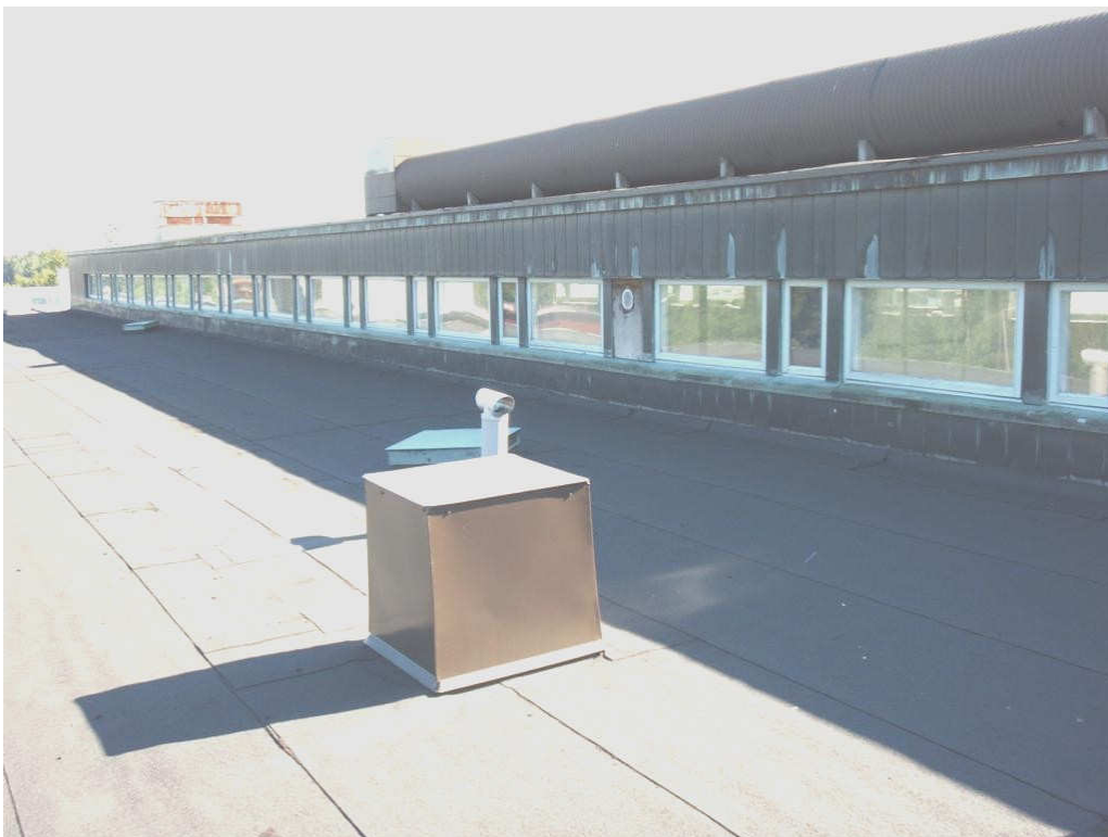
KUVA 8. A-osan sisääntulopuolen 4. kerroksen paikoittain irtoillut ikkunalauta.
