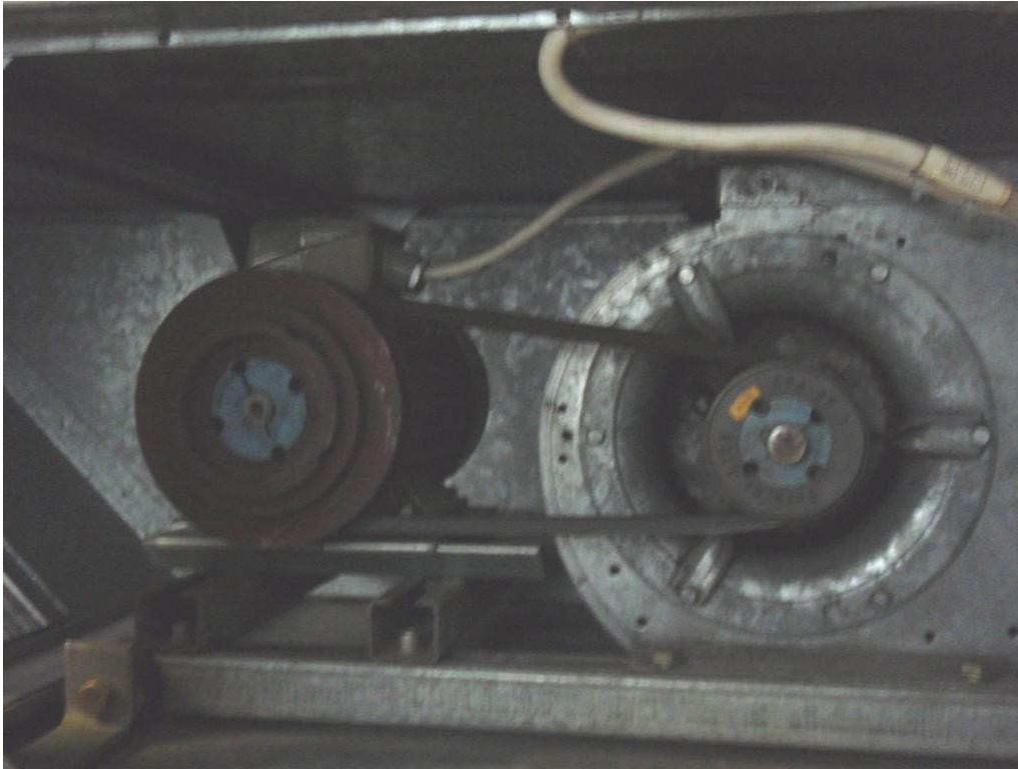
KUVA 5. Tuloilmakoneen 5TP hihna huonossa kunnossa ja löysällä
