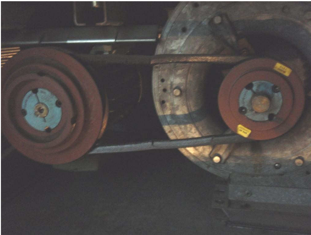
KUVA 6. Poistoilmakoneen 5PP hihna huonossa kunnossa ja löysällä
