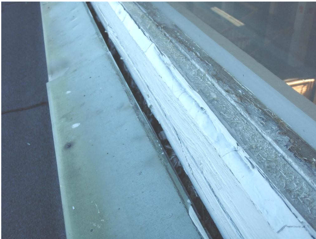
KUVA 9. Ikkunalaudassa on paikoittain jopa 30mm rako eristetilaan.
