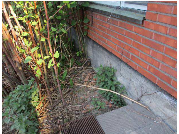
Sokkelin reunasorastus puuttuu, edustalla haitallista kasvillisuutta
