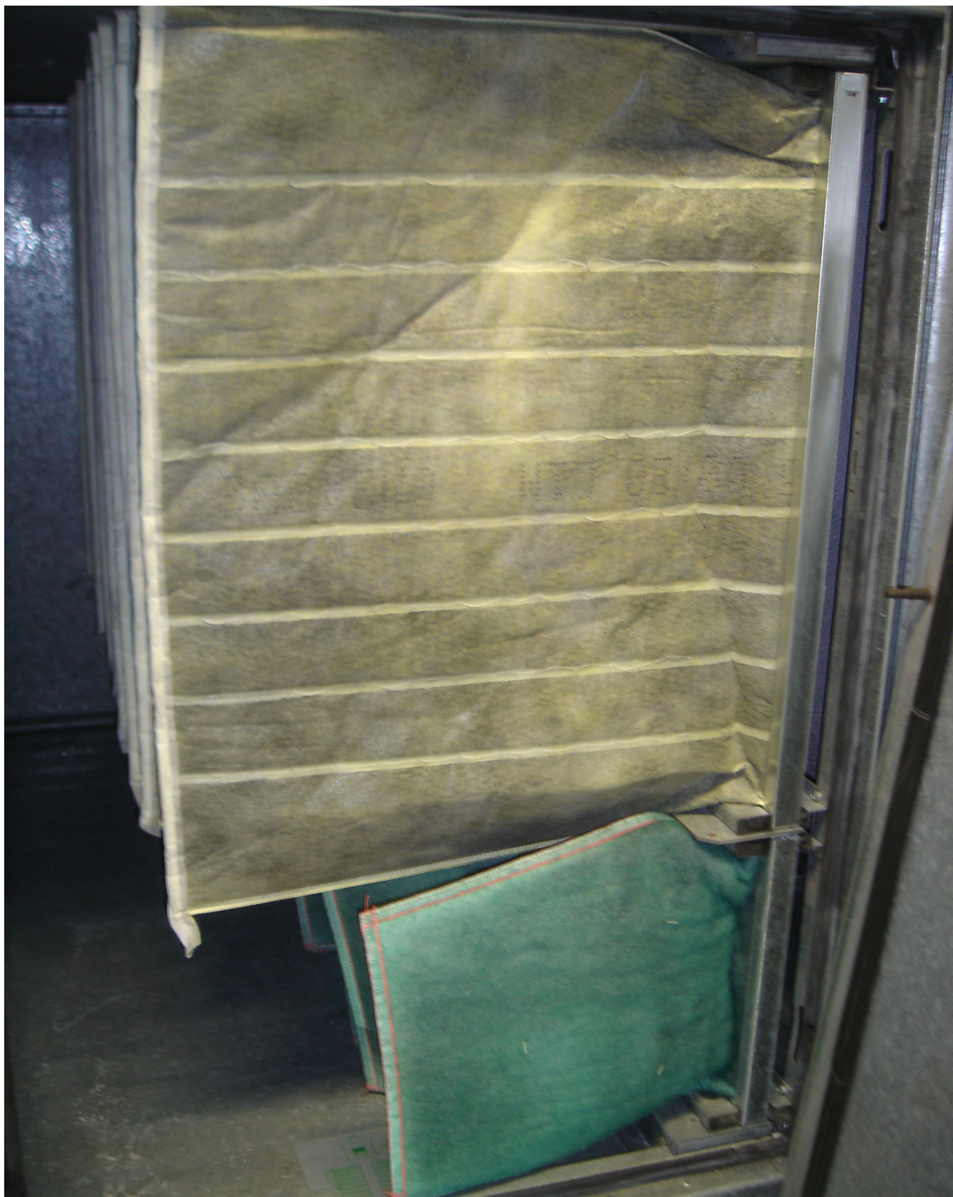
KUVA 9. Yleiskuva tuloilmakoneen TK 4 suodattimista.
