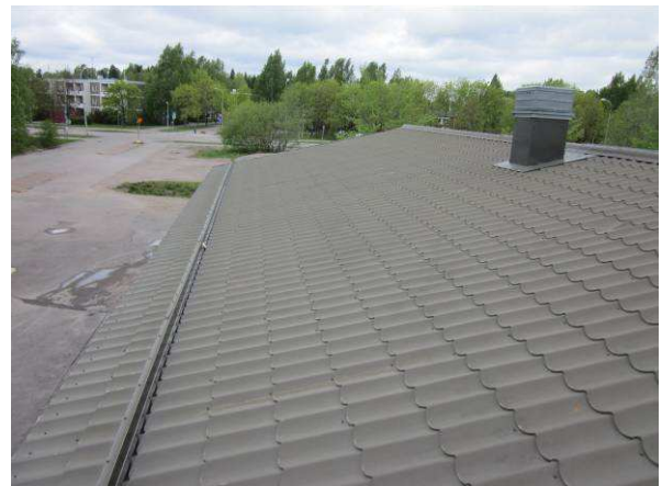
Yleiskuvaa peltikatolta, katteessa on yksittäisiä kolhuja, jotka kannattaa paikkamaalata
