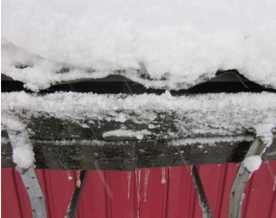
Talotikkaiden kiinnityskohdasta räystäslaudat ovat lähteneet irti
