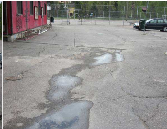
Asfaltissa halkeilua rakennuksen edustalla
