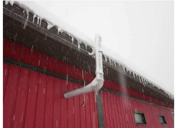
Rakennuksessa ei ole räystäskouruja
