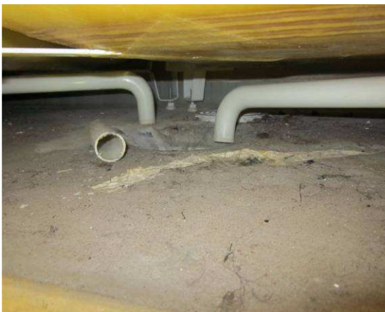
Kuvaa suihkukaappien alapuolelta, toinen poistoputki ei mene lattiakaivoon
