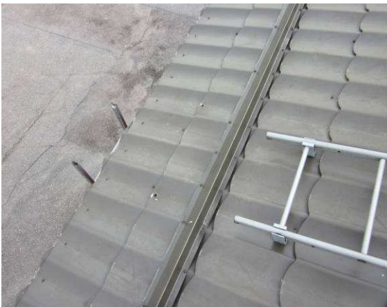
Rikkoutuneiden talotikkaiden kiinnitysruuvien paikoista vesi pääsee räystäsrakenteeseen
