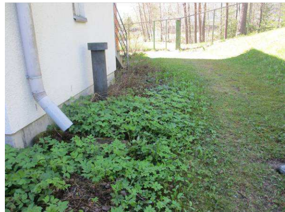
Rakennuksen Länsinurkalla vedenohjaus on puutteellisella tasolla
