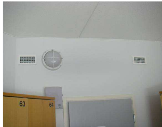
Tulo- ja poistoilmaventtiilejä majoitustilassa.
