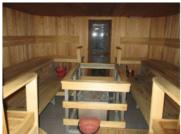
Kuvaa löylyhuoneesta, lauteissa on havaittavissa tummumia
