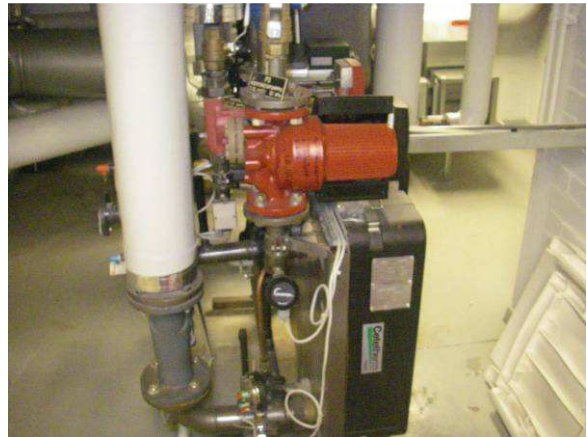
Lämmönsiirripaketti on vuodelta 1995.
