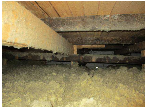
Vanhan osan yläpohjan puurakenteissa tummentumia
