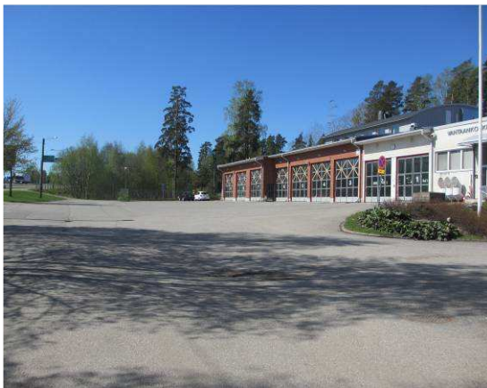
Isolla asfalttikentällä on paikallisia vaurioita
