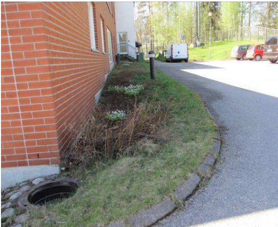
Pohjoisnurkalla maanpinnat kallistavat rakennuksen suuntaan ja vierustalla on humusmaata
