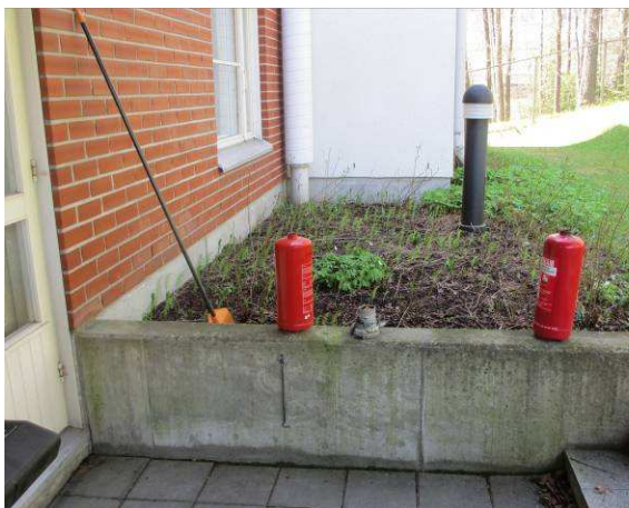
Sokkelin vierustalla multamaata, pintavedet imeytyvät rasittamaan alapuolisia rakenteita.
