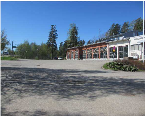
Rakennuksen edustalla on iso asfaltoitu alue, asfaltissa on paikallisia painumia ja vaurioita
