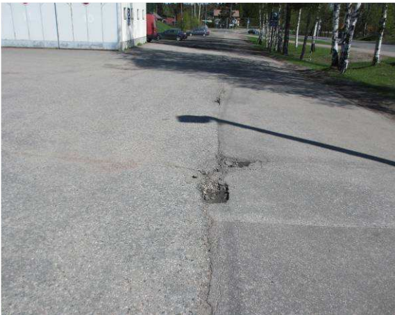
Alueen asfalteissa on painumia ja vaurioita
