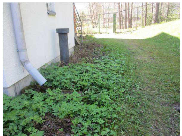
Kuvan syöksytorven edustalla vedenohjauksissa on puutteita
