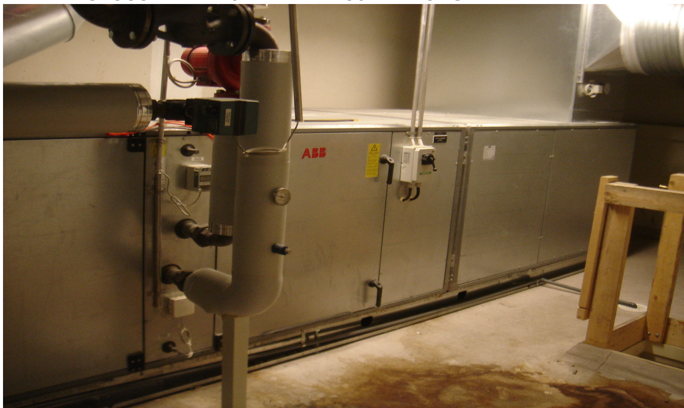
KUVA 1. Yleiskuva IV- konehuoneesta.
