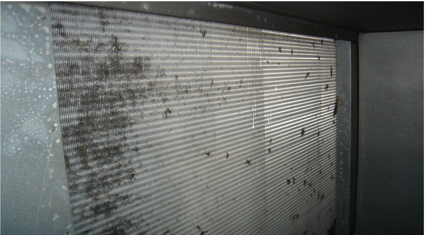
KUVA 54. Yleiskuva lämpöpatterista 15TK1.
