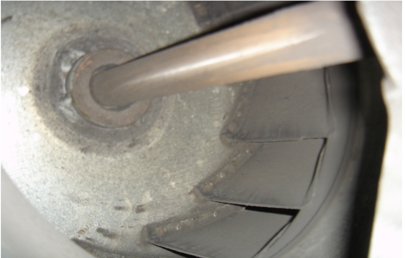
KUVA 37. Yleiskuva poistoilmapuhaltimesta 12PK1.
