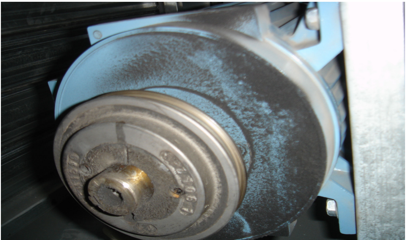
KUVA 36. Yleiskuva tuloilmapuhaltimen moottorista 12PK1.
