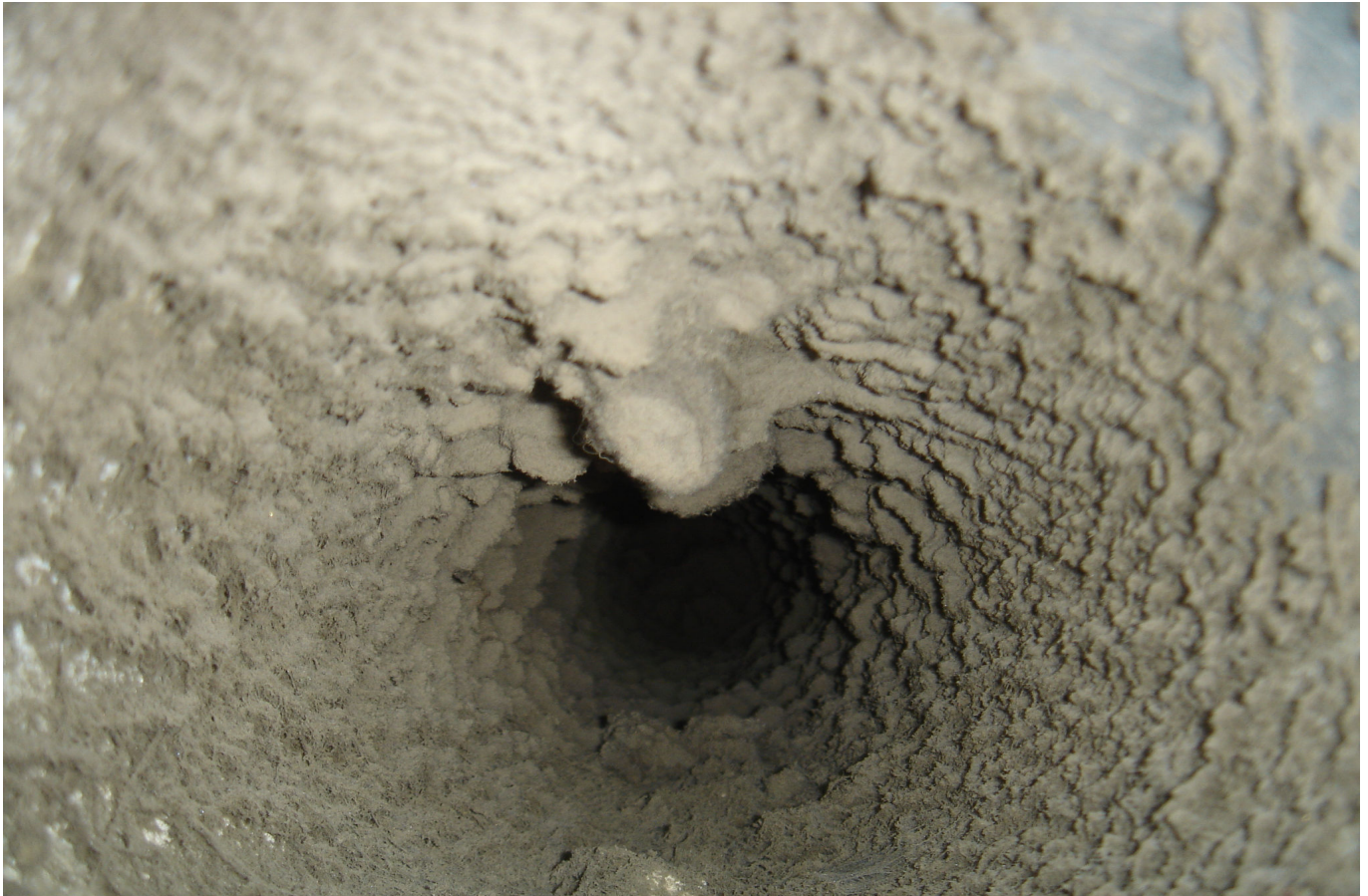
KUVA 65. Yleiskuva huoltomiehen WC- tilojen poistoilmakanavasta.
