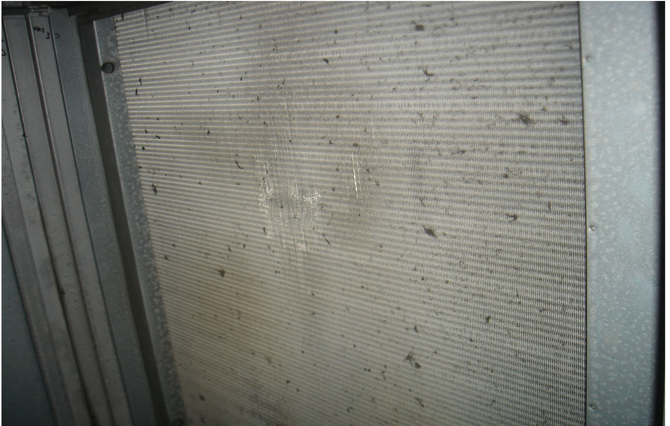
KUVA 15. Yleiskuva LTO- patterista TK05.
