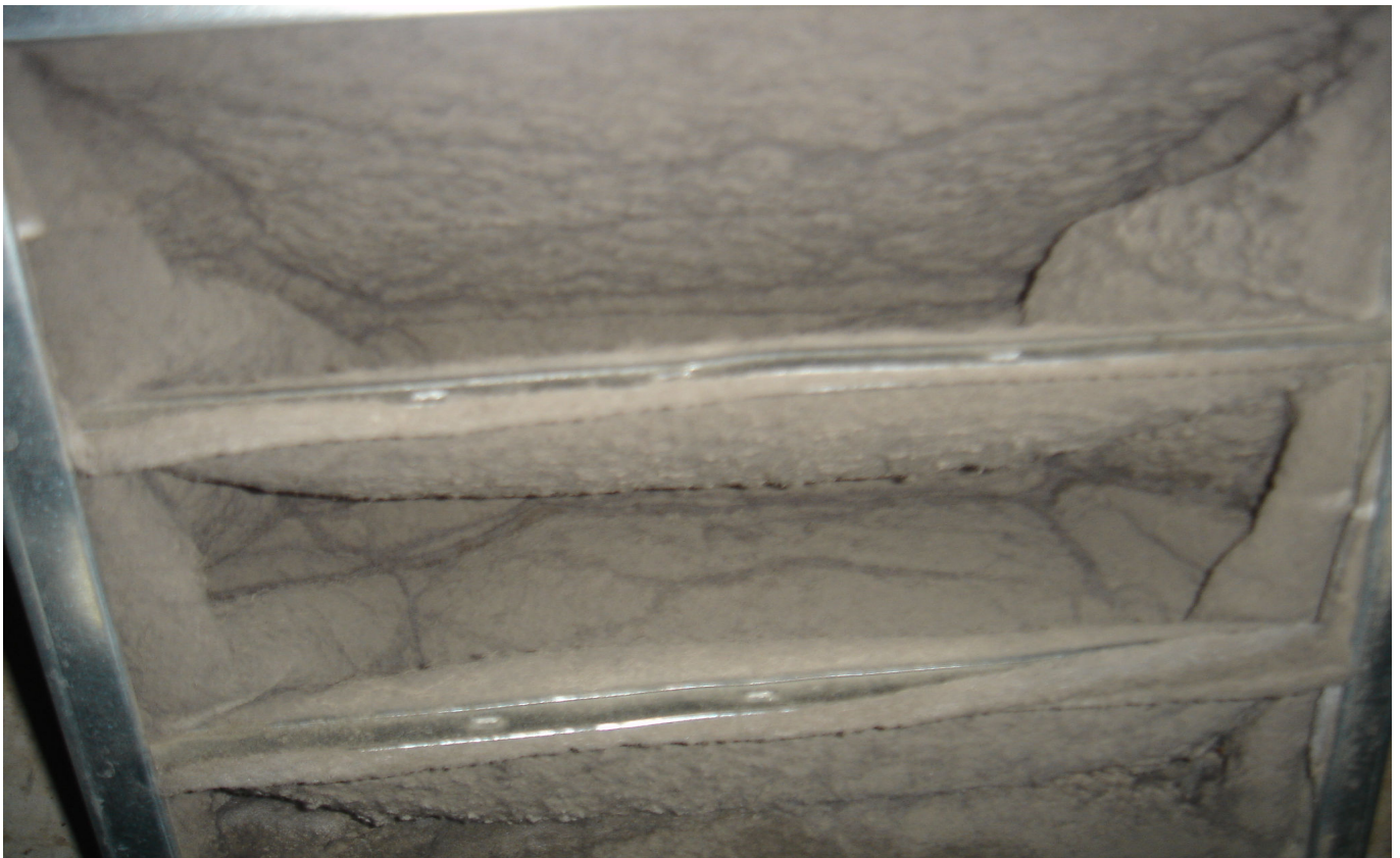
KUVA 50. Yleiskuva poistoilmasuodattimesta 13PK1.
