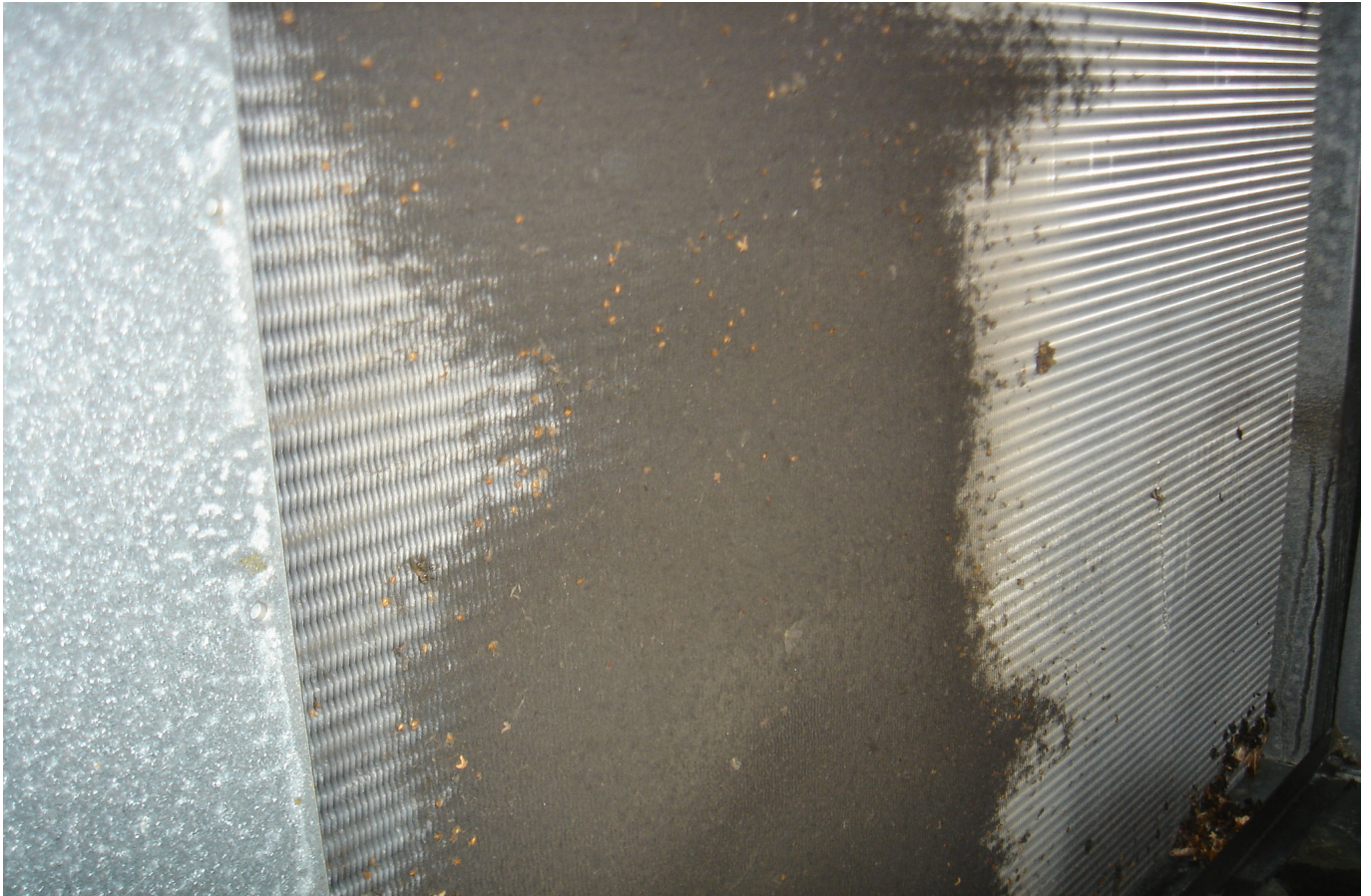
KUVA 43. Yleiskuva lämpöpatterista 13TK2.
