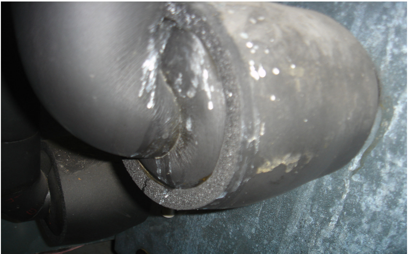
KUVA 10. LTO:n laippaliitos vuotaa 3TK1.
