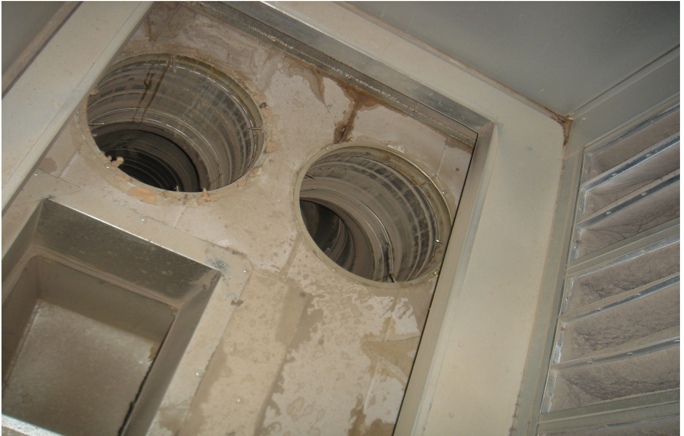
KUVA 51. Yleiskuva poistoilmakammioista 13PK1.
