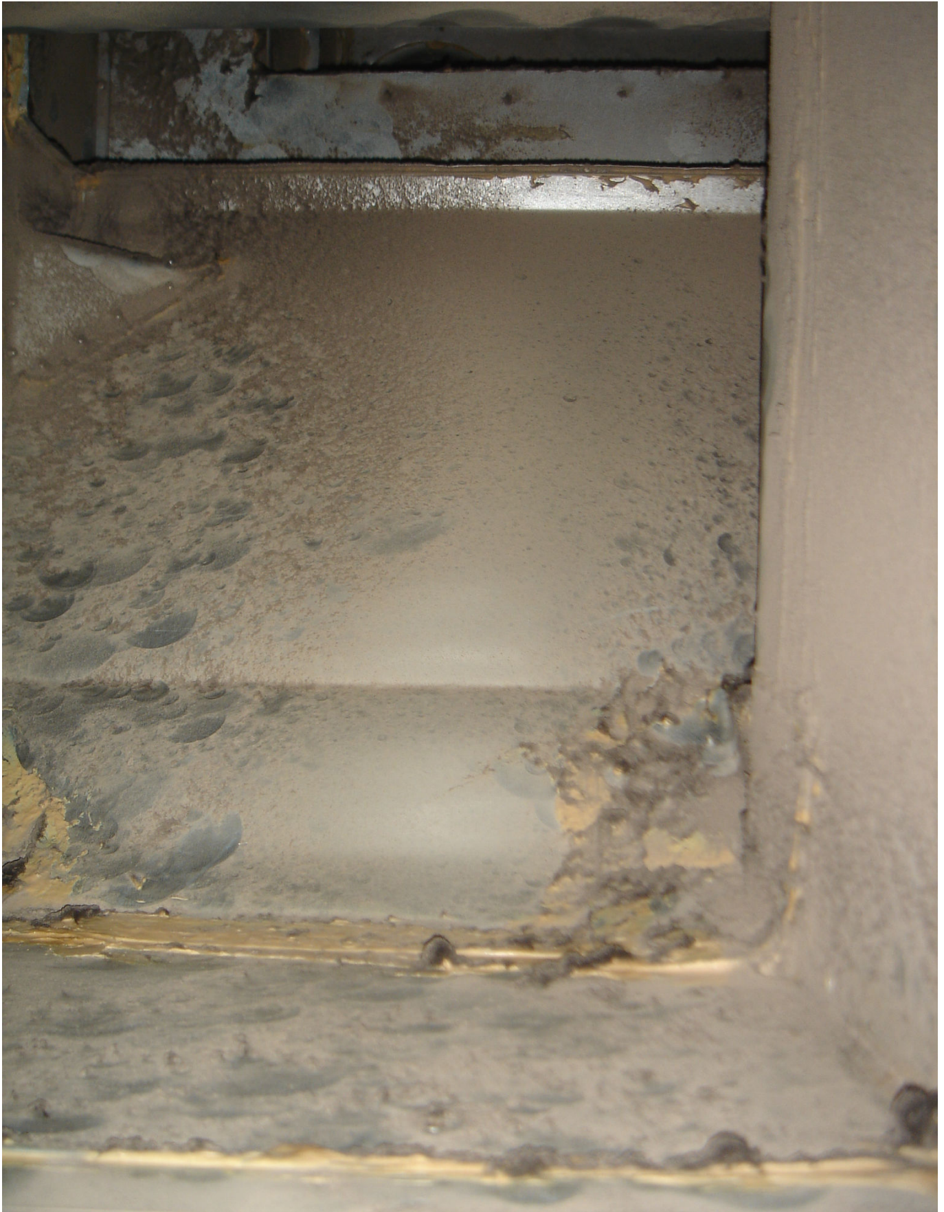
KUVA 12. Yleiskuva poistoilmakammioista 3PK1.
