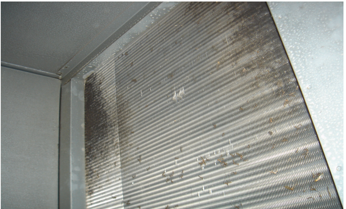
KUVA 24. Yleiskuva lämpöpatterista 11TK1.
