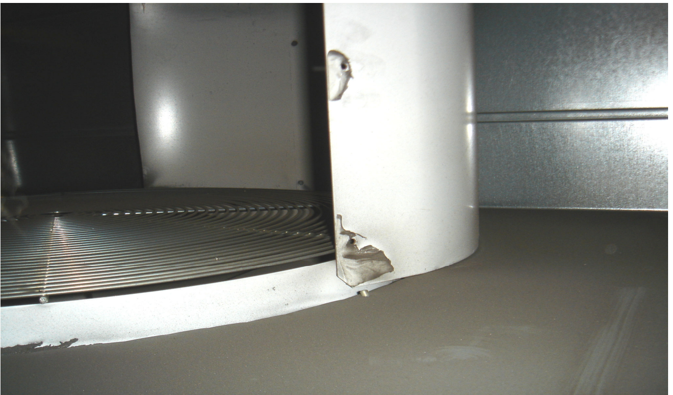
KUVA 30. Yleiskuva puhaltimen kammiosta 11KK1.
