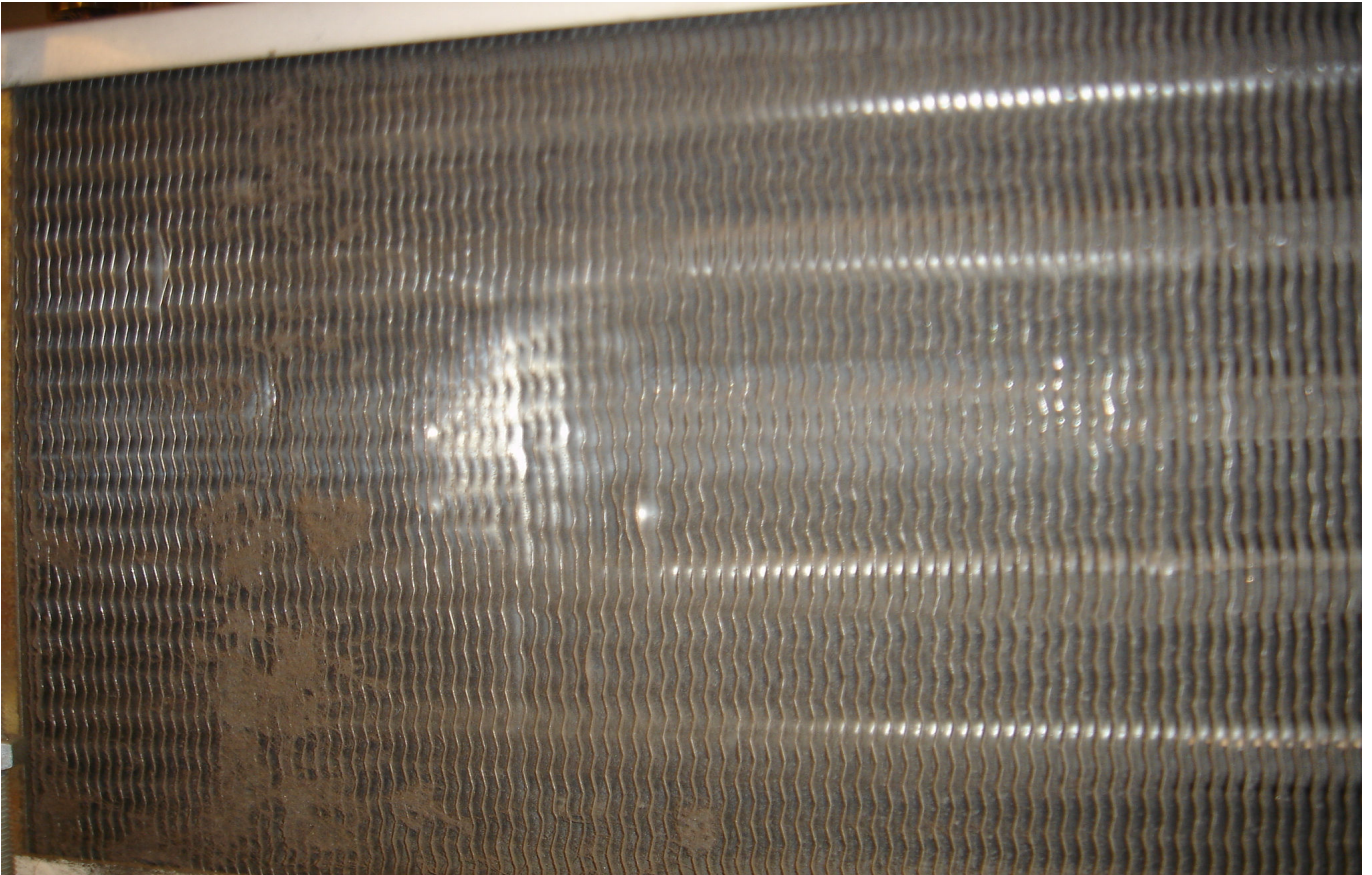
KUVA 29. Yleiskuva lämpöpatterista 11KK1.
