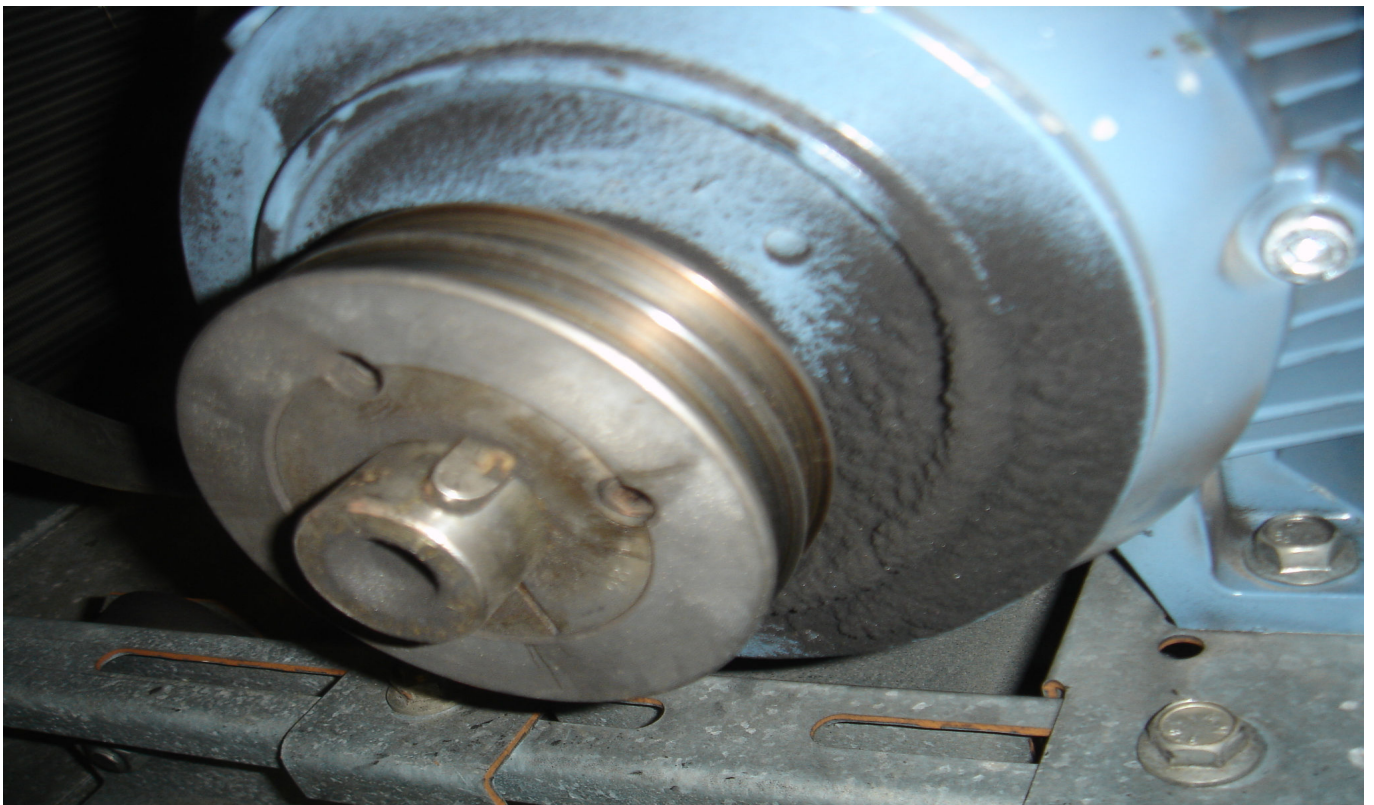
KUVA 16. Yleiskuva tuloilmapuhaltimen moottorista TK05.
