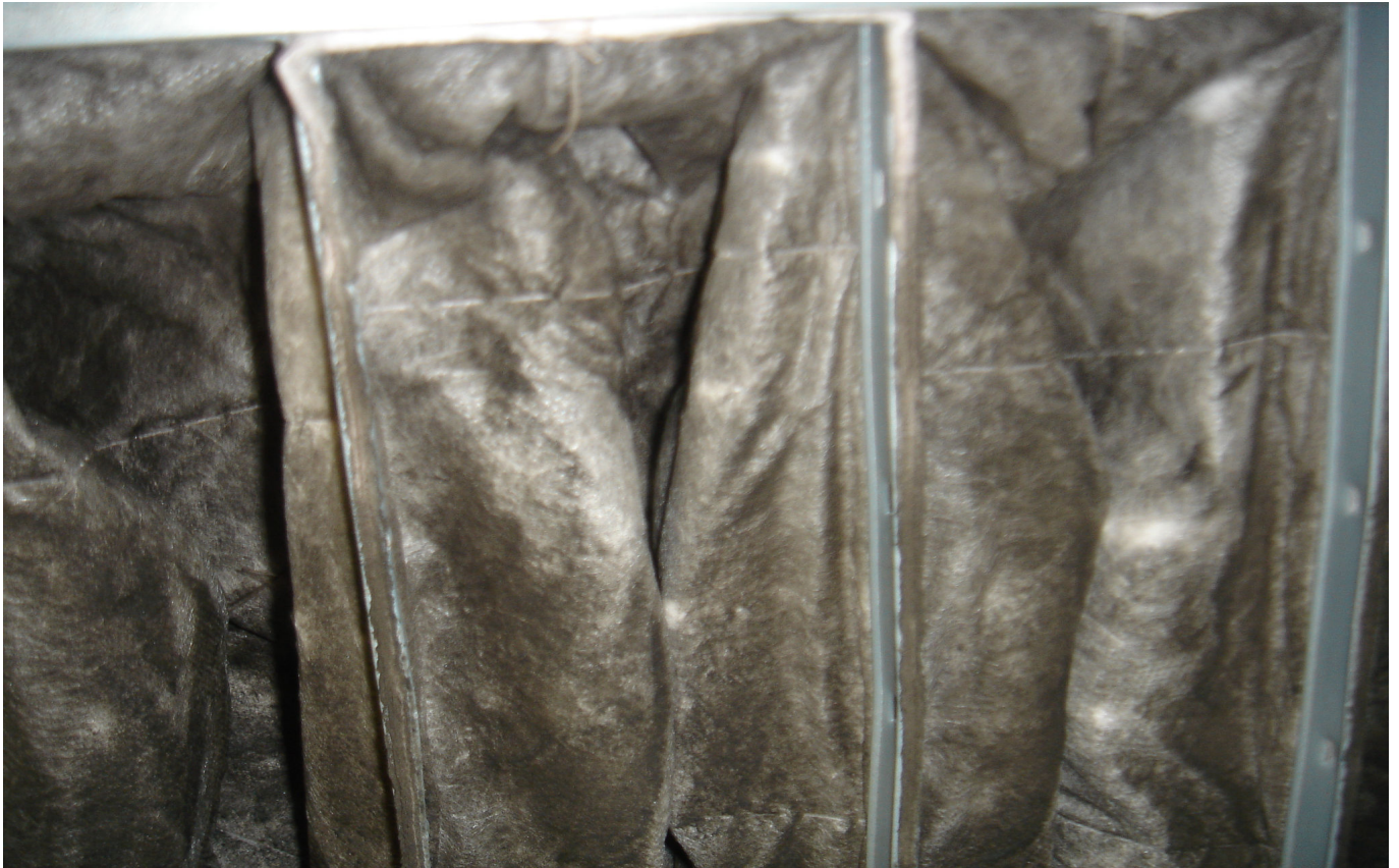
KUVA 3. Yleiskuva tuloilmasuodattimesta 2TK1.
