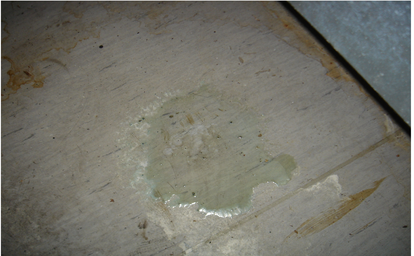
KUVA 9. LTO:n laippaliitos vuotaa 3TK1.
