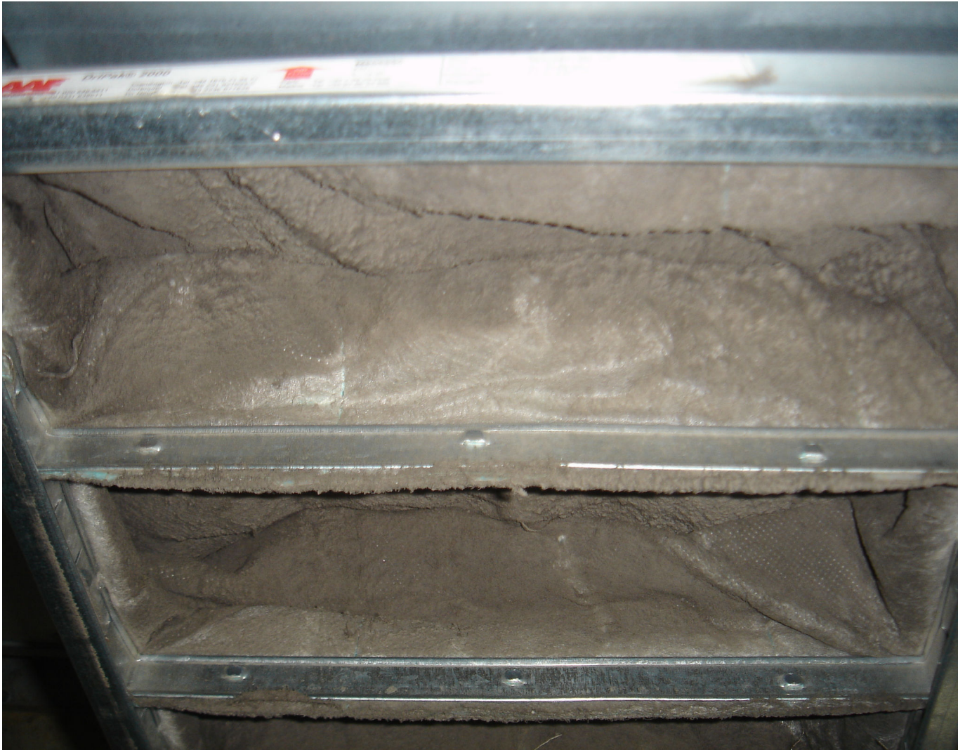
KUVA 11. Yleiskuva poistoilmasuodattimesta 3PK1.
