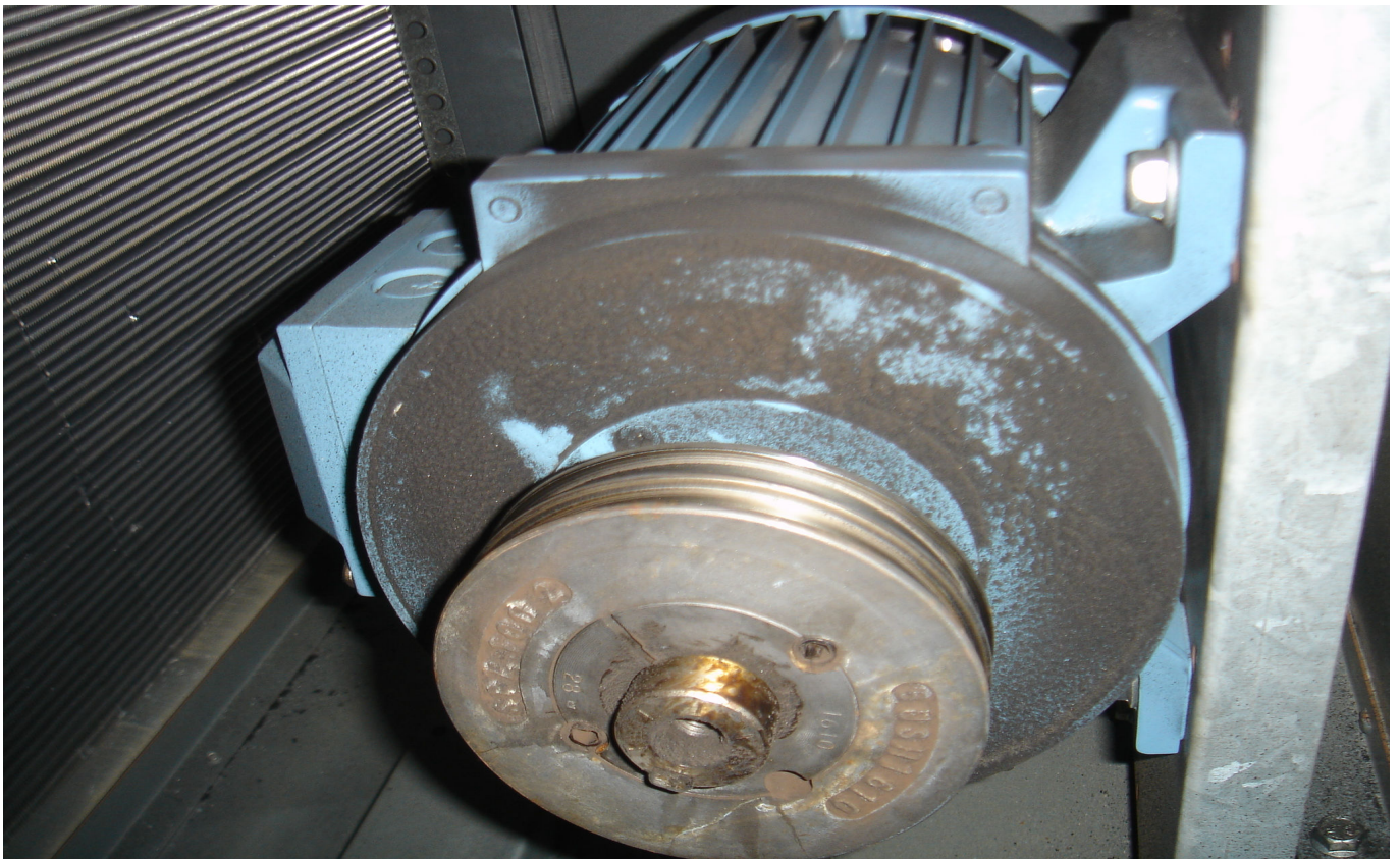
KUVA 34. Yleiskuva tuloilmapuhaltimen moottorista 12TK1.
