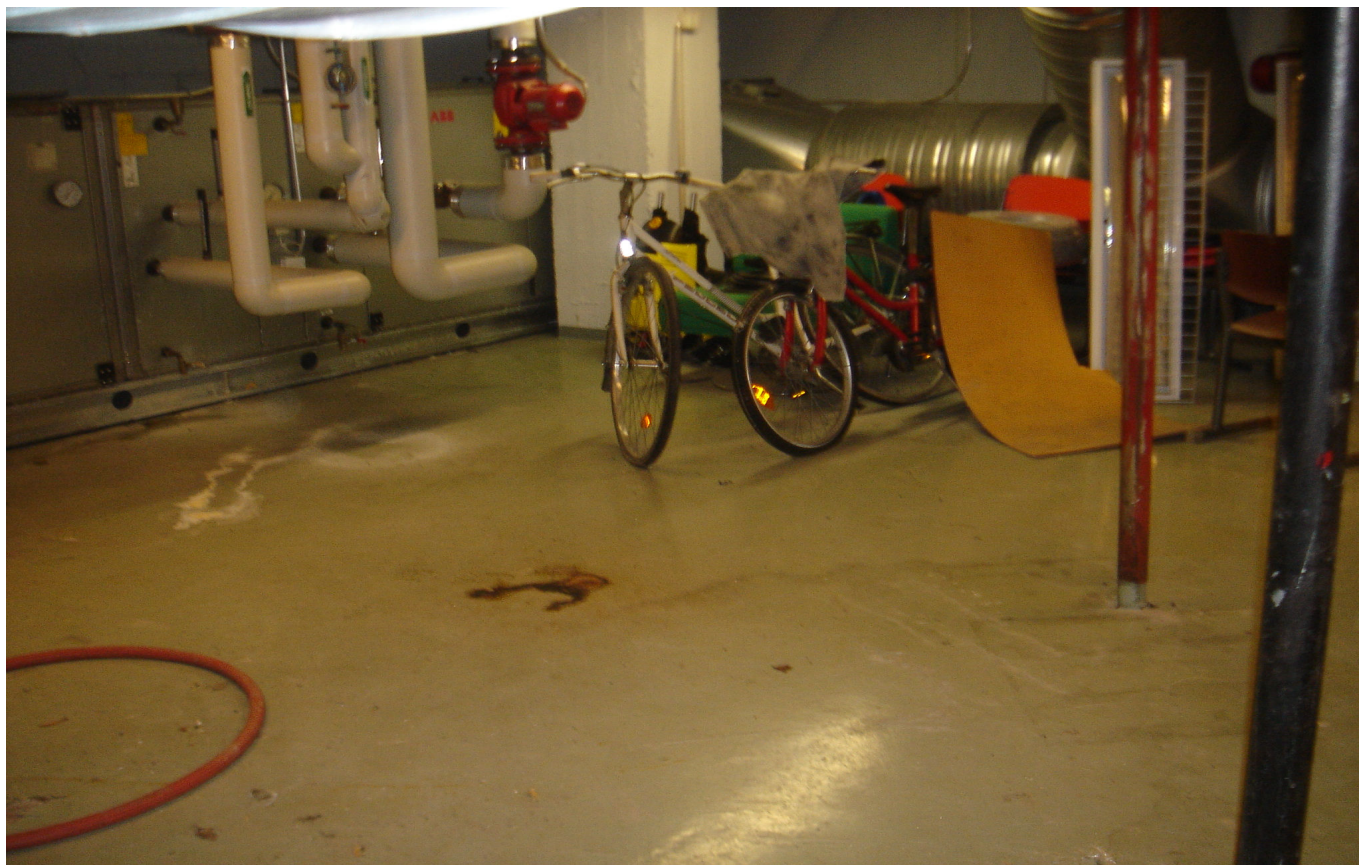
KUVA 2. Yleiskuva IV- konehuoneesta.
