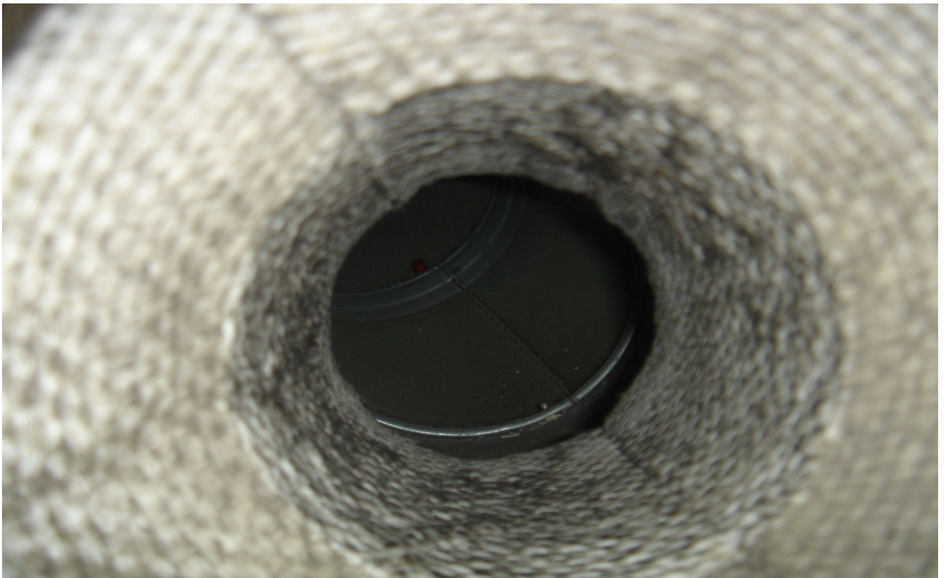
KUVA 60. Yleiskuva tuloilmakanavassa olevasta äänenvaimentimesta.
