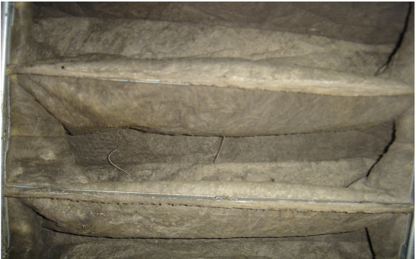
KUVA 14. Yleiskuva tuloilmasuodattimesta TK05.
