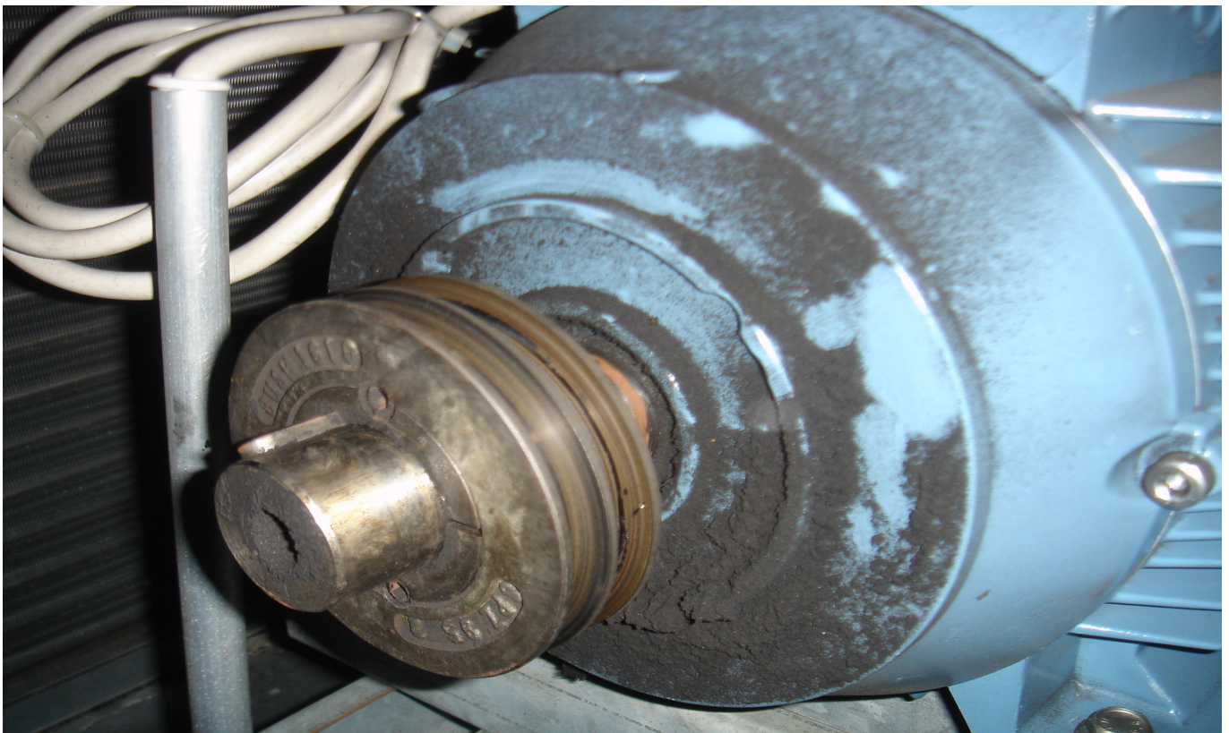
KUVA 40. Yleiskuva tuloilmapuhaltimen moottorista 13TK1.
