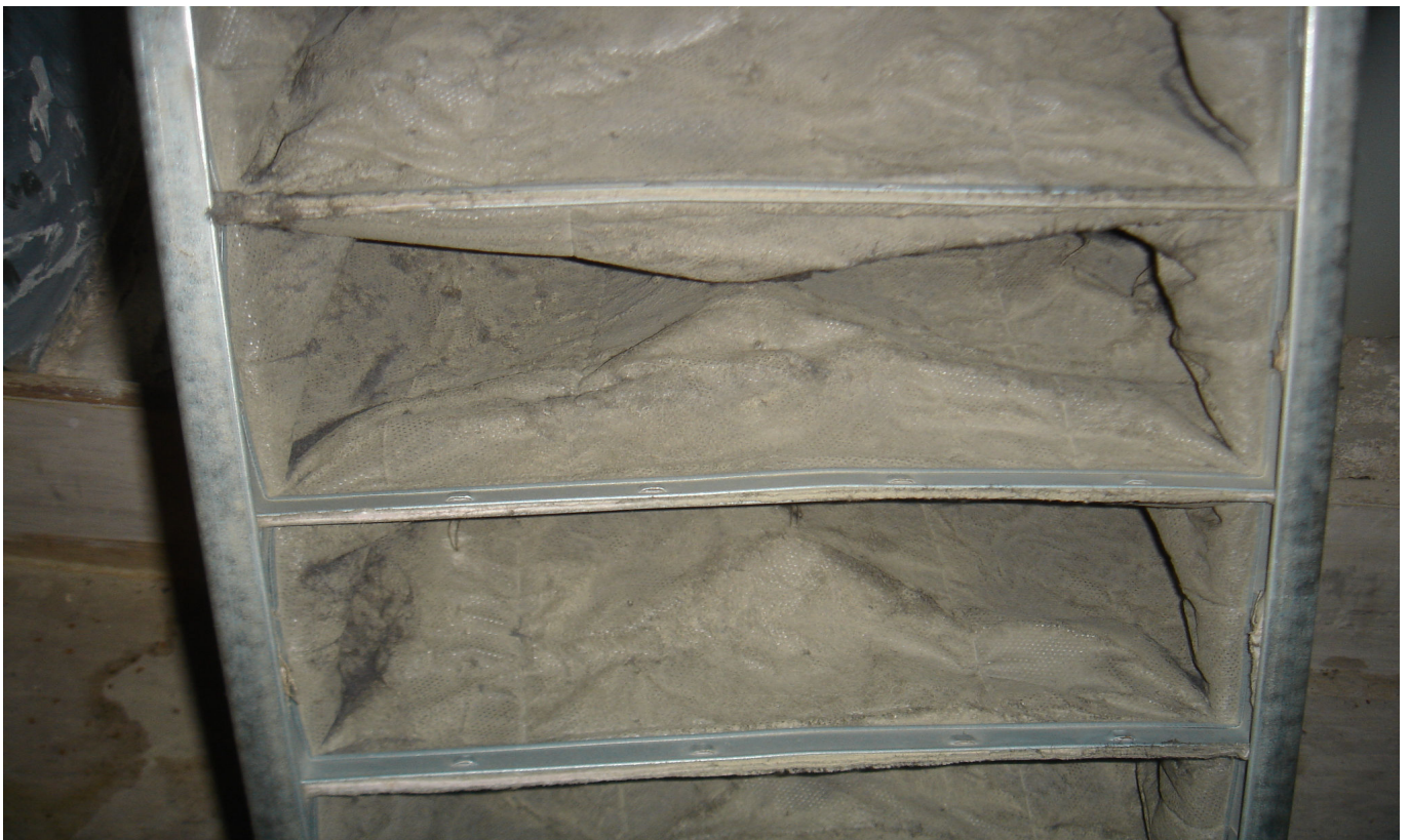
KUVA 46. Yleiskuva tuloilmasuodattimesta 13TK3.
