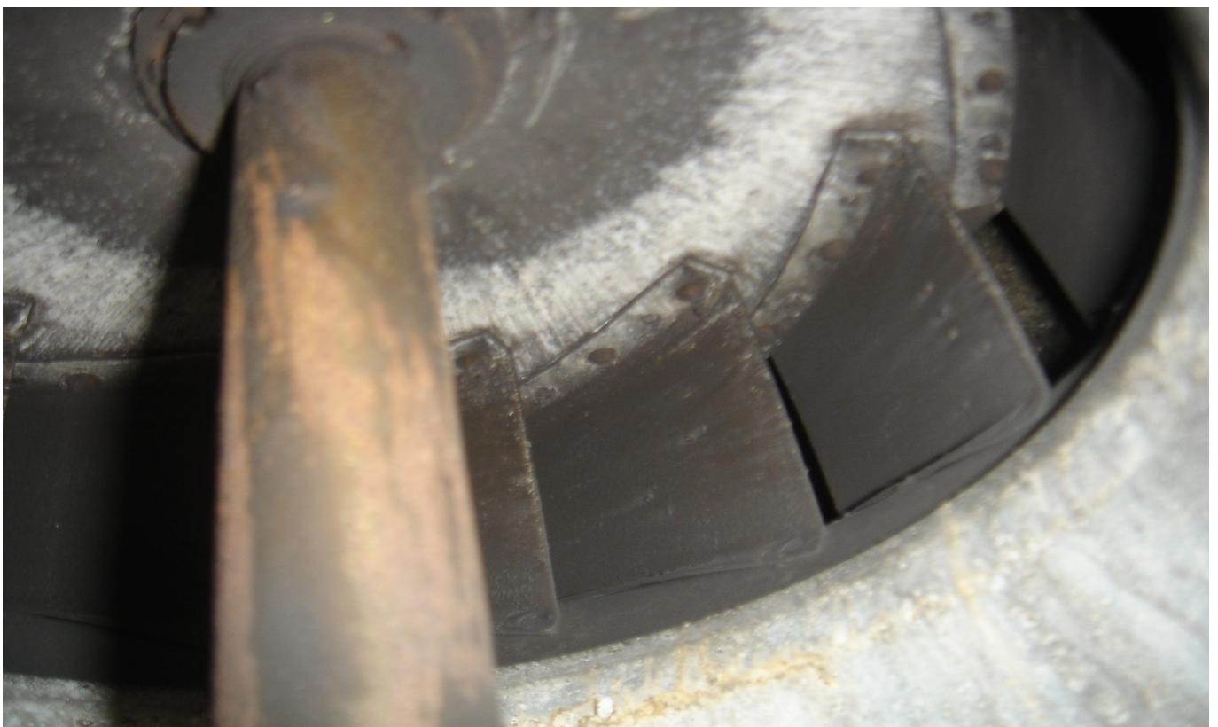
KUVA 44. Yleiskuva tuloilmapuhaltimesta 13TK2.
