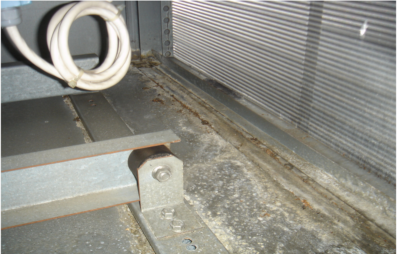
KUVA 45. Yleiskuva tuloilmakoneen kammiosta 13TK2.
