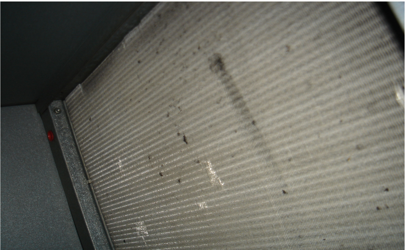
KUVA 8. Yleiskuva LTO- patterista 3TK1.
