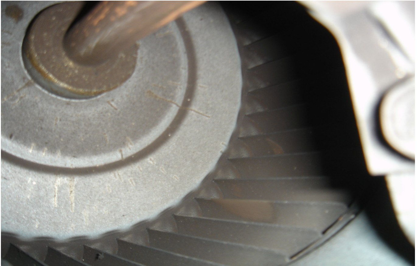
KUVA 25. Yleiskuva tuloilmapuhaltimesta 11TK1.
