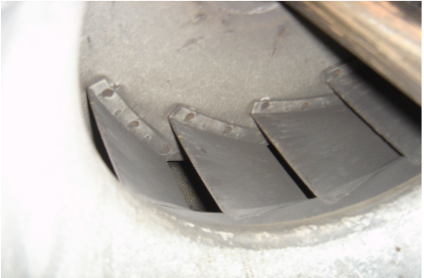
KUVA 41. Yleiskuva tuloilmapuhaltimesta 13TK1.
