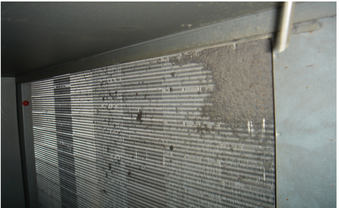
KUVA 48. Yleiskuva lämpöpatterista 13TK3.
