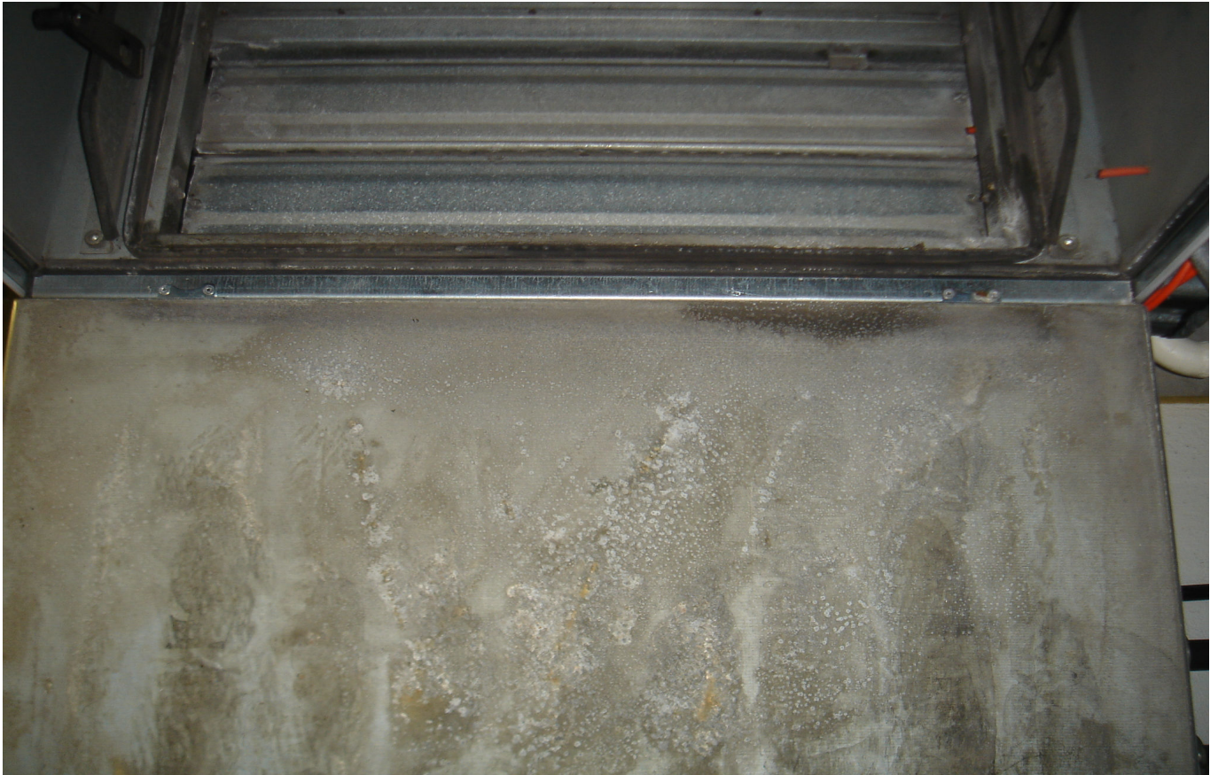
KUVA 5. Yleiskuva tuloilmakoneen kammiosta 2TK1.
