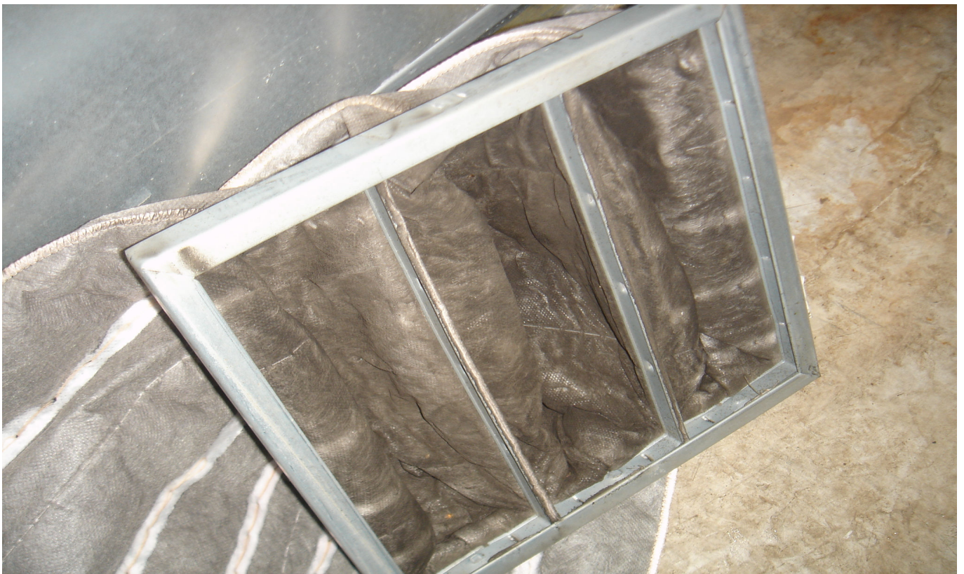
KUVA 38. Yleiskuva tuloilmasuodattimesta 13TK1.
