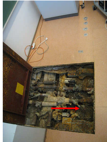
Kuva 2 Äidinkielen luokan 206 MP6 (1-4). Vapautta vettä nuolen osoittamassa kohdassa. Ventilivuoto tv..
